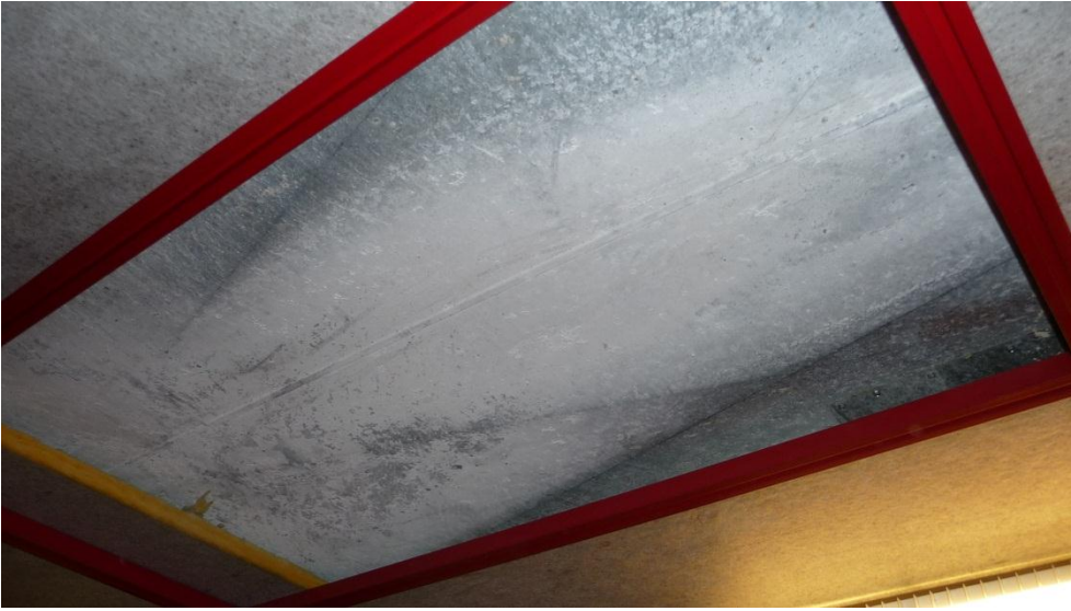
Käytävän katon kanavistoa, kondenssikosteuden jälkiä
