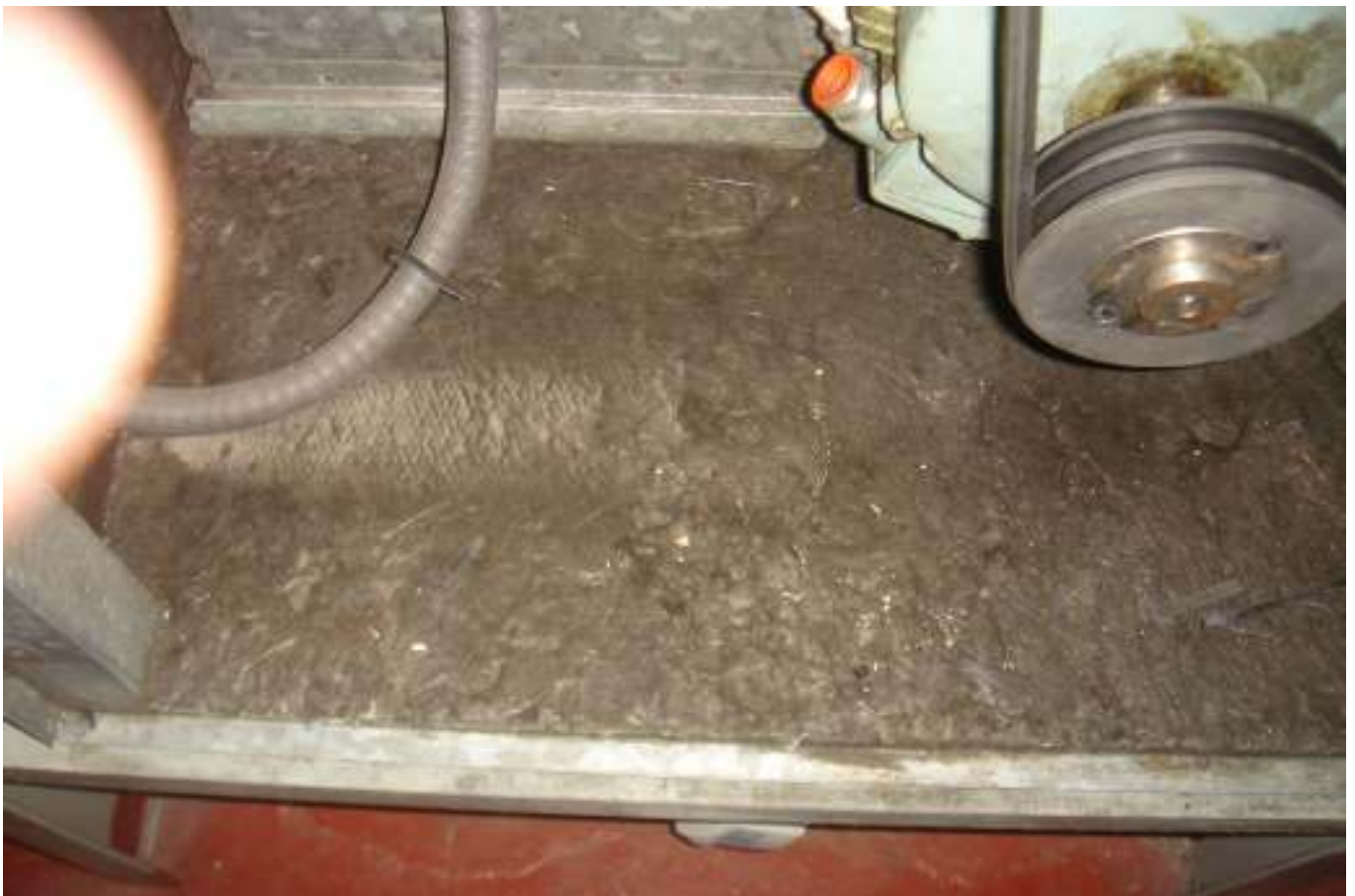
KUVA 16. Kammioiden läpiviennit eivät ole tiiviitä.
