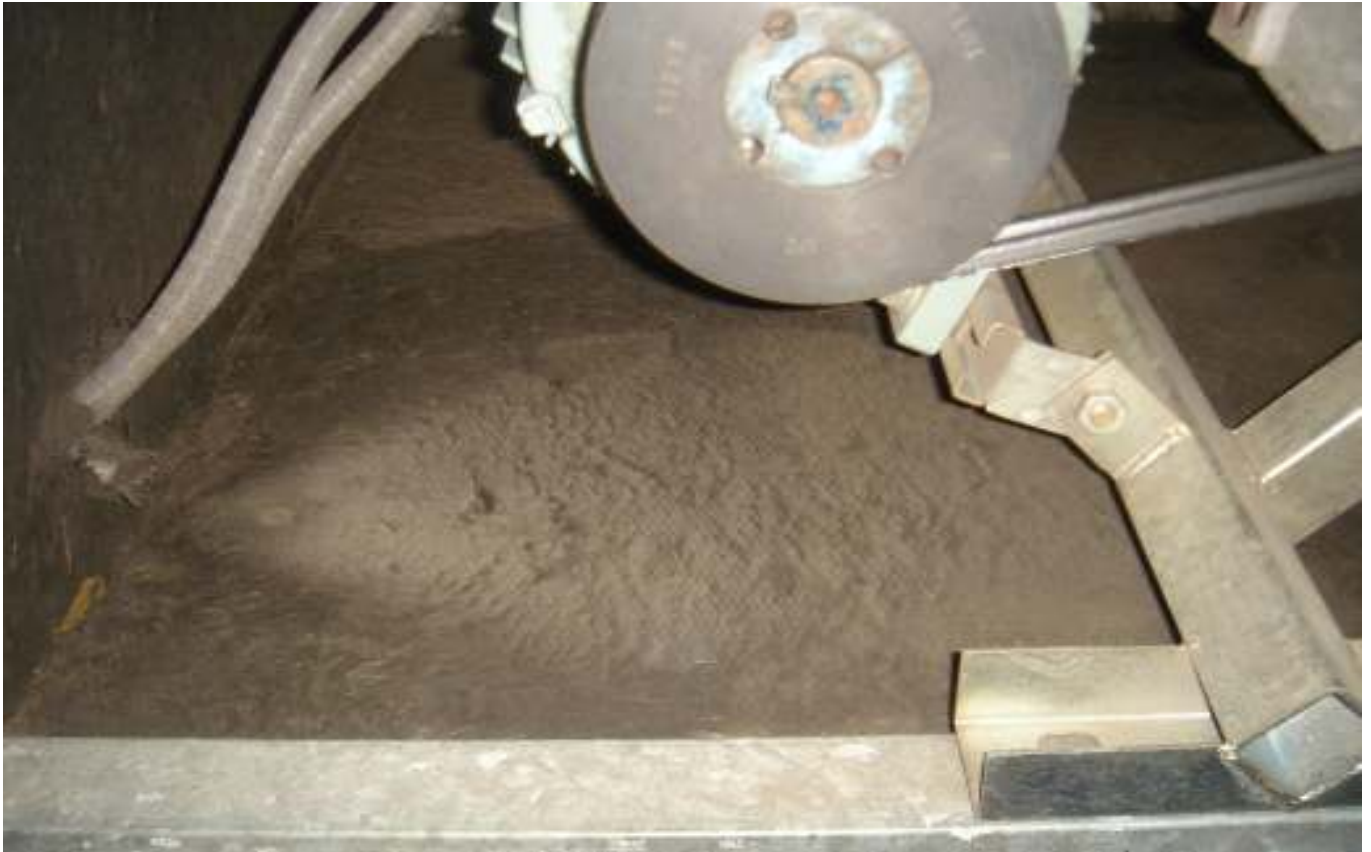
KUVA 7. Kammioiden läpiviennit eivät ole tiiviitä.
