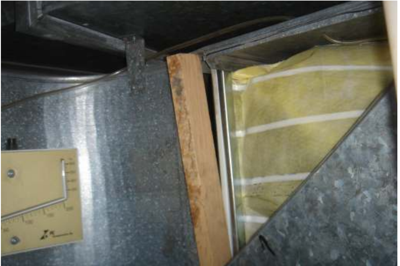
KUVA 11. Suodatinseinämät eivät ole tiiviitä (seinämää on tiivistetty laudalla).
