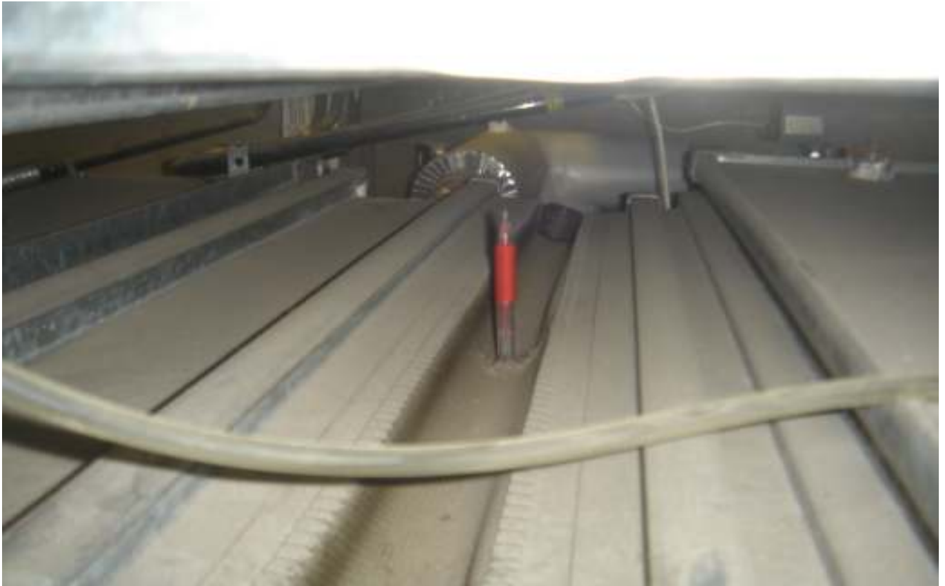
KUVA 15. Tuloilmakoneen joustavassa liittimessä on reikä.
