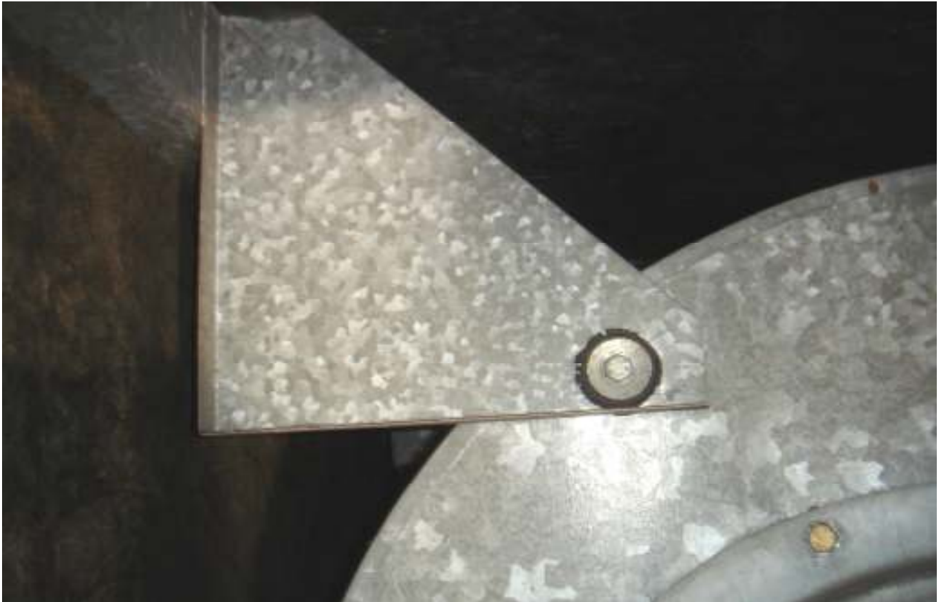
KUVA 5. Puhaltimien kumityynynt ovat heikossa kunnossa.
