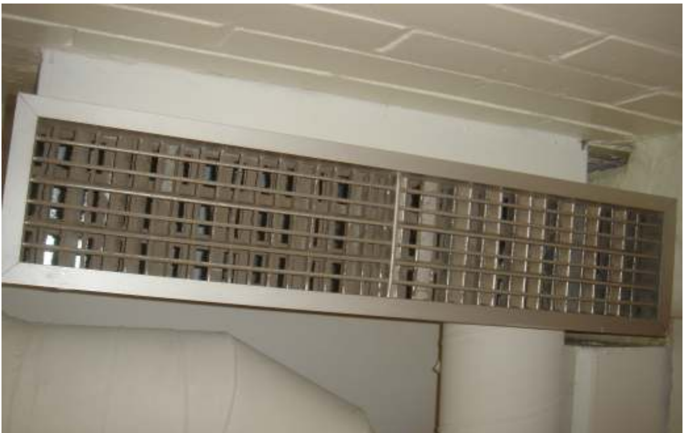
KUVA 22. Poistoilmasäleikkö on melko pölyinen.
