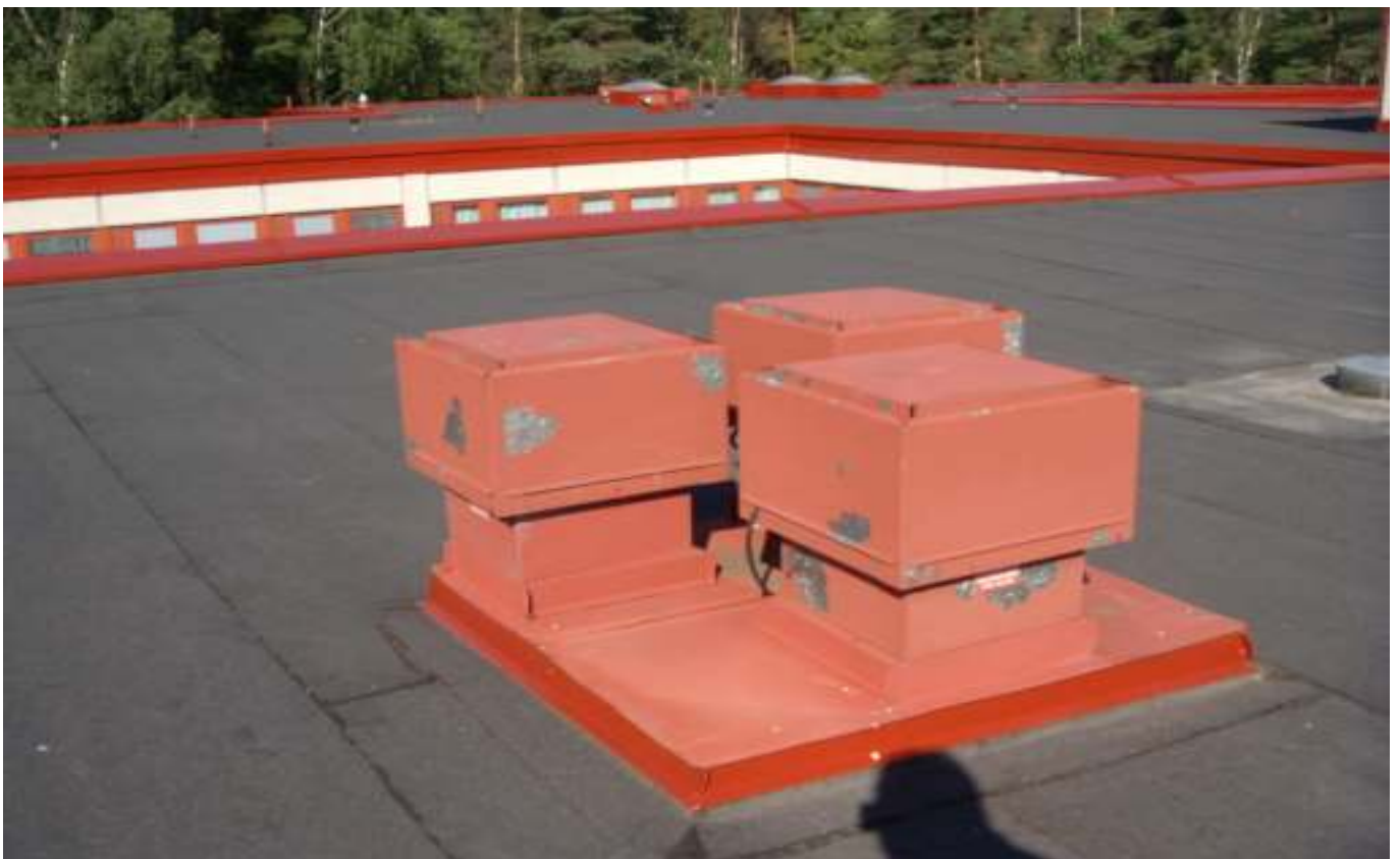
KUVA 18. Vesikatolla olevia huippuimureita, jotka eivät olleet päällä.
