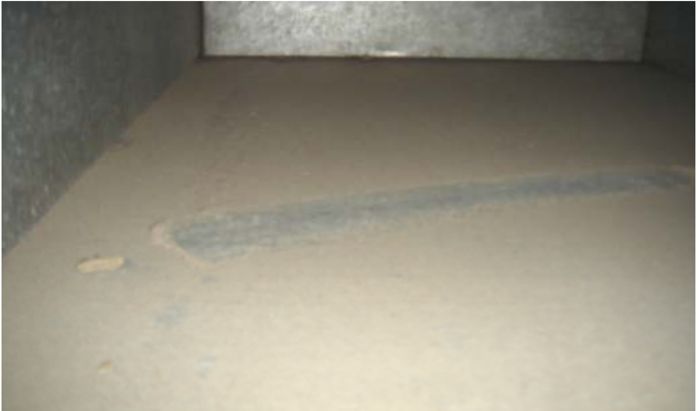
KUVA 23. Poistoilman pääte-elimessä on melko paljon pölykertymää.
