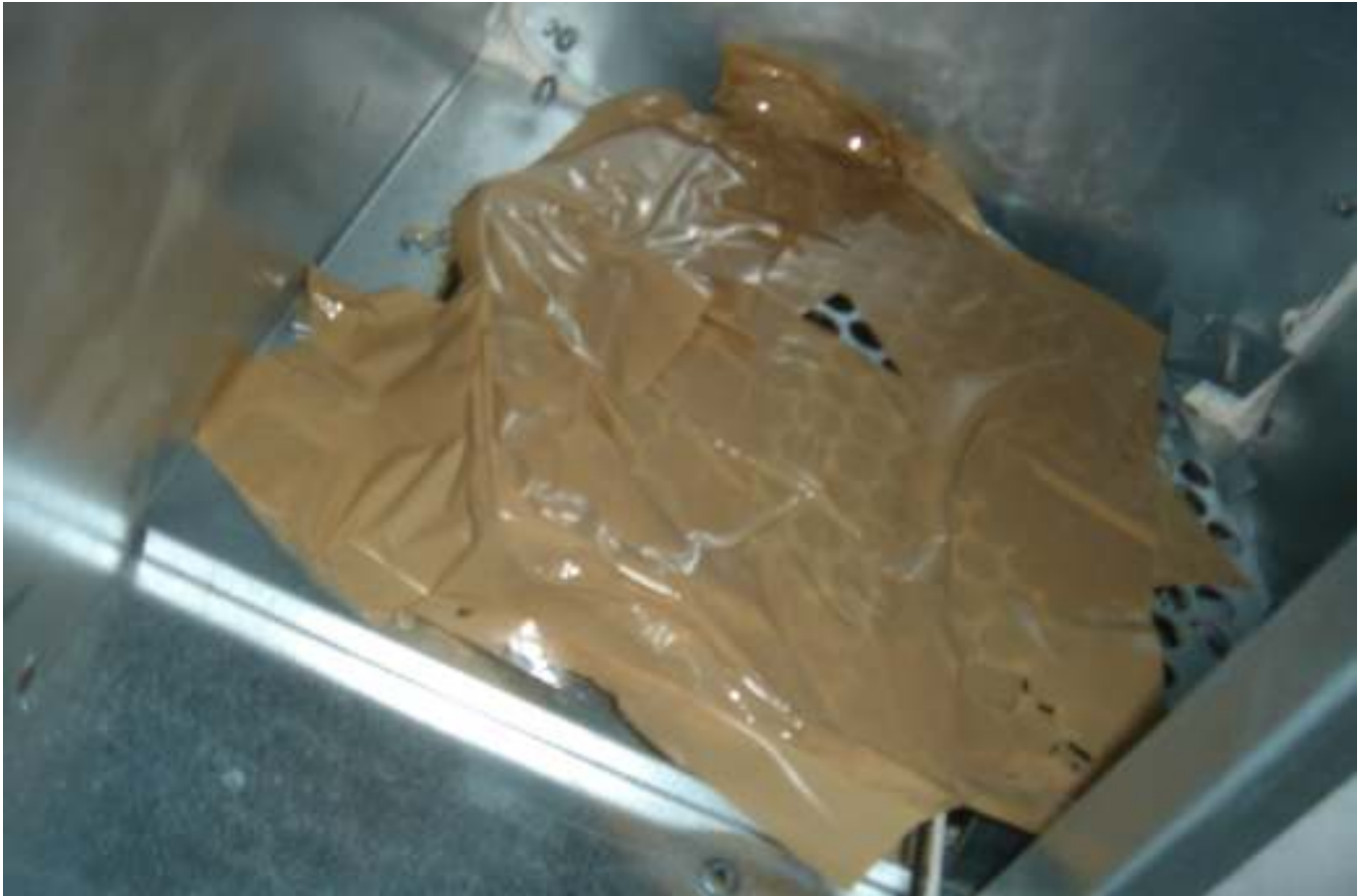
KUVA 21. Huoneen n:o 2082 tuloilman pääte-elin on tukittu.
