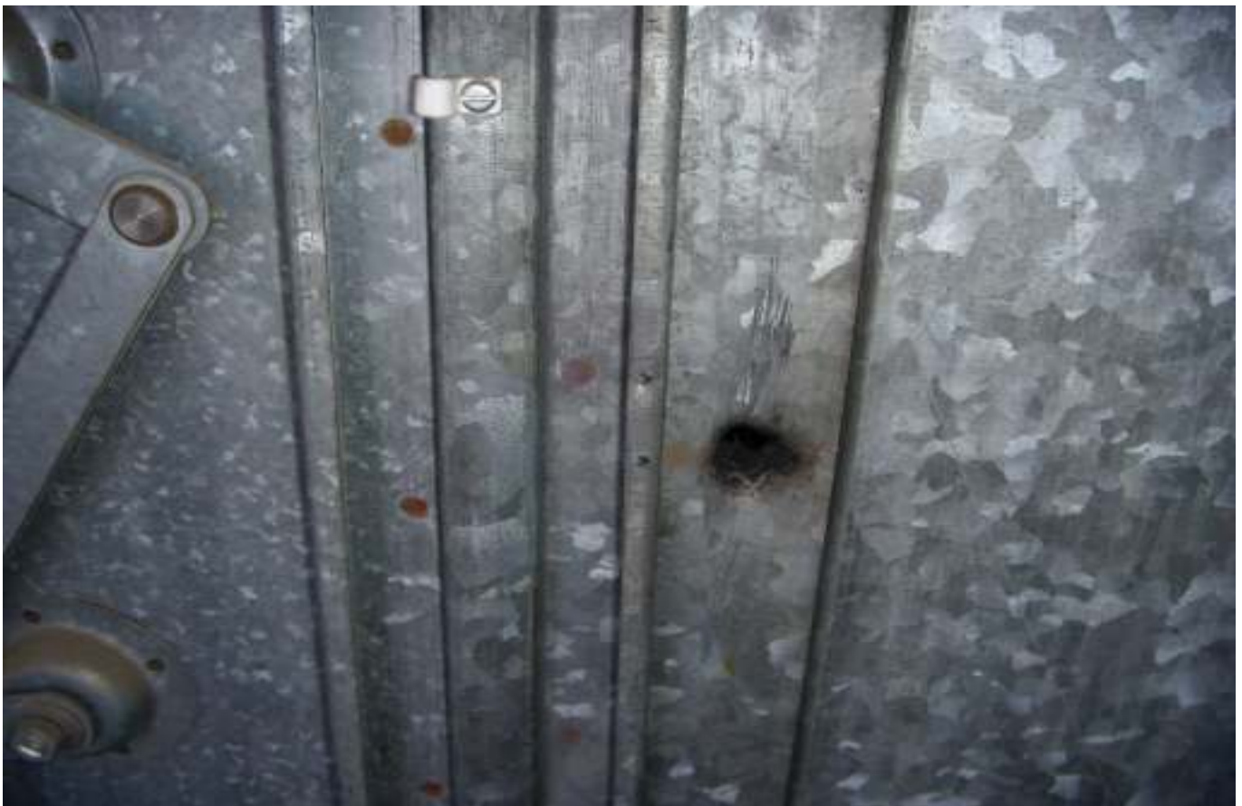
KUVA 8. Kammioissa on turhia reikiä.
