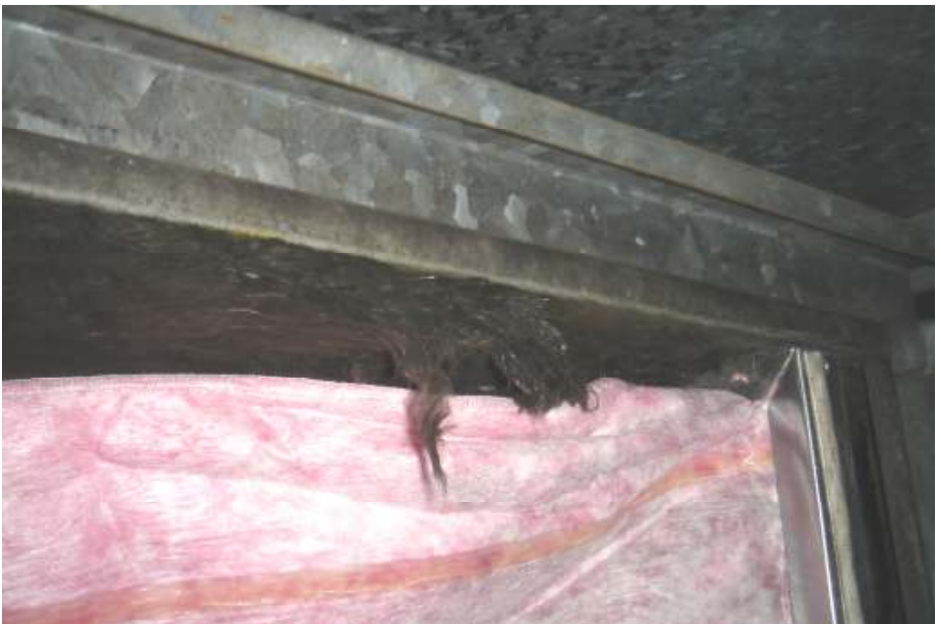
KUVA 10. Kammioiden villapinta on osin rikki.
