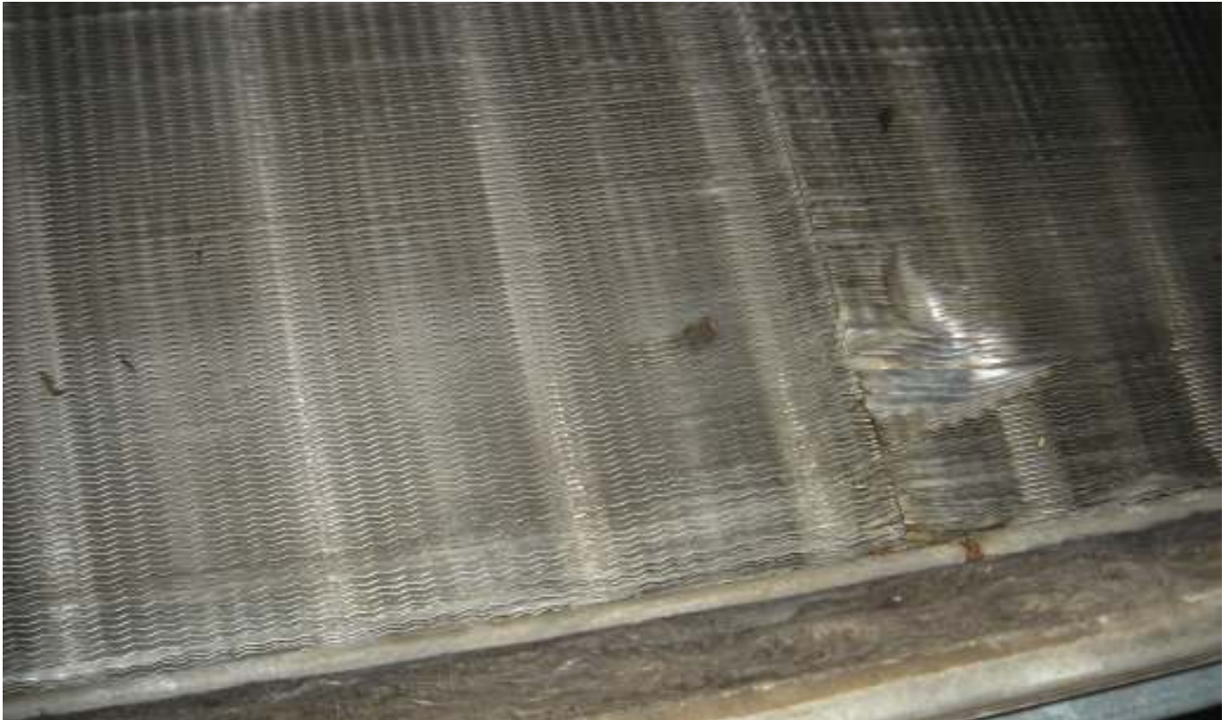
KUVA 13. Lämmityspatterissa on muutama kolhu, jotka tulee kammata auki.
