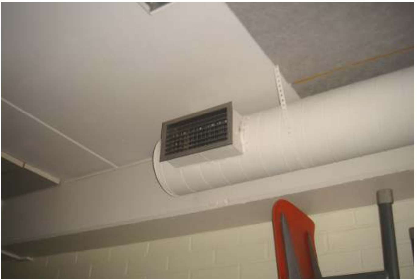
KUVA 20. Luokkatilojen tuloilmasäleiköt ovat ritiläsäleikköjä.
