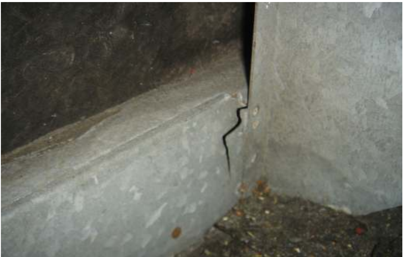
KUVA 6. Poistoilmapuhaltimen kiinnitys on hieman revennyt.
