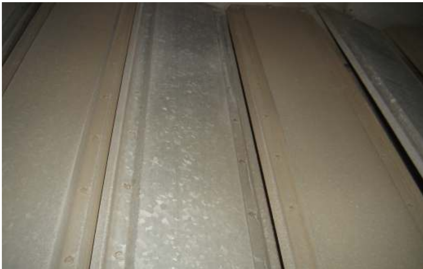
KUVA 2. Tuloilmakoneen TU 16 sulkupelti ei sulkeudu täysin.
