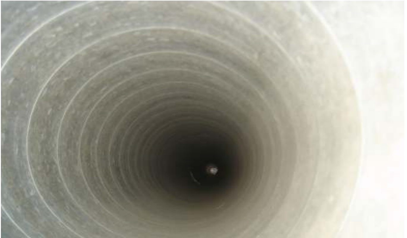
KUVA 19. Tuloilmakanavissa on hieman pölykertymää.
