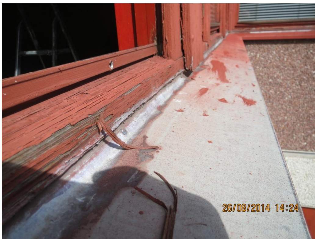
Kuva 3: ikkunakarmin alareuna ulkopuolelta
