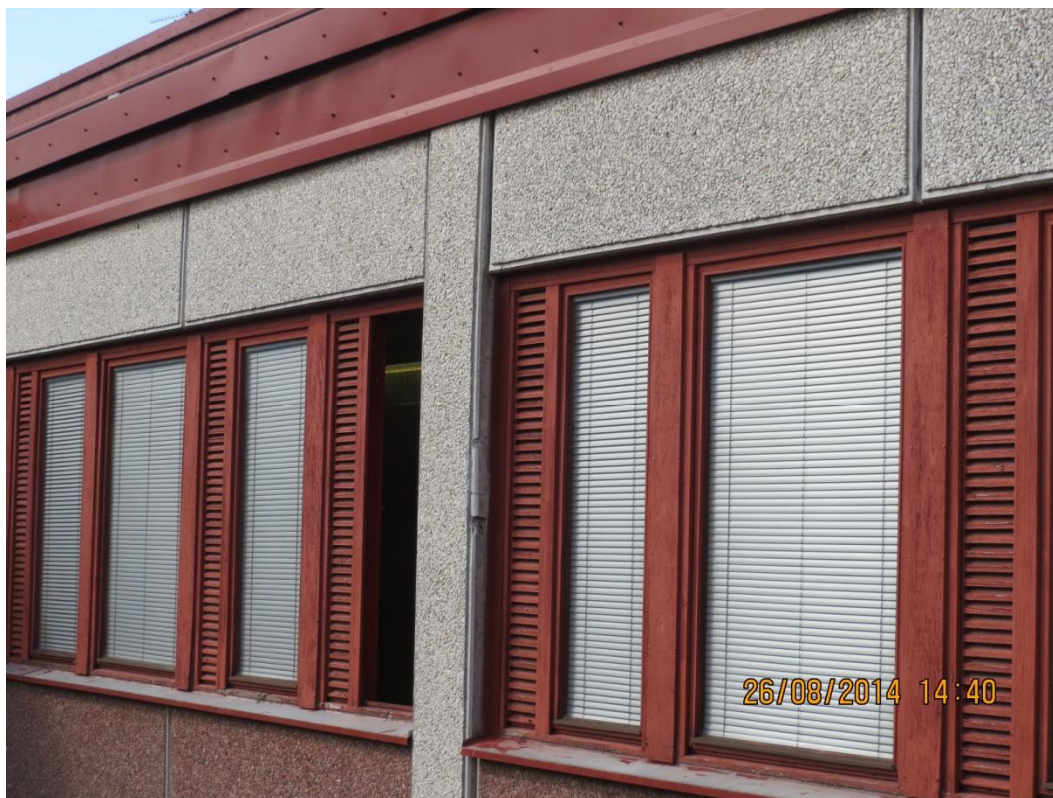
Kuva 8: pilarin kohdalla oleva kuorielementti vaurioitunut nurkasta
