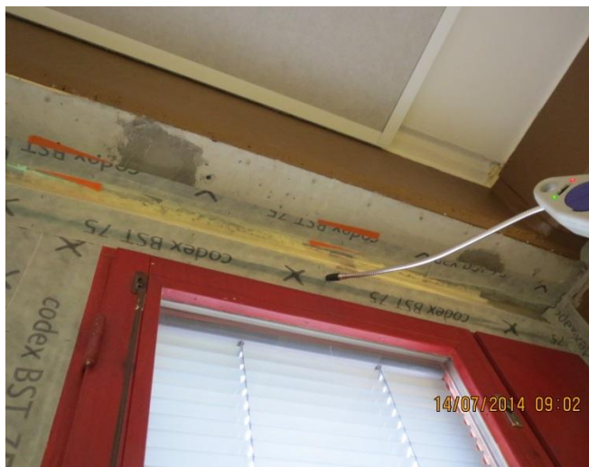
Kuva 5: vuotokohta ikkunan yläreunassa
