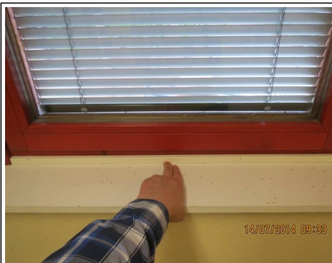
Kuva 10: vuotokohta ikkunan alapuolella
