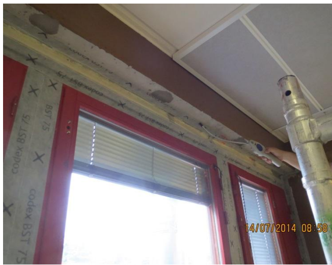
Kuva 3: vuotokohta höyrynsulun ja betonipalkin liitos
