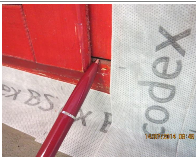
Kuva 1: vuotokohta ikkunan karmiliitoksessa.
