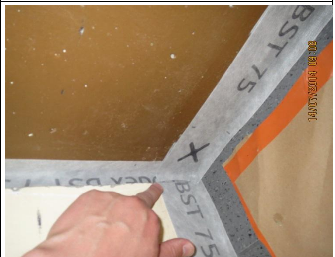
Kuva 8: vuotokohta sisäkuoren ja pilarin liitos, nurkka
