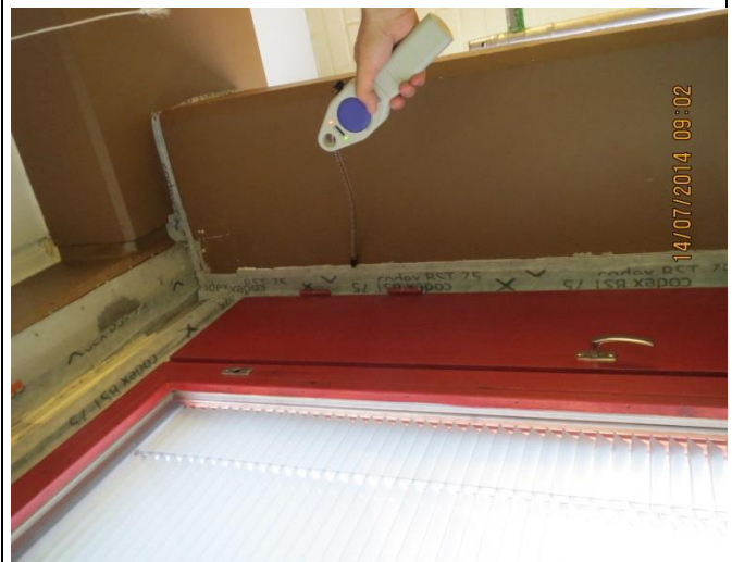
Kuva 6: vuotokohta ikkunan ja pilarin liitos
