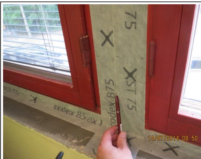
Kuva 2: vuotokohta nauhan saumakohdassa
