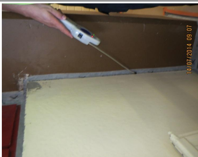
Kuva 7: vuotokohta sisäkuoren ja pilarin liitos
