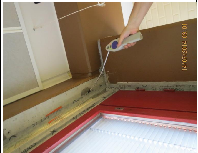
Kuva 4: vuotokohta höyrynsulun ja betonipalkin liitos
