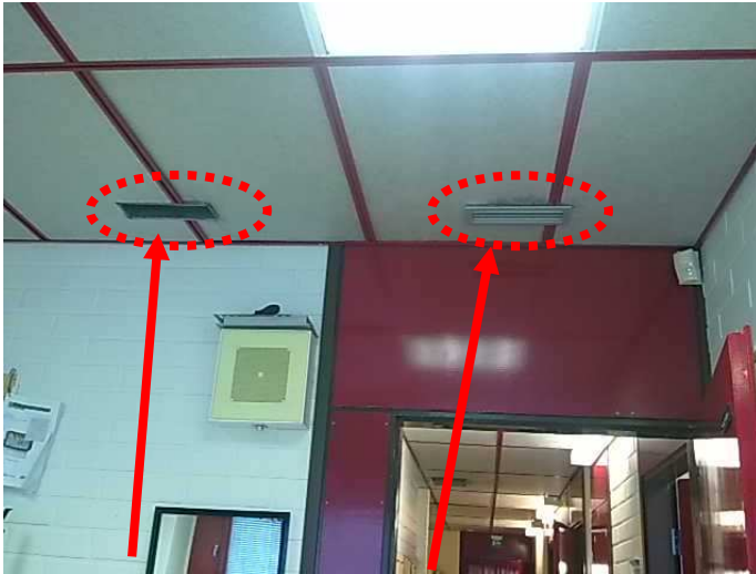
Tuloilmanvaihtventtiili ja poisto
