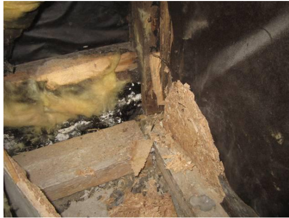
Kuva 34 RA3, kosteusvaurioitunut lastulevy, näyte MAT7
