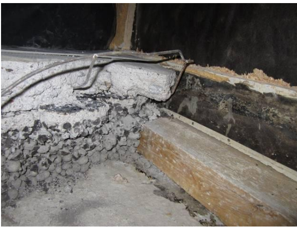
Kuva 33 Avaus RA3, puuta huonossa paikassa, ks-betonista näyte MAT6.
