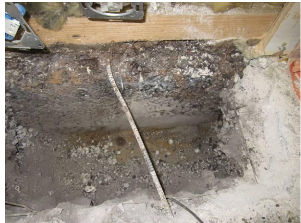
Kuva 12 Kevytsorabetonin alla on kostea ja hai-seva hiekka, josta otettiin näyte MAT4.
