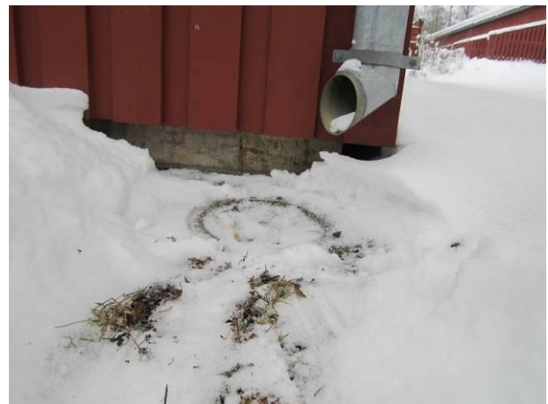
Kuva 2 Syöksytorvivedet jäävät nurkalle.
