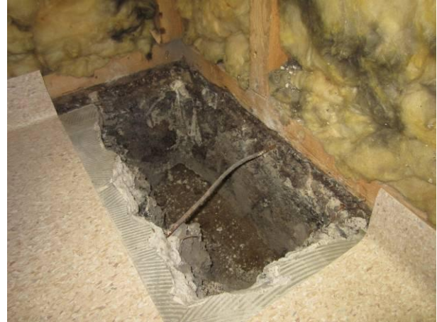
Kuva 14 Avaus RA2, haisevaa hiekkaa ks- betonin alla. Tilkkeestä näyte MAT5.
