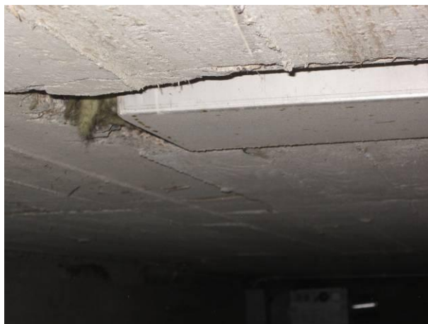
Kuva 30 Peltikotelo henkilökunnan keittiön alla, voi olla syynä ilmavuotoihin/ hajuihin.
