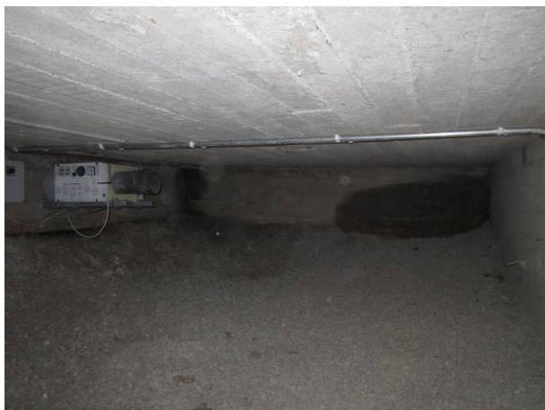
Kuva 29 Alustatilaa henkilökunnan keittiön alla, betonisokkeli on märkä kaakkoispäädystä RA3 -avauksen alapuolella.
