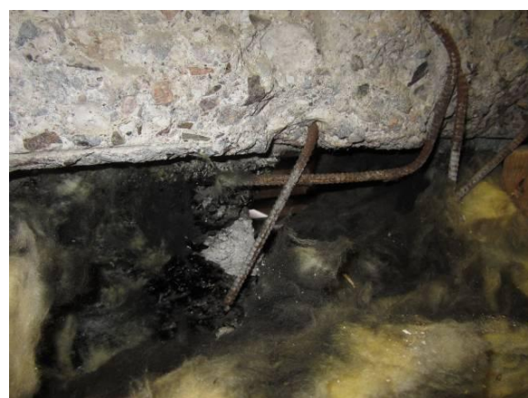
Kuva 36 RA4-avaus, villan takana on venttiili
