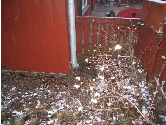
Kuva 3 Kattoveden ohjaus on puutteellinen.
