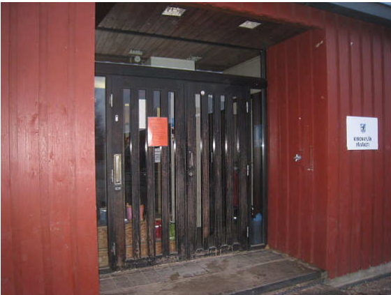
Kuva 9 Ulko-ovien maalipinnat ovat kuluneet.
