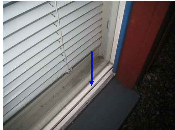
Kuva 10 Ikkunan alalista kaareutuu irti karmista, jolloin sadevettä voi päästä ulkoseinärakenteeseen.
