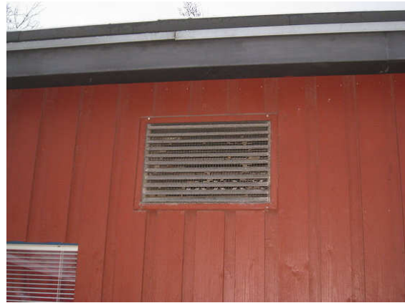
Kuva 16 Ilmanottosäleikköä ei ole suojattu.
