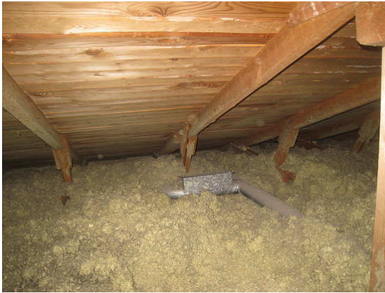
Kuva 15 Yläpohjassa olevia IV-kanavia ei ole eristetty asianmukaisesti.
