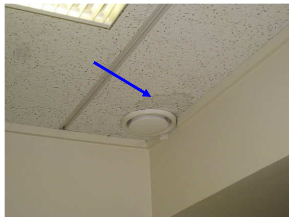
Kuva 12 Tyypillinen IV-venttiilin kohdalla oleva vesivuotojälki.
