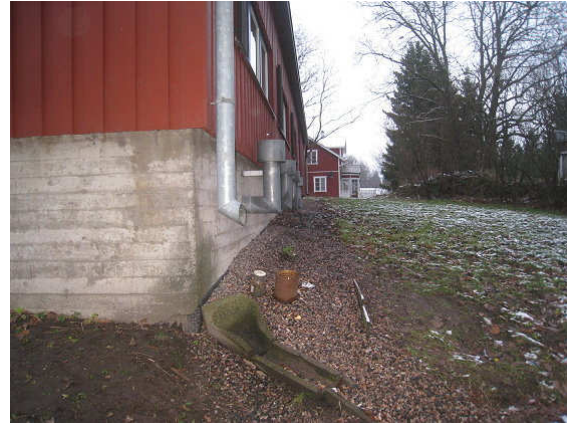
Kuva 4 Syöksytorven ulosheitin korkealla. Vettä roiskuu perusmuuriin.
