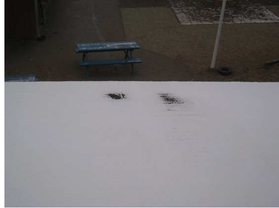
Kuva 14 Yläpohjan ilmavuodosta johtuen lumi- peitettä sulanut poistoilmaventtiilin koh- dalta.
