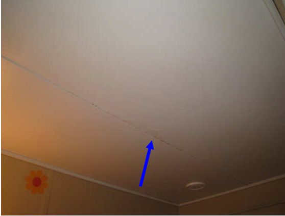
Kuva 13 Vesijälki WC-tilassa 16 lastulevyalakatossa.
