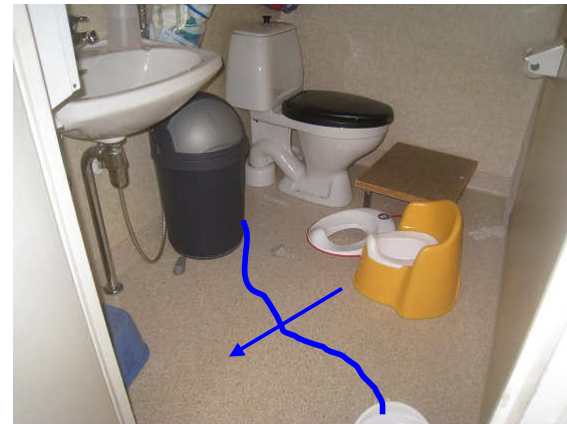
Kuva 6 WC-tilan 4 lattiassa kohonnut pintakosteus.
