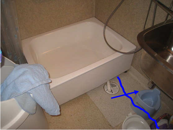
Kuva 7 Kohonnut pintakosteus on myös WC-tilan 5 puolella.
