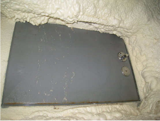
Kuva 7 Sisäänkäyntiluukussa esiintyy kondenssia.
