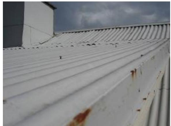
Ruostevaurioita, kiinnitysnauloja oli myös noussut ylös.
