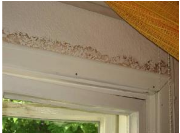
Vuotojälki yläkerran huoneessa ikkunan päällä.
