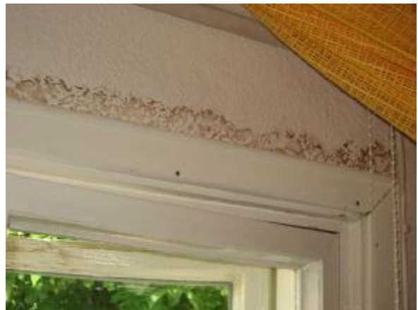
Vuotojälki myös yläkerran huoneessa ikkunan yläpuolella.
