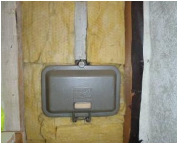
Pääkeskus sijaitsee eristeen sisällä.
