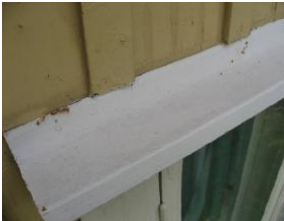
Ikkunoiden yläpuolisten pellitysten tiiviys on kyseenalainen.
