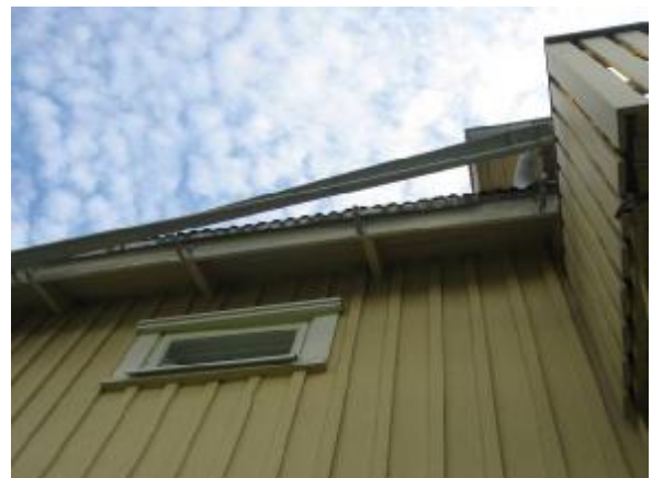
Räystäskouru on putoamaisillaan talon länsipuolella.
