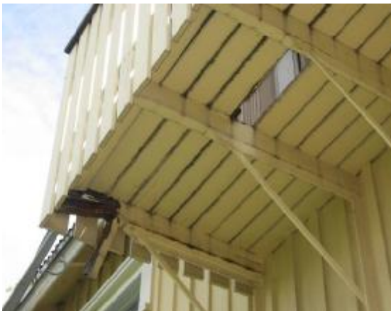
Parveke on vaarallisessa kunnossa – se tulee uusia välittömästi.
