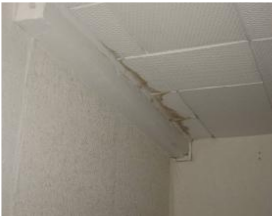
Yläkerrassa havaittiin piipun juuressa vuotojälki.
