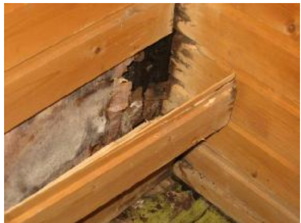
Maanpaineisiin seinäpaneelin takana on märkä.
