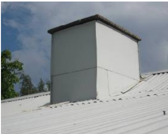
Piipun juuresta (takaa) on tapahtunut vuoto.
