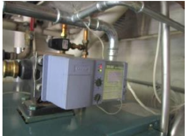
Lämmityksen säätösikkipö on uusittu 2000-luvulla
