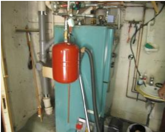
Öljylämmityskattila ja öljypoltin
