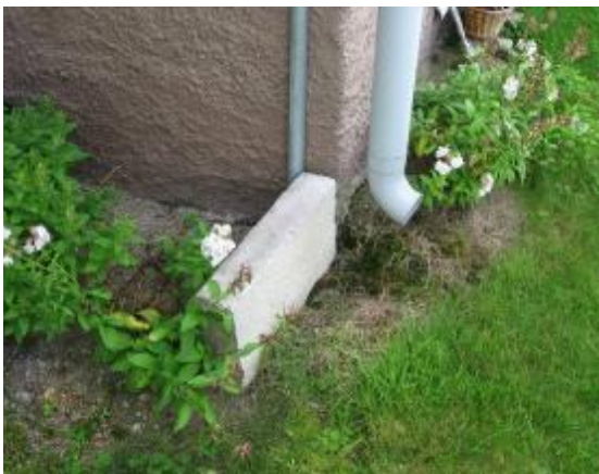
Veden ohjaus toimii huonosti, kellaritilassa vastaavassa kohdassa on lahovaurio.
