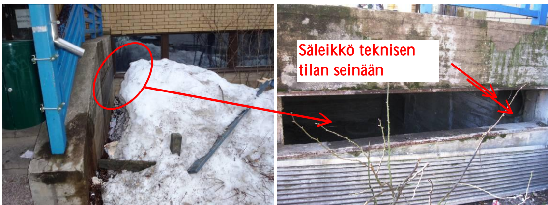
Kuva 35a ja b. Kirjaston pääsisäänkäynnin portaikon alapuolella on liikuntasalin IV-koneen tuloilmakammio. Kammion ilmanottosäleikkö on lähellä maanpintaa ja jää talvella lumikinosten alapuolelle.
