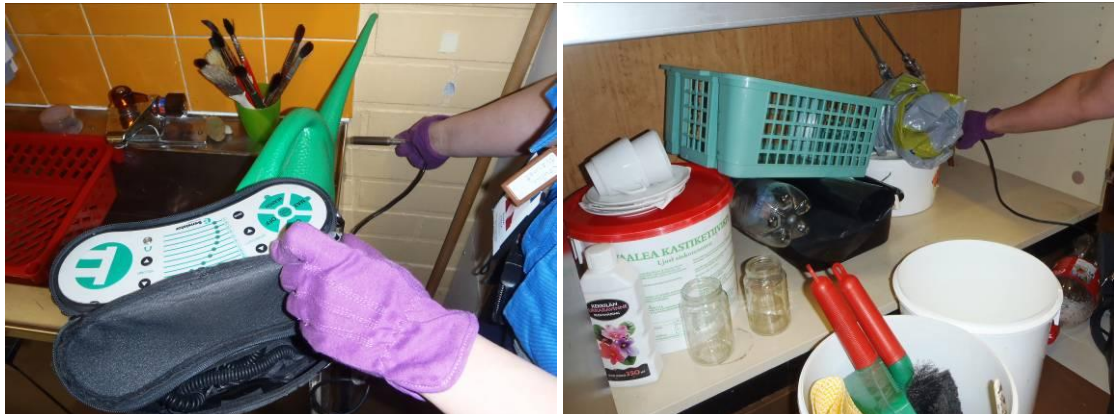
Kuva 29a ja b. Opetustilan 107 ulkoseinärakenteen merkkiainekokeessa oli ilmapuotoa allaskaapin takaa. Allaskaapin alalevytyksen vesiputkien läpiviennistä oli selvää vuotoa.
