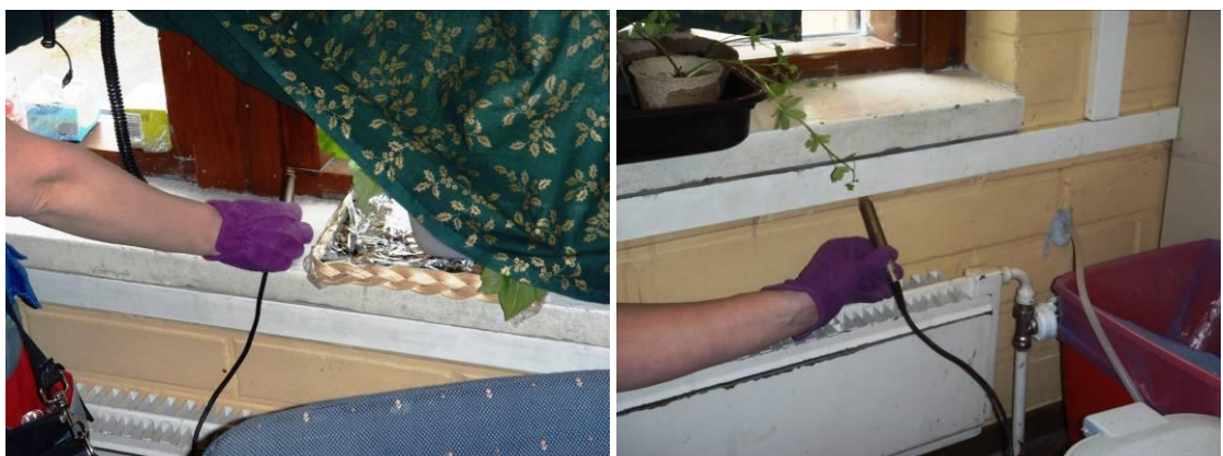
Kuva 28a ja b. Ulkoseinärakenteen merkkiainekokeessa oli ilmavuotoa sekä ikkunapenkin ala- että yläpuolelta. Ikkunaliittymistä oli myös ilmavuotoa.
