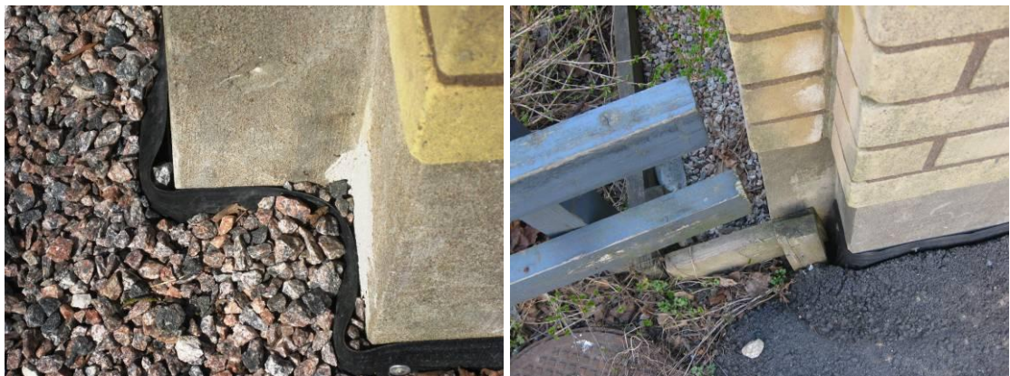
Kuva 2a ja b. Talon ulkonurkissa näkyvät perusmuurilevyt ja sepelisorastus. Levyn yläreunan ja seinän välissä on selvä rako.
