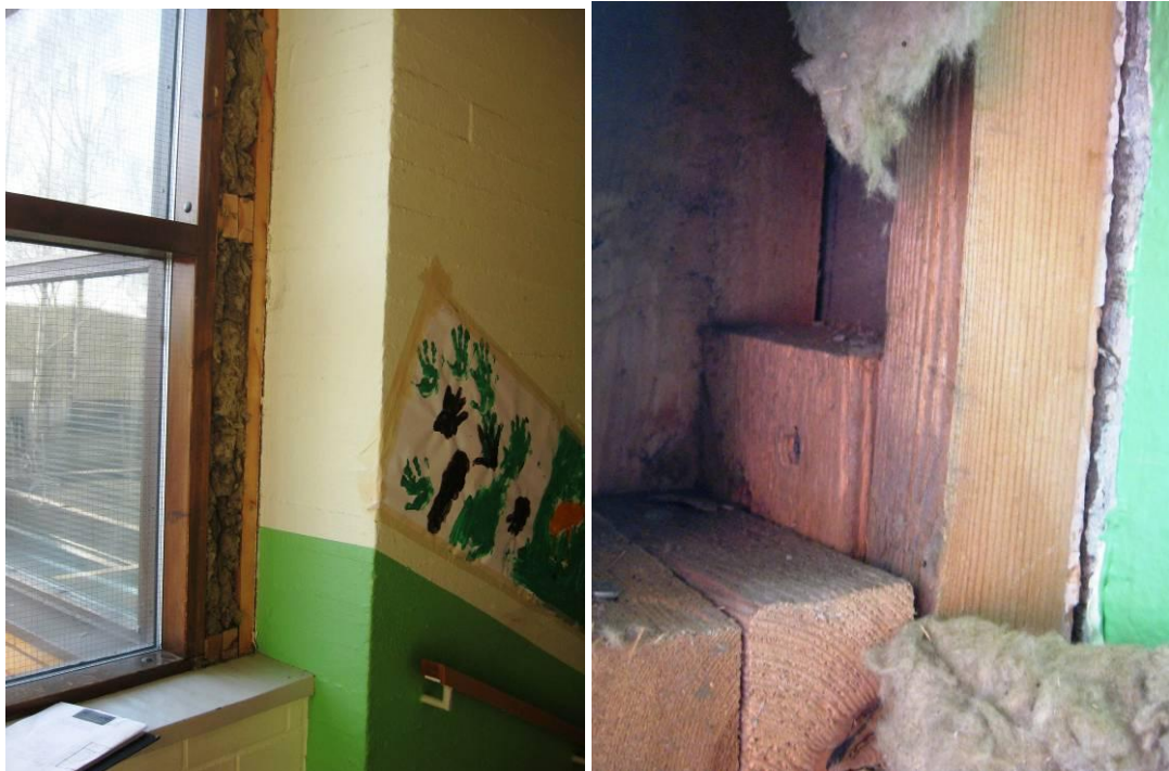
Kuva 27a ja b. Porrashuoneen 101 toisen kerroksen porrastasanteen ikkunan reunaan tehdystä rakenneavauksesta (RAK10) havaittiin selvää ilmavuotoa sisälle päin. Mineraalivillasta otettiin materiaalinäyte (5317-3). Villan takaa oli nähtävissä kirjaston lukusalin ikkunan apukarmi.
