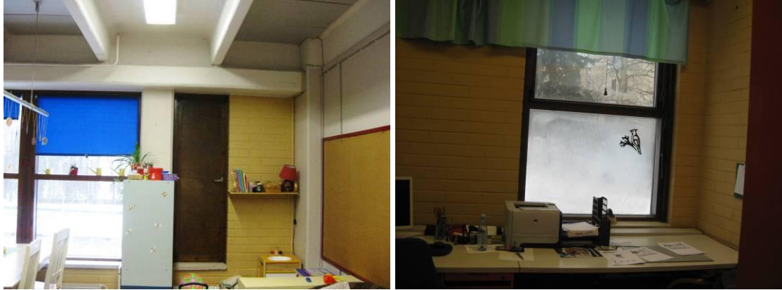
Kuva 22a ja b. Ikkunat ovat puurakenteisia, kolmilasisia kiinteitä lämpölasielementtejä. Tuuletusikkunat ovat lasittomia puurakenteisia, viereisten ikkunoiden korkuisia tuuletusluukkuja. Monin paikoin lämpölasielementit ovat samentuneet.
