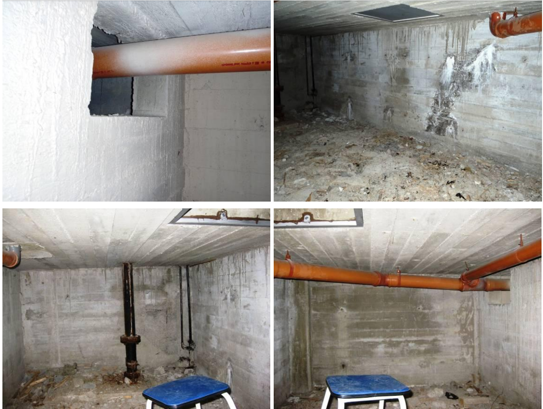
Kuva 9a ja b. Näyttämävaunun tilan itäisivulta on tiivistämätön viemäriäpivienti, jonka toisella puolella on pieni, matalahko, ~1,5 m, alustatila, johon on käynti lämmönjakohuoneen/teknisen tilan kulkuluusta. Savulla havaittuna teknisestä tilasta on ilmavirtaus alustatilaan päin kulkuluukun kohdalla. Alustatilan betonilattian päällä on rakennusjätettä mm. puupalasia. Tilaa ei ole tuuletettu.
