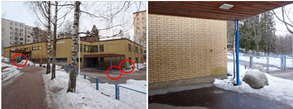
Kuva 4a ja b. Kirjaston katoksen ja pääoven katoksen vedenpoisto tapahtuu ulkopuolisiin syöksytorvin. Pääoven katoksen toinen syöksytorvi heittää vedet ulkoseinälle päin.
