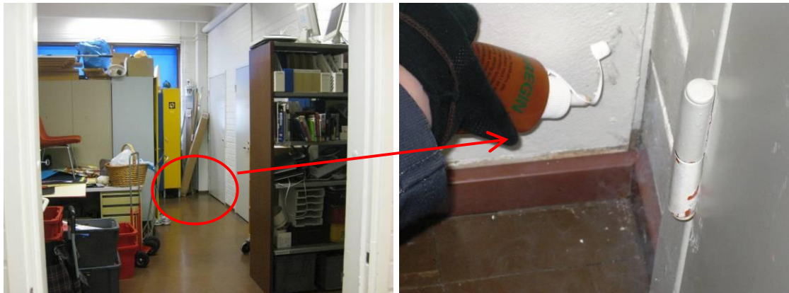
Kuva 14a ja b. Kirjaston eteläpään alapohjarakenteesta oli savulla havaittuna voimakas ilmavirtaus huonetilaan päin kirjastovaraston eteläseinustalla olevan koteloinnin liittymissä. Kirjaston henkilökunnalta saadun tiedon mukaan aamuisin töihin tullessa on aistittavissa ko. tiloissa maakellarin hajua.
