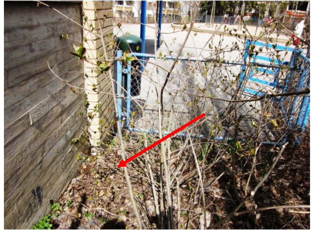
Kuva 14 Maanpinta viettää rakennukseen päin.
