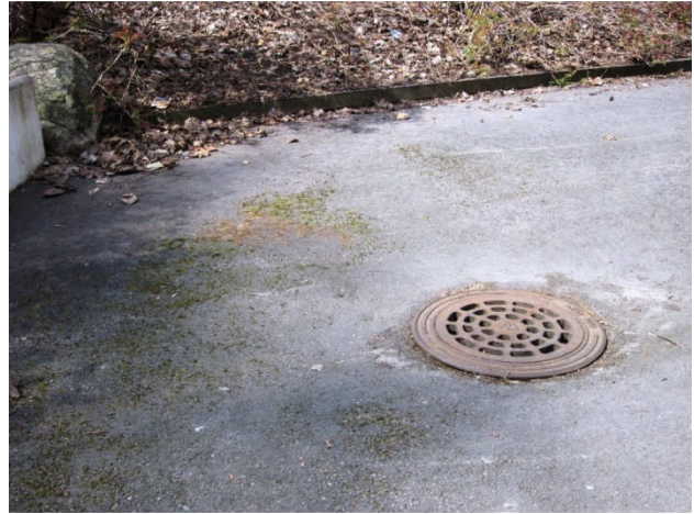
Kuva 6 Kaivon kansiosa asfaltin pintaa korkeammalla.
