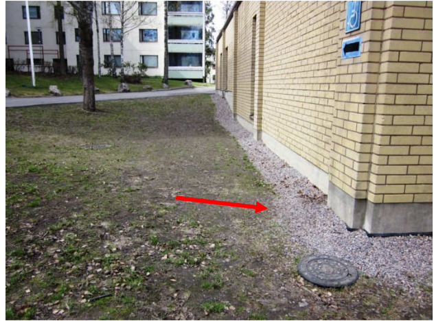
Kuva 10 Kaivon kansiosa maanpintaa korkeammalla. Maanpinta viettää rakennukseen päin kulman läheisyydessä.
