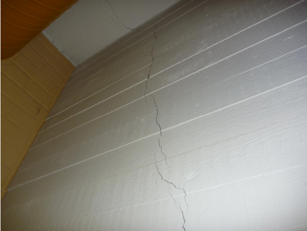
Kuva R4 Maanvastaisessa seinässä on pystysuuntaisia halkeamia.
