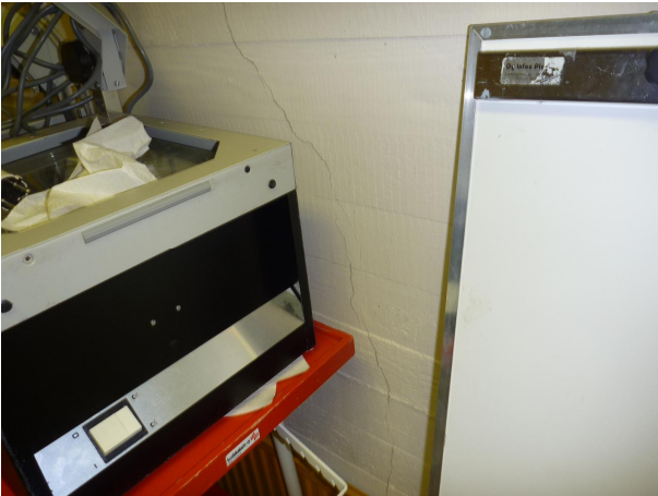
Kuva R5 Maanvastaisessa seinässä on pystysuuntaisia halkeamia.
