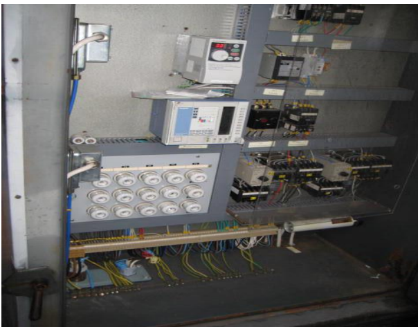
Kuva 4. Näkymä katolla olevasta IV-keskuksesta
