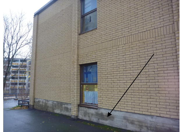
Kuva R8. Sokkelissa korroosioaurioituneita teräksiä näkyvillä.
