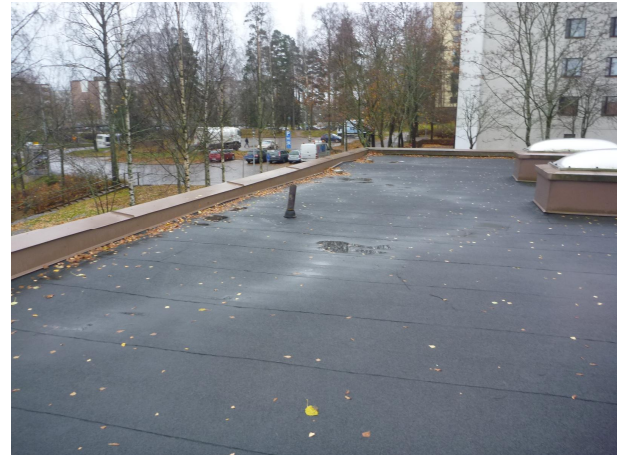
Kuva R14. Vesikatto on uusittu muutamia vuosia sitten. Vesikatolla on yksittäisissä kohdin lammikoitumista.
