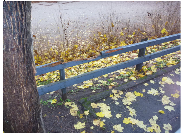
Kuva R2 Pihan puu-aidat ovat paikoin lahonneet.
