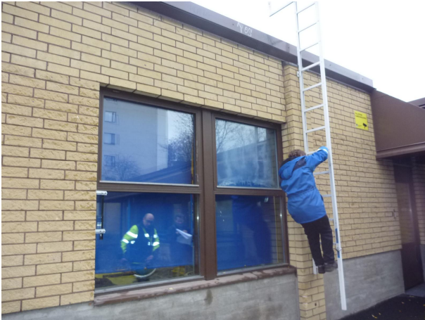
Kuva R11. Ikkunat ovat tyydyttävässä kunnossa. Suositellaan ikkunoiden maalaus-kunnostusta.
