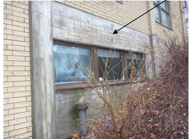
Kuva R9. Korroosioaurioita sokkelissa.
