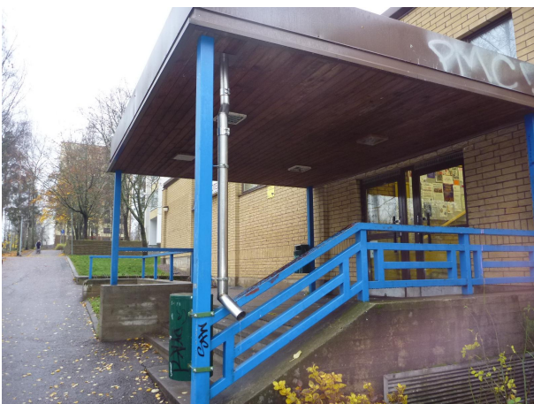
Kuva R13. Ulkoportaat ovat kuluneet. Suositellaan pinnoituskorjausta.
