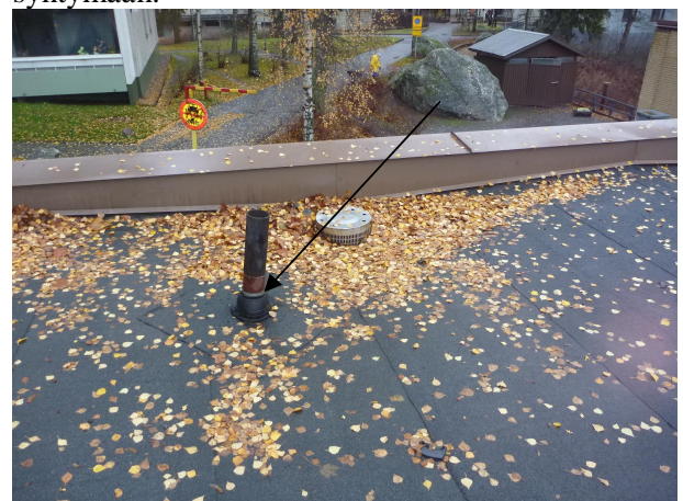
Kuva R15. Läpiviennit paikoin puutteelliset.
