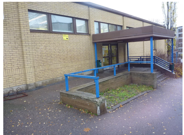
Kuva R3 Pihan betonipenkereissä on rapautumavaurioita.
