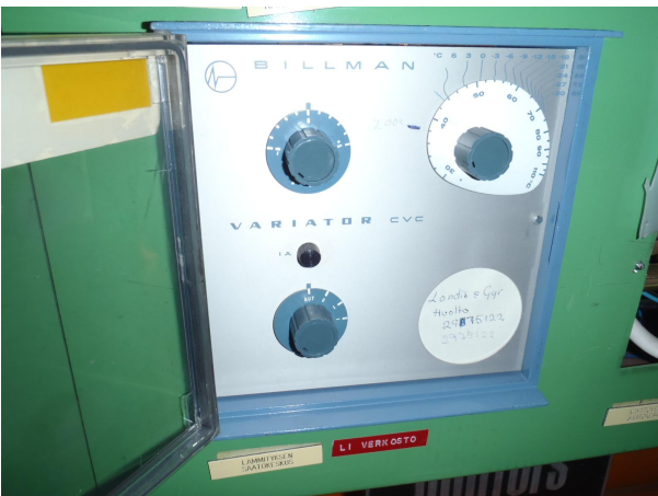
Kuva. L5 lämmitysverkoston säätöyksikkö on elinkaarensa lopussa.
