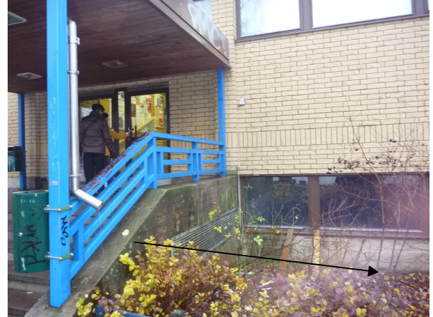
Kuva R1. Maanpinnan muotoilut rakennuksen vierellä viettävät paikoin rakennukseen päin. Rakennuksen vieressä maanpinnat ovat paikoin painuneet.
