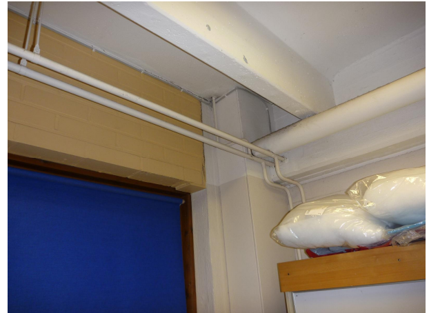
Kuva R24. Rakenteiden saumoissa on paikoin halkeilua.
