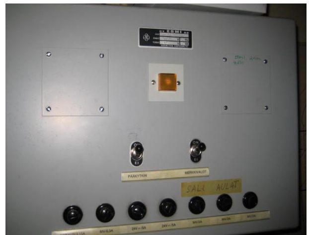
Kuva 3. Näkymä vanhasta merkkivalaistuskeskuksesta.
