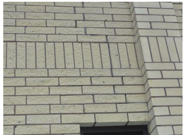
Kuva R10. Tiilijulkisivujen laastisaumoissa halkeamia.
