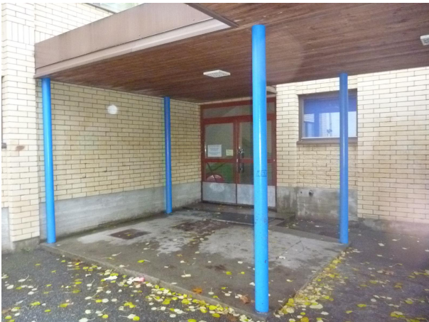
Kuva R12. Sisäänkäyntikatosten pilarien maali on kulunut. Suositellaan pilareiden maalaus-kunnostusta.
