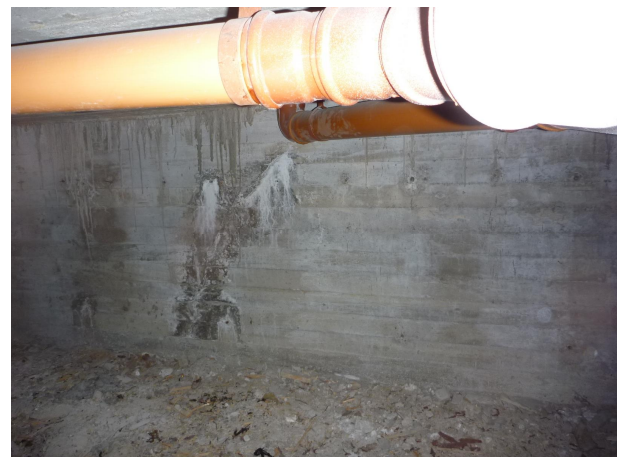
Kuva R19. Kellarityhjiössä on kosteusvalumajälkiä. Todennäköisesti valumajäljet eivät ole ihan tuoreita.
