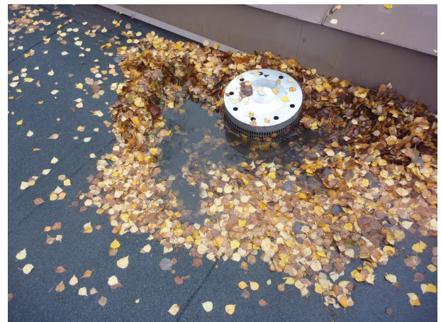
Kuva R15. Vesikaton kattokaivo oli tukkeutunut. Todennäköistä on että katon vesivuodot ovat mahdollisia, mikäli ko. ongelmia katoilla pääsee syntymään.
