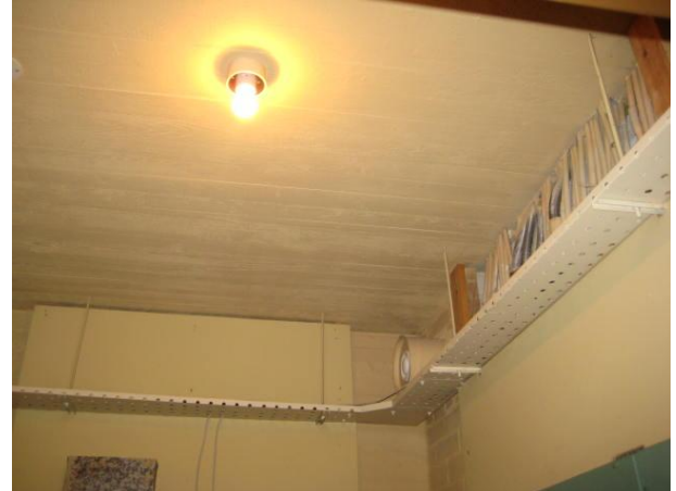
Kuva 2. Pääkeskustilassa puuttui valaisinkupu (myös Lämmönjakohuone).
