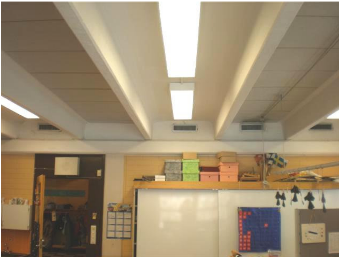
Kuva 7. Luokkahuoneen tulo- ja poistoilmanvaihdon päätte-elimet.
