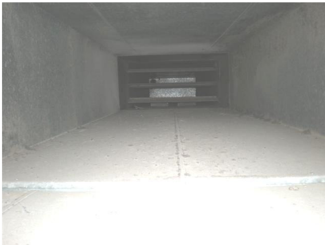
Kuva 6. Poistoilmakoneen 4PP1 runkokanavaa.
