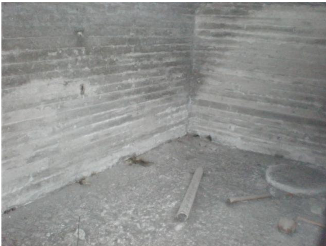
Kuva 5. Tuloilmakoneen 4TP1 raitisilmakammio.
