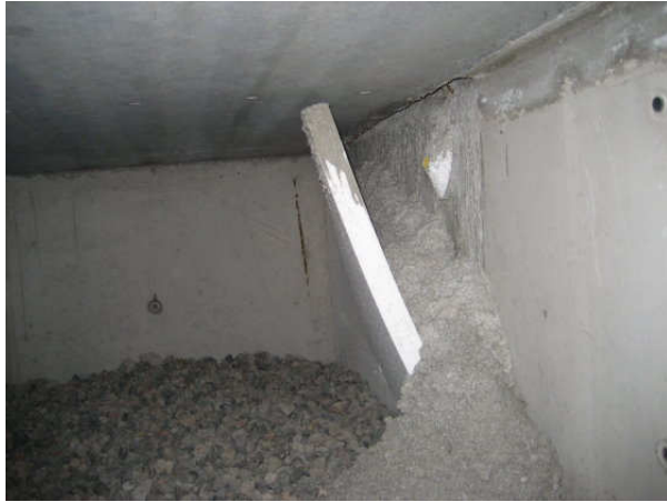
Kuva 7 Valupurseita ja eristerepeämä auditoriosalin 120 ja pukuh. 121 väliseinän alla.
