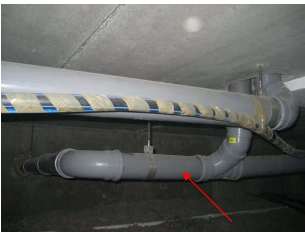
Kuva 23 Keittiön 105 alla on pohjaviemäriässä kallistusvika.
