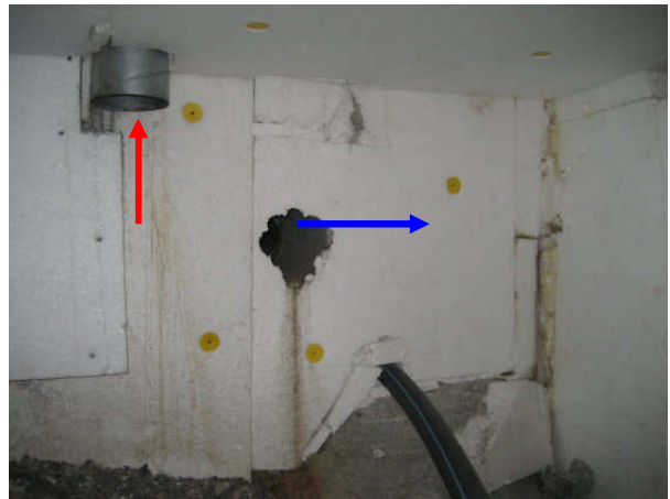
Kuva 10 Lämpökeskus 108 päätyseinässä on tuloilmareitti ja poistokanava. tuloilmaputkesta oli valumajälkiä.
