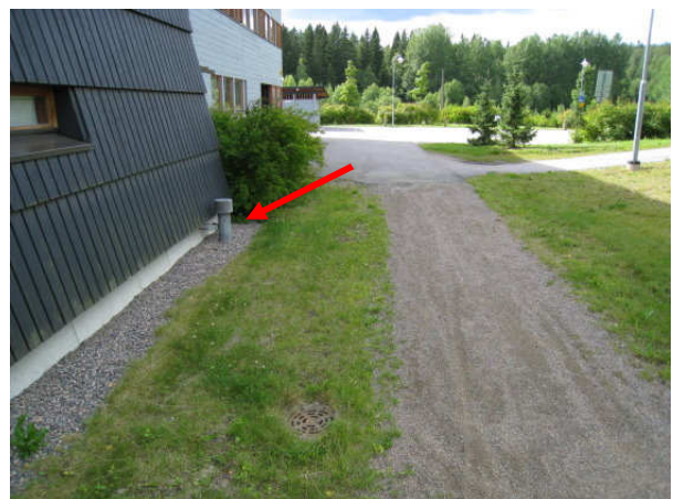
Kuva 30 Maanpinnat ovat tasaisia auditoriosalin 120 pohjoissivulla ja sadevesikaivo on lähellä rakennusta. tuuletusputken aukko ei näy alustatilassa.
