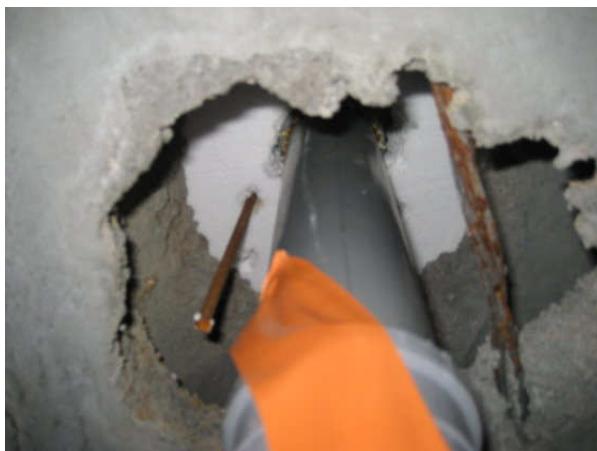
Kuva 17 Tässä tiivistysvalu tv. oli unohtunut keittiötilojen alla viemäriä läpiviennistä, johon kiinnitettiin oranssi merkkiteippi
