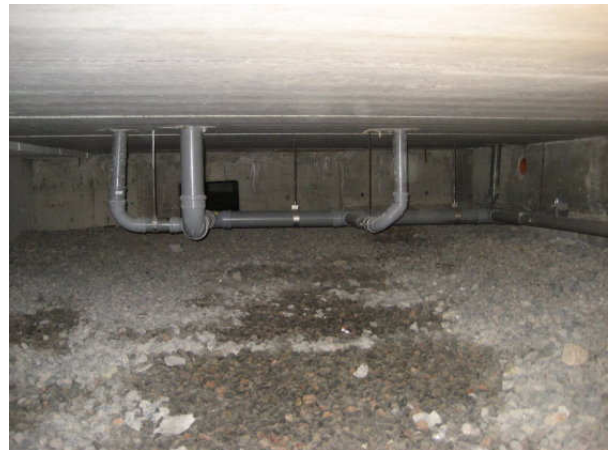
Kuva 4 Alustatila porrastilan 101 ja kotipalvelutilojen 117–119 alapuolella. Tässä se- pelipinta on keskialueella hieman kostea
