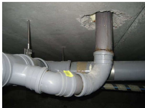
Kuva 24 Keittiön 105 alla oleva viemäriiliitos padottaa yli 50 mm. Läpivienti ei ole tiivis.
