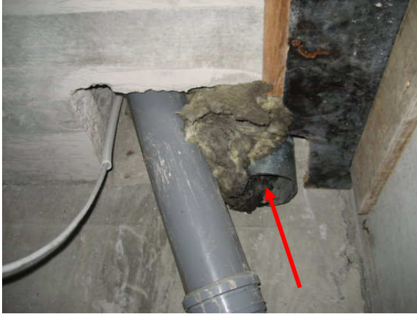
Kuva 19 Iso epätiivis läpivienti ryhmätila 128 keittiönurkan kotelon kohdalla, jossa on myös toisen poistokanavan pää osin villojen sisällä.
