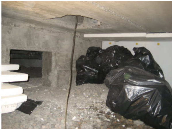
Kuva 3 Alustatiloista jo kerätty rakennusjäte oli unohtunut säkkeihin.
