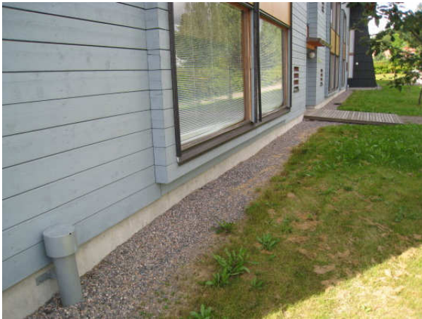
Kuva 27 Ryhmäsiiven itäisivulla ei ole kuin 2 kpl tuuletusputkia, joista etualalla olevan kohdalla olevan tilan lattia on kylmä henkilökunnan mukaan.
