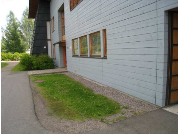
Kuva 31 Keittiön edustalla maa on montulla ja kerää pintavettä. Suunniteltuja tuuletusputkia ei ole asennettu jostain syystä, sisäpuolella on vain tukitut reiät.
