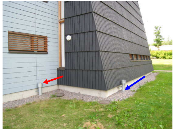
Kuva 28 Ryhmäsiiven rajalla ja auditoriosalin 120 itäisivulla olevista tuuletusputkista vain vasen on viety läpi, mutta oikeanpuoleisen tuloreikää ei näy ontelotilassa.
