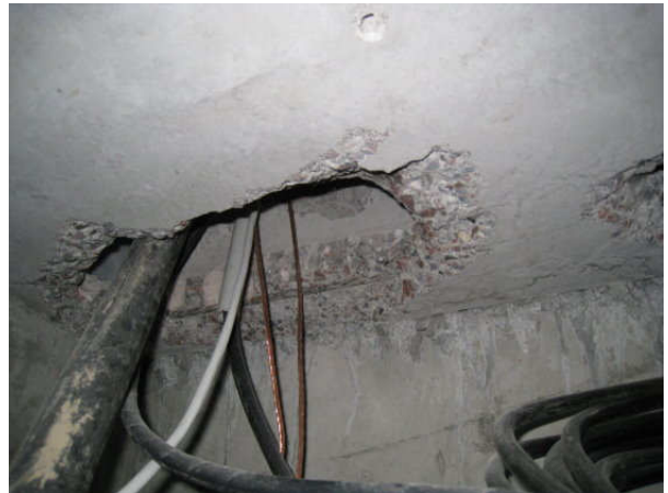
Kuva 16 Alapinnalta tiivistämätön kaapeliläpivienti
