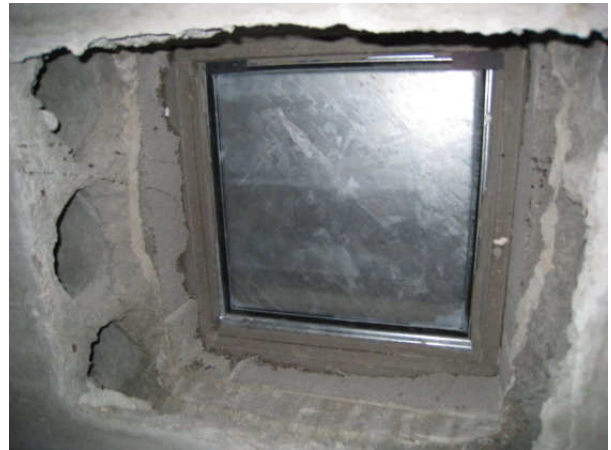
Kuva 2 Kulkuluukun reunat ovat viimeistelemättä ja tiivistämättä onteloiden suuntaan.
