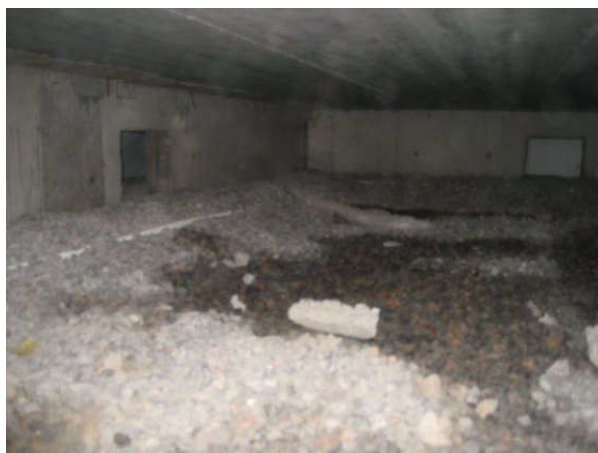
Kuva 5 Auditoriosalin 120 alla on kostea se- pelipiä. Keskellä ryömintätilan korkeus on arviolta n. 1100 mm.
