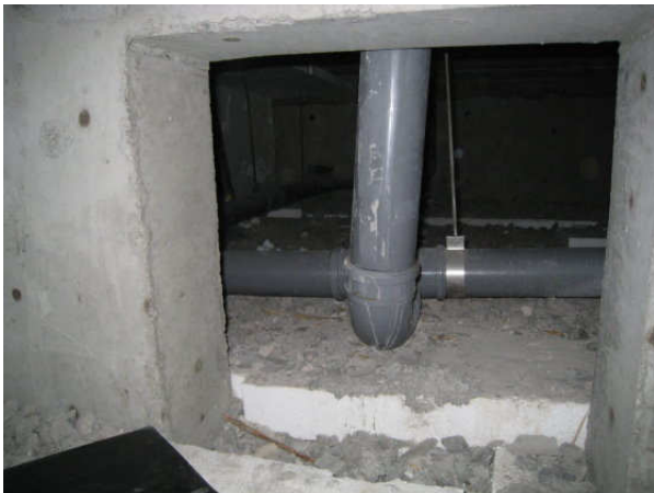
Kuva 21 Kulkuaukon edessä oleva viemärihaaritus pesuhuone PH 133 alapuolella. Routaeriste ja sepeli madaltavat kulkuaukkoa.
