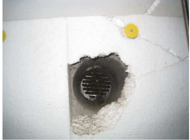
Kuva 14 Sisäpihan puuterassin kohdalla lähes kaikki korvausilmareitit olivat tukossa ulkoapäin. Venttiileissä on verkot, jotka jäävät puhdistamatta.
