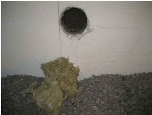
Kuva 9 Käyttämätön tuuletusputken reikä keittiön alla oli tukittu villalla, perällä on ulkoa valunutta hiekkaa.
