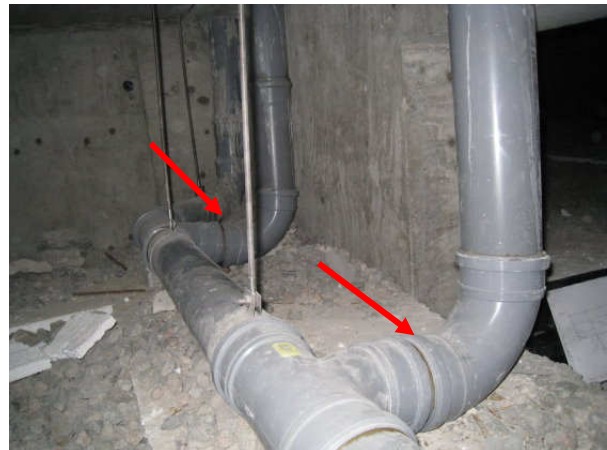
Kuva 22 Pesuhuone PH 133 alapuolella olevat liitokset padottavat jätevettä
