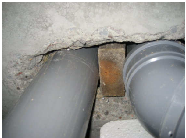
Kuva 18 Puinen tuki oli jäänyt läpivientiin, joka on tiivistämättä.
