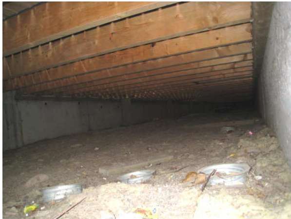
Kuva 15 Sisäpihan puuterassin alla hiekkatäyttö on pääosin nostettu liian ylös. Tilassa on rakennusjätettä.
