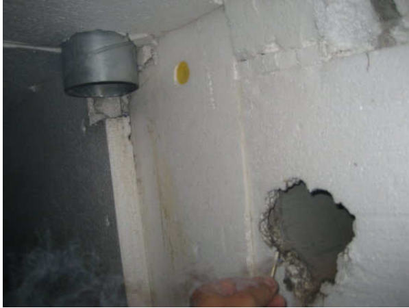
Kuva 13 Merkkisavun mukaan korvausilmavirta painui alustatilaan päädystä, vaikka vieressä oli imua poistokanavaan.
