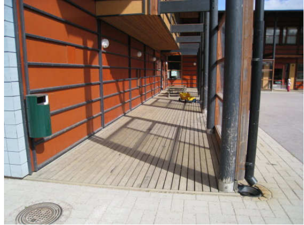
Kuva 32 Sisäpihan puuterassin alta alustatilaan johtavat suunnitellut ja tehdyt korvaus- ilma-aukot ovat lähes kaikki maan peittämät. Kattosadevedet on viemäroity.
