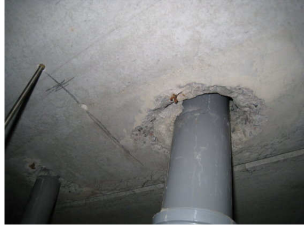
Kuva 20 Tämä viemärläpivienti on yritetty tiivistää valamalla, mutta valu on osin irronnut, eikä läpivienti ole tiivis.
