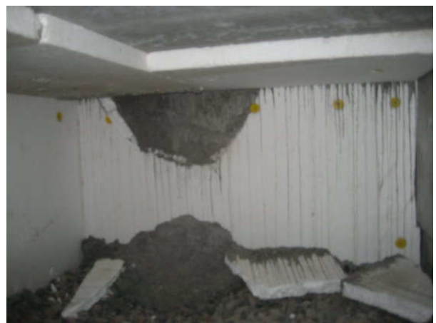
Kuva 6 Rengasvalubetoni on pursunut alustatilaan ja routaeriste on rikki auditoriosalin 120 varaston alapuolella.
