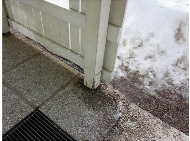
Kuva 19 Pystytolpan alaosa vaurioitunut.
