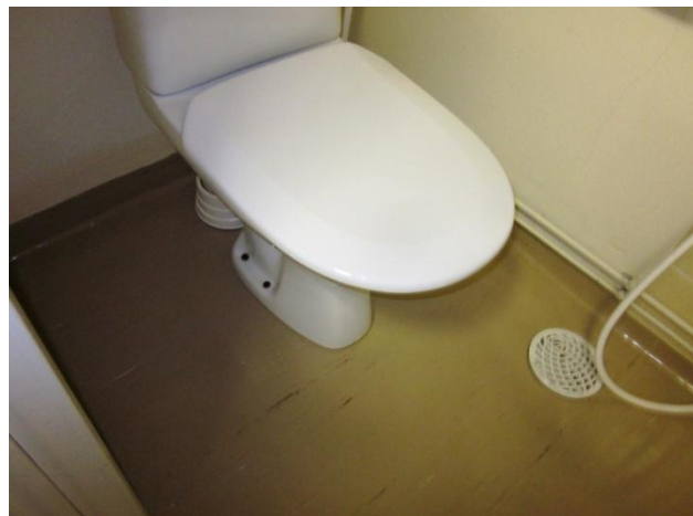
Kuva 25 WC-istuin on kiinnitetty muovimaton läpi lattiaan.
