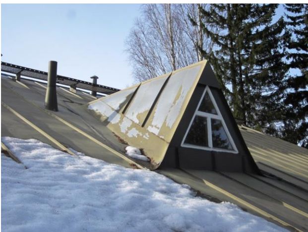
Kuva 12 Vesivuoto kattolyhdyn oikealla puolella.
