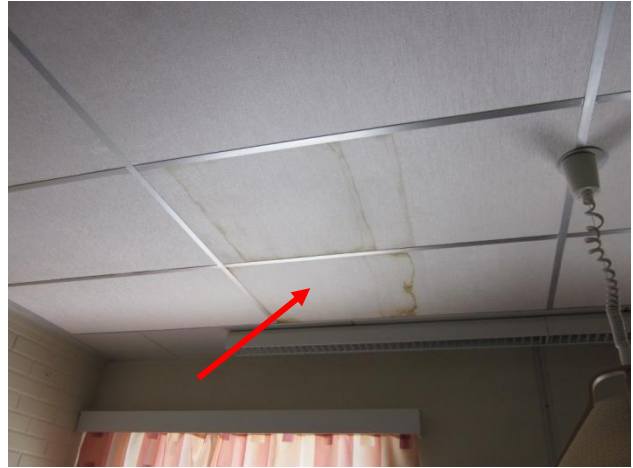
Kuva 15 Vesivuotojälki 2.kerrosen ryhmähuoneen katossa.
