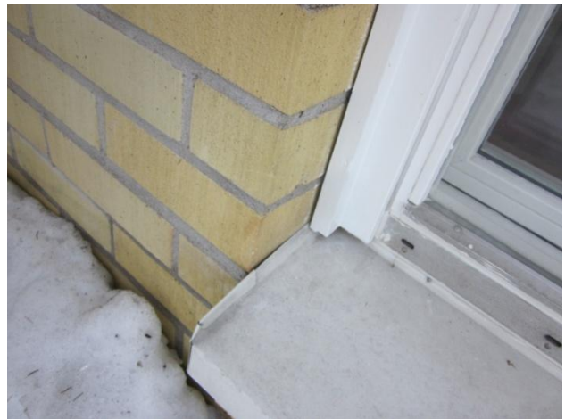
Kuva 21 Vesipellin ja tiilimuurauksen liittymä ei ole tiivis.
