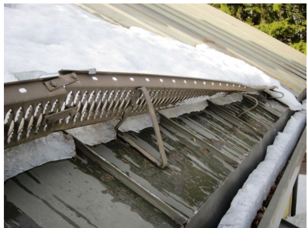
Kuva 13 Lumesteen kiinnitys-/ tukirakenteet ovat pettäneet.
