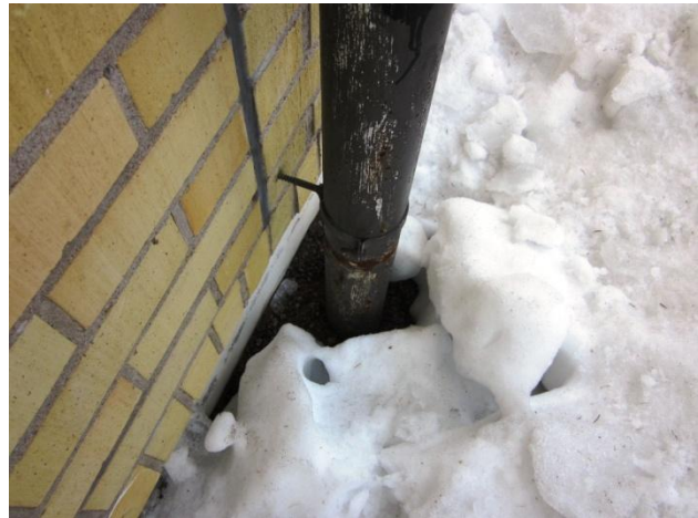
Kuva 2 Syöksytorven alaosassa ruostetta.
