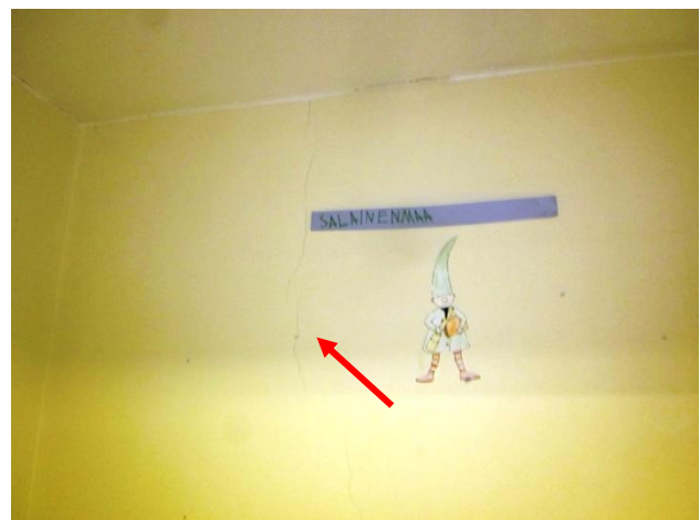
Kuva 17 Halkeama 1.kerrosen verastilan kohdalla päätyseinässä.
