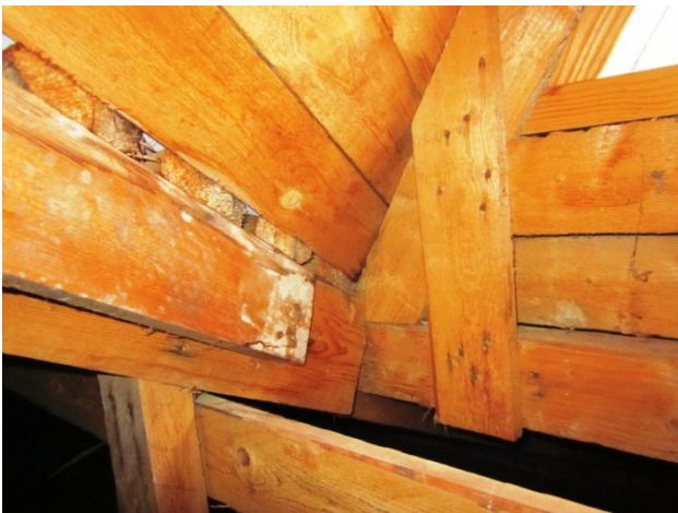
Kuva 10 Kattolyhdyn kohdalla vesivuotoa.
