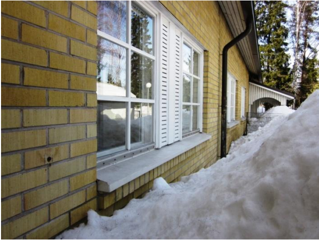
Kuva 18 Lunta julkisivumuurausta vasten idän puoleisella sivustalla.
