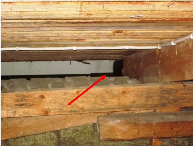
Kuva 14 Rästään kohdalla on vesivuotoa.
