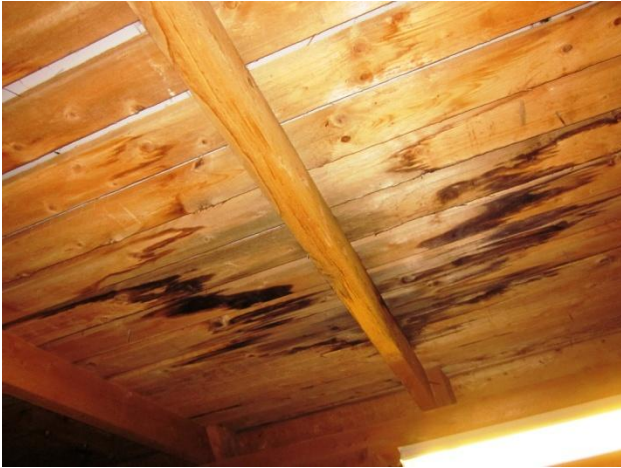
Kuva 8 Katossa vesivuotojälki. Nyt kuiva.
