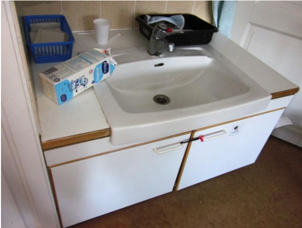
Kuva 26 Silikonitiivistyksissä on puutteita.
