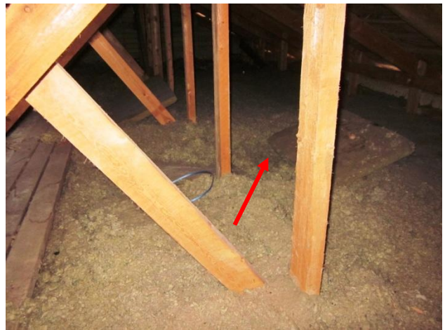
Kuva 11 Kattolyhdyn alapuolella märkää lämmöneristettä.
