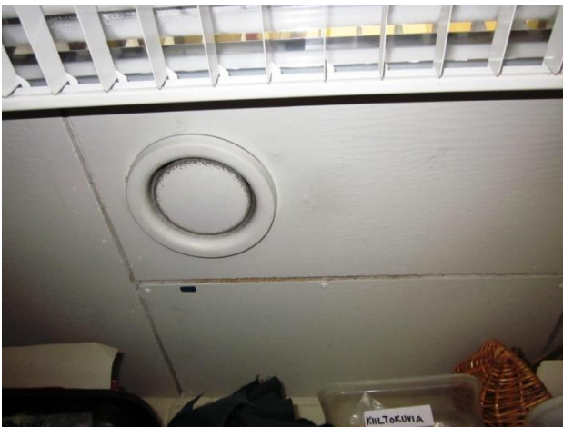
Kuva 16 Pölyinen IV-kanavan venttiili.
