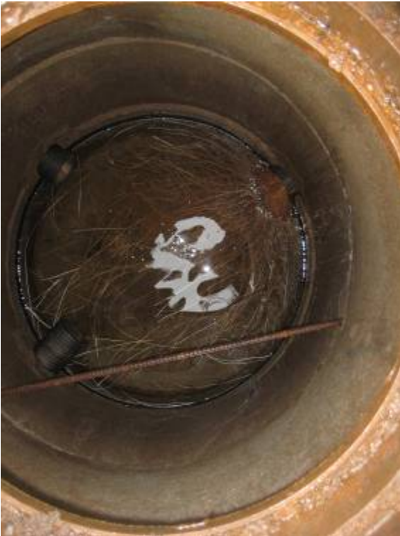
RAK-KUVA 3: Salaojakaivosta tehtyjen havaintojen mukaisesti salaojaputkistossa runsaasti kasvustoa (juuria). Salaojajärjestelmän kunto tulee selvittää lisätutkimusten avulla.
