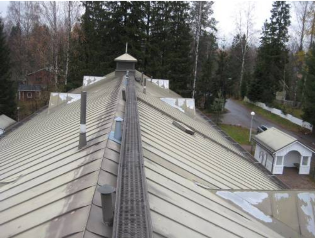
RAK-KUVA 9: Katteen pintakäsittelyssä esiintyy vaurioita.
