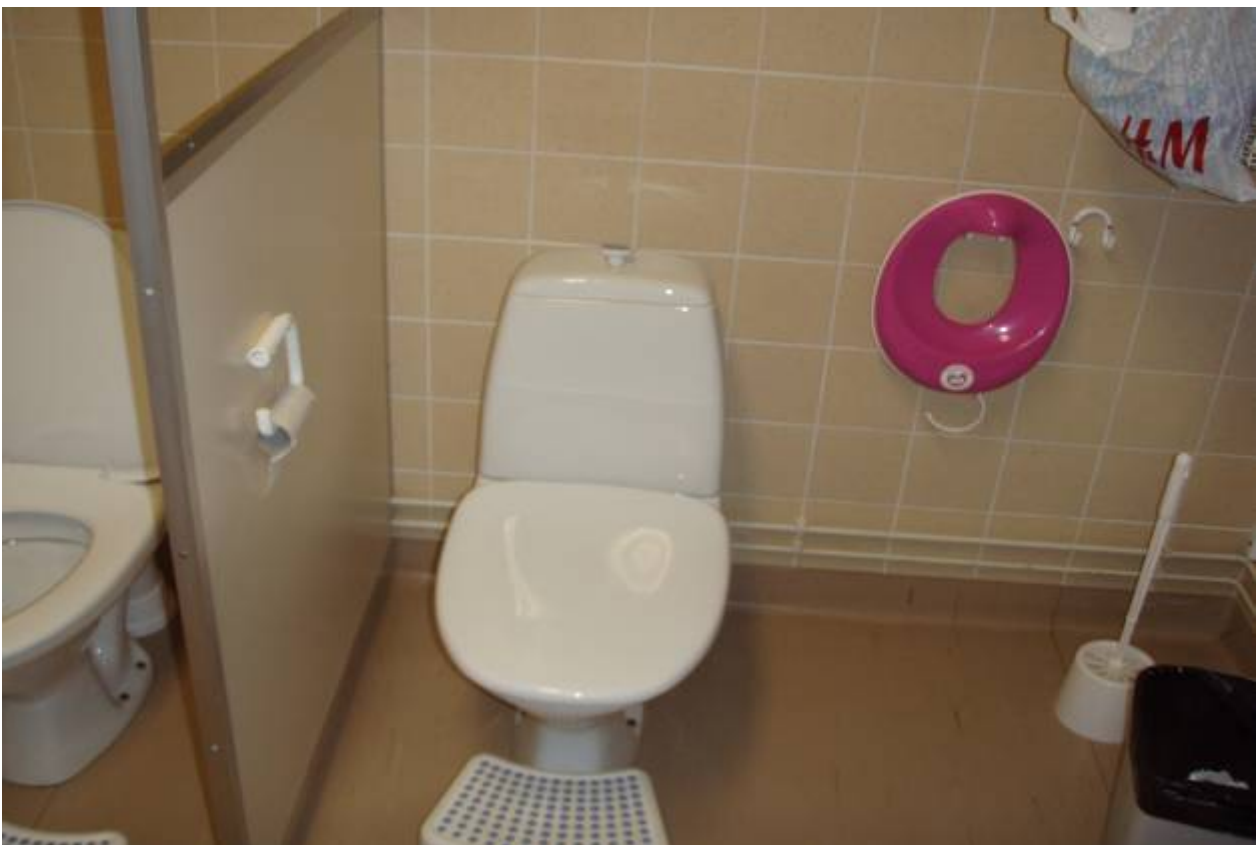
LVI-kuva 4. Yleiskuva wc-istuimista.
