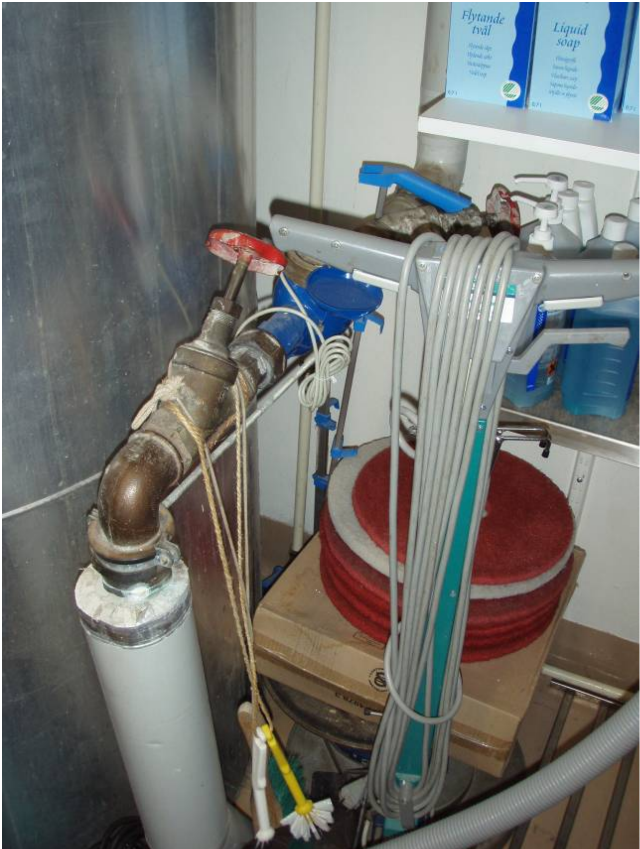
LVI-kuva 2. Yleiskuva vesimittarista ja pääsuluista.
