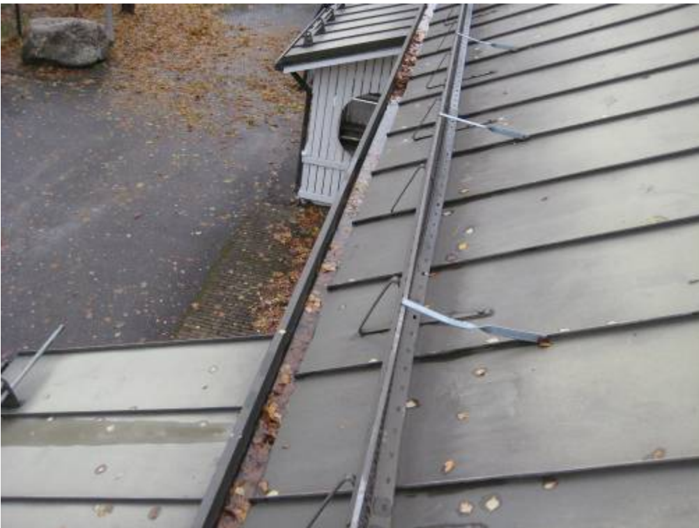
RAK-KUVA 10: Räystäskoururakenteiden puhdistukseen tulee kiinnittää nykyistä enemmän huomiota.
