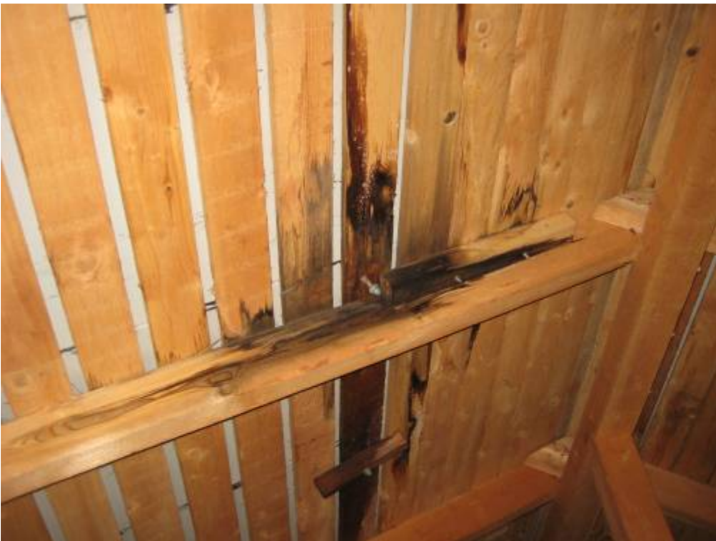
RAK-KUVA 8: Katerakenteessa esiintyi vuotokohta tarkastusajankohtana.
