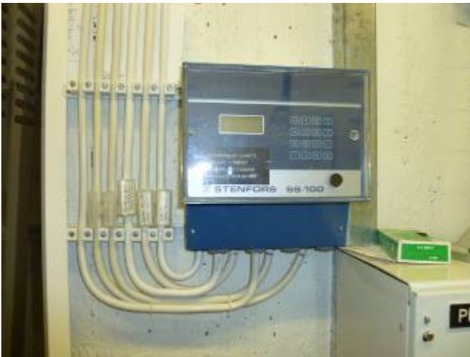
S-KUVA 11. Lämmitysjärjestelmän ohjaus
