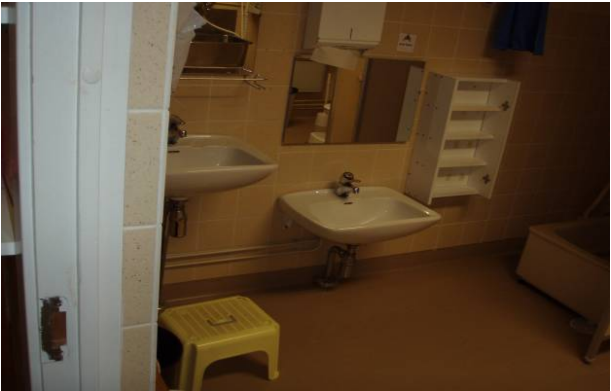
LVI-kuva 3. Yleiskuva vesikalusteista.
