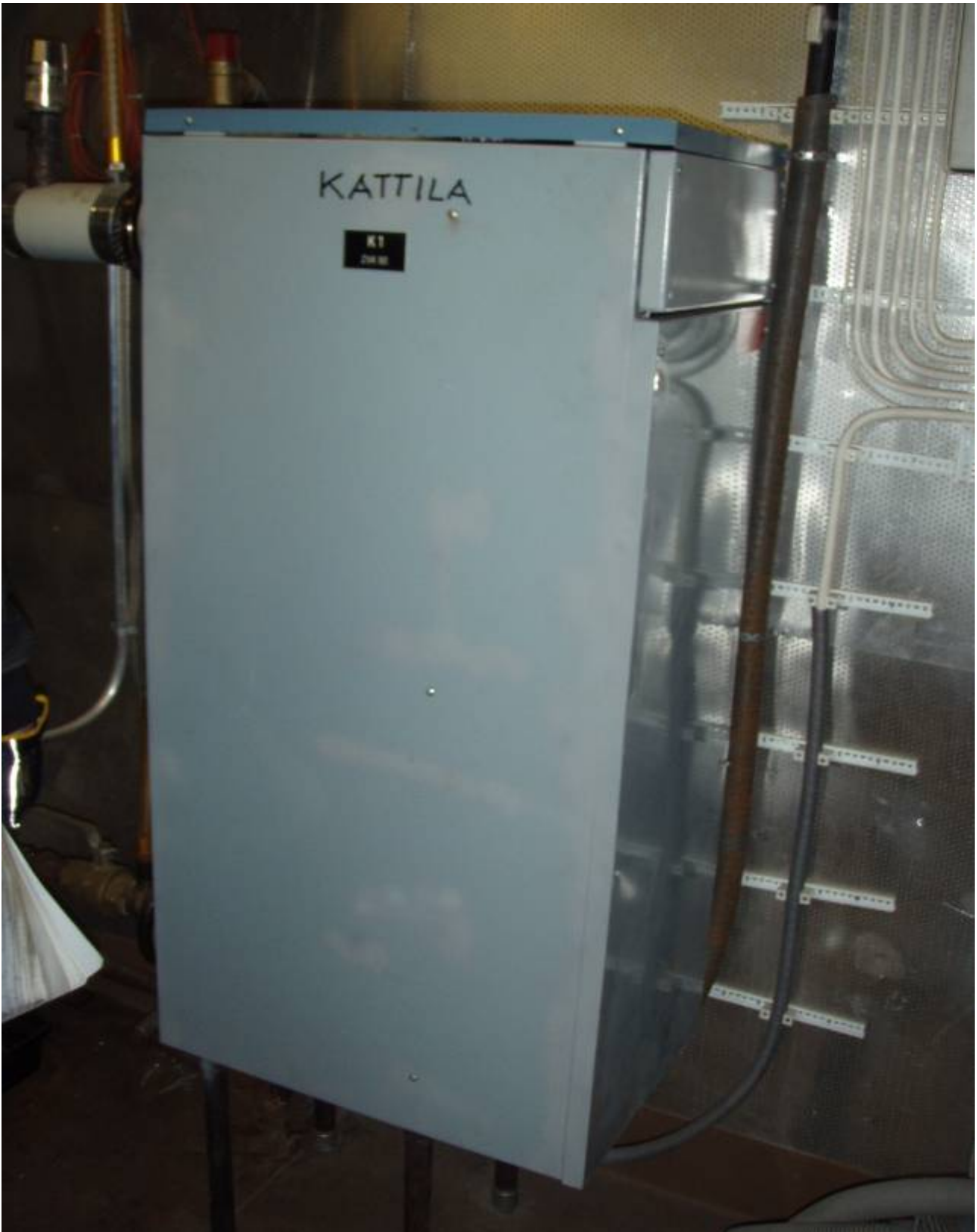
LVI-kuva 1. Yleiskuva sähkökattilasta.
