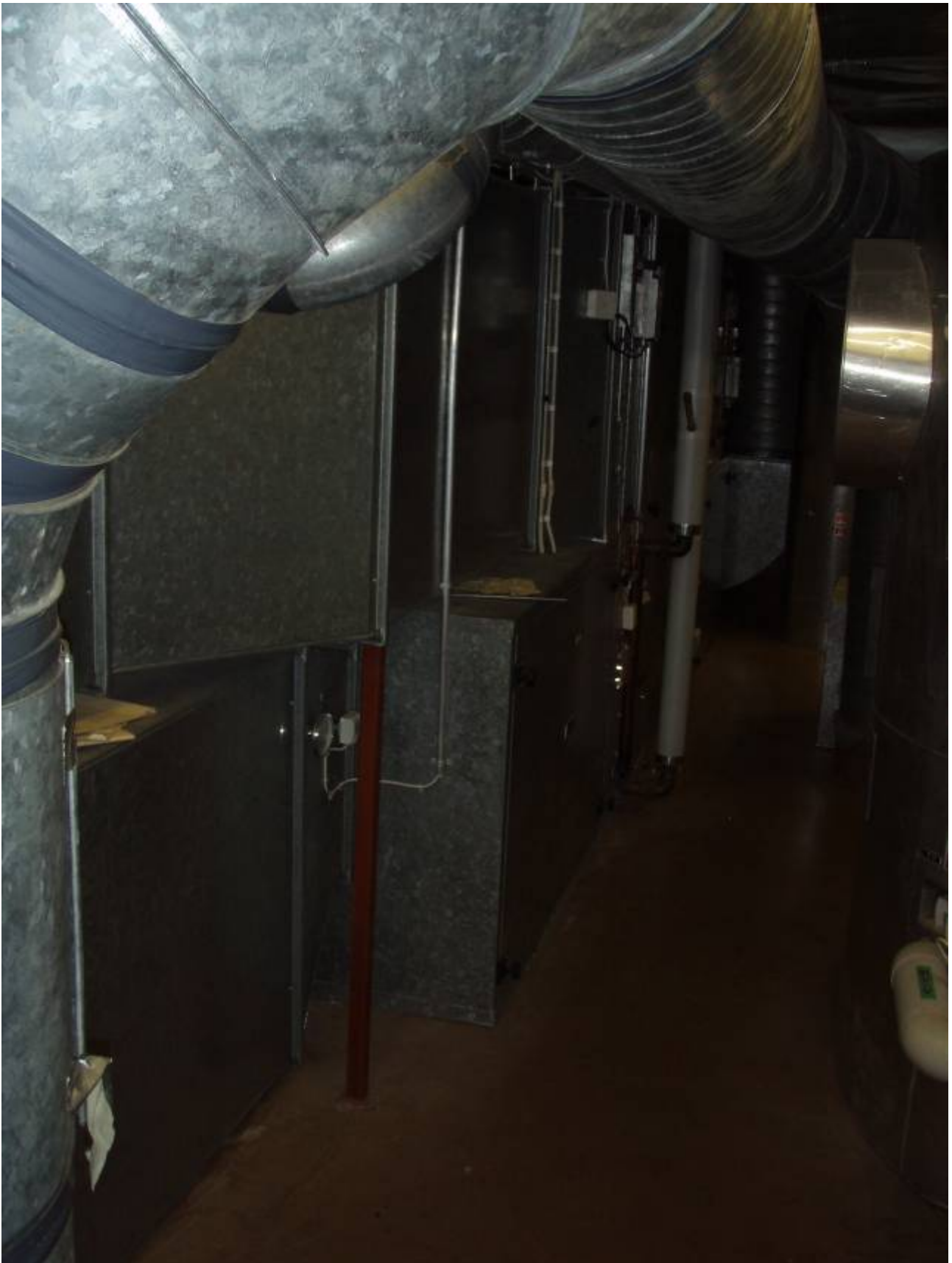
LVI-kuva 5. Yleiskuva IV- konehuoneesta.
