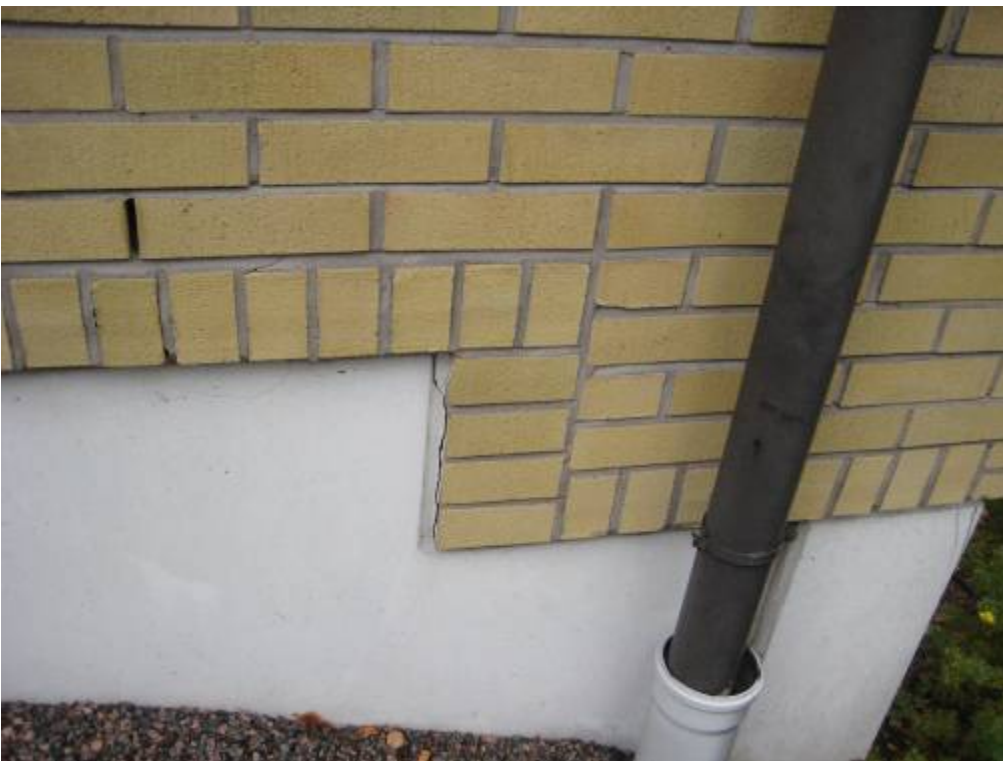
RAK-KUVA 4: Rakennuksen koilliskulman ulkoseinärakenteessa esiintyy halkeamia..
