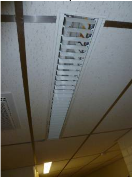
S-KUVA 6. Käytävän valaistus
