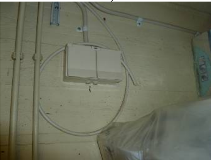
S-KUVA 14. Väestösuojan puutteellinen antennipiste
