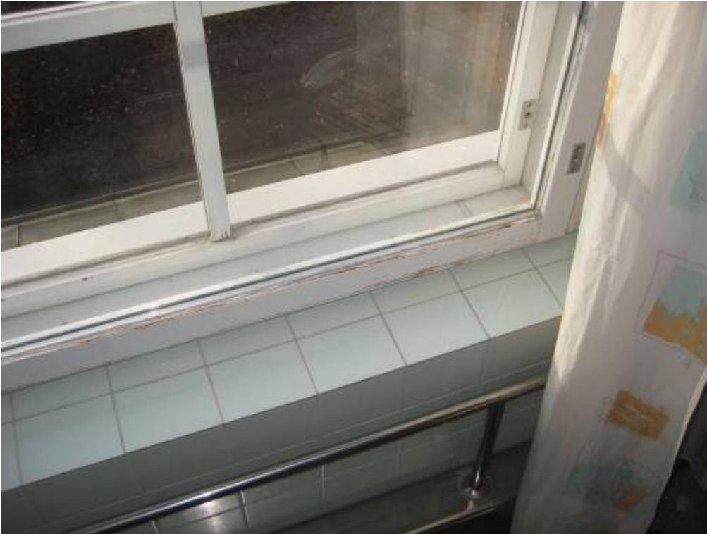
RAK-KUVA 7: Ikkunoiden sisä- ja välipuitteiden pintakäsittelyissä esiintyy paikoin vaurioita.
