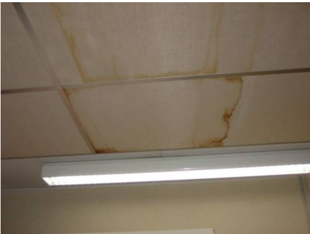
RAK-KUVA 12: 2. kerroksen sisäkattojen levytyksissä esiintyy kosteusvauriojälkiä. Levyrakenteet tulee vaihtaa välittömästi.
