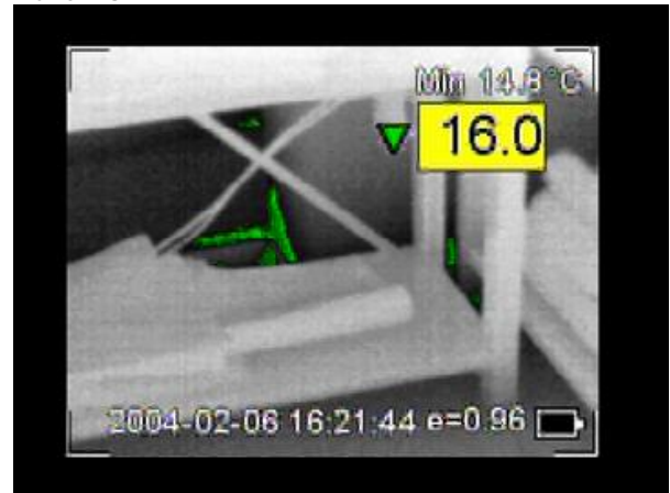
Huone 232, ikkunaseinä, ikkunasyvennöksen oikea alakulma, pilarin juuressa, alavälipohjan liitos. Min 14.8/tr 21.5
