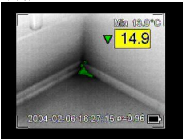
Huone 234, ikkunaseinän oikealla puolella oleva seinä, oikea alakulma, alavälipohjan liitos. Min 13.0/tr 21.5
