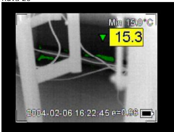
Huone 233, ikkunaseinä, ikkunasyvennöksen vasen alakulma, alavälipohjan liitos. Min 15.0/tr 21.5
