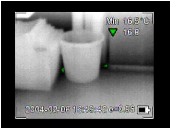
Huone 201, ikkunaseinä vasen alaosa, alavälipohjan liitos. Min 16.5/tr 22.0
