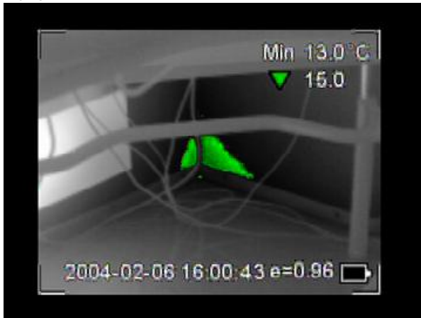
Huone 218, ikkunaseinä, vasen alakulma, alavälipohjan liitos. Min 13.0/tr 22.0
