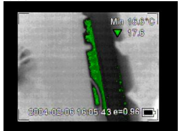
Huone 221, ikkunaseinä, vasen alakulma, alavälipohjan liitos. Min 16.6/tr 22.0
