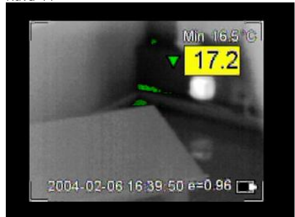
Huone 209, ikkunaseinä, vasen alakulma, alavälipohjan liitos. Min 16.5/tr 21.5
