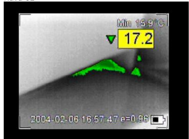
Huone 249, ikkunaseinä, oikea alakulma, alavälipohjan liitos. Min 15.9/tr 21.5
