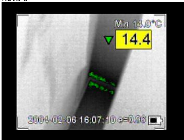
Huone 222, ikkunaseinä, vasen alakulma, alavälipohjan liitos. Min 14.0/tr 21.0
