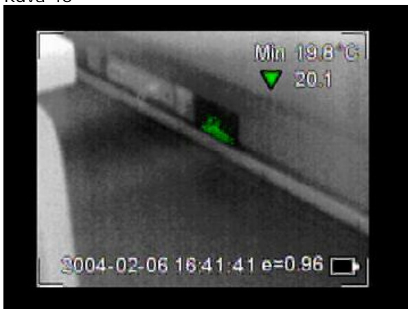
Huone 207, ikkunaseinä, ilmavuoto oikeanpuolimmaisesta pistorasiasta. Min 19.8/tr 22.0. Mitattu ilmavirtaus 0.6 m/s.
