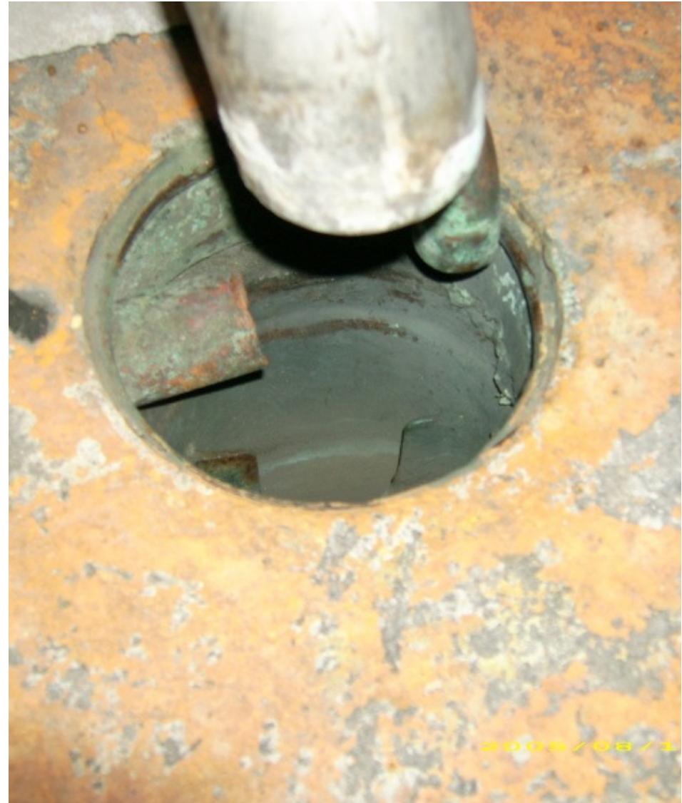
Konehuoneen lattiakaivot ovat kuivuneet.
