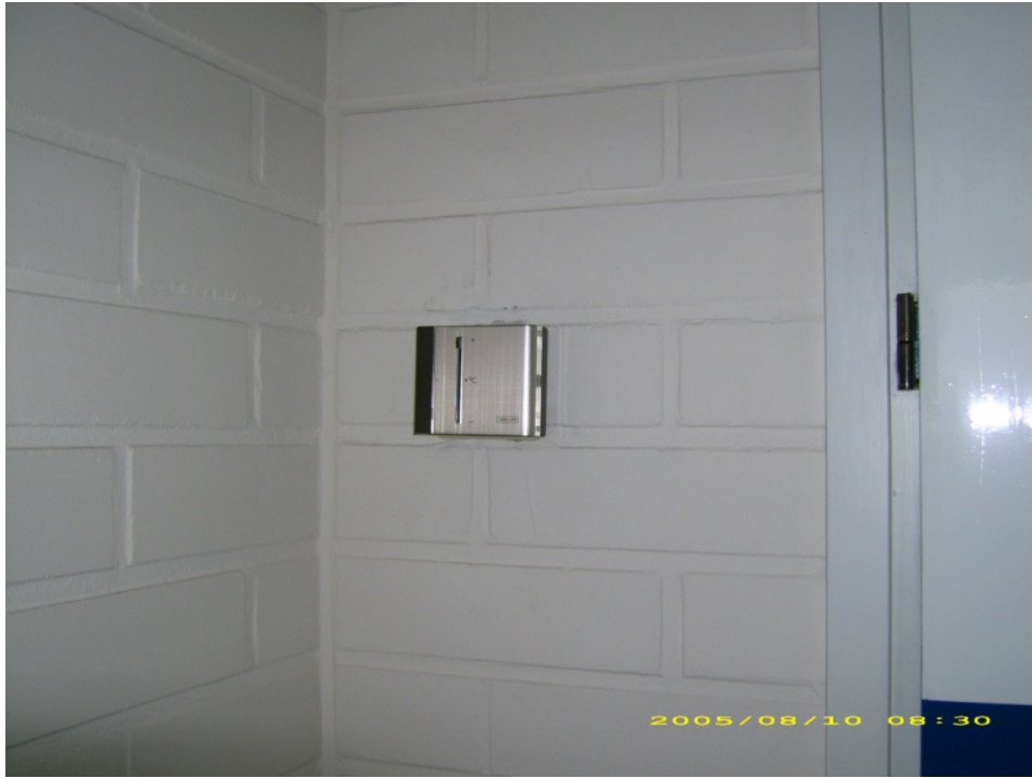
Jälkilämmityspattereiden säätimiä säädetty epäloogisesti.
