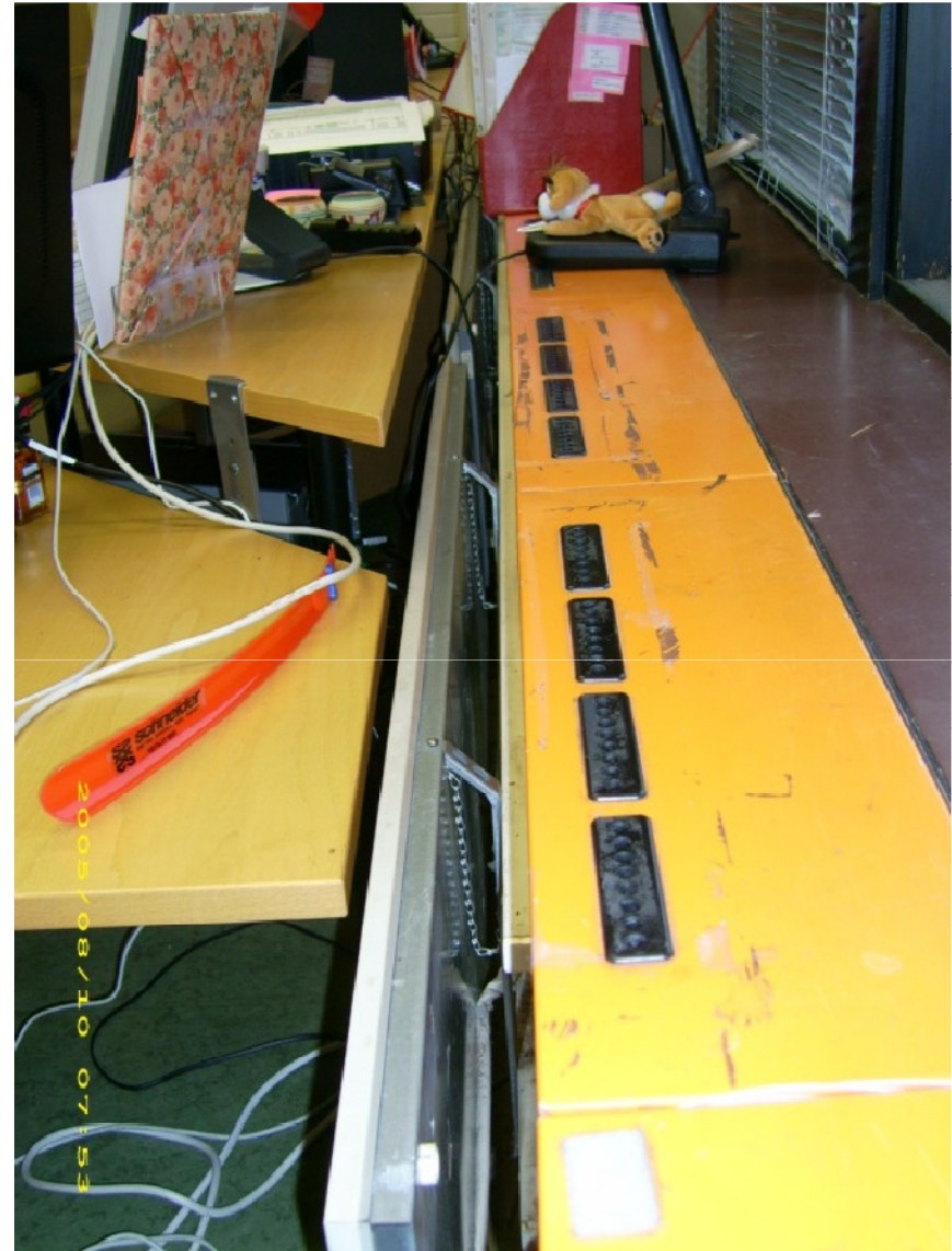
Huonekohtaiset patterit paikoin päällä, paikoin suljettuina.
