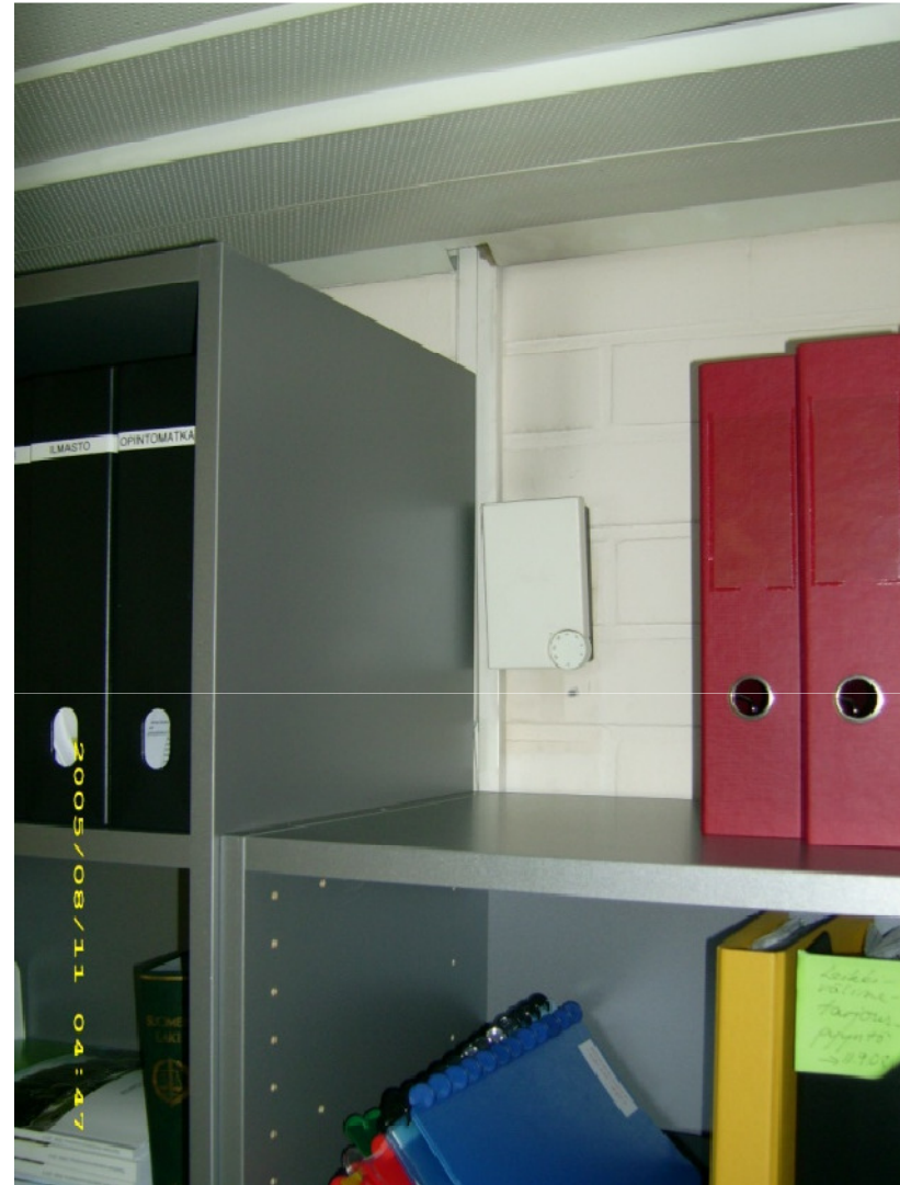
Huoneen 405 anturi ja tuntoelin hyllyn takana seinää vasten.
