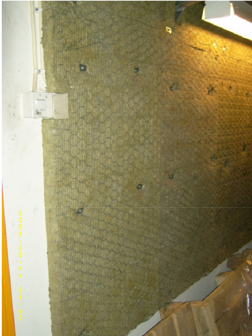
Konehuoneen seinillä on pinnoittamatonta mineraalivillaa.
