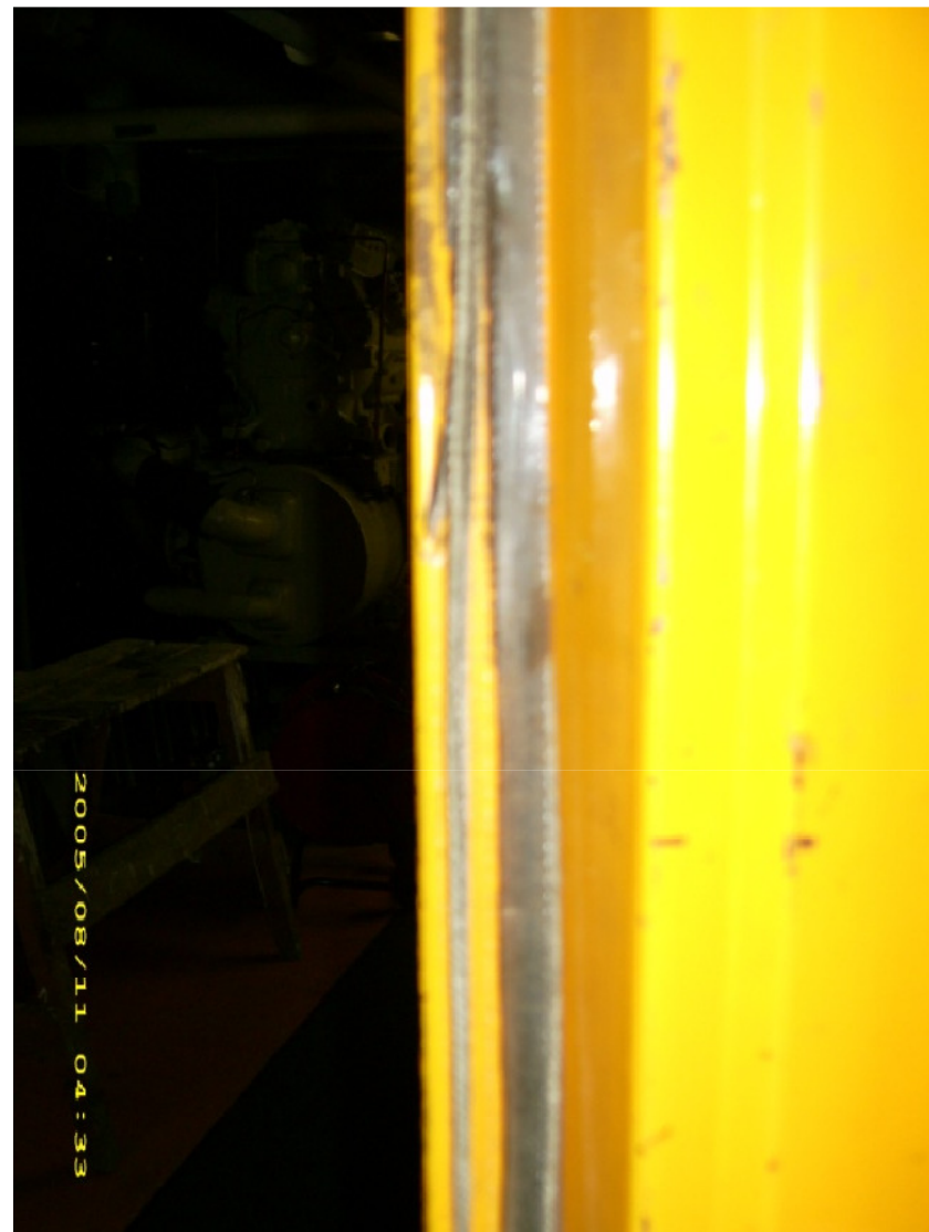
Oven tiivisteet ovat rikkoutuneet. IV-konehuone on ylipaineinen toimistoon nähden.
