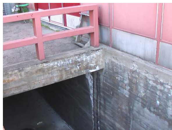
Kuva 18. Vesivuotoa ja pakkasrapautumaa sisäpihan ”sisäänkäyntitunnelissa.
