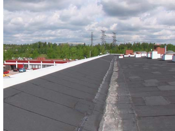
Kuva 24. Kaivolinjojen kaadot on korjattava peruskorjauksen yhteydessä. Kaivolinjaan on jo asennettu ”paikkakermi”.
