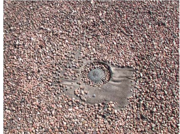
Kuva 22. Umpivirtauskaivo ruokalan päällä. Näihin kupariin kaivoihin (ja niiden putkistoihin) saattaa ikääntymisen myötä tulla vuotoja.
