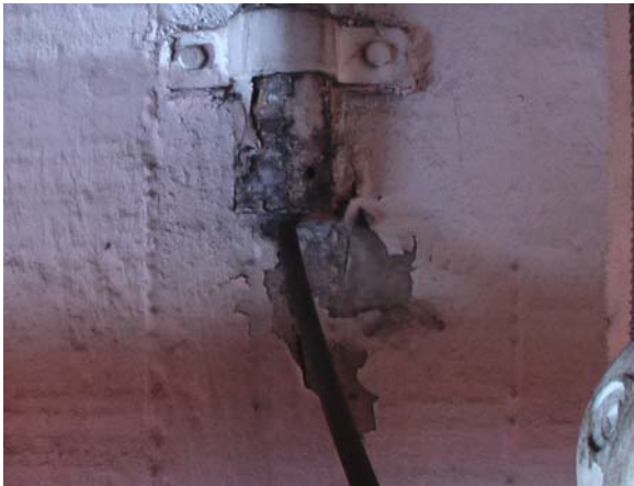
Kuva 26. Antenniputken alapäässä on kosteusjälkiä. Kyseessä on antenniputken kondenssivesi ja/tai sadeveden valuminen antenniputken sisässä.
