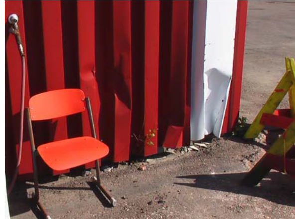
Kuva 16. Törmäysvaurio korjaamosiiven eteläpäädyssä. Julkisivupelti ulottuu liian alas asfalttiin saakka.
