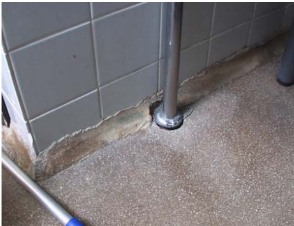
Kuva 8. Keittiön akryylibetonipinnoitteen ylösnosto seinälle on virheellinen ja epäluotettava. Kuvassa myös epätiivis viemäriläpivienti.
