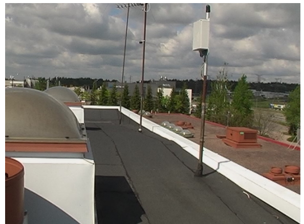
Kuva 30. Vuotokohta on kuvassa taaimpana näkyvän antennin kohdalla. On myös mahdollista, että vuoto on muualla. Vesi voi valua höyrynsulkua pitkin kaivolinjoille päin ja sieltä edelleen poimulevyn pohjaa pitkin kohti antenniläpiviennintä (ks. kuva 27).
