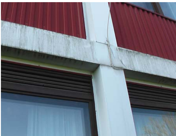
Kuva 9. Yleiskuva julkisivun verhouksrakenteista. Lika näkyy valkoisessa rankapellissä. Tippalista tai erilainen vaakapellin muotoilu estäisi sadeveden valumisen ikkunarakenteeseen tehokkaammin.
