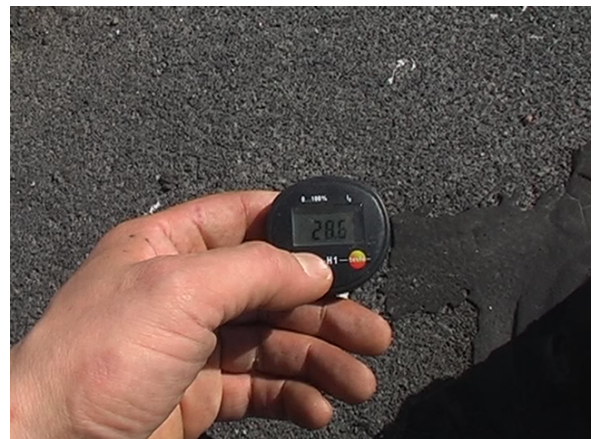
Kuva 36. Katon lämmöneristeen kosteus syvyydellä 100 mm mitattiin 9:stä pisteestä. Suhteellinen kosteus vaihteli välillä 27,6-37,4 RH -% ja lämpötila välillä 17,8-28,0 °C
