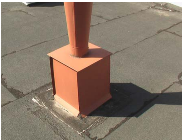
Kuva 33. Kattoläpivientityyppä vuotokohdan lähellä, 1 kpl (n. 300x300). Paikattu.
