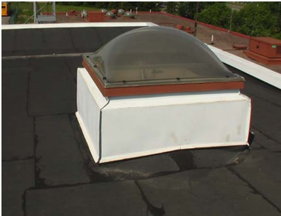
Kuva 32. Kattoläpivientityyppä vuotokohdan lähellä: kattoikkunat 2-3 kpl (n. 1500x1500).
