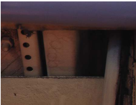
Kuva 27. Myös poimulevyn alapinnassa on jälkiä kosteudesta. Kyseessä voi olla räystäällä tapahtuva kondenssi (profiilin urat eivät saisi avautua ulkoilmaan!) tai muualta kattoalueelta kulkeutuva vesi.
