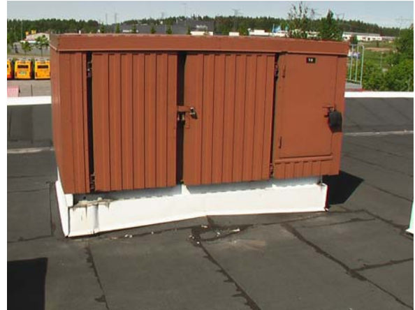
Kuva 34. Kattoläpivientityyppä vuotokohdan lähellä, 1 kpl (n. 2000x2000). Sama laite kuin kuvassa 31.
