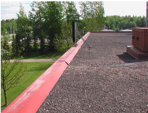
Kuva 20. Räystäiden korkeus kattopinnasta on riittävä. Pellit ovat hieman liian pitkiä (lämpöliikkeet) ja yläpinta ei kaada sisäänpäin (=puutteet).
