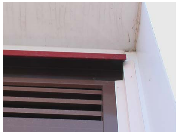
Kuva 11. Vesi voi päästä rakenteeseen ikkunan yläpuolisen vesipellin päädyn kautta.
