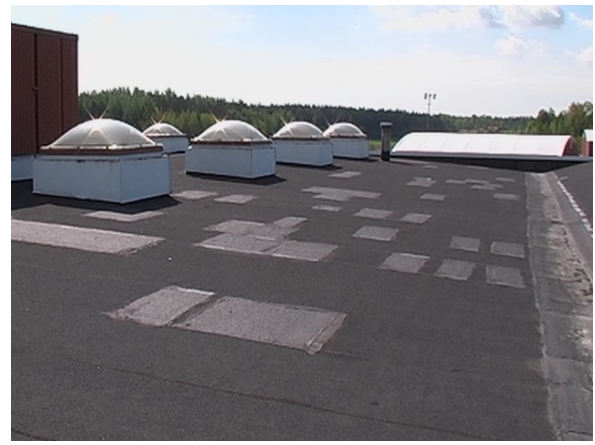
Kuva 23. Tutkijan käsityksen mukaan korjaamosiiven katto on jo saneerausikässä.
