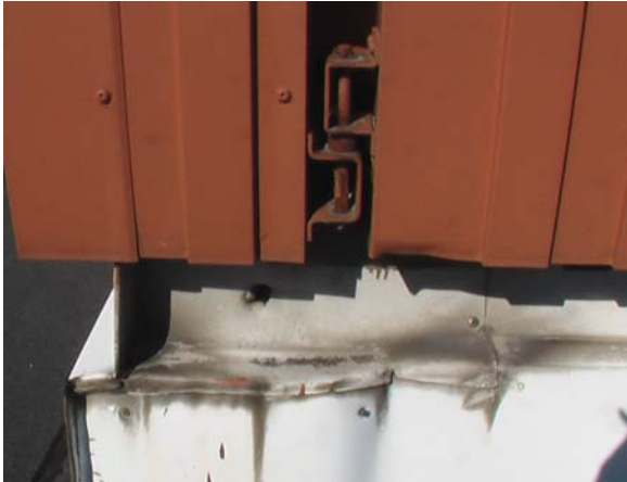
Kuva 31. Vuotokohtaa lähellä olevan IV-kojeen ylösnostopellitykset todettiin epätiiviiksi. Mm. kaksi reikää löytyi pellityksestä, kuvassa yksi reikä.
