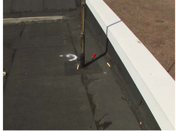
Kuva 29. Antennin sisä- ja ulkoputken liitos todettiin epätiiviiksi. Tilanne korjattiin huoltomiehen toimesta kumibitumikitillä.
