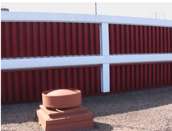
Kuva 3. Vesivuotokohta korjaamotiloihin katolta nähtynä. Vesi tulee sisään ylemmältä katolta, ei ylösnostosta
