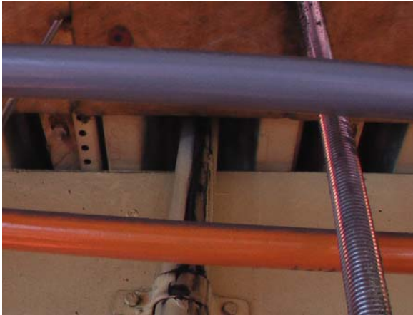
Kuva 25. Kello, jonka päälle vesi vuotaa sijaitsee kuvassa näkyvän antenniläpiviennin alapuolella.
