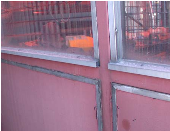
Kuva 14. Korjaamosiiven vanhoissa teräs-lasiseinissä on ollut vesivuotoja. Umpiosan lämmöneristävyys on puutteellinen.
