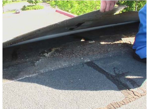
Kuva 28. Vesi pääsee esteettä räystäspellin alle korjaamasiivien harjan kohdalla.
