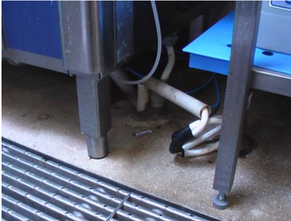
Kuva 7. Aika-ajoin tulniva lattiakaivo astianpesukoneen alla. Epätiivittä johtoläpivientejä.
