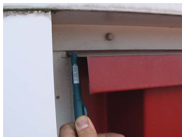
Kuva 12. Vesi voi päästä seinärakenteeseen profiilipellin yläpuolisen vesipellin päädyn kautta. Huomaa vaatimaton kaato. Avainasemassa on kosteutta kestävä ja yhtenäinen tuulensuojalevy.
