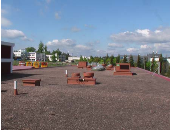
Kuva 19. Näkymä toimistosiiiven katolta ruokalaan päin. Kattotyypin on luotettava, joskin kateella on jo ikää. Suojakiveys on irti, joten peruskorjauksesta tulee kustannuksiltaan edullisempi.
