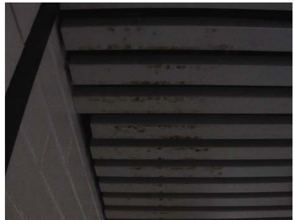
Kuva 5. Vesivuotokohta Vantaan Veden tiloissa käytävällä. Yläpuolella sijaitsee keittiön astianpesukone. Vuoto on peräisin viemäröinneistä ja/tai epätiivyistä läpivienneistä keittiön lattiassa
