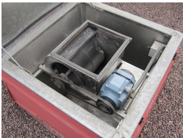
Kuva LVI-13. Yhteiskanavapuhallin kansi avattuna.
