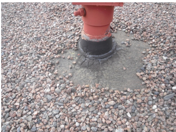
Kuva R-17. Singelin alta paljastunut kermi on kovettunut ja halkeillut.
