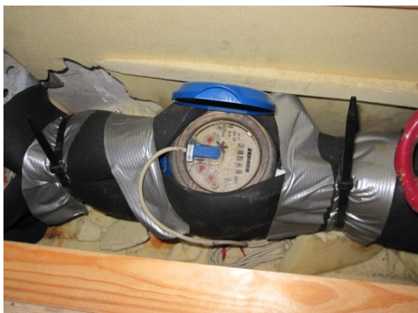
Kuva LVI-7. Päävesimittari sijaitsee päiväkodin tiloissa 1. kerroksessa.
