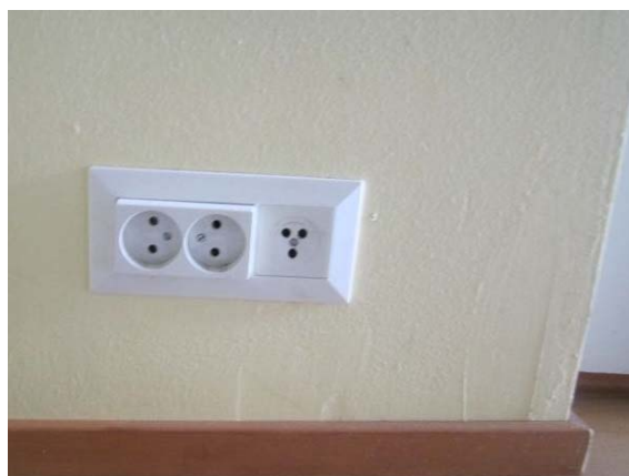
Kuva S-10. Alkuperäinen maadoittamaton pistorasia.
