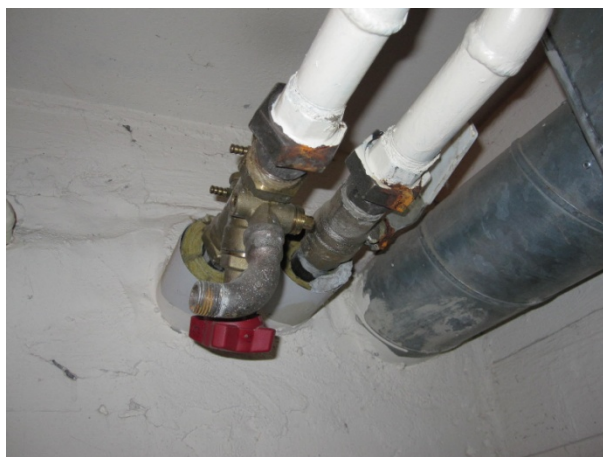
Kuva LVI-4. Lämmitysverkoston sulku- ja linjasäätöventtiilit ovat alkuperäisiä.
