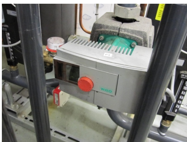
Kuva LVI-2. Kiertovesipumput ovat taajuusmuuttajakäyttöisiä.
