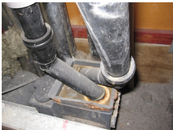
Kuva LVI-10. Kuvassa on putkihormissa oleva vesilukollinen kokoojakaivo.
