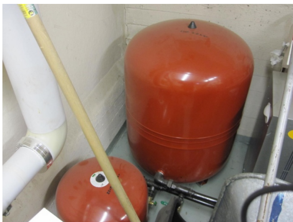
Kuva LVI-3. Lämmitys- ja iv-verkoston kalvopaisuntasäiliöt.
