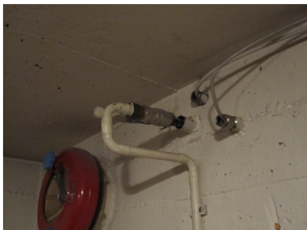
Kuva LVI-8. Väestönsuojaan tuleva kylmävesijohto, sulkuventtiili on alkuperäinen.
