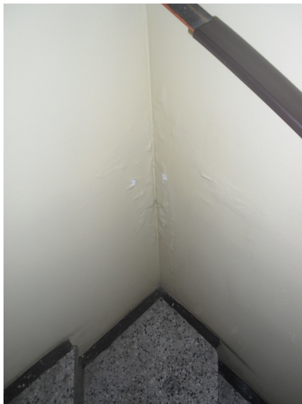
Kuva R-20. Vanha kosteusvaurio porrashuoneen seinässä.
