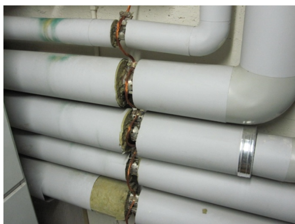
Kuva LVI-6. Lämmitys- ja käyttövesiverkoston eristyksiset ovat mineraalivillaa ja päällysteenä näkyvillä paikoilla on käytetty PVC-muovia.
