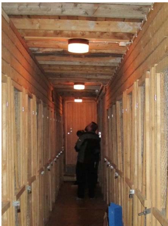
Kuva S-9. Ullakkokäytävän valaistus.
