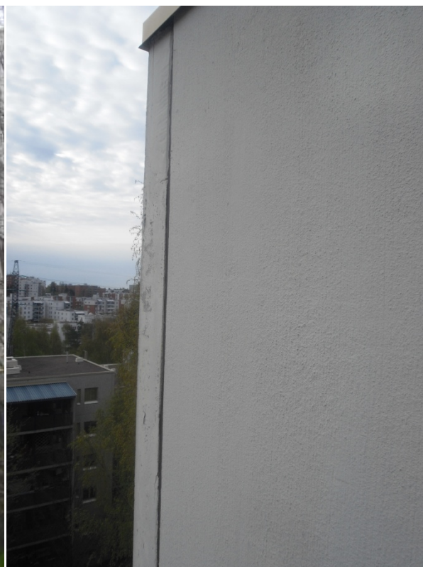
Kuva R-8. Nurkkaelementissä näkyvä mahdollinen rapautumavaurio.
