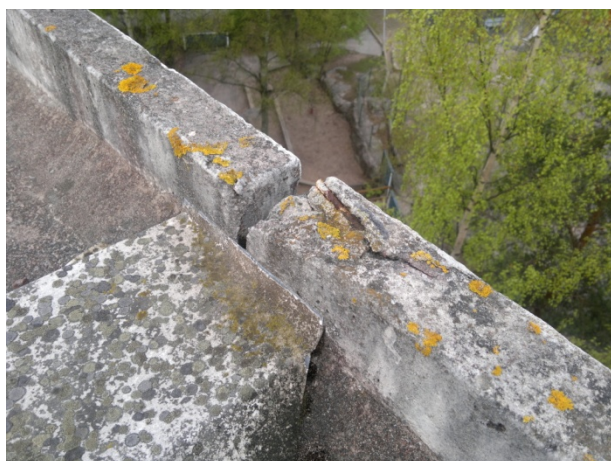
Kuva R-11. Ylimmällä parvekekatolla ruostunut teräs betonirakenteessa.
