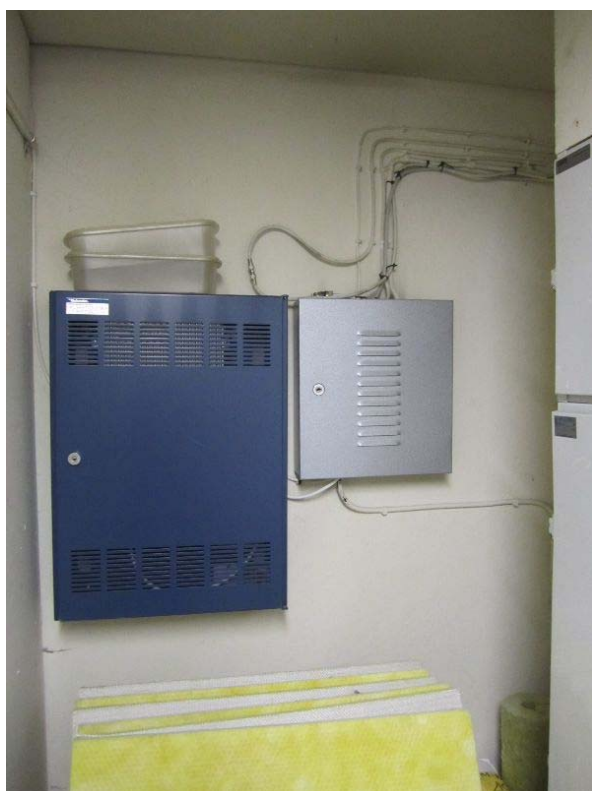
Kuva S-5. Antennivahvistin pääkeskustilassa.
