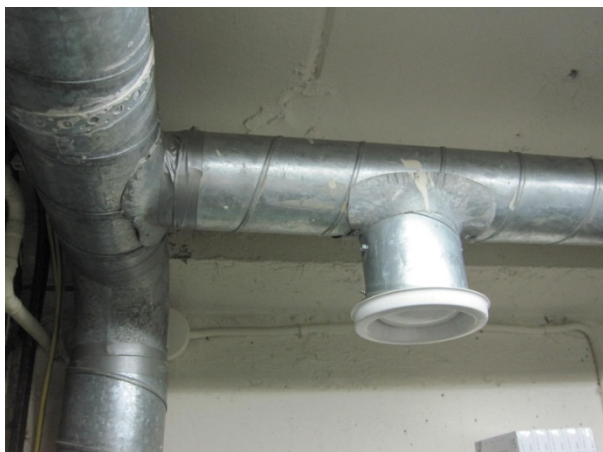
Kuva LVI-15. Kanavat ovat pyöreitä peltikanavia.
