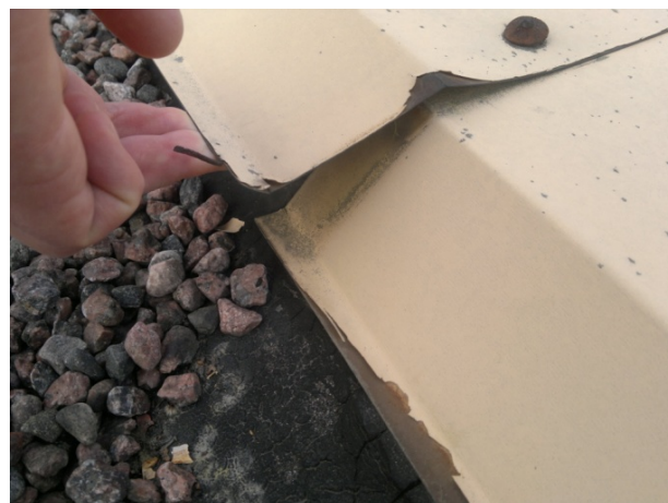
Kuva R-18. Räystäspellin kiinnitysruuvi on ruostunut.
