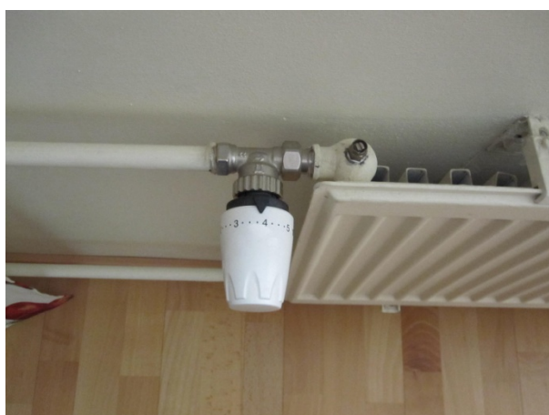
Kuva LVI-5. Patteriventtiilit ovat termostaattisia mallia TA TRV-2.
