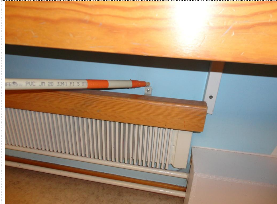
Kuva 3: Yksittäisiä ilmavuotoja havaittiin patterikiinnikkeiden kohdalla (kuva tilasta leikki/lepo 100)
