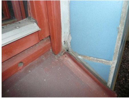
Kuva 24. Rakoja vesipellin ja smyygin liitoksessa.
