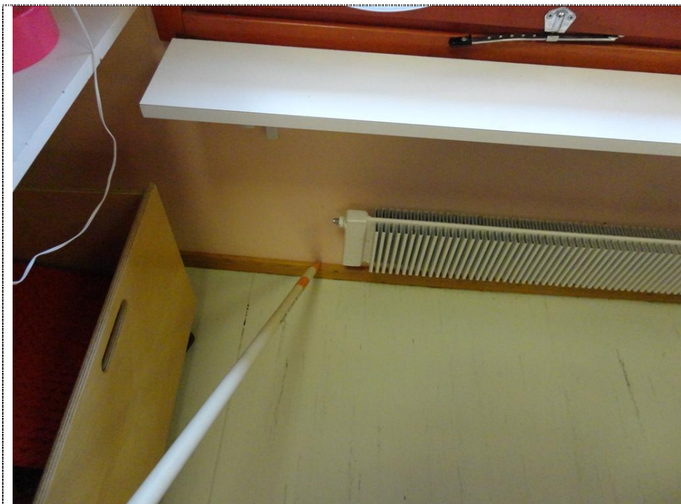
Kuva 4: Tyypillinen vuotokohta alapohja- ja ulkoseinärakenteen liitoskohdassa (ryhmähuone 111).
