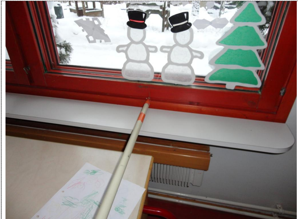
Kuva 5: Vähäisiä vuotoja havaittiin ikkunakarmeista.
