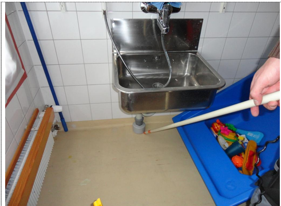
Kuva 6: Vuotoilmareitti vesileikkihuoneen 106 viemäroinnin läpiviennistä on peräisin ulkoseinä- ja/tai alapohjarakenteesta.
