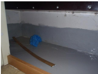
Kuva 13. Vesimittarihuoneen lattiapinnoite irtoaa.
