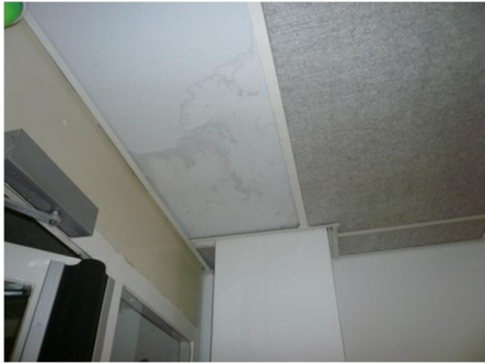
Kuva 19. Vanha vuotojälki alakatossa.
