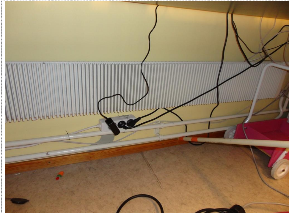
Kuva 1: Laskettaessa merkkiainetta huoneen 104 alapohjaan, havaittiin merkkiaineen kulkeutuvan sisäilmaan kyseisen tilan seinien ja alapohjan liitoksista.
