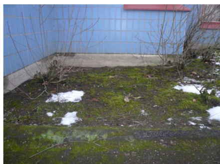
Kuva 3. Puutteita maanpinnan kallistuksissa.
