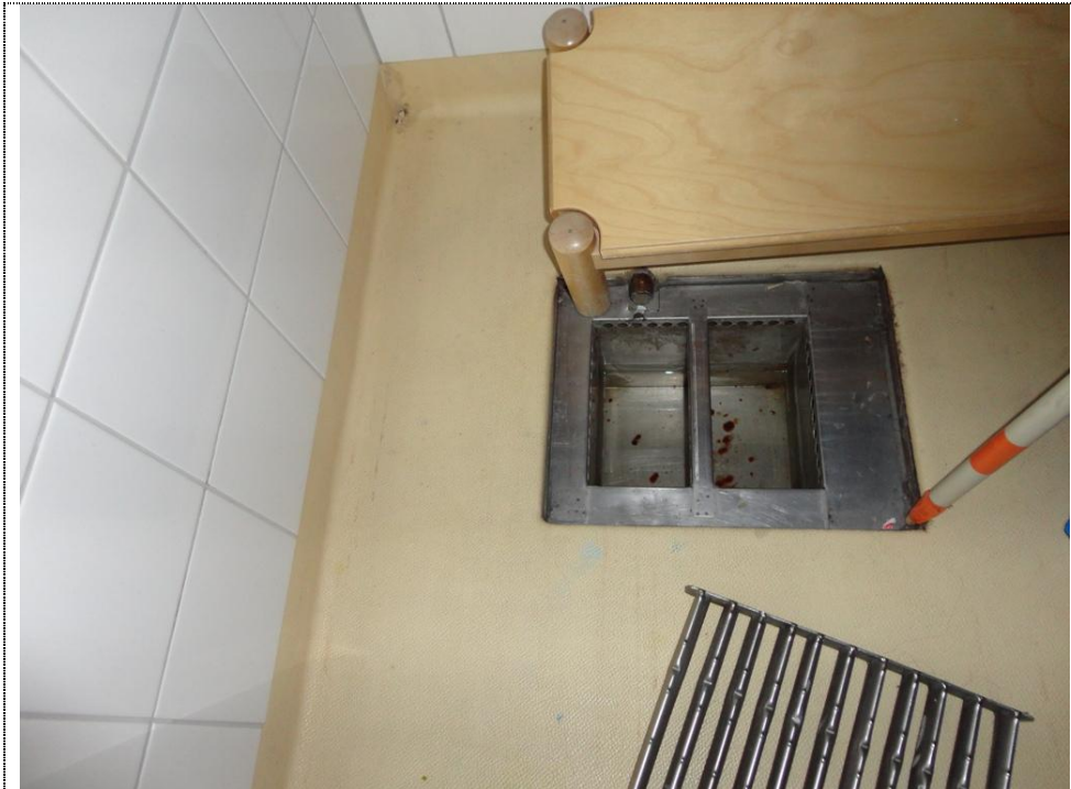
Kuva 7: Vähäinen vuotoilmareitti vesileikkihuoneen 106 läpiviennin liitoksesta on peräisin ulkoseinä- ja/tai alapohjarakenteeseen syötetystä merkkiaineesta.
