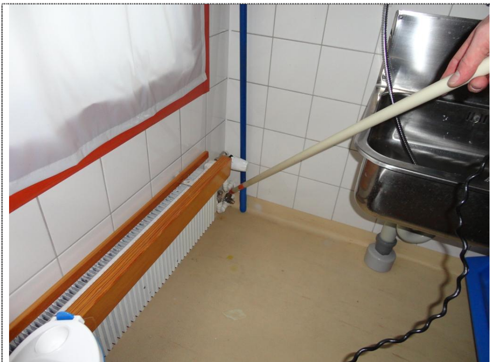
Kuva 8: Vuotoilmareitti vesileikkihuoneen 106 patteriputken läpiviennistä.
