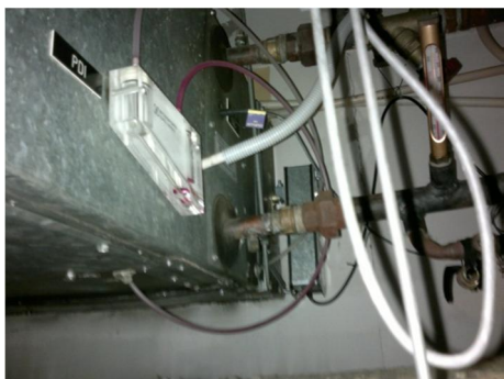
Kuva 25. Paine-eroa mittaava manometri on vaikeasti luettavissa.
