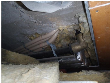
Kuva 22. Kotelon sisässä oleva läpivienti.
