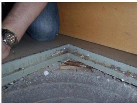
Kuva 10. Betonirenkaan ja lattian avonainen liitos.
