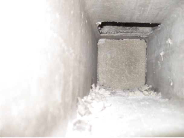
Kuva 5 2.krs. B-siipi WC / m poistoilmakanava. (Mineriittikanavaa) Kanavan pohjalla reiän teosta syntyneet jätteet.
