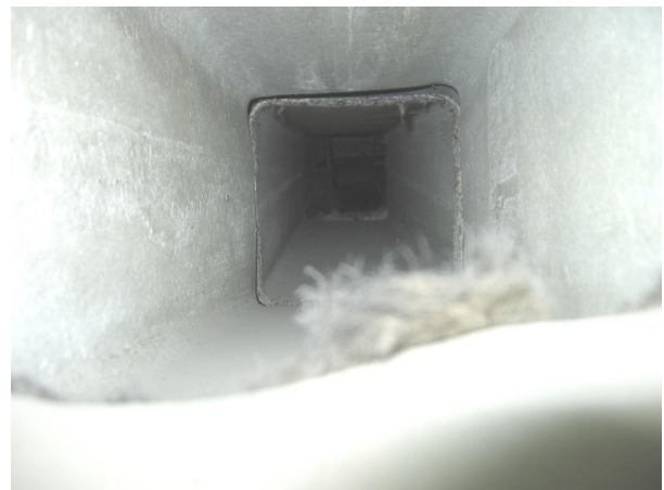
Kuva 32 1.krs. A-siipi Huone 611 poistoilmakanava. (Mineriittikanavaa)
