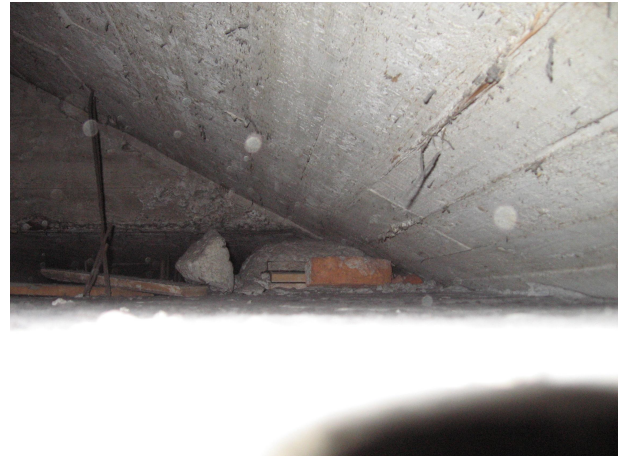
Kuva 22 2.krs. C-siiven aula, venttiilit johtavat suoraan rakenteisiin.
