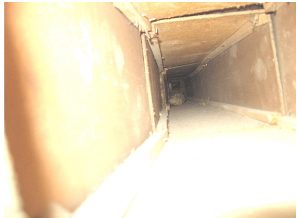
Kuva 20 2.krs. C-siipi Huone 744 poistoilma- kanava. (Repeillyt lastulevykanava)
