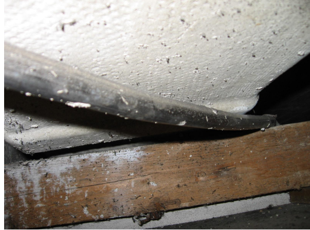
Kuva 2 2.krs. B-siipi kopiohuoneen Venttiilin ja runkokanavan välistä otettu kuva välitilaan.
