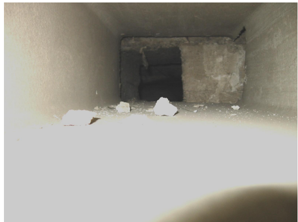
Kuva 4 2.krs. B-siipi, huoneeseen 712 menevä poistoilmakanava toiseen suuntaan.
