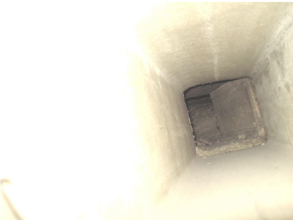
Kuva 19 2.krs. C-siipi Huone 743 poistoilma- kanava. (Mineriittikanavaa)
