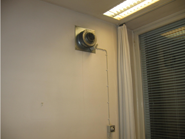
Kuva 17 1.krs. Laajennusosa Huone 637. Huoneeseen on asennettu oma pois- toilmapuhallin -6 /-23 l/s
