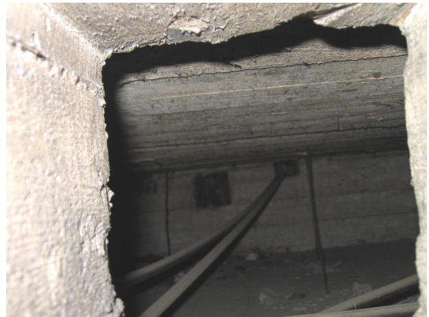
Kuva 28 2.krs. C-siipi Huone 703 poistoilma- kanava. kanavassa risteilee sähköjohto- ja
