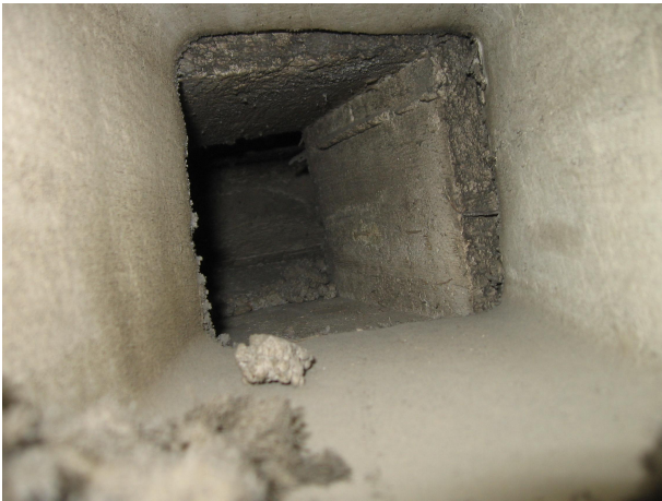
Kuva 29 1.krs. A-siipi Huone 602 poistoilmakanava. (Mineriittikanavaa)
