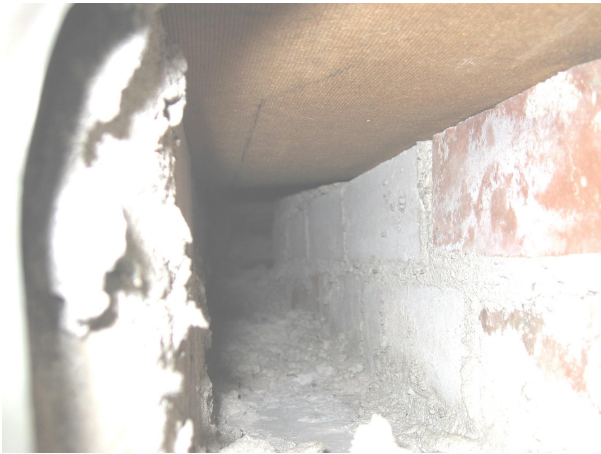
Kuva 33 1.krs. A-siipi Huone 615 poistoilma-kanava. Tiili / Vanerilevy kanava
