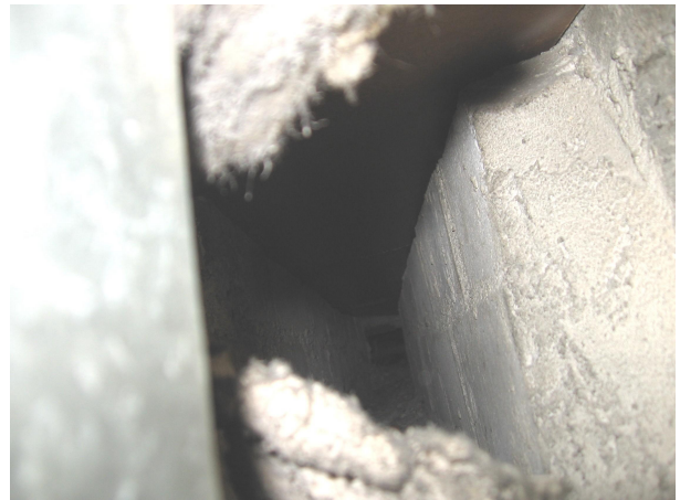
Kuva 30 1.krs. A-siipi Huone 617 poistoilmakanava.
