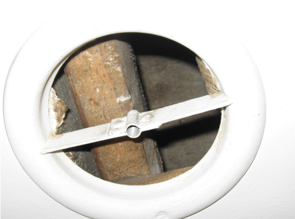
Kuva 7 2.krs. B-siipi. Huoneessa 714 ei ole kanavaa ollenkaan vain venttiili katossa
