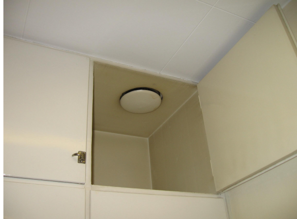
Kuva 10 2.krs. B-siipi, huoneessa venttiili sijoitettu kaapin sisään.
