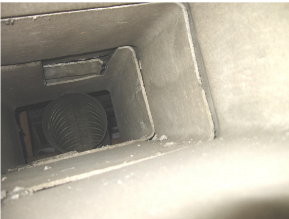
Kuva 3 2.krs. B-siipi, huoneeseen 712 menevä poistoilmakanava. (Mineriittikanavaa) Kanava pahasti lohkeillut ja huoneeseen johtava metallikanavan liitos tiivistämättä.
