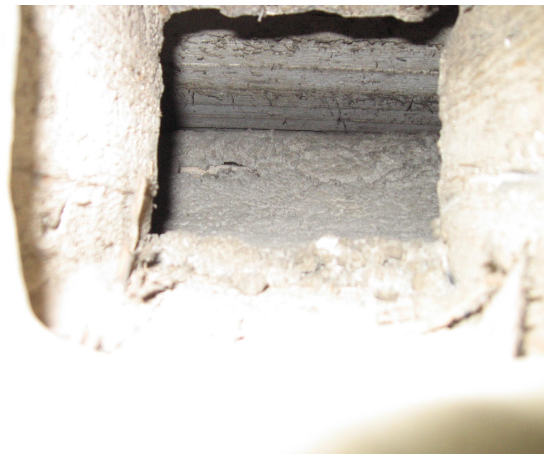
Kuva 12 Rakenneainekanaavissa on myös reikiä.
