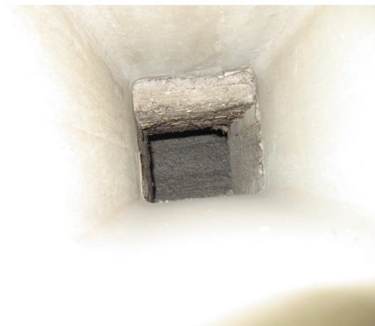
Kuva 24 1.krs. C-siipi Huone 663 poistoilmakanava. (Mineriittikanavaa)
