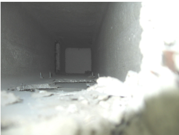
Kuva 31 1.krs. A-siipi WC:t No:128 poistoilmakanavat. ei tapahdu laisinkaan ilmavirtausta (Mineriittikanavaa)
