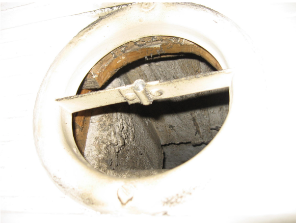
Kuva 11 1.krs. B-siipi Huone 628-630 poistoilmakanava. (Rakenneainekanaava) Venttiilin kiinnitykset eivät ole tiiviitä, poistoilmaa ei pystytä hallitusti ohjaamaan huoneisiin, poistoilmanvaihto imee rakenteista.
