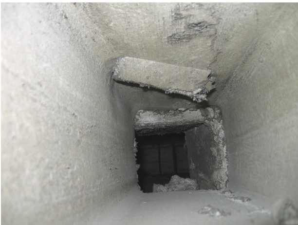
Kuva 27 2.krs. C-siipi Huone 706 poistoilma- kanavavat. (Mineriittikanavaa)
