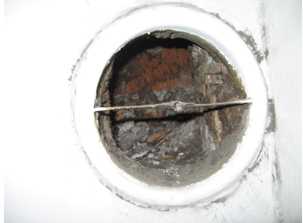
Kuva 18 1.krs. Laajennusosa Huone 646. Venttiili puhalttaa, pysty on rakennei- neinen.
