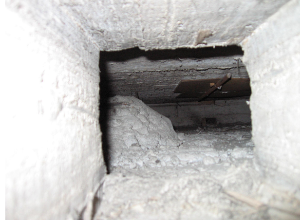
Kuva 6 2.krs. B-siipi, huoneiden 727–228 poistoilmakanava (Rakenneainekanaava) Runkokanavissa on betonia ym. epätaisuuksia mikä estää runkokanavien vaakaosuuksien kuvaamista.
