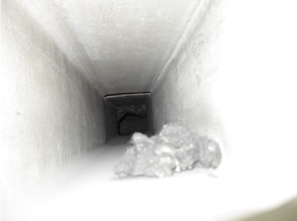
Kuva 9 2.krs. B-siipi. Huone 716, poistoilmakanava. (Mineriittikanavaa)
