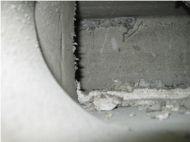
Kuva 25 2.krs. A-siipi WC:n poistoilmakanava. (Mineriittikanavaa)
