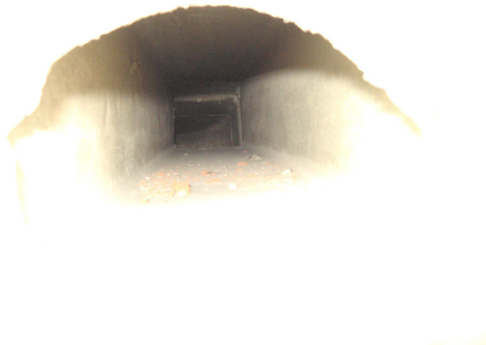
Kuva 23 1.krs. C-siipi WC:n poistoilmakanava. (Mineriittikanavaa)
