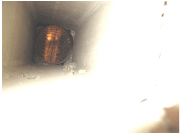
Kuva 26 2.krs. A-siipi WC:n poistoilmakanava. (Mineriittikanavaa)
