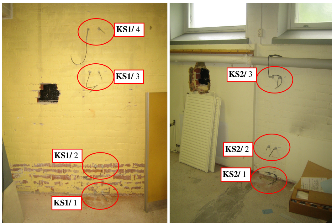
Kuvat 4 ja 5. Vantaan kaupungintalo, kellarikerroksen ulkoseinien suhteellisen kosteuden mittapisteet KS 1 / 1 – 4 ja KS 2 / 1 - 3
