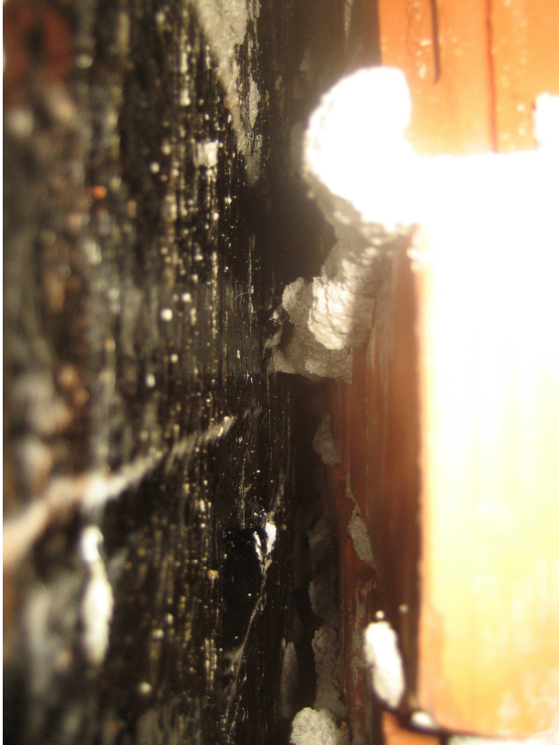
Kuva 14. Vantaan kaupungintalo, kellarin ulkoseinän mittauskohdassa KS1 sisäpuoleisen tiiliverhouksen ja kantavan betoniseinän välissä on selkeä, noin 2 – 4 cm:n rako, jossa aistinvaraisesti todettiin voimakasta ilmavirtausta.
