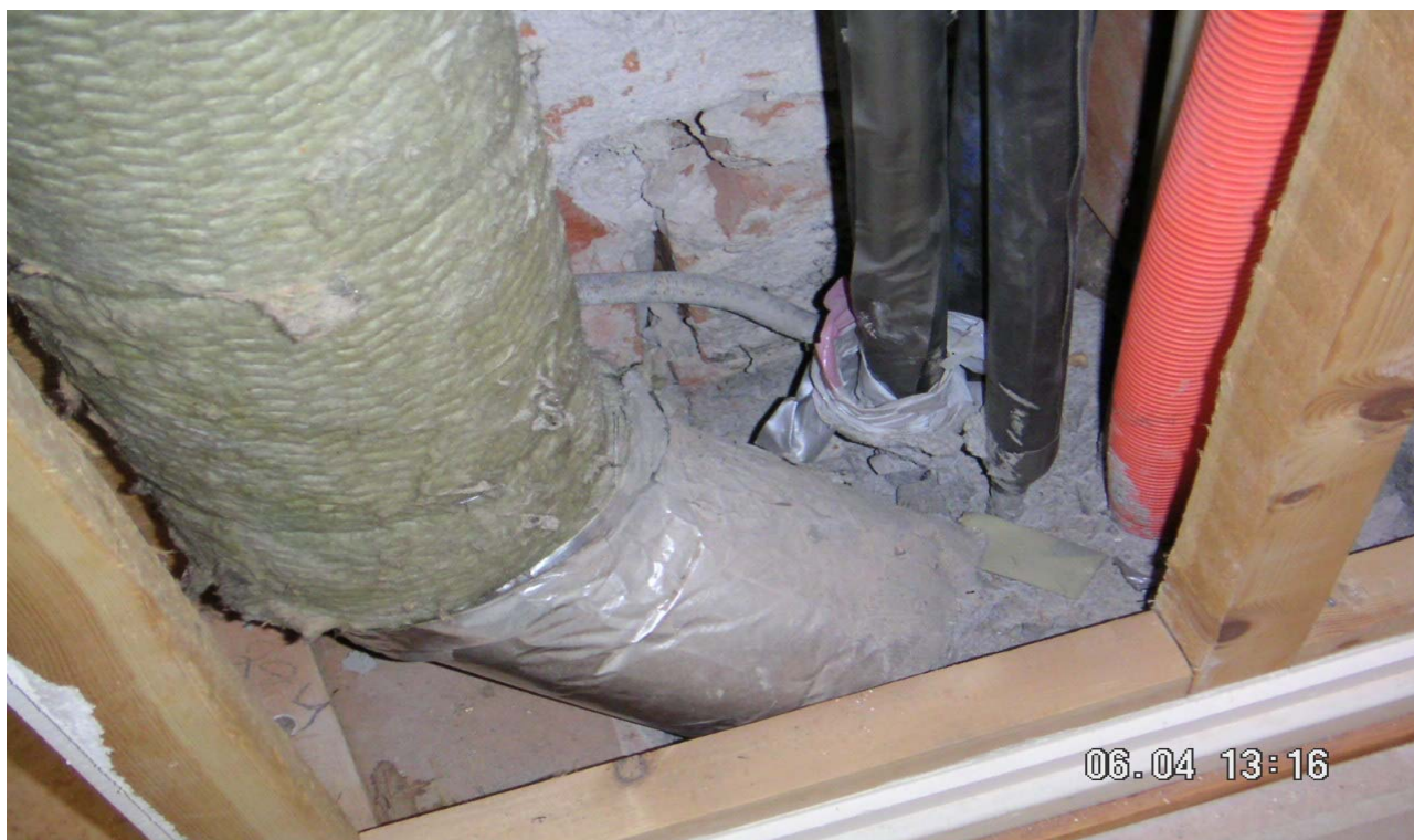
KUVA 6. Läpivientien tiivistyksessä on parantamisen varaa.
