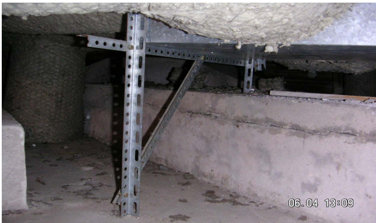
KUVA 3. Ullakolla olevaa rakenneaineista kanavaa, joka on halki.
