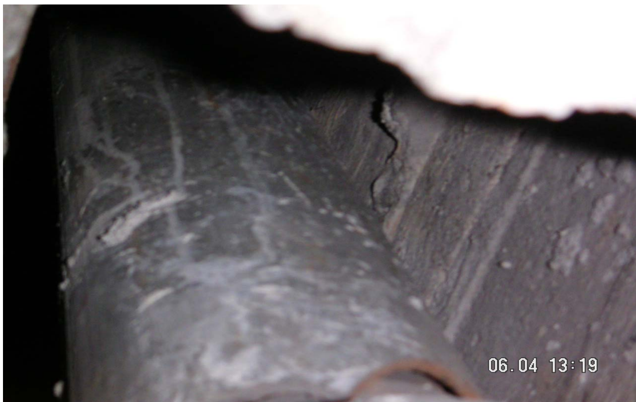
KUVA 5. Läpiviennistä puuttuu tiivistys kokonaan.
