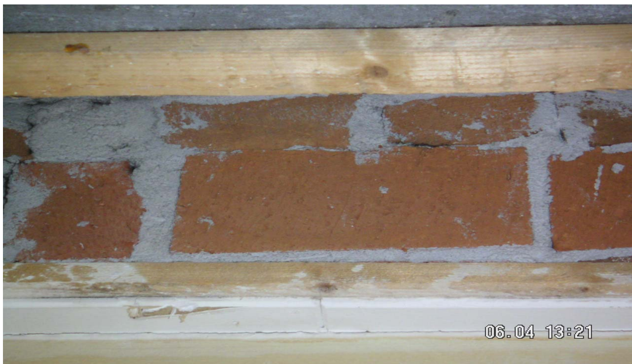
KUVA 1. Huoneessa oleva rakenneaineinen hormi on lohkeillut.
