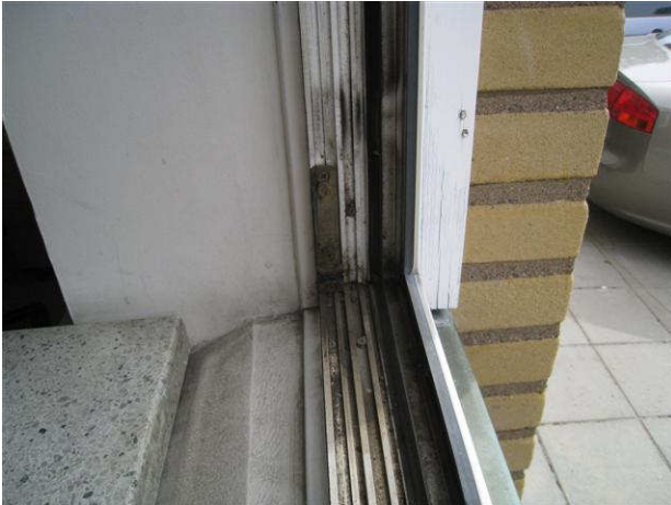
Kuva 7 Huoneen 604 muovirakenteisten ikkunoiden väleissä on runsaasti pölyä.
