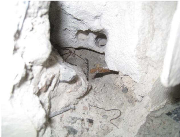
Kuva 13 Huoneen 615 ikkunan kohdalla siporexin alla ei havaittu korkkihalkaisua.
