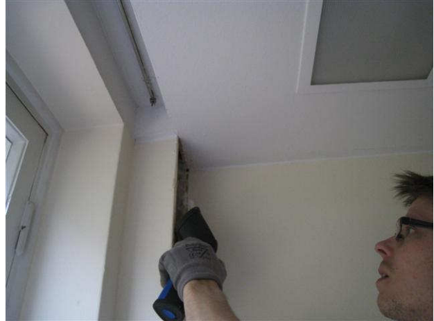
Kuva 14 Huoneen 615 lämpöputkien nousukoteloon painui merkkisavua.
