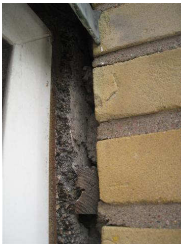
Kuva 9 Huoneen 604 sivupieli, josta on poistettu peitelistä, eristeenä on korkki.
