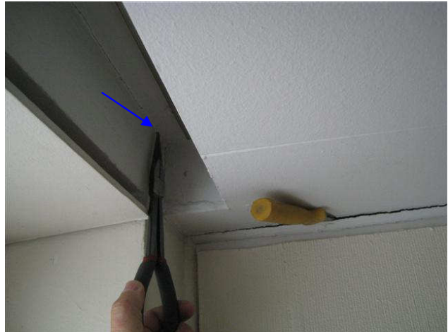
Kuva 4 Huoneen 604 verhokotelon reiästä tuli ilmaa. Alakatto jatkuu 605 suuntaan.
