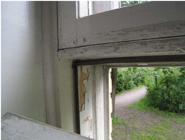
Kuva 19 Huoneen 620 ikkunan maali lohkeilee.
