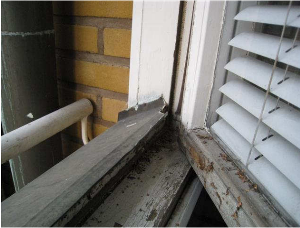
Kuva 31 2. kerroksen pienryhmätilan avattavan ikkunan pellitysratkaisu on huono, ikkunassa on kosteusvaurioita.
