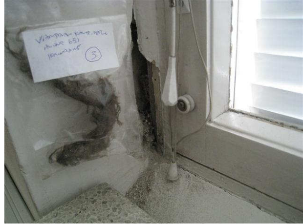
Kuva 26 Huoneen 651 ikkunan luontoperäinen tilke (Näyte 3) sisälsi mikrobeja.
