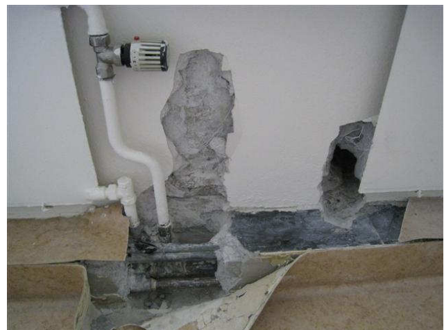
Kuva 12 Huoneen 615 asennuskotelossa on lämpöputket ja kaapeleita.
