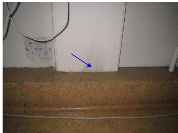
Kuva 18 Huoneen 620 asennuskotelon ja putkiousukotelon ilmavuotojälkiä.
