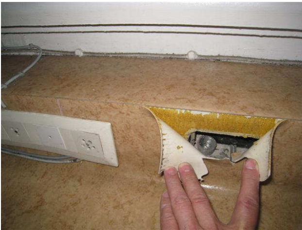
Kuva 27 Huoneen 651 kaapeliputkien kautta tuli kreosotille viittaavaa hajua.
