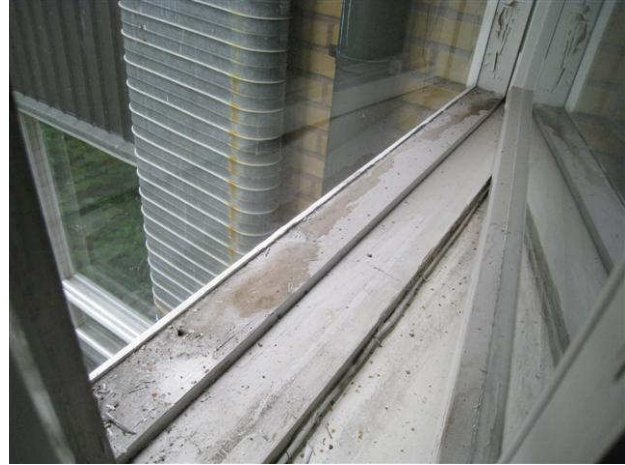
Kuva 32 2. krs:n pienryhmätilan ikkuna, jossa on vielä ulkolasi paikallaan. Tässäkin on vuotojälkiä.
