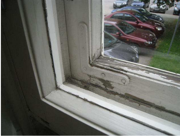
Kuva 25 Huoneen 651 ikkuna on kärsinyt kosteusvaurioita.
