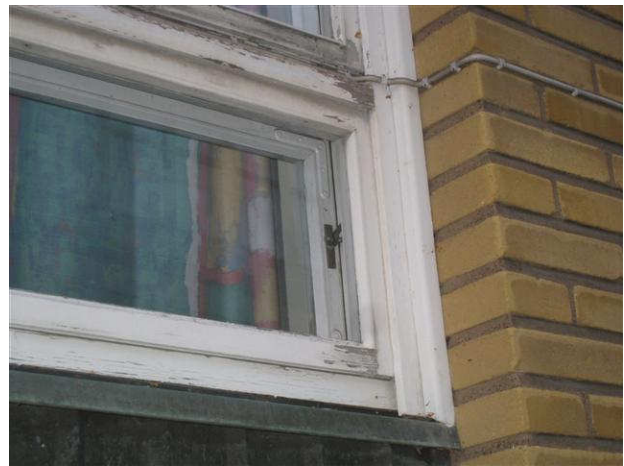
Kuva 20 Länsisiiven pohjoissivun ikkuna on kunnut ulkoapäin, liittymässä puulista.
