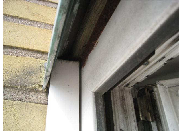
Kuva 8 Huoneen 604 ikkunan ylä ja sivupieli.
