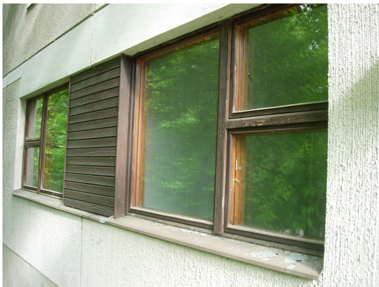
3. Kerrostalojen puupintaiset ikkunat kaipaavat huoltomaalausta kunnossapitajakson alkupuolella.
