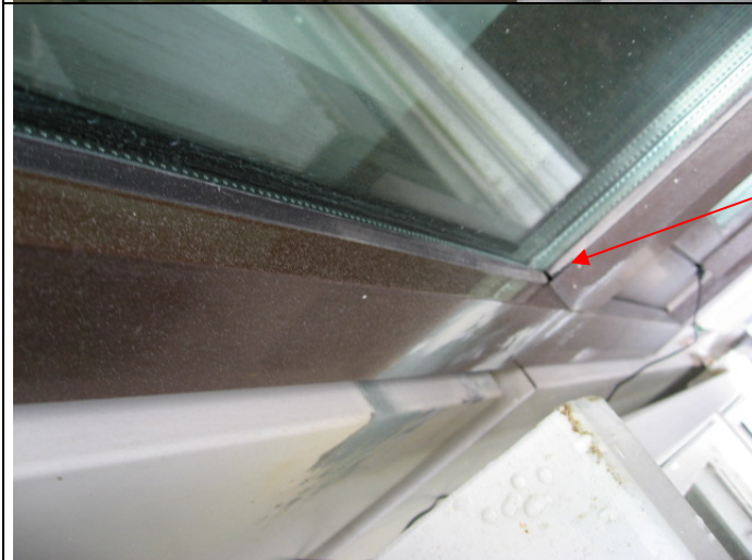
Kuva 8 Ikkuna tiiviste auki ja väljä.
