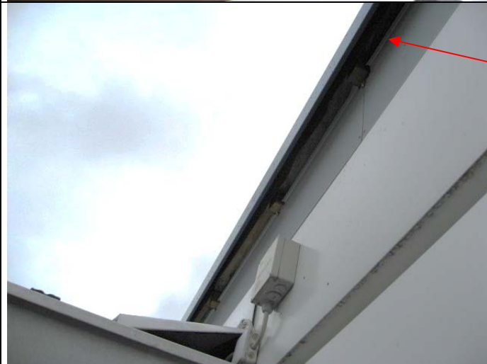
Kuva 5 Myrskypelti puuttuu. Tuulella vesi menee tätä kautta rakenteisiin.
