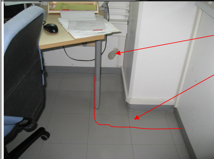
Kuva 11 Seinästä maali poistettu Lattia märkä.
