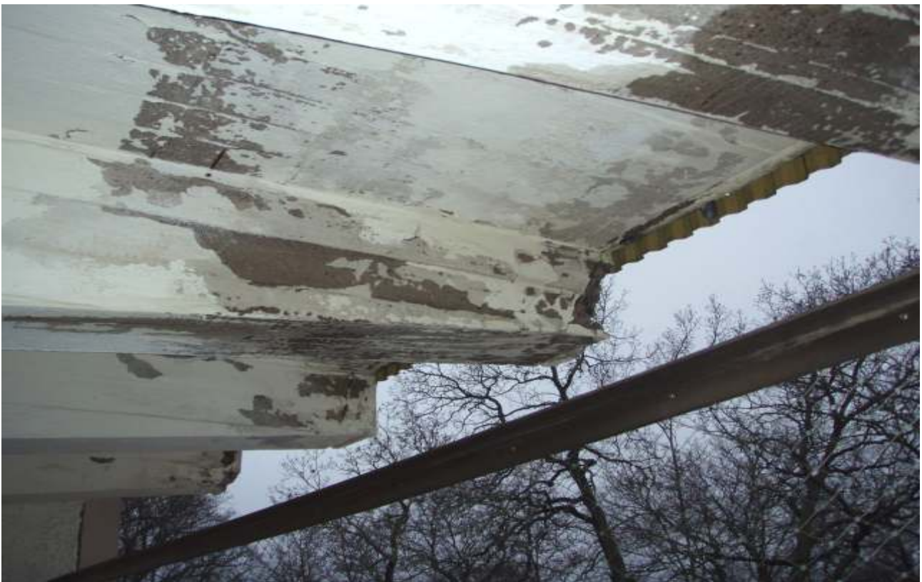
R-kuva 2. Parvekerakenteissa esiintyi tarvetta rakenteiden kunnostamiselle.
