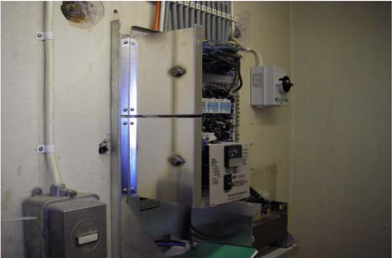
S- kuva 3. Huoltamaton turvavalaistusjärjestelmän keskus.
