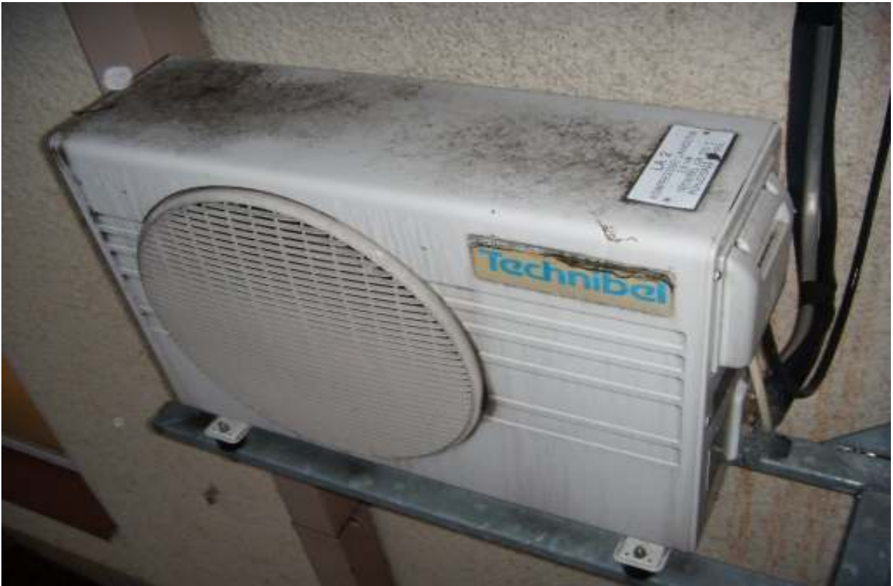
LVI-kuva 11. Yleiskuva lääkehuoneen ulkoyksiköstä.
