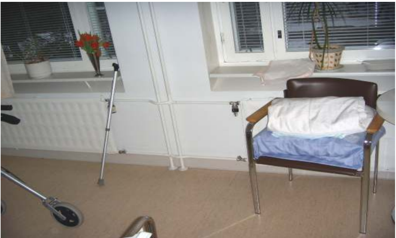
LVI-kuva 8. Vuodeosastojen huoneissa on rikkiäisiä patteriventtiileitä.
