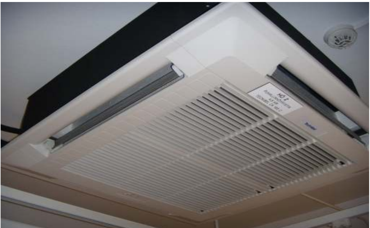
LVI-kuva 10. Yleiskuva lääkehuoneen sisäyksiköstä.
