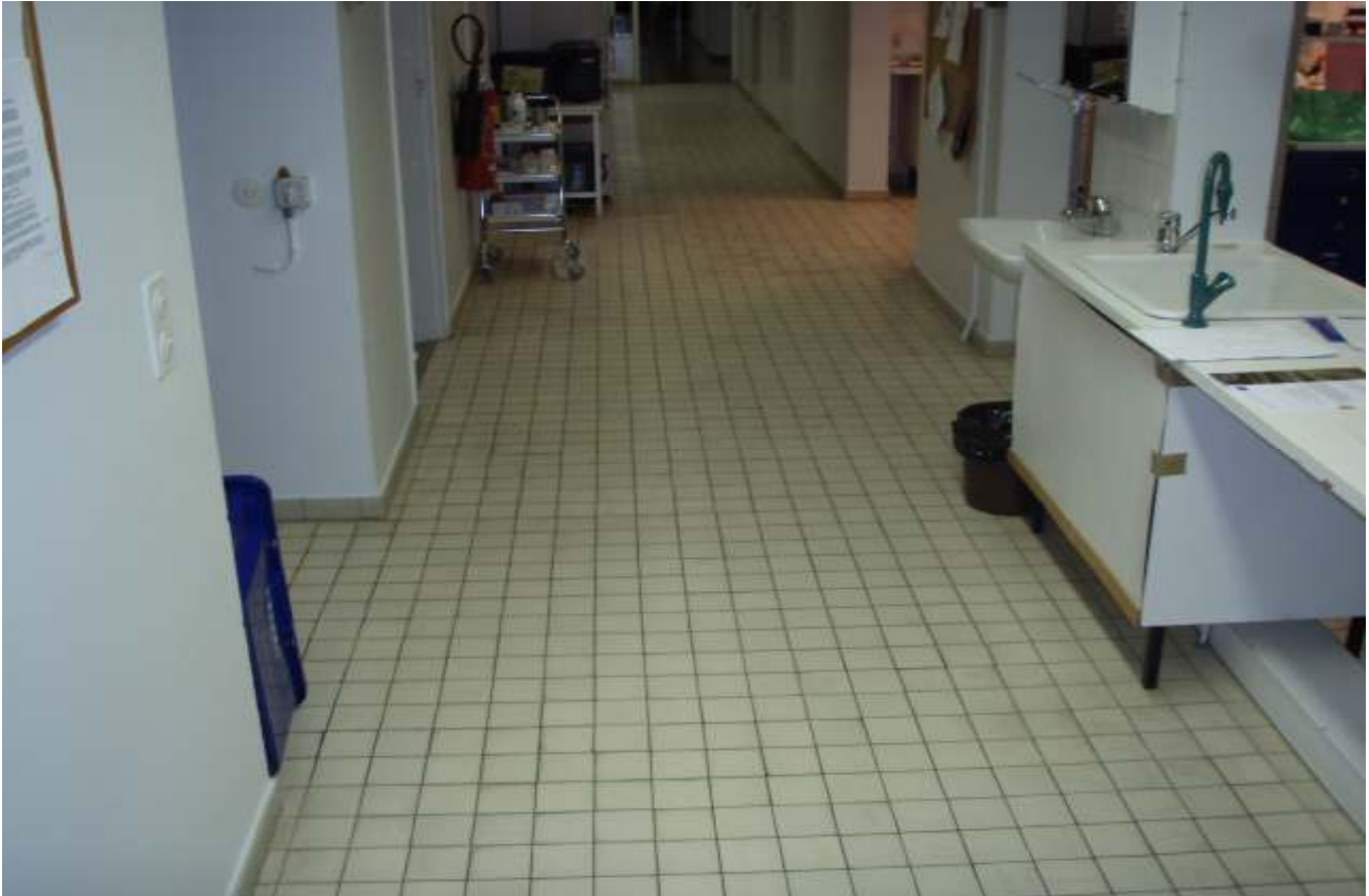
R-kuva 9. 1. kerroksessa sijaitsevan laboratoriotilan pintarakenteet ovat ikääntyneitä ja niiden arvioitiin edellyttävät kunnostustoimenpiteitä lähivuosien aikana.
