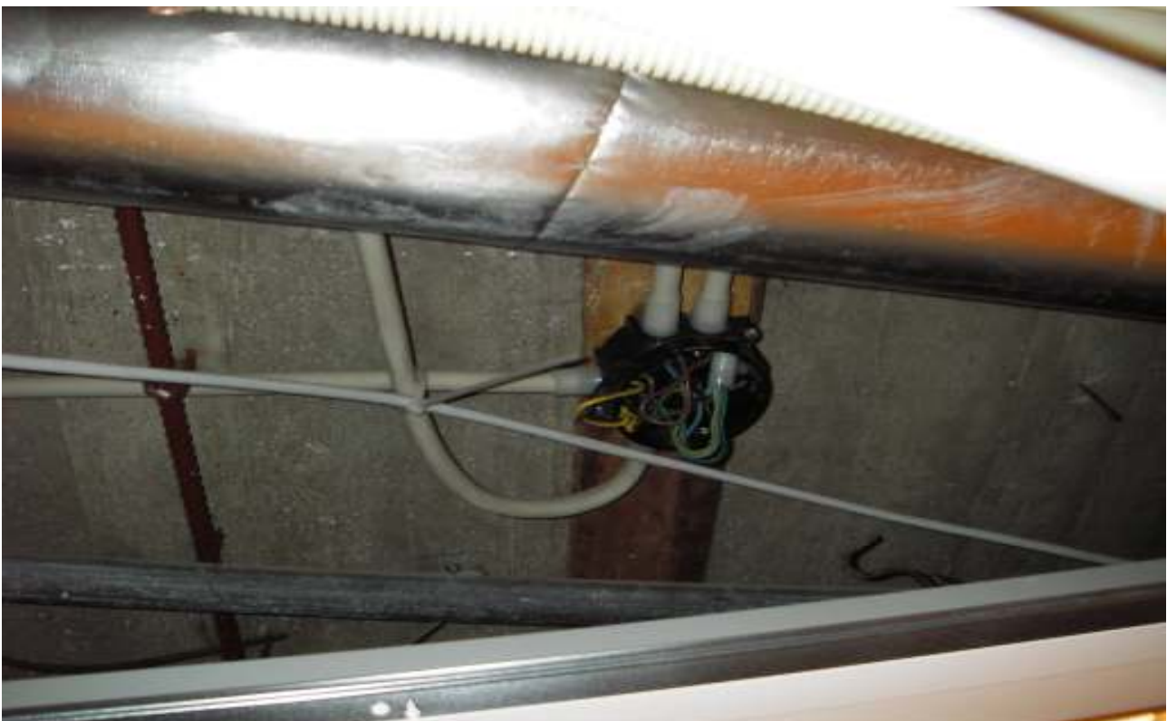
S-kuva 6. Alalaskukattojen yläpuolella jakorasioista puuttuu kansia.
