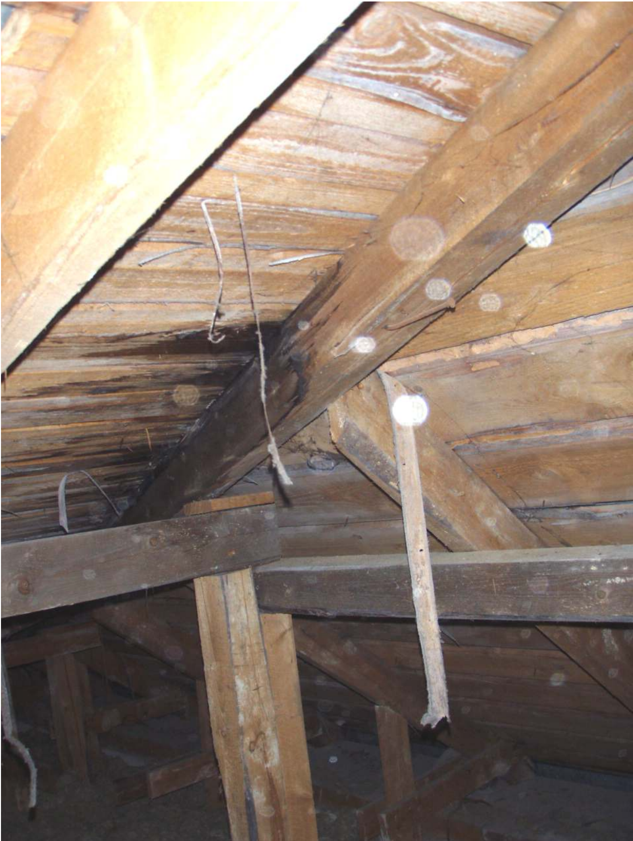
R-kuva 4. Vesikaterakenteessa havaittiin olevan useassa kohtaan vuotoja.
