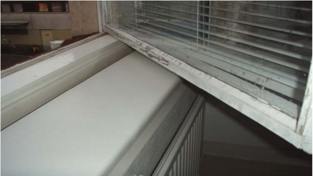
R-kuva 1. Ikkunarakenteissa esiintyi tarvetta huoltomaalaukselle.
