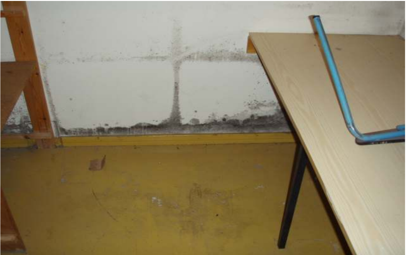
R-kuva 5. Pohjakerroksessa sijaitsevan, käytöstä poistetun varastotilan pintarakenteissa esiintyi tarvetta kunnostustoimenpiteille.
