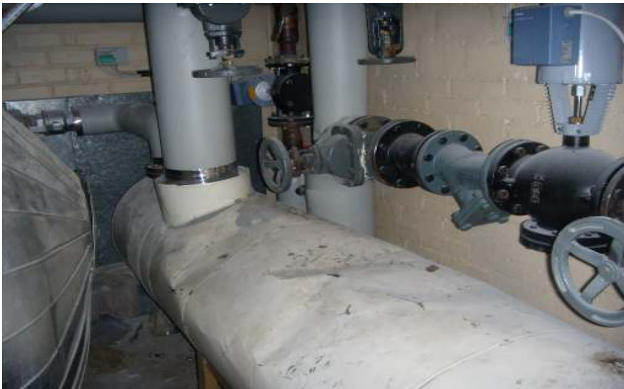
LVI-kuva 1. Käyttövesiverkoston vanha lämmönsiirrin.
