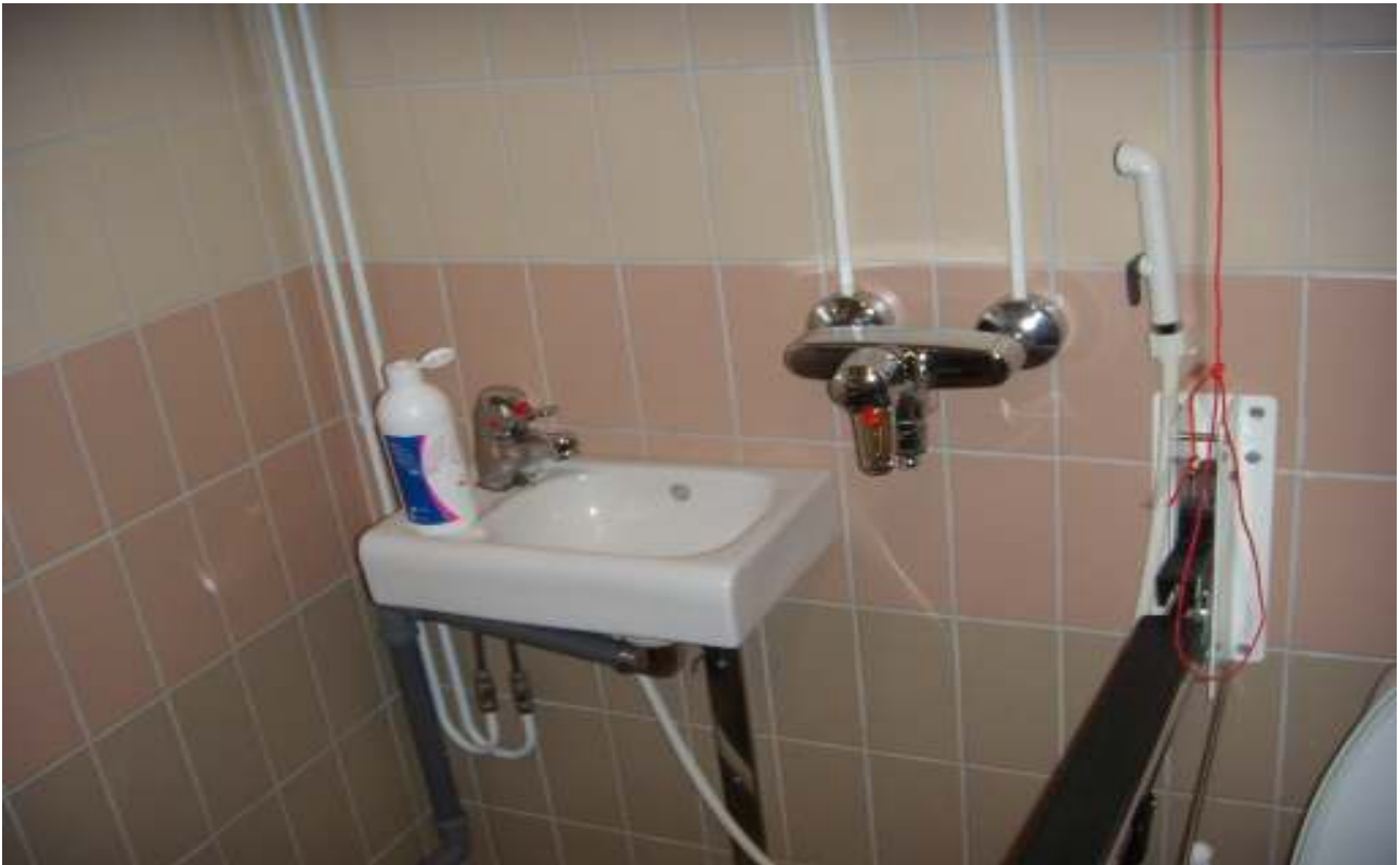
LVI-kuva 9. Yleiskuva osastojen vesikalusteista.
