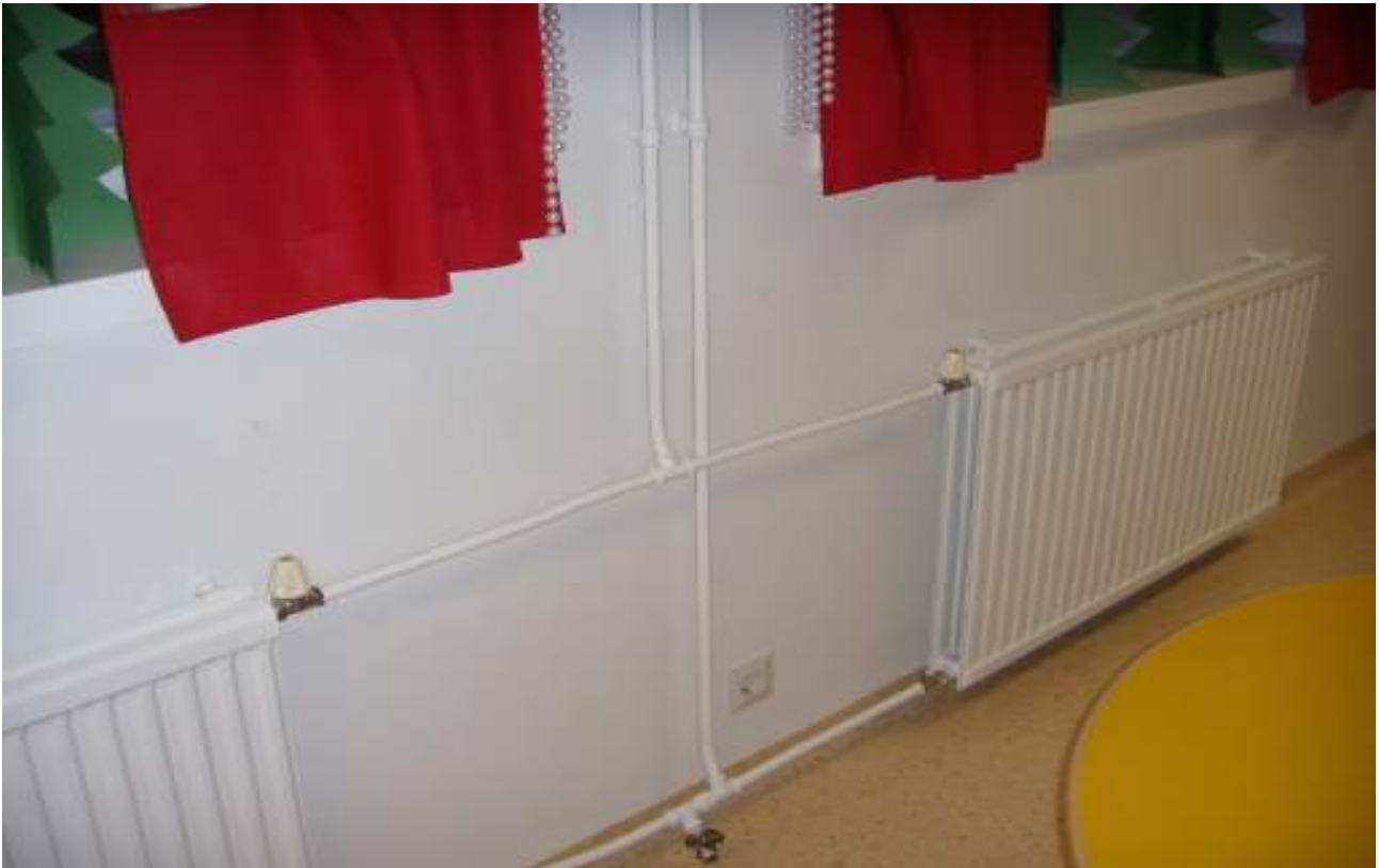
LVI-kuva 7. Yleiskuva käsisäätöisistä patteriventtiileistä.
