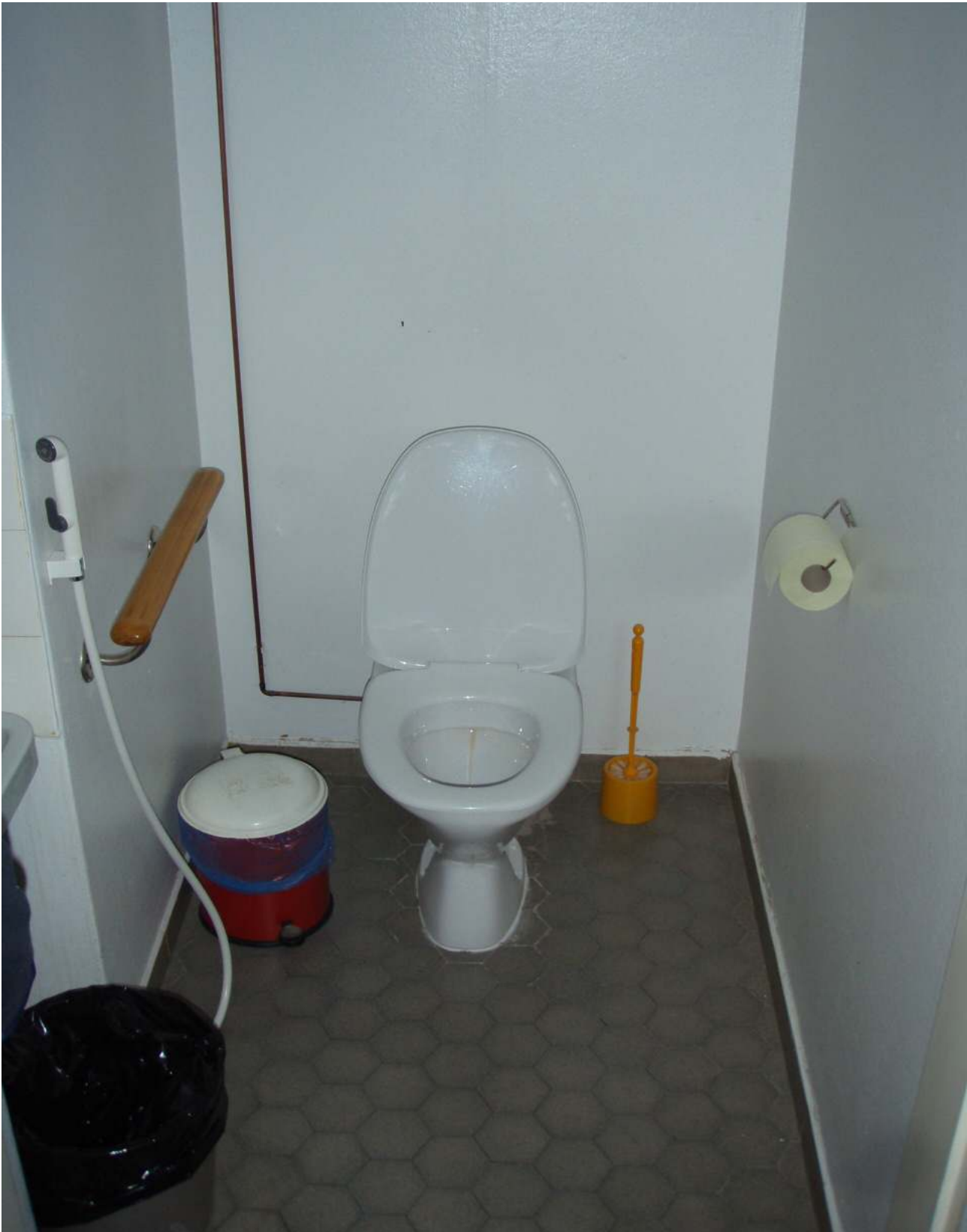
R-kuva 8. Osa wc-tilojen pintarakenteista on ikääntyneitä ja ne suositellaan kunnostamaan lähinnä esteettisistä syistä muiden tilojen saneeraustoimenpiteiden yhteydessä.
