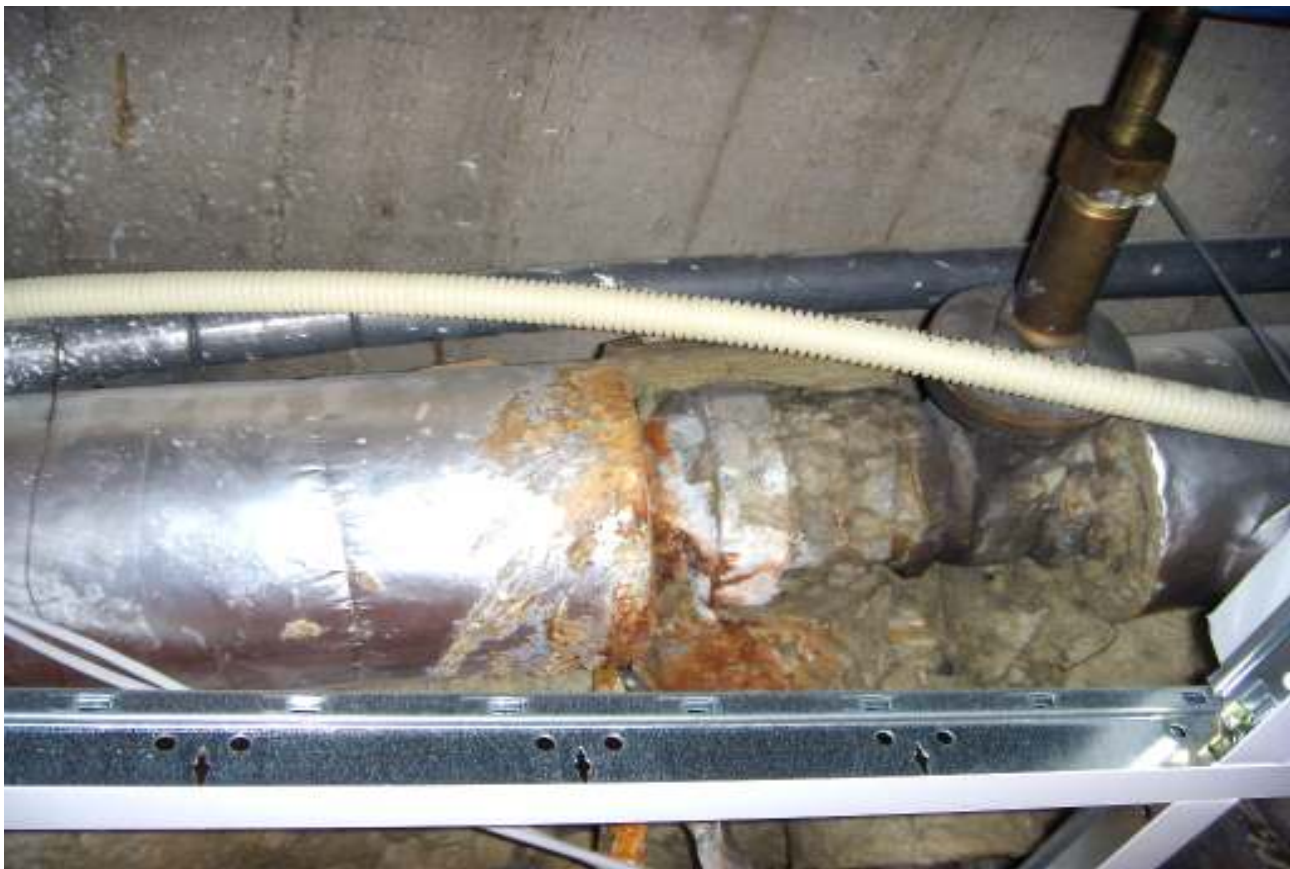
LVI-kuva 3. Yleiskuva kylmävesiverkoston vanhasta sulkuventtiilistä.
