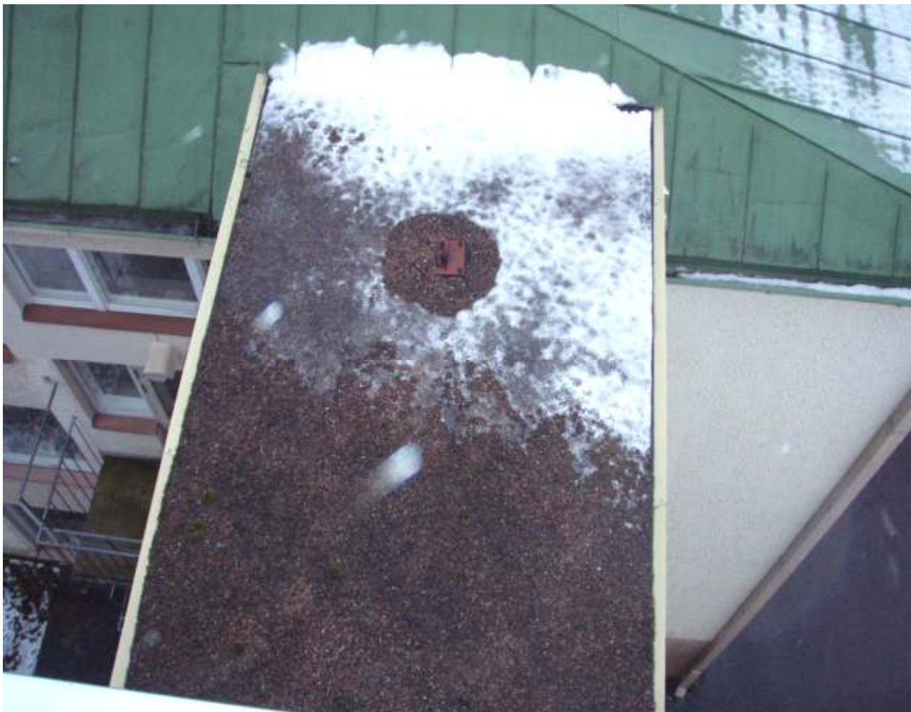
R-kuva 3. Laajennusosaan liittyvän yhdyskäytävän katossa esiintyy käyttäjien mukaisesti ajoittain vuotoja.
