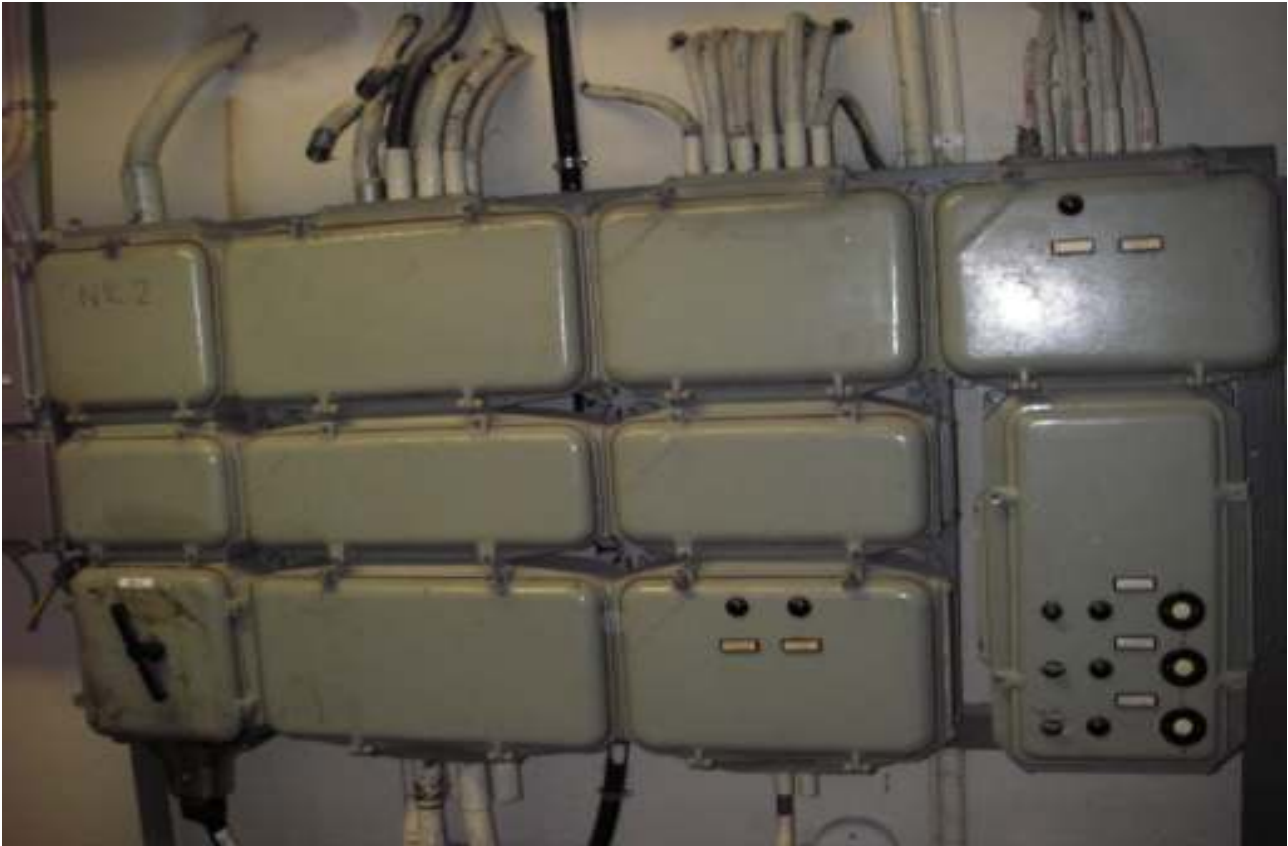
S- kuva 1. Vanha NK 2 nousukeskus pääkeskustilassa.
