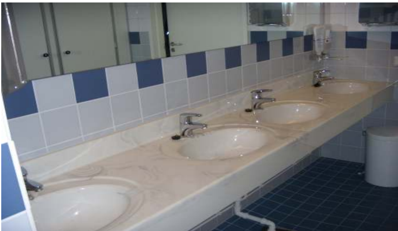
LVI-kuva 4. Yleiskuva uusituista sosiaalitalan kalusteista.
