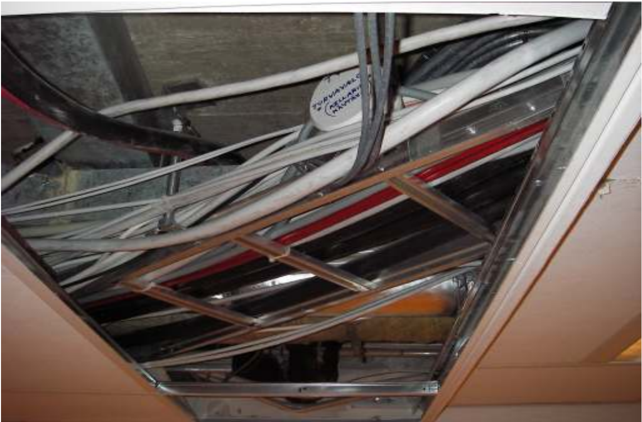
S-kuva 5. Käytävien kaapelointireiteillä on kaapeleita runsaasti hyllyjen ulkopuolella.
