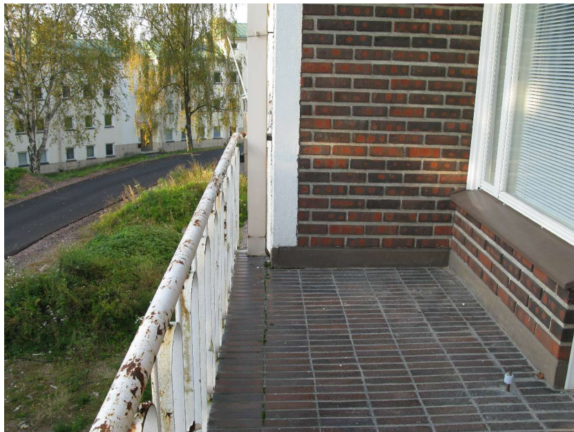
Kuva 6. Yleiskuva kaakkoissivun parvekkeesta. Parvekelaatan holkka on paikoittain lohjennut. Teräsrakenteinen parvekekaide on hiekkapuhalluksen ja uusintamaalauksen tarpeessa. Parvekkeen etureunan palkkia on huoltohenkilöstön mukaan korjattu muutamavuosi sitten, kun pakkasvauriot aiheuttivat isoja lohkeamia siihen.
