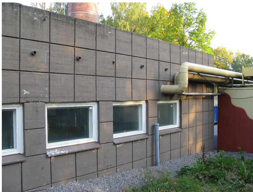
Kuva 3. Kaakkoissivun matalaosa, betonisokkelissa havaittiin yksittäisiä halkeamia sekä maalipinnan hilseilyä.
