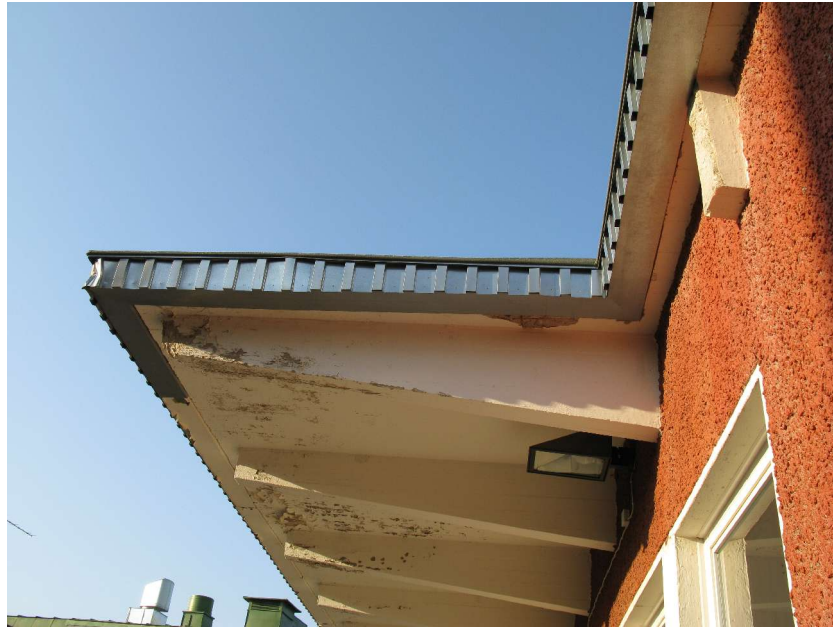
Kuva 9. Yläpihan katoksen betonirakenteet. Etummaisessa ulokepalkissa törmäysvaurio, laatan ja palkkien betonit ovat ohuthietutkimuksen mukaan läpikarbonatisoituneet sekä pahoin pakkasrapautuman vaurioittamia.
