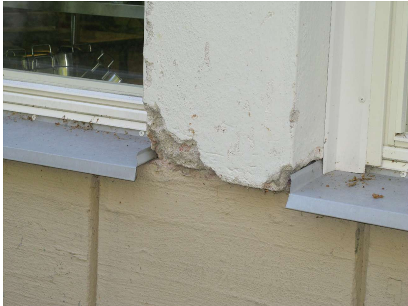
Kuva 13. Ikkunoiden vaihdon yhteydessä on vaihdettu myös ikkunapellitykset. Peltien kaatoa ei ole korjattu eikä pystypielen tiiveyteen ole puututtu. On todennäköistä että vanha ikkunapelti on ollut rappauksen sisällä ja irrottamisen yhteydessä rappaus on murtunut.
