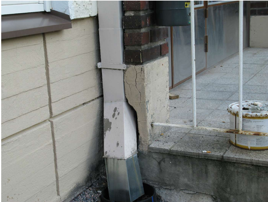
Kuva 7. Pääsisäänkäynnin syöksytorven vieressä oleva tiilipilasteri ja sen sokkeli. Sokkeli pahoin vaurioitunut.
