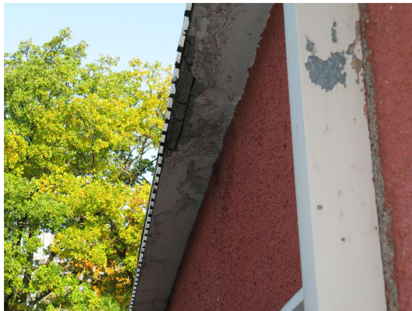
Kuva 10. Betonirakenteiset räystäät on monin paikoin pahoin rapautunut ja betonin karbonatisoitumisen vuoksi radoitteet ruostuneet. Ylläolevan kuvan kaltaisia räystäävaurioita oli rakennuksessa useita.
