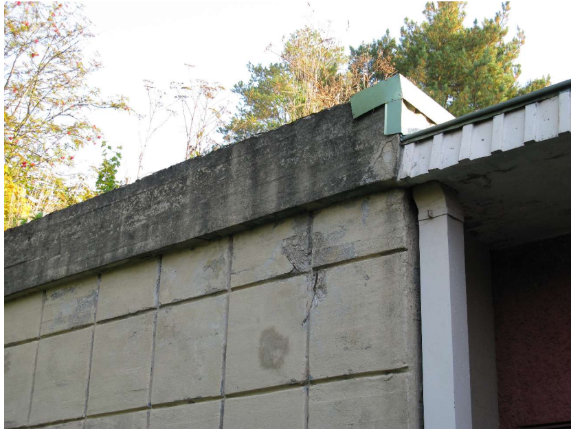
Kuva 5. Yläpihan tukimuurin ylänurkka. Kuvan mukainen vaurio on tyypillinen tälle seinälle. Tartunteräket ovat pinnassa ja betonissa pakkasrapautumisen aiheuttamia lohkeamia.
