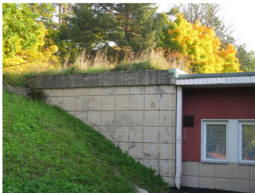
Kuva 4. Yläpihan tukimuuri. Tukimuurissa havaittavissa pakkasrapautuman aiheuttamaa betonipinnan lohkeilua.
