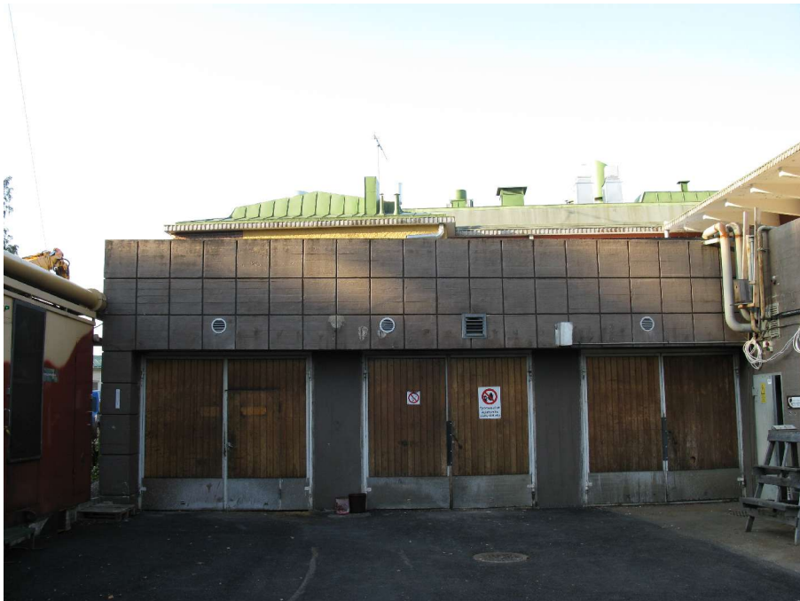
Kuva 8. Julkisivu koilliseen, matalanosan betonipintaisessa julkisivussa betonin karbonatisoitumisesta johtuvaa raudoitteiden ruostumista.
