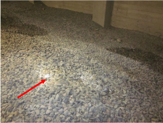
Kuva 5 Sepelin pinnalla kellertävä huntu/ kidekerros.
