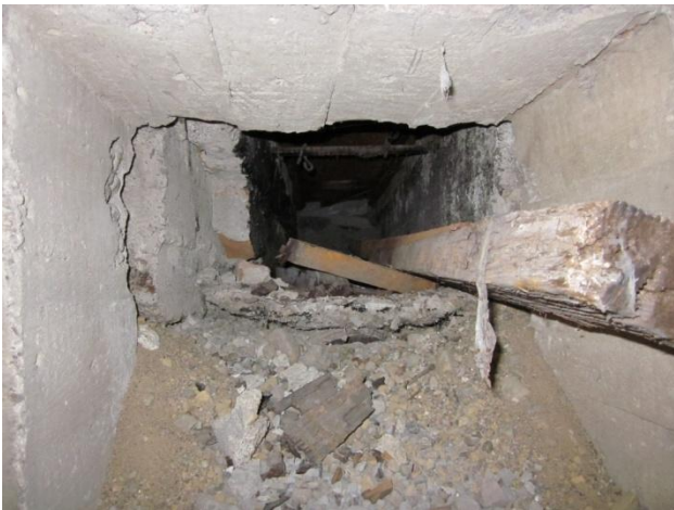
Kuva 14 Talonmiehen varaston kohdalla onkalo, jonne jätetty laudan puutavaran kappaleita.
