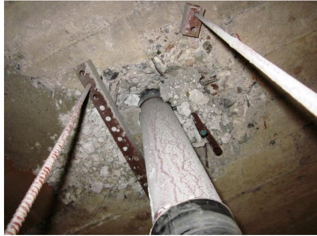
Kuva 9 Myöskään kaikkia käytössä olevien viemäreiden läpivientejä ei ole tiivistetty.
