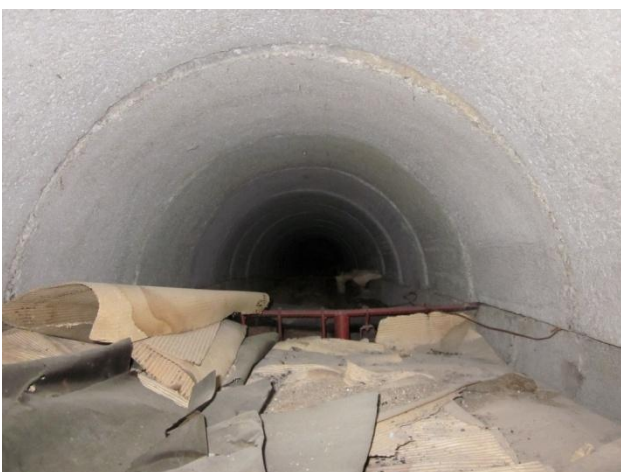
Kuva 16 Tuulikaapin kohdalta putkikanaali. Pahveissa on kosteusjälkiä.
