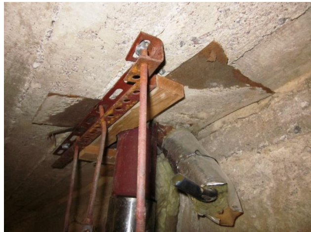
Kuva 11 Läpiviennissä on kosteusvaurioitunutta puukuitulevyä.
