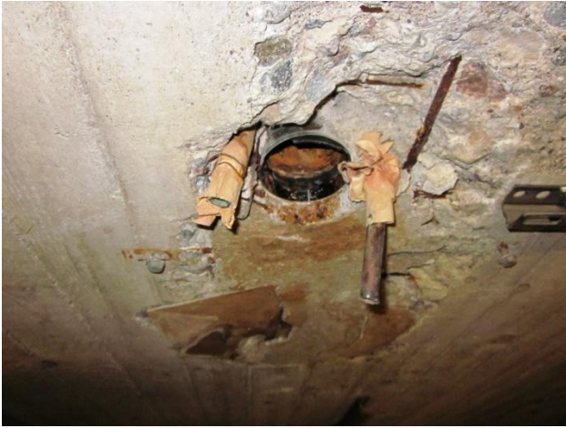
Kuva 8 Käytöstä poistettuja tiivistämättömiä läpivientejä. Lisäksi on kosteusvaurioitunutta puukuitulevyä.
