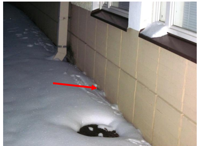
Kuva 7 Tuuletusputki on vaarassa peittyä lumeen.
