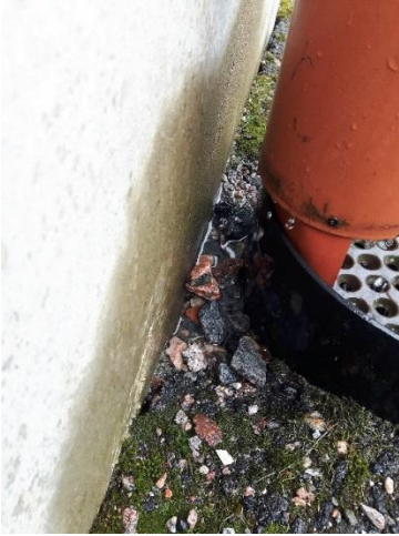
Kuva 1. Sadevesikouru valuttaa vettä ulkoseinän viereen.
