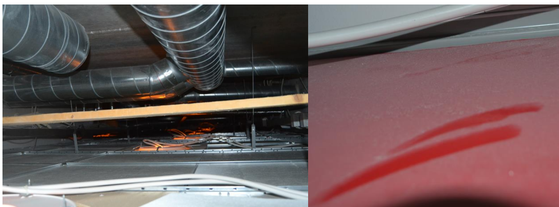
Kuva 14. AB-solussa (päiväkoti) alaslaskettujen kattojen yläpuolella ilmanvaihtoputkien päällä pölyä. Väestönsuojan (sosiaalitila) alaslasketun katon yläpuolella runsaasti pölyä (oikealla).
