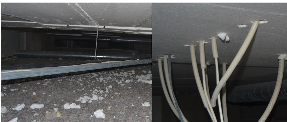
Kuva 5. FG-solun alapohjatilassa oli jonkin verran ei orgaanista rakennusjätettä. Suhteellinen kosteus ja lämpötila normaalit (RH 52,2 %, 16,6°C). Läpiviennit (sähkö/viemäriputket) oli pääosin tiivistämättä.
