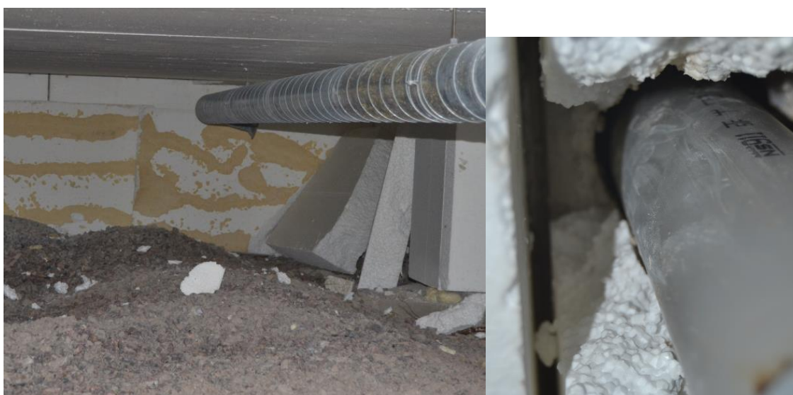
Kuva 3. D-solu läpivientejä ei ollut tiivistetty. Muutama EPS-levy oli irronnut ontelolaatasta. Ilman suhteellinen kosteus ja lämpötila oli normaali (RH 52,9 %, 17,0°C)
