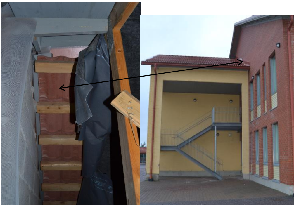
Kuva 22. E- ja F-solussa aluskate osittain irti kohdasta, joka portaikon katoksen kohdalla. Mahdollinen vesivuoto kohdassa ei ulotu sisäpuolisiin rakenteisiin.
