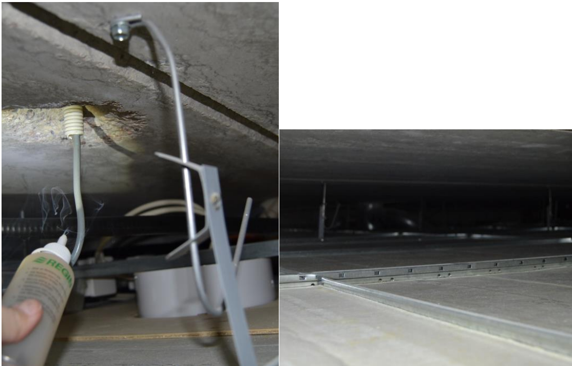
Kuva 16. Aulatiloiissa alaslaskettujen kattojen yläpuoli siisti. Kaikki yläpohjan läpiviennit oli tiivistämättömiä. Merkkikaasu ei liikkunut läpiviennistä kumpaankaan suuntaan eli rakenteista ei havaittu ilmavuotoja.
