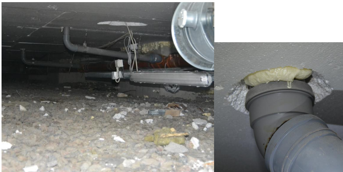
Kuva 2. C-solun alapohjatilassa ilman suhteellinen kosteus alhainen (RH 26,2 %, 17,6°C). Viemäri läpiviennit oli tilassa tiivistetty polyuretaanivaahdolla.
