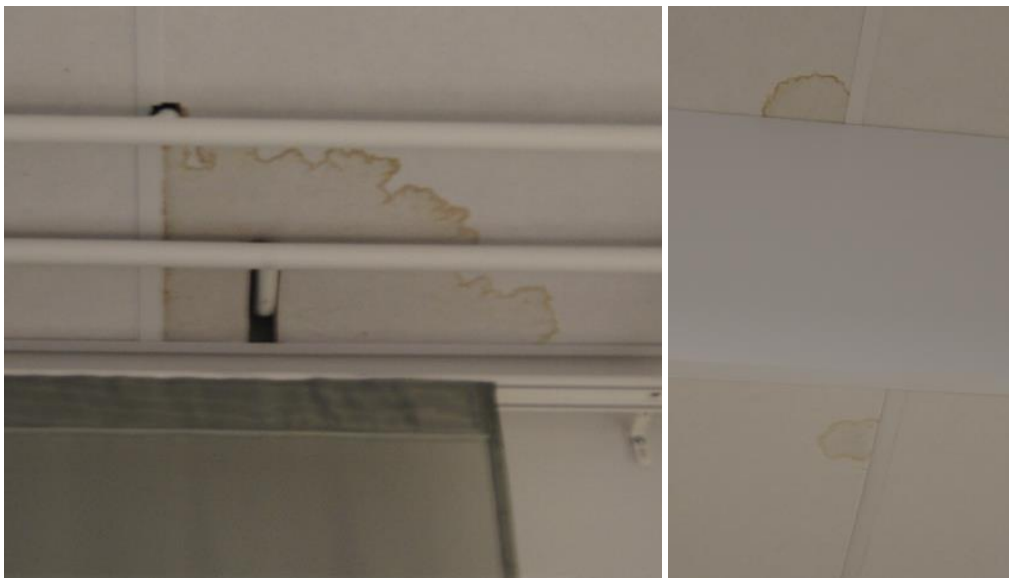
Kuva 18. E-solun luokassa 1212 havaittiin katon akustolevyissä vanhoja kosteuden aiheuttamia jälkiä. Ko. luokan yläpuolella on luokka 2106, jossa oli muutamia vuosia sitten tapahtunut tulipalo. On mahdollista, että jäljet ovat syntyneet sammutusvesien valumisesta välipohjarakenteeseen.
