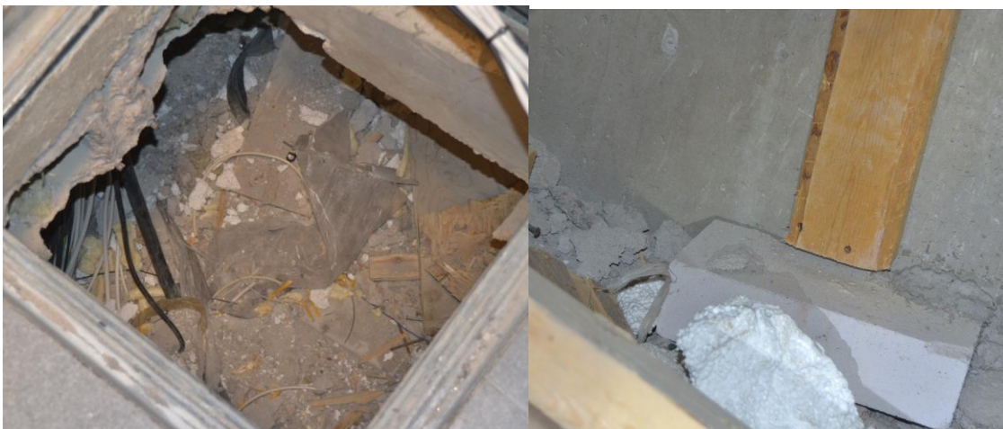
Kuva 6. H-solun ryömintätilassa oli runsaasti rakennusjätettä. Läpivientejä ei ollut tiivistetty. Merkkejä kosteudesta ei pinnoilla havaittu (RH 40,4 %, 18,5°C), mutta tilassa havaittiin ummehtunut haju.
