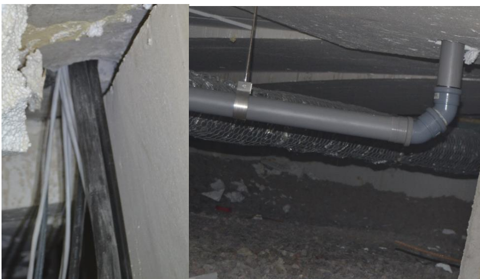
Kuva 7. I-solun alapohjatilassa ei havaittu merkkejä kosteudesta. Läpivientejä ei ollut tiivistetty.
