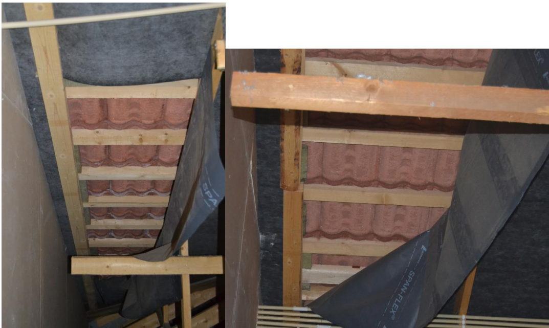
Kuva 21. AB- (päiväkoti, vasen kuva) ja E-solussa (oikea kuva) aluskate irronnut kattokannattimien päältä. Vieressä ilmanvaihtokonehuoneen seinä (US3).
