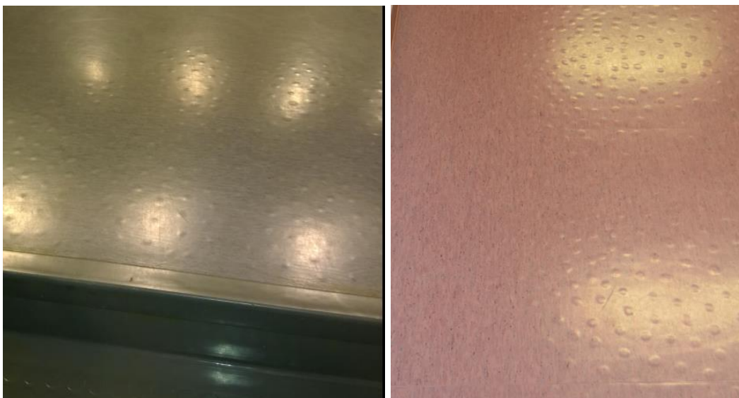
Kuva 8. Lattiapinnoitteissa havaittiin paikoin kupruilua. Vasen kuva 2. kerroksen aulasta, oikea kuva 1. kerroksen I-solun käytävältä (VSS, AP3).
