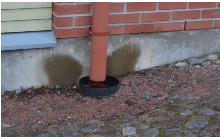
Kuva 11. Maanpinta oli pääsääntöisesti muotoiltu pois päin rakennuksesta. F-solun Tilkuntien puoleisella seinustalla nupulakiveys kaatoi lievästi ulkoseinään päin. Sokkelissa kosteuden aiheuttamia jälkiä.
