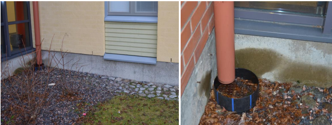
Kuva 10. Sisäpihoilla siipien yhtymäkohdissa sekä I-solun vierustalla on istutuksia. Rakennuksen vierustoilla on näillä kohdoin vajaan metrin levyinen sepeli. Useiden syöksytörvien vierustoilla oli nähtävissä sokkelissa kosteuden aiheuttamia jälkiä. Vastaavilla kohdoin
