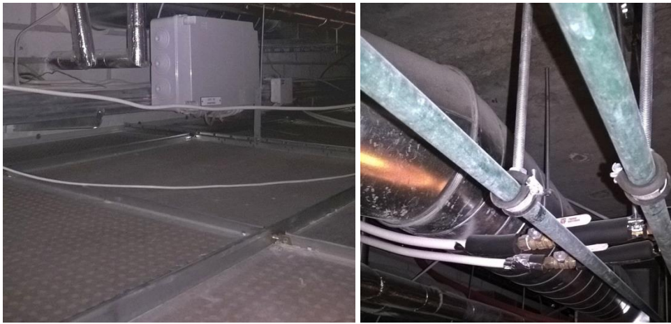
Kuva 1. D-solu 1 krs: mineraalivillalevyt poistettu, jonkin verran pölyä. IV-kanavat pölyisiä.
