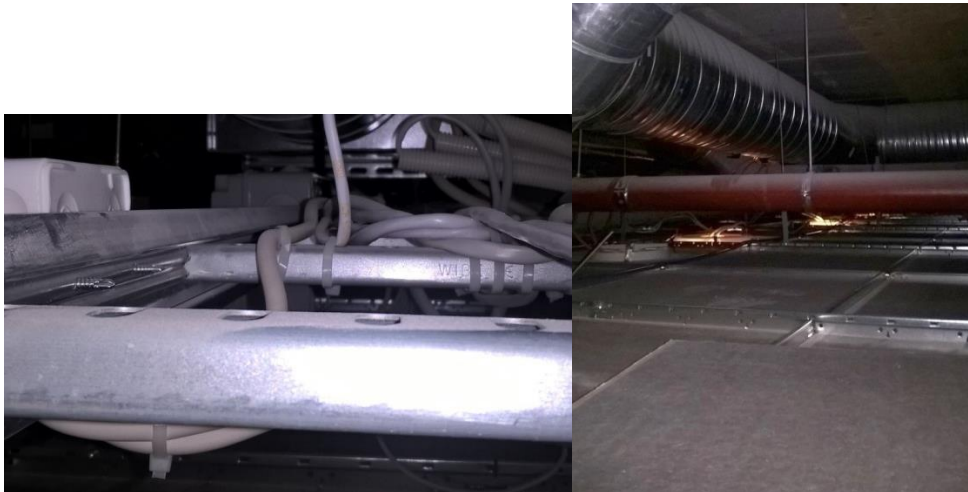
Kuva 2. E-solu 1 krs: mineraalivillalevyt poistettu, jonkin verran pölyä, osin hyvin pölyistä (pienijakoista pölyä)
