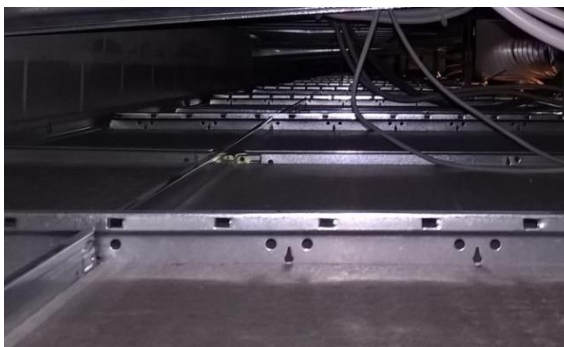
Kuva 3. F-solu 1 krs: mineraalivillalevyt poistettu, vähäinen määrä pölyä
