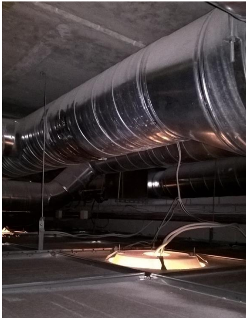
Kuva 5. E-solu 2 krs: mineraalivillalevyt poistettu, vähäinen määrä pölyä. IV-kanavat pölyiset
