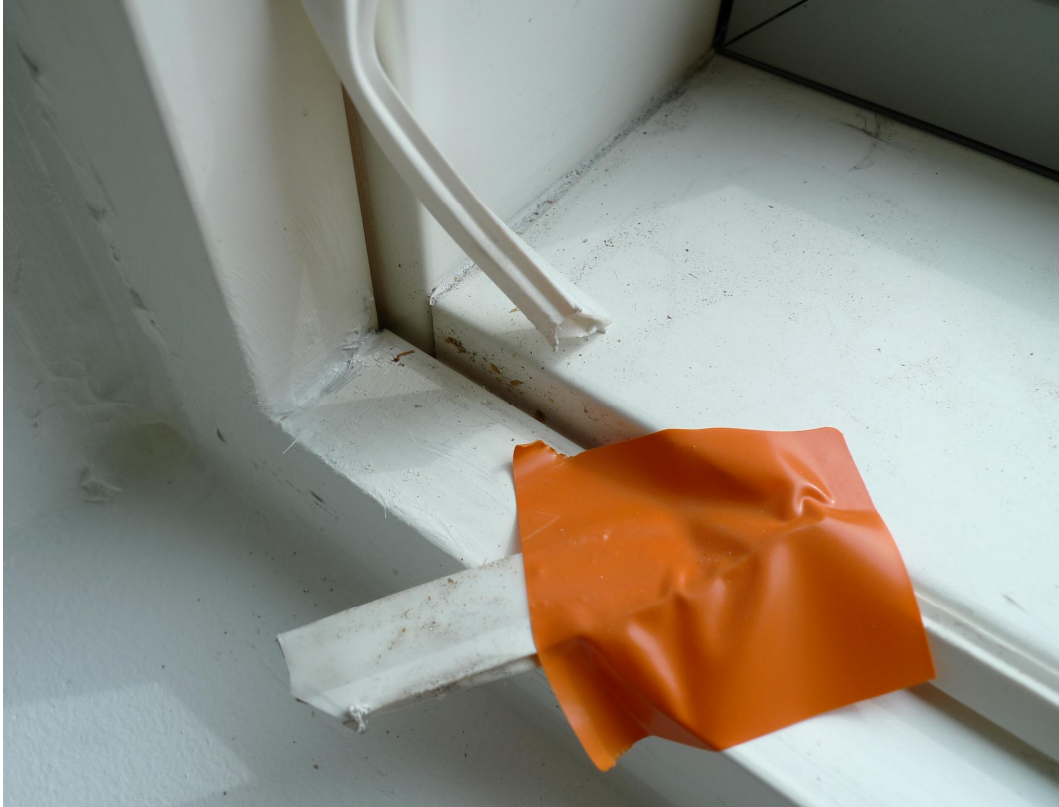
Kuva 1. Tila 1176. Ikkunan pysty- ja vaakakarmin liittymästä irrotettiin tiivisteitä, jotta Blowerproof-sively saatiin jatkettua koko salvoksen alueelle. Toimenpiteen jälkeen salvoksissa ei havaittu enää vuotoja.
