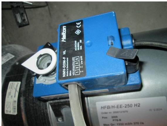
Kuva 6. Rakennuksen D-osassa sijaitseva IMS, huomaa avoimeksi jäänyt ohjelmointiliittimen suojakansi.
