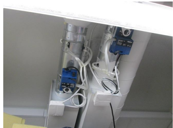
Kuva 7. Tilan 2016 tulo- ja poistokanavan IMS-yksiköt.
