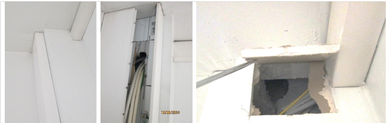
Kuvat 3 ja 4. Ilmavuotoja sähkökourun ja katon liitoskohdasta ja avoin läpivienti sähkökourusta kotelorakenteeseen.
