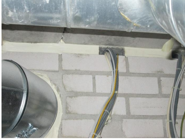
Kuva 19. Opetustilan ja käytävän välisessä seinässä avoin läpivienti alas lasketussa katossa.
