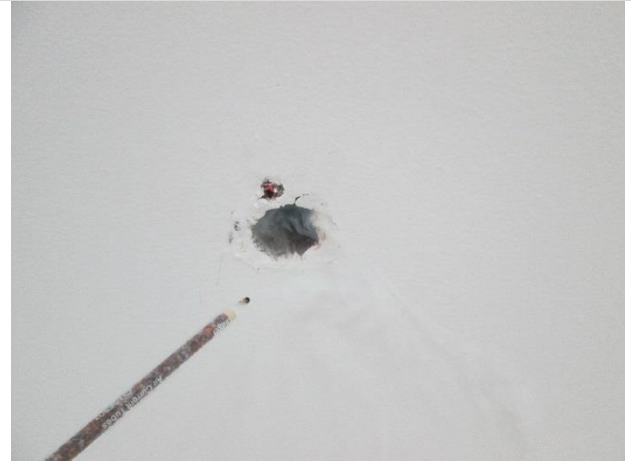
Kuva 9. Reikiä yläpohjan ontelolaatoissa, ilmapuoto opetustilaan.
