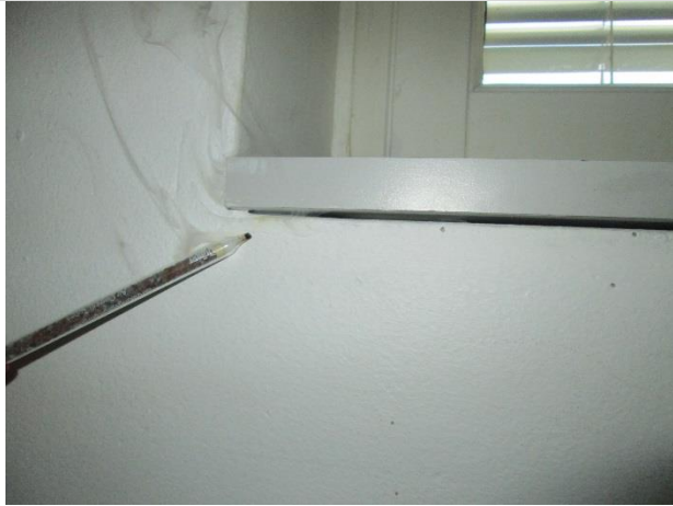
Kuva 8. Pistemäisiä ilmapuotoja ikkunapenkin ja ikkunalaudan välistä.
