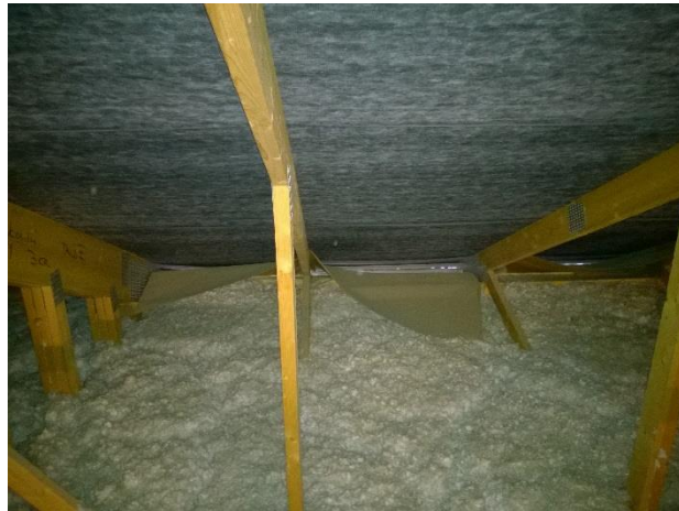
Kuvat 12 ja 13. Yleiskuva yläpohjan tuulettuvasta tilasta, räystästuuletus toimii. Tuulenojaimet ovat paikoin tippuneet
