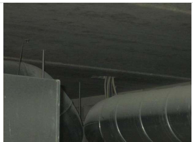
Kuva 18. IV-kanavien päällä- runsaasti pölyä. Yläpohjan ontelossa avoin sähköläpivienti.
