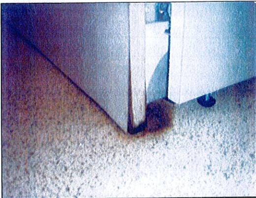
Kuva 3. Vesileikkihuoneen 1.137 kaapin alahyllyn/koroketason etulevy on kastunut.
