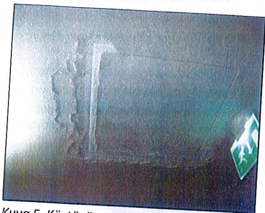
Kuva 5. Käytävän 2.085 sisäkatoissa on vaurioita.
