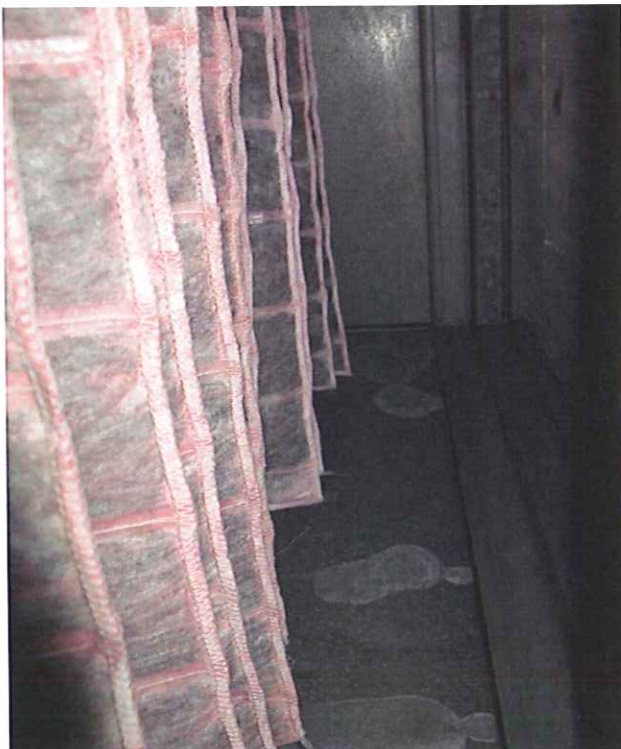
Kuva 4. Tuloilmakoneen suodattimien alapuolella on vähäisiä vesilammikoitumisen jälkiä.
