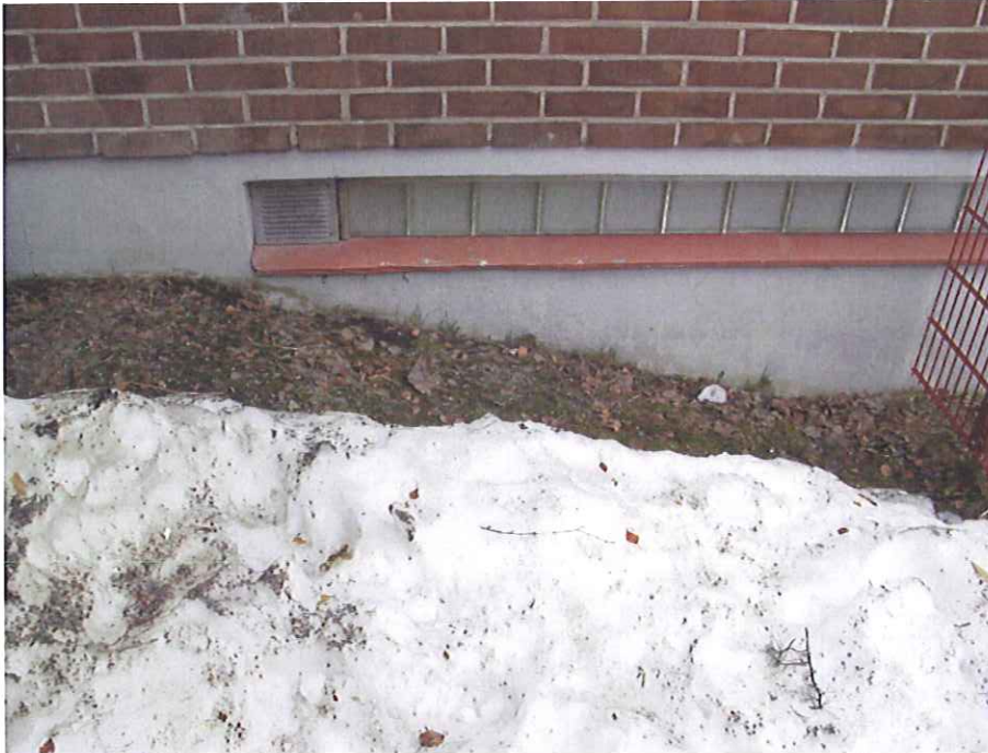
Kuva 3. Wc/kph:n (huone 116) ulkopuolella perusmuurilevyn yläreunan asennuslista puuttuu. Sisäpuolella ei havaittu normaalista poikkeavaa kosteutta.
