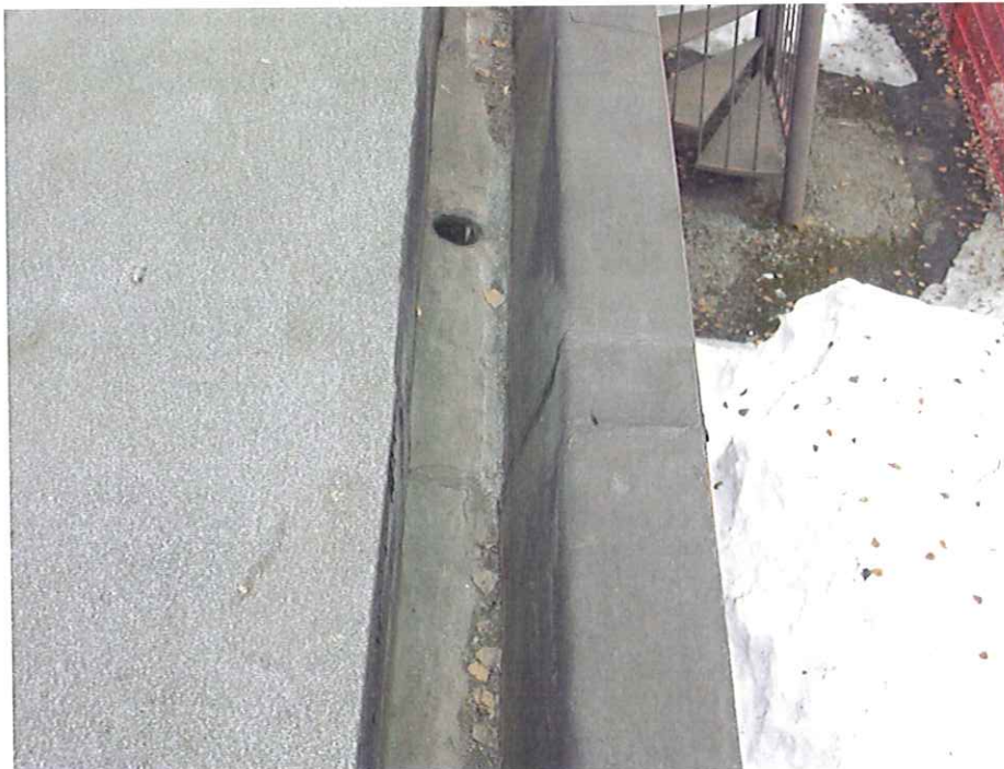
Kuva 12. Kattovesikourut on toteutettu ns. sisäpuolisena kouruna. Bitumikermillä pinnoitetun kourun liittymä syöksytorveen on altis vaurioitumaan.
