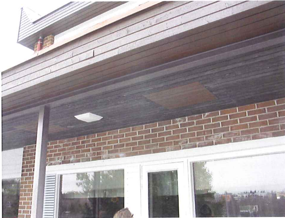
Kuva 1. Huoneen 108 ulkopuolisen tiilverhouksen kosteushärmäjälkiä. Betonisen leukapalkin maalaus on lohkeillut.
