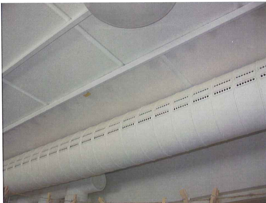
Kuva 6. Raitisilmapiutkisto puhallus on tummentanut akustovillaa.
