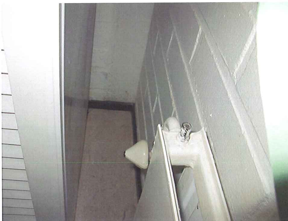
Kuva 7. Huonetilan 122 maanvastaisen seinän maalipinnoite on kupruillut vanhan nyt kuivan tiiliverhouksen pinnasta.
