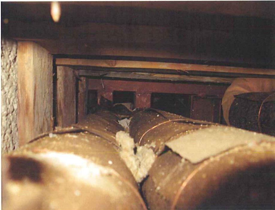
Kuva 17. Putkikanaalissa on purkamattomia puumuotteja.
