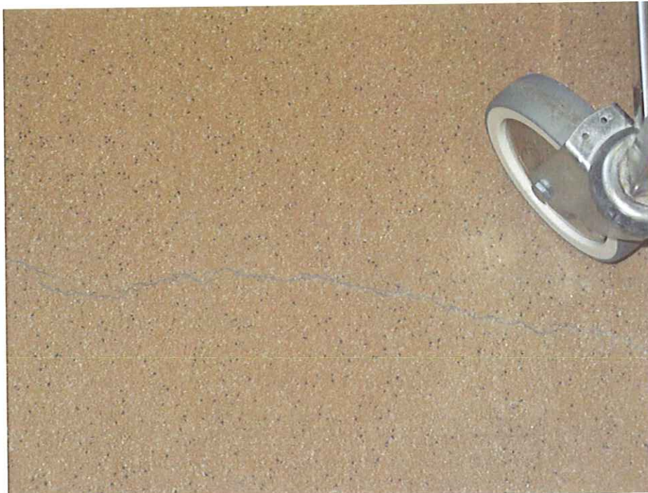
Kuva 19. Keittiötiloissa (209 ja 212) lattiapinnotteessa on joitain hiushalkeamia, mutta lattiassa ei todettu normaalista poikkeavia pintakosteusilmaisimen arvoja.
