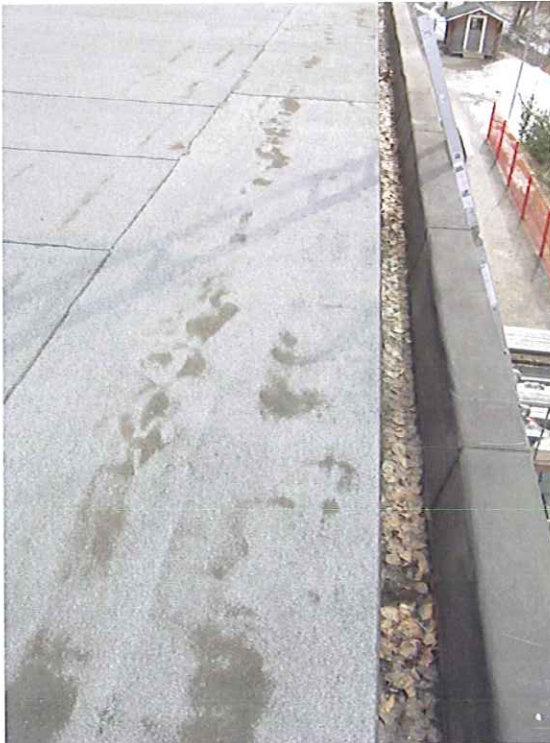
Kuva 13. Kourun kallistus on vähäinen. Puustosta kertyvä lehtimassa edellyttää aktiivista huoltoa etenkin syökytorviaukkojen ollessa melko pienet.
