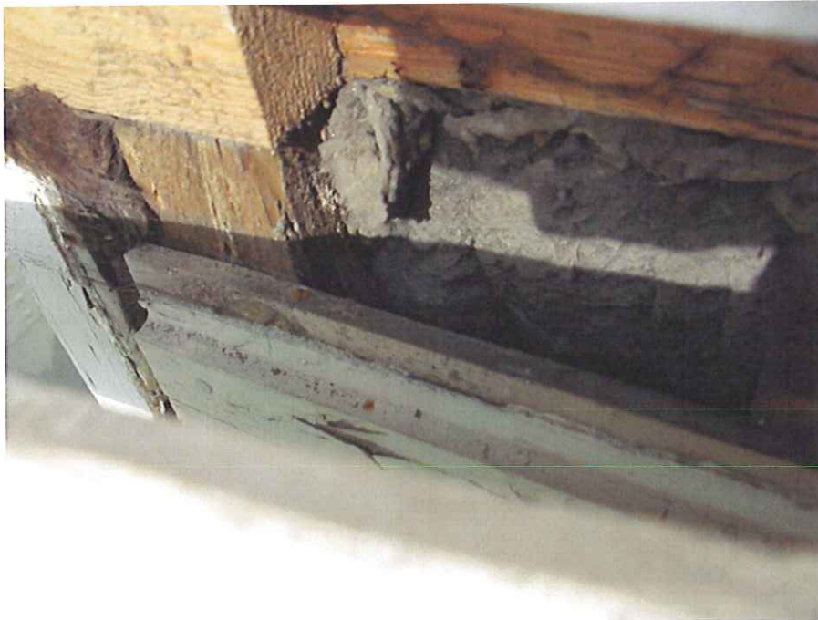
Kuva 15. Ikkunoiden tilkerive on erittäin pölyistä. Ikkunakarmin apurungon/-koolauksen puuosissa on vanhoja kuivia kosteuden aiheuttamia jälkiä.
