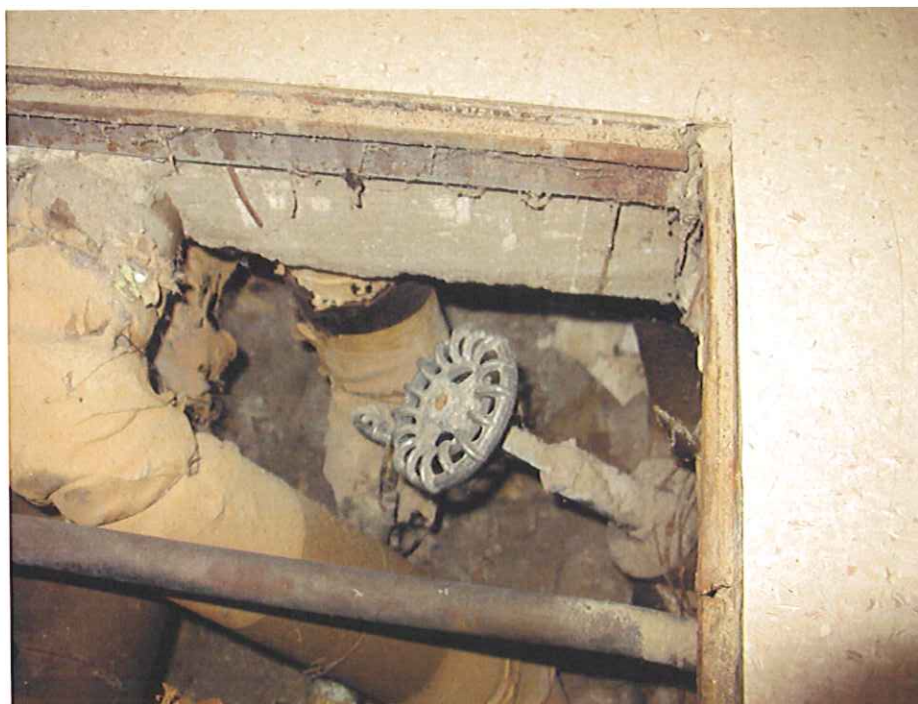
Kuva 18. Huoneen109 kohdalla putkikanaalissa on kosteustuottoa. Kanaalissa oli aistinvaraisesti arvioituna mikrobiperäinen haju.
