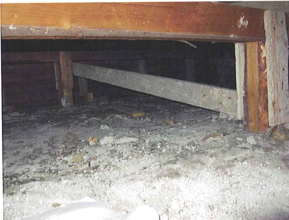
Kuva 10. Alemmassa eikä ylemmssä yläpohjatilassa ollut lisälämmöneristystä.
