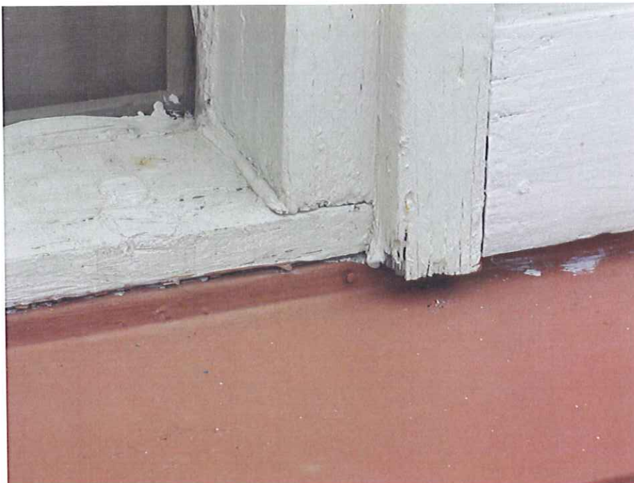
Kuva 2. Vesipelti on liitetty karmissa olevaan uraan. Naulakiinnitys on löystynyt.
