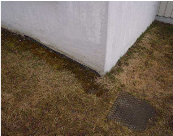
Sokkelipintaan etupuolelta, paikoin on havaittavissa musta ns. patolevy.
