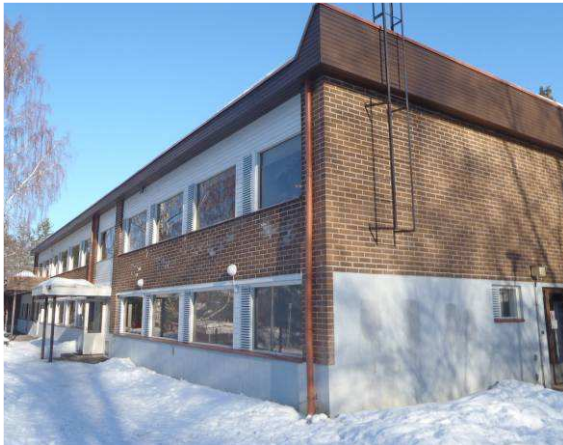
Rakennuksen takapuolella julkisivun tiilipinnoissa on havaittavissa valkoisia kalkkihärmejä jälkiä.
