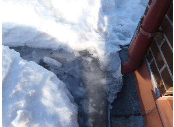
Kuvaa vesikatolle muodostuneesta jäätä rännin kohdalle.
