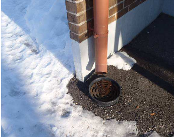
Sadevedet johdetaan katolta rännejä pitkin sadevesijärjestelmiin.
