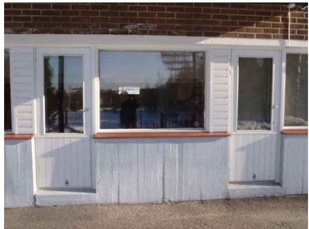
Puuovet vaikuttivat vielä toimivilta. Niiden uusimista suositellaan ikkunoiden uusimisen yhteydessä.
