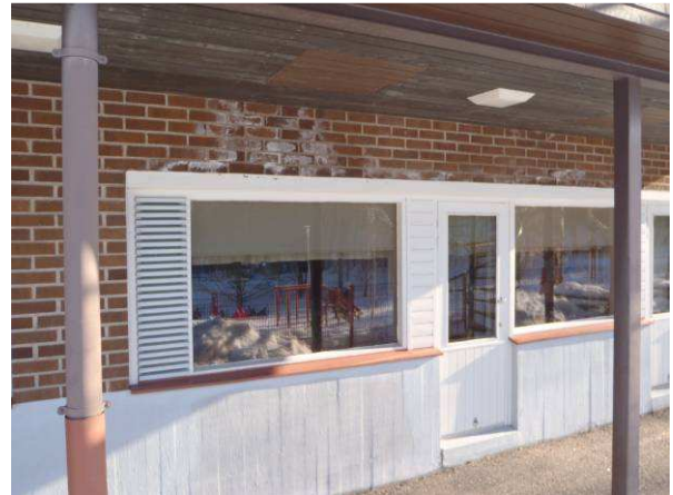
Ikkunan päällä seinässä aiemmin olleen vesivuodon aiheuttamia jälkiä.
