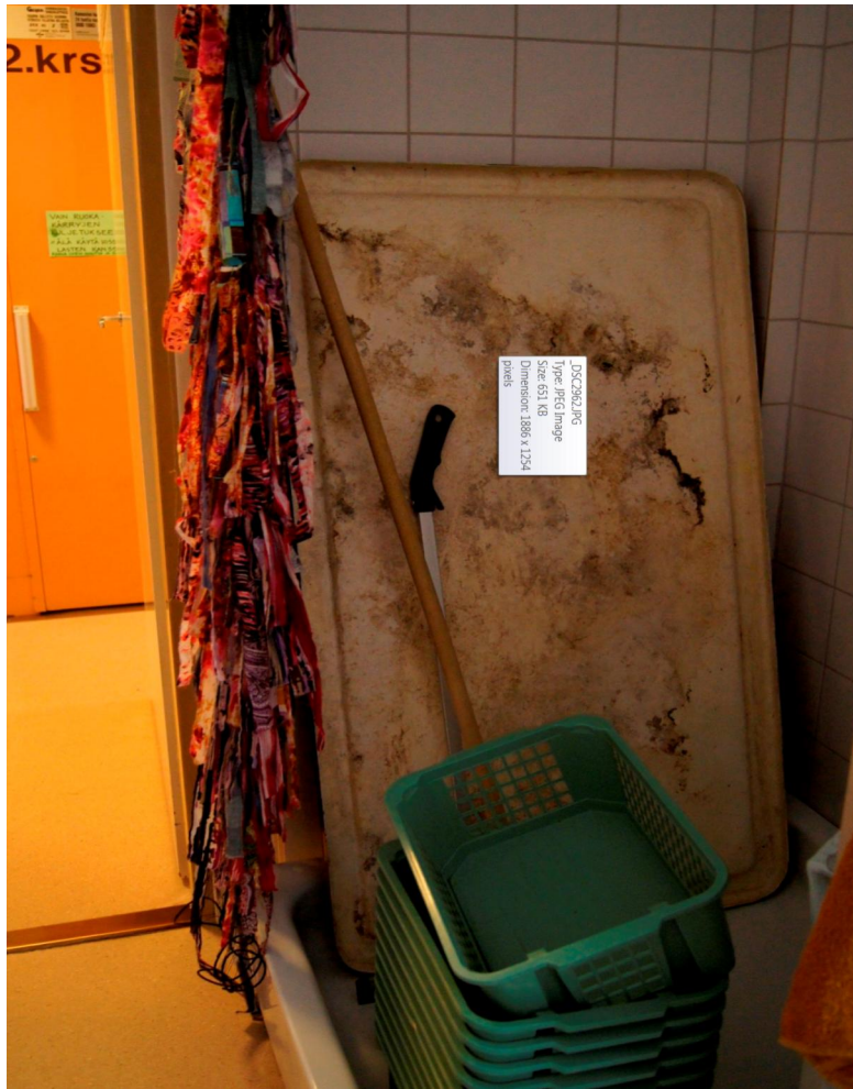
Kuva 2962. Päiväkodin sisätiloissa säilytetään mikrobivaurioituneita tavaroita, joista voi päästä epäpuhtauksia sisäilmaan.
