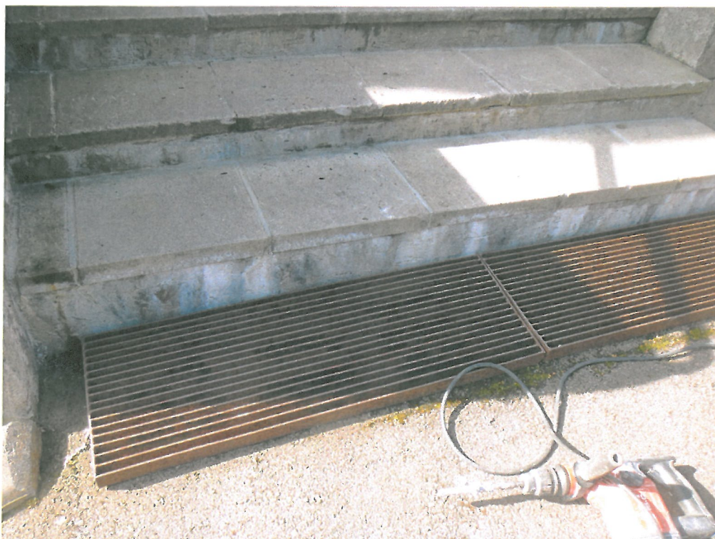
Kuva 7. Pohjoispäädyn porras. Pystypinnoissa on näkyvissä kalkkisuotaumaa
