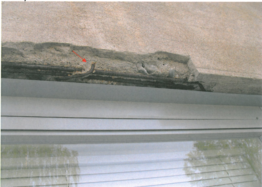
Kuva 4. Ikkunan ylityspalkin alapinnasta ja sivulta on irronnut terästen betonipeite. Terästen pinta ruosteessa.
