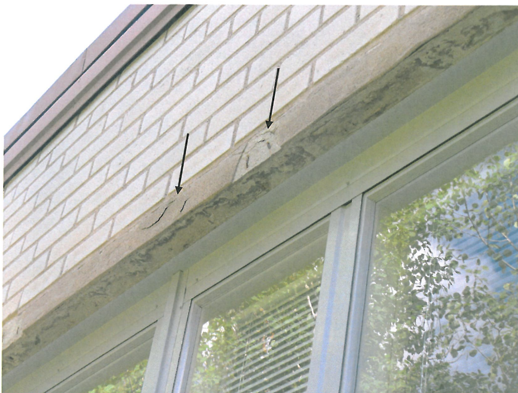
Kuva 5. Ikkunan ylityspalkeissa on selvästi näkyvissä alkanut terästen korroosio.
