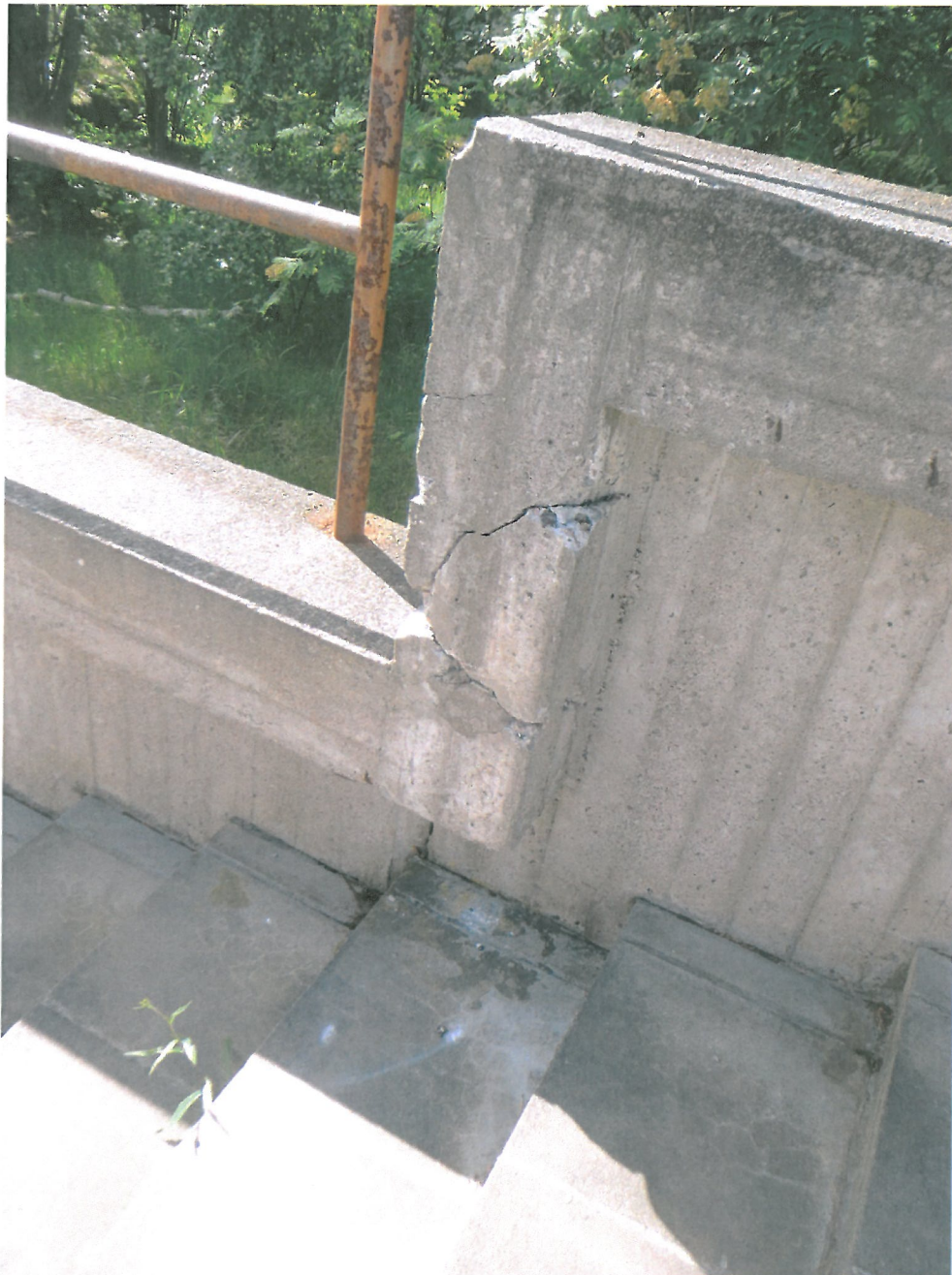
Kuva 10. Porraskaiteen levennyksestä murtuma. Rakenteen raudoitus pitää palan paikoillaan.
