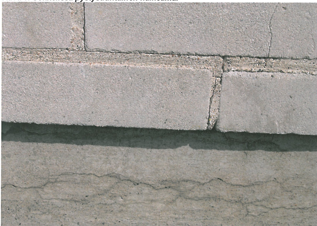
Kuva 2. Sokkelissa vaakasuuntaista ja verkkomaista halkeilua, pakkasrapautumaa. Tiilien saumauksessa halkeamia.
