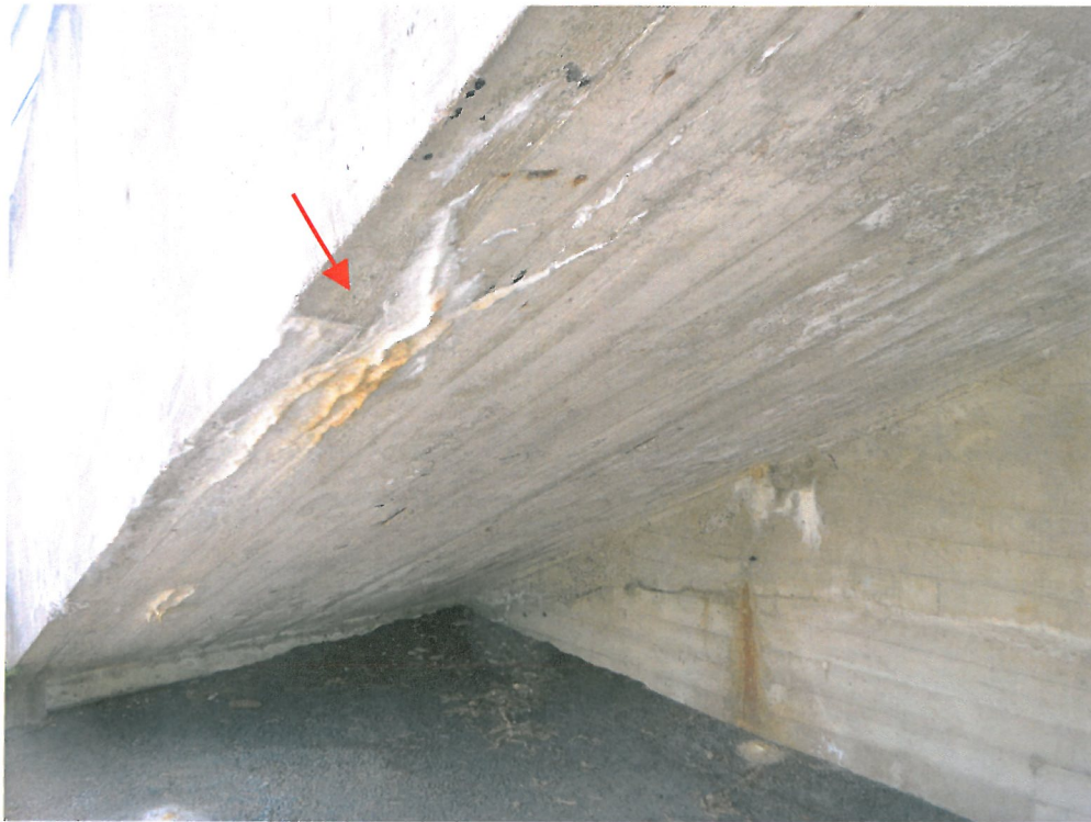
Kuva 18. Itäsiipeen johtavien betoniportaiden alapinnassa on näkyvissä kalkisuotaumaa.
