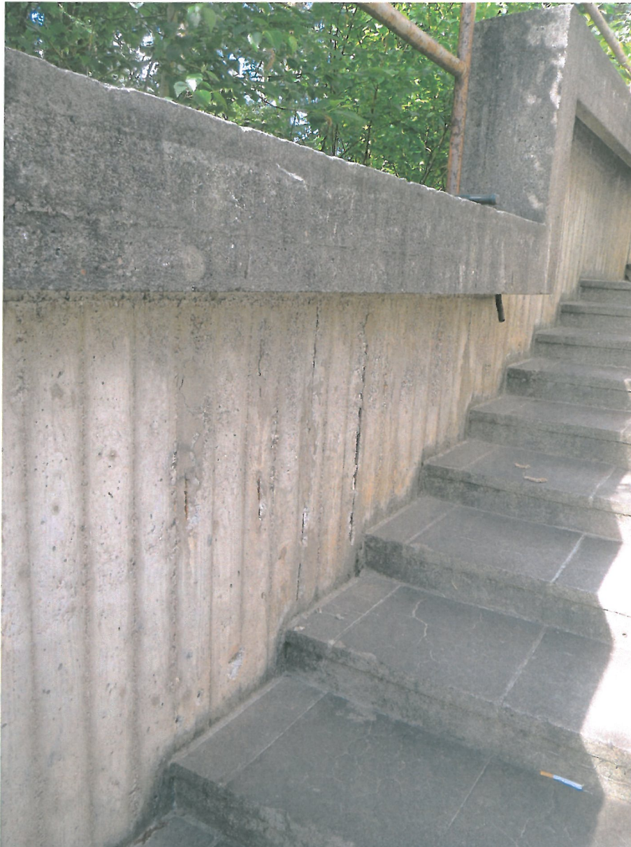
Kuva 9. Porraskaiteessa näkyvissä terästen korroosio. Betonisen kaiteen päällä lisäksi metallikaide, joka on myös ruostunut.
