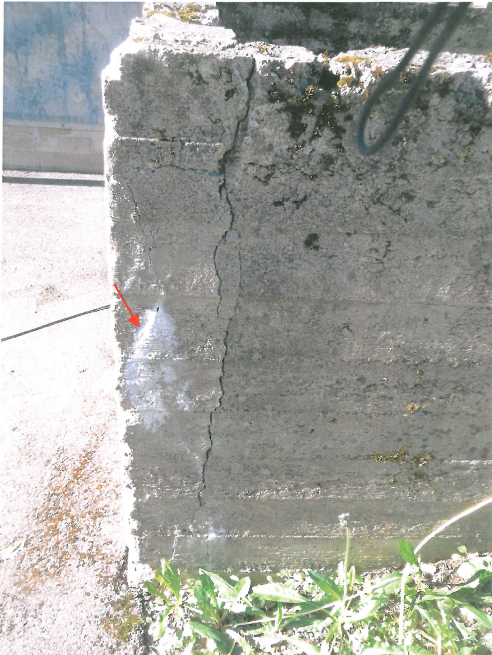
Kuva 15. Pohjoispäädyn tukimuurirakenteen kulmassa suuri halkeama ja kalkkisuotaamaa.
