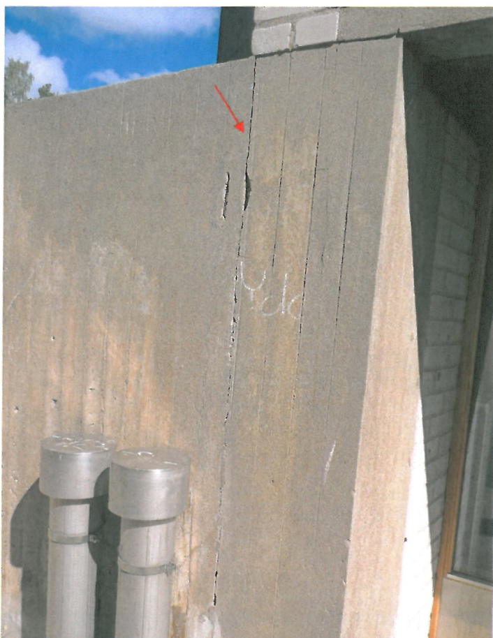
Kuva 13. Eteläpäädyn sisäpihan tukimuri. Rakennuksen ulkoseinän ja tukimuurin rajassa kulkee halkeama.
