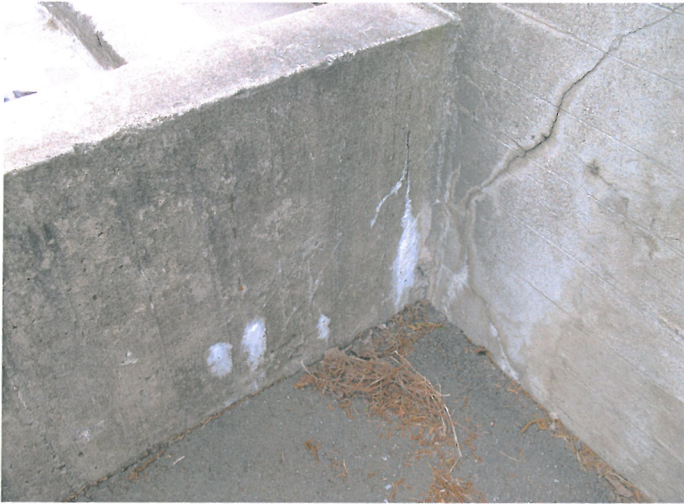
Kuva 11. Sokkelin ja portaan reunuksen liittymiskohta. Sokkelissa näkyvissä halkeama ja portaan reunuksessa kalkkisuotaamaa.
