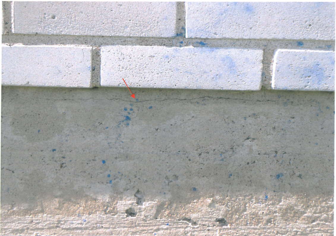
Kuva 3. Sokkelin yläreunassa kulkeva vaakasuuntainen halkeama. Eteläpään sisäpiha, länsisiipi.
