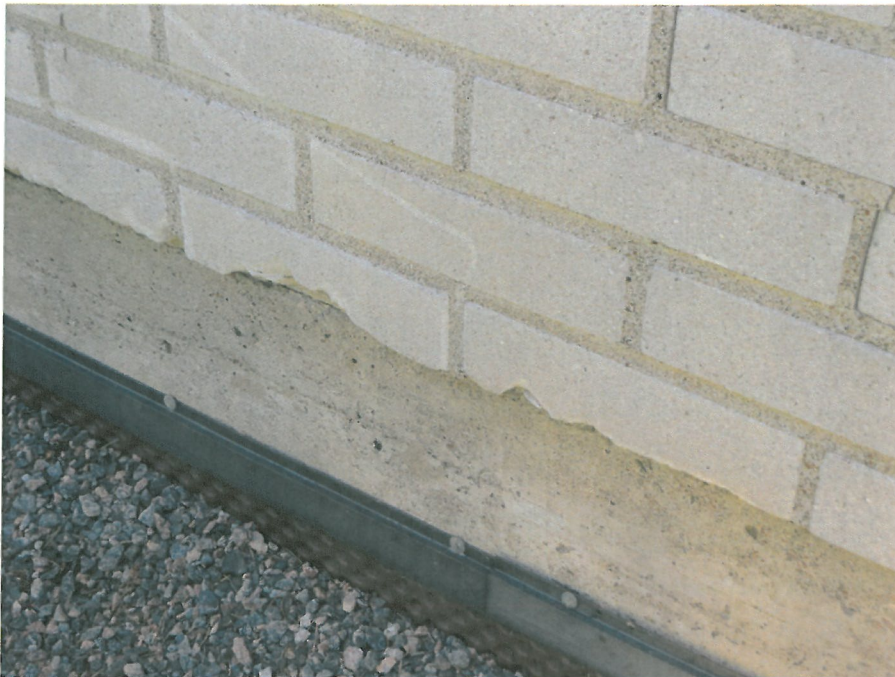
Kuva 16. Tiilien alareunat kuluneet.
