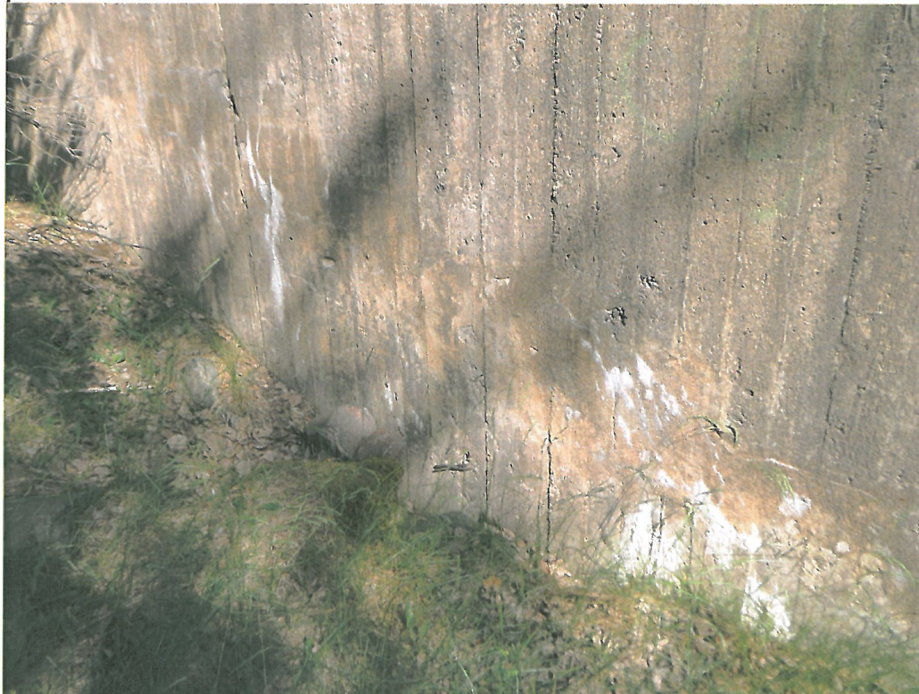
Kuva 12. Eteläpäädyn porraskaide metsän puolelta. Maanrajassa näkyvissä kalkkisuotaamaa.
