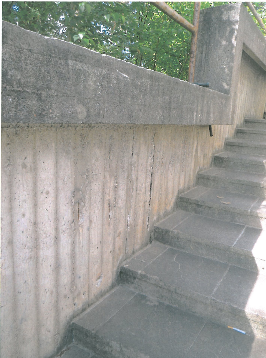
Kuva 9. Porraskaiteessa näkyvissä terästen korroosio. Betonisen kaiteen päällä lisäksi metallikaide, joka on myös ruostunut.
