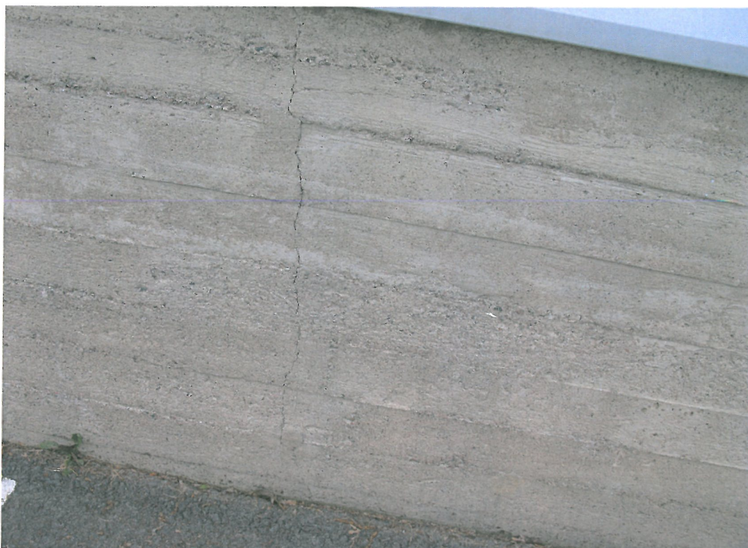
Kuva 1. Sokkelissa pystysuuntainen halkeama.
