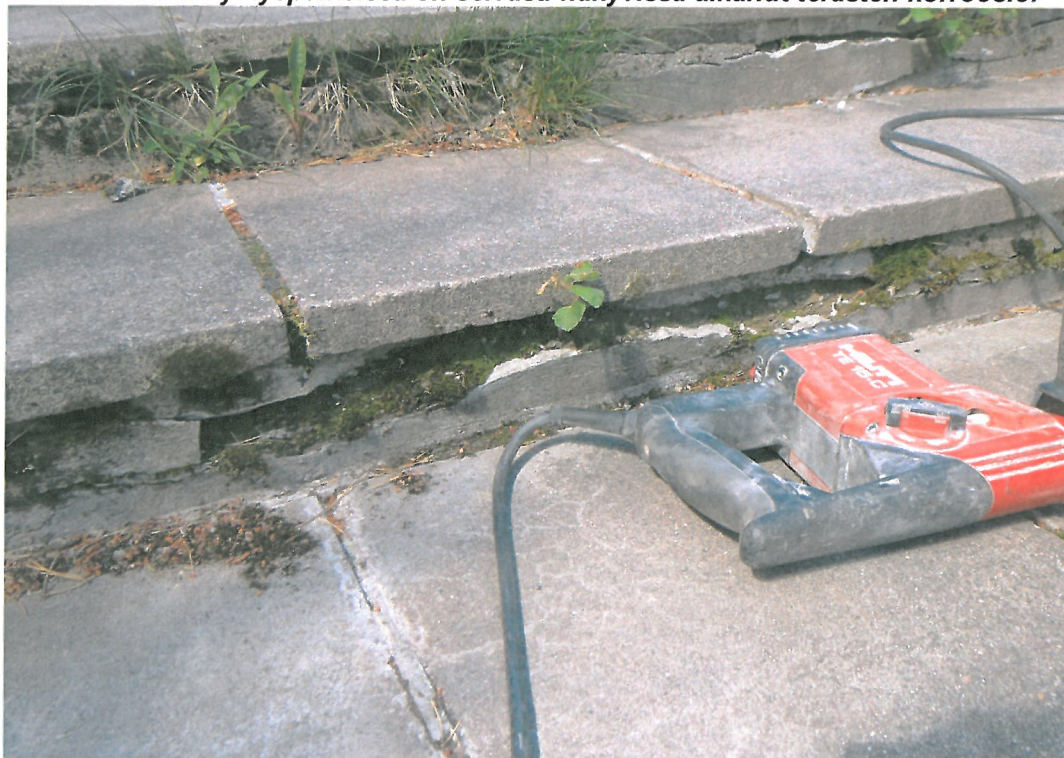
Kuva 6. Eteläpäädyn portaiden pystypinnat ovat pahasti murtuneet ja murtumakohtissa kasvaa kasvillisuutta.
