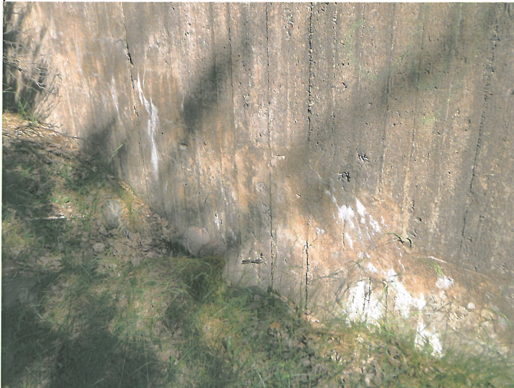
Kuva 12. Eteläpäädyn porraskaide metsän puolelta. Maanrajassa näkyvissä kalkkisuotaamaa.
