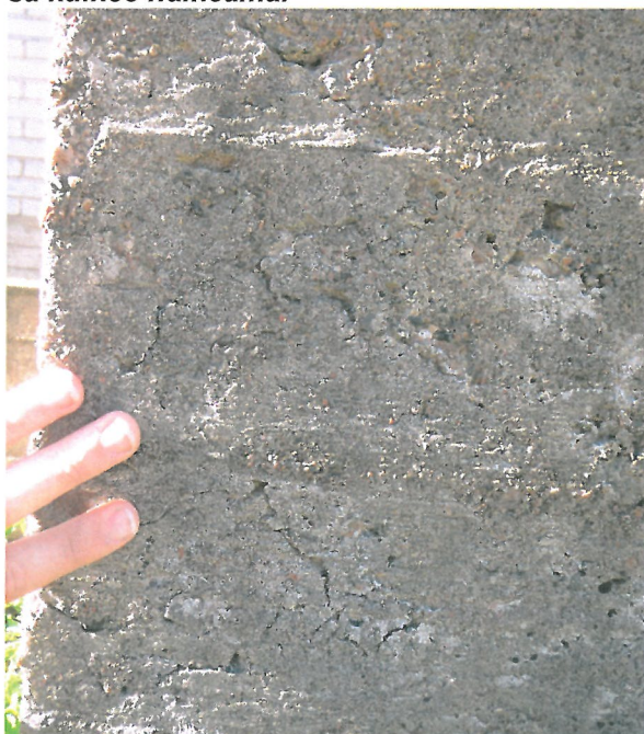
Kuva 14. Pohjoispäädyn tukimuurirakenteiden pinta on rosainen ja siinä on halkeamia.
