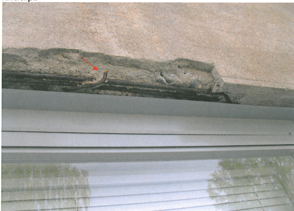
Kuva 4. Ikkunan ylityspalkin alapinnasta ja sivulta on irronnut terästen betonipeite. Terästen pinta ruosteessa.
