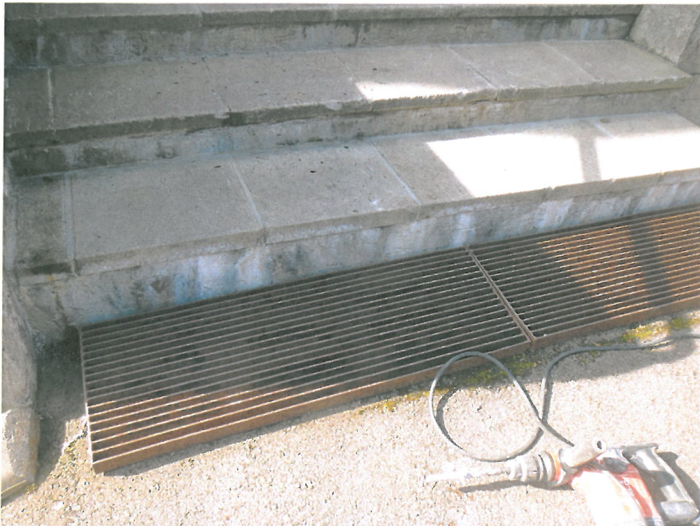
Kuva 7. Pohjoispäädyn porras. Pystypinnoissa on näkyvissä kalkkisuotaumaa
