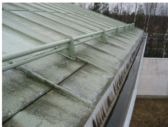
Kuva 8 Rästäskouru on hieman ruosteessa.
