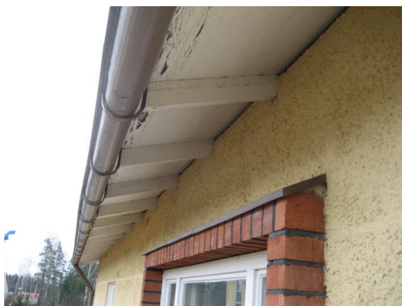
Kuva 7 Rästään reunalla on maali irti.
