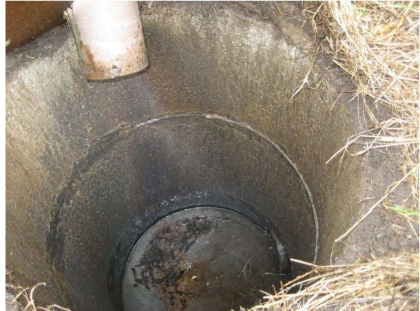
Kuva 4 Rännikaivossa on lietepesä lähes täynnä.
