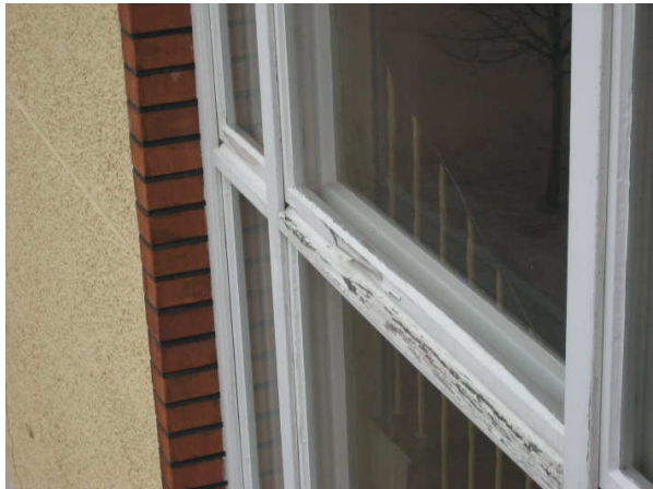
Kuva 6 Porrashuoneen alkuperäisen ikkunan maali on lohkeillut.
