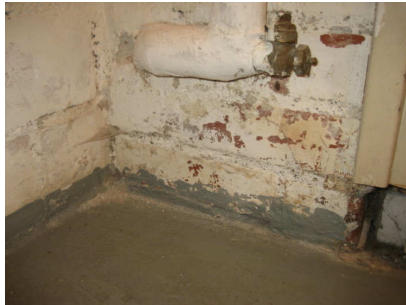
Kuva 16 Maanpaineulkoseinän ja väliseinän liittymässä on vesivauriojälkiä.
