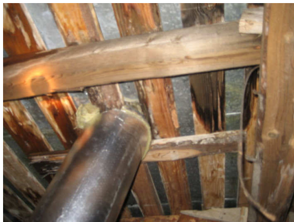
Kuva 11 Putkiläpiviennin kohdalla olevat ruodelaudat ovat märkiä .
