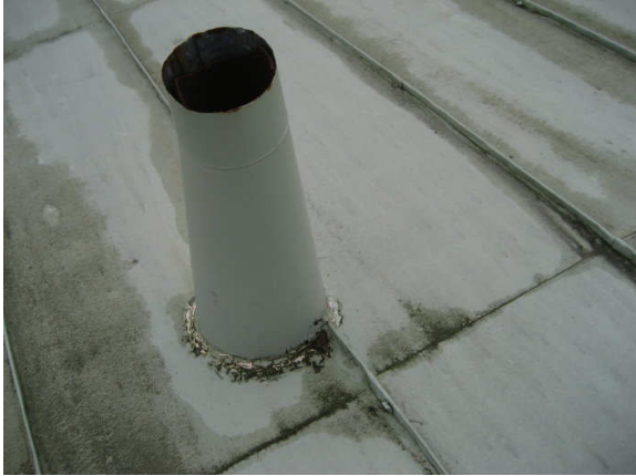
Kuva 9 Viemärin tuuletusputken läpivienissä on kittitiivistys.
