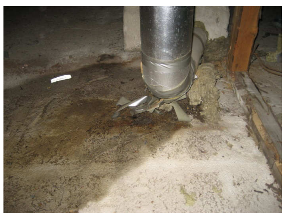
Kuva 12 Yläpohjan betoniölaatta oli vesimärkä ja alla oleva eristekin voi olla kastunut.
