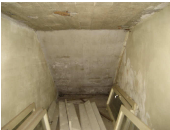
Kuva 17 Portaiden alla on huonokuntoinen säh-kökeskustila, jonka lattia- ja seinäpin-noissa on kosteutta ja ilmanvaihto on huono.
