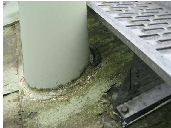
Kuva 10 Eristetty putkiläpivienni, joka vuoti. Kattosillan pulttien läpiviennit ovat riski.
