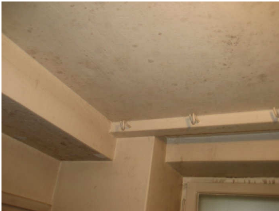
Kuva 15 Pesuhuoneen katossa on hometta.
