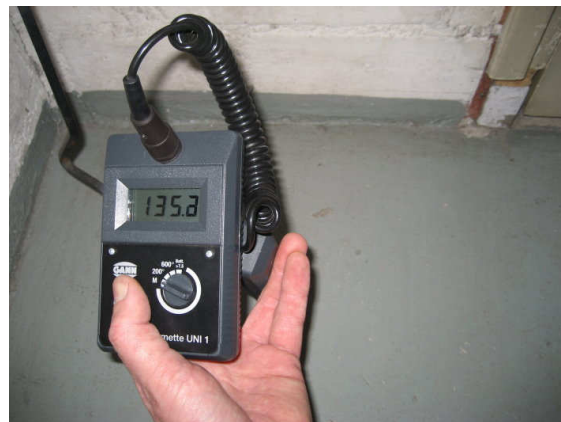
Kuva 18 Tässä Gann pintakosteuden tunnistin näyttää lähes maksimiarvoa kellarin lattiassa länsipäädystä käytävällä.
