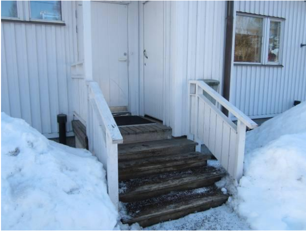
Kuva 17 Keittiön kuluneet portaat ja kaiteet.
