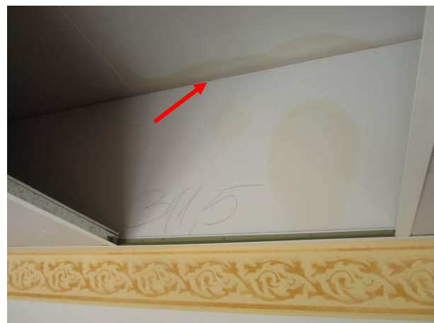
Kuva 36 Vuotojälkiä kotikeittiö 49 katonrajassa väliseinän kohdalla.
