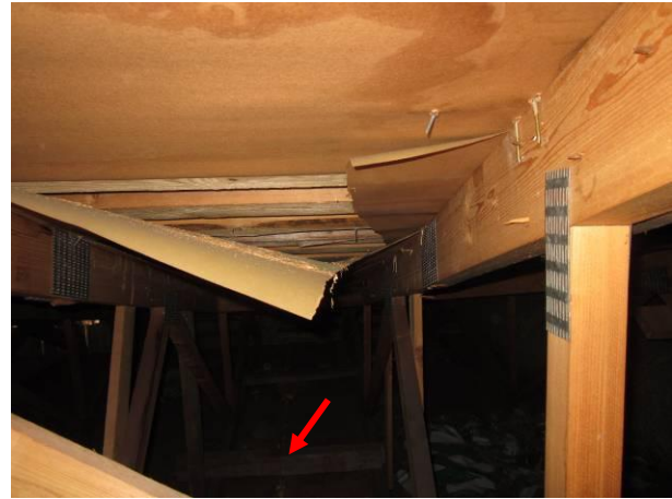
Kuva 24 Aluskate on revennyt rikki, alapaar- teiden varaan on tehty ripustus.
