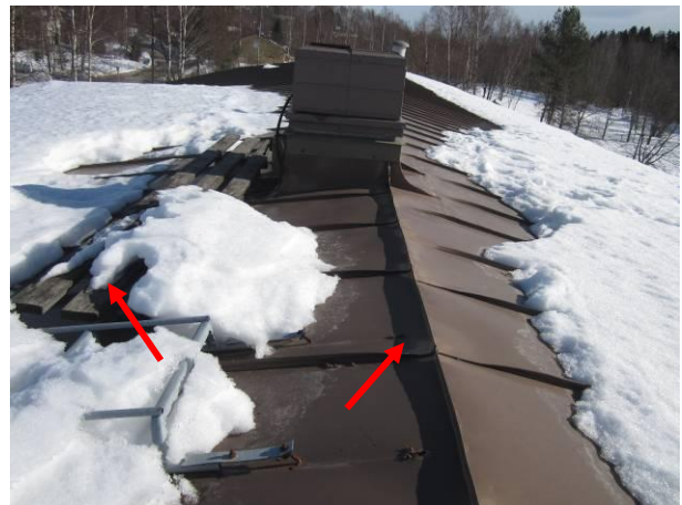
Kuva 20 Huono kattosilta, lapetikkaat ovat irti ja on reikiä.
