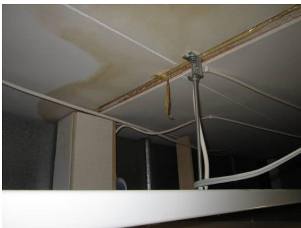
Kuva 35 Vuotojälkiä ET 35 alakattotilassa.
