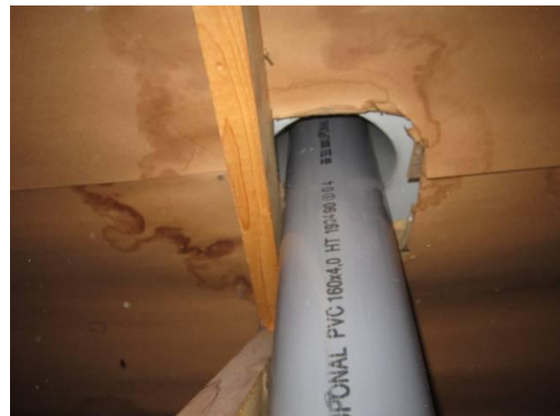
Kuva 26 Aluskate on huonosti alustatilan tuu- letusputken läpiviennissä.
