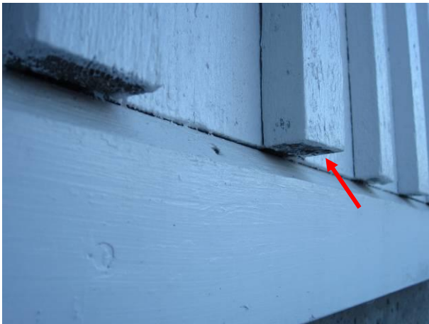
Kuva 11 Sokkelinrajan vaakalista, pystyri- mojen päät on maalaamatta.
