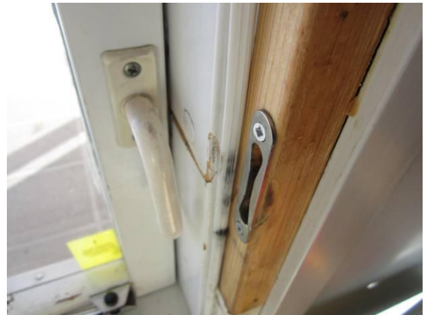
Kuva 16 Tuuletusikkunan vastalevy on painunut, ei sulkeudu tiiviisti.
