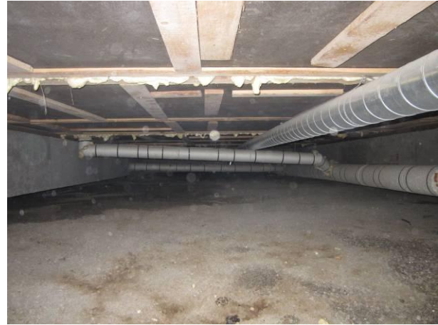
Kuva 8 Ryömintätilaa, sepelissä on mikrobi- kasvua.
