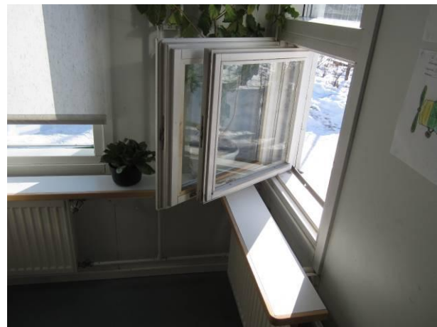
Kuva 40 Yleinen "ilmanvaihtoratkaisu" vaikutti olevan jäähdytyskeino.
