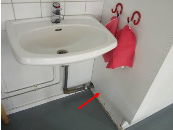
Kuva 37 Lavuaarin vieressä roiskevesivaurioita ryhmähuoneessa 10.
