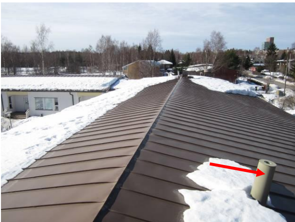
Kuva 19 Yleiskuva, kallistunut putki.
