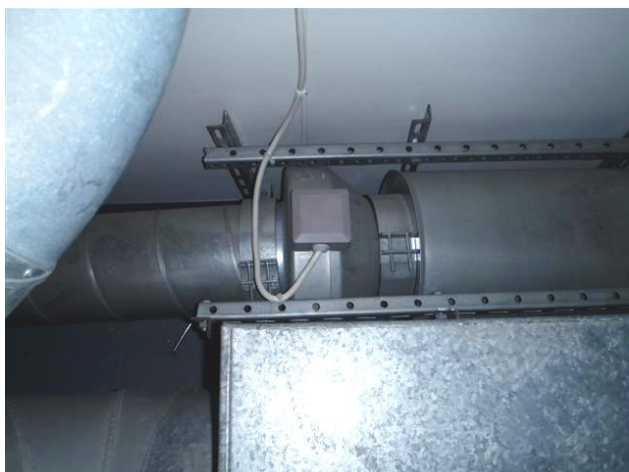
Kuva 3 Alapohjan tuuleuksesta ja teknisen tilan ilmanvaihdosta vastaava kanavapuhallin PF3.
