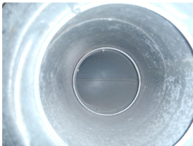
Kuva 2 Lähes puhdas poistoilmakanava.
