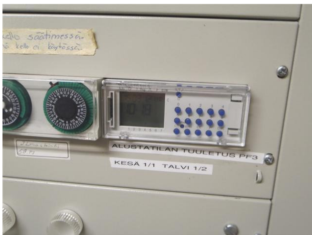
Kuva 4 Kanavapuhaltimen PF3 ajastinkello.
