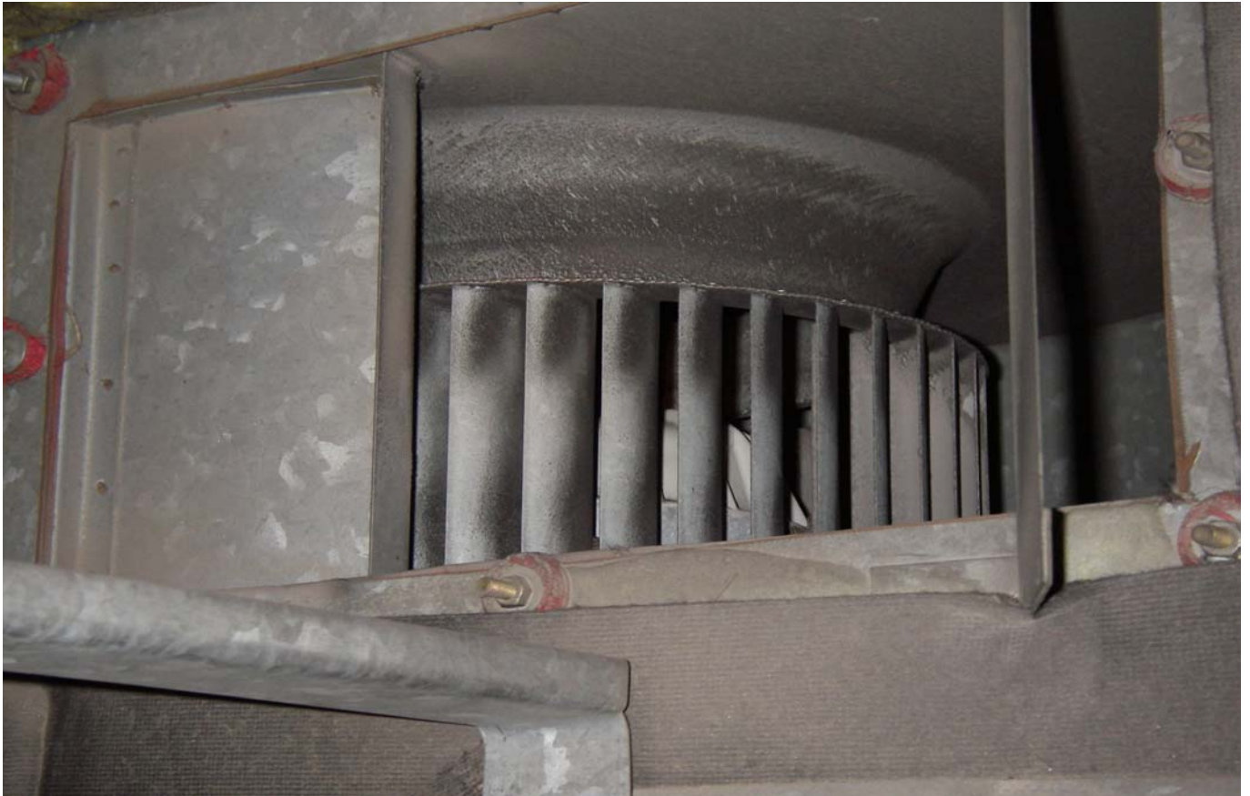
KUVA 5. Tuloilmapuhallin on hieman nokinen.
