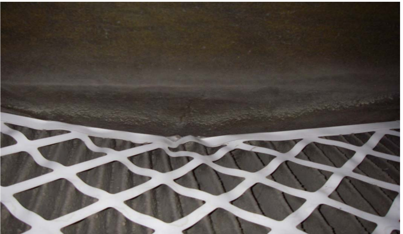
KUVA 2. Tuloilmakoneen suodatin on likainen ja pois paikoiltaan.
