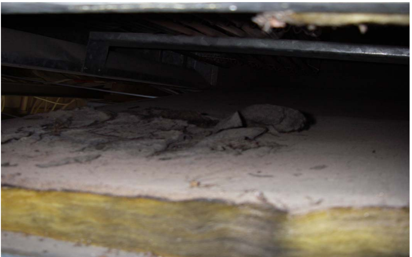
KUVA 4. Tuloilmakoneen kammioiden mineraalivillaiset seinämät ovat osin pahoin rikki
