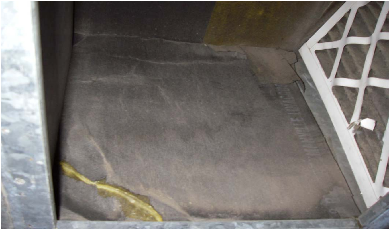
KUVA 3. Tuloilmakoneen kammioiden seinämät on vuorattu mineraalivillalla, joka on osin rikki.
