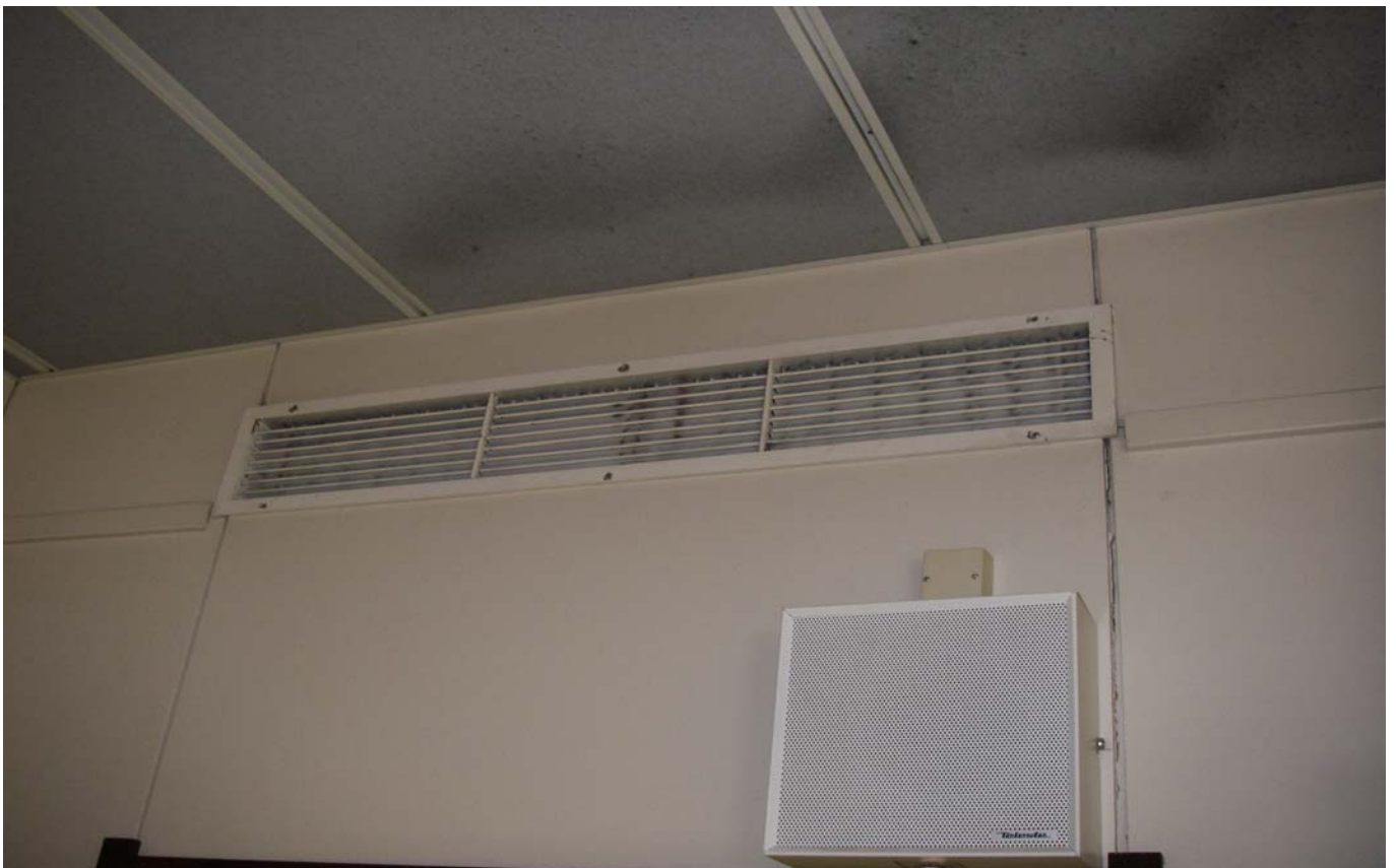
KUVA 8. Luokkatilojen tuloilmasäleiköt ovat ritiläsäleikköjä.
