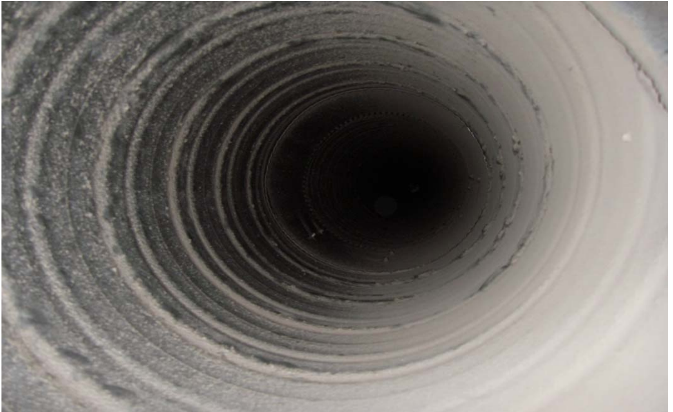
KUVA 7. Poistoilmakanavissa on melko paljon pölykertymää.
