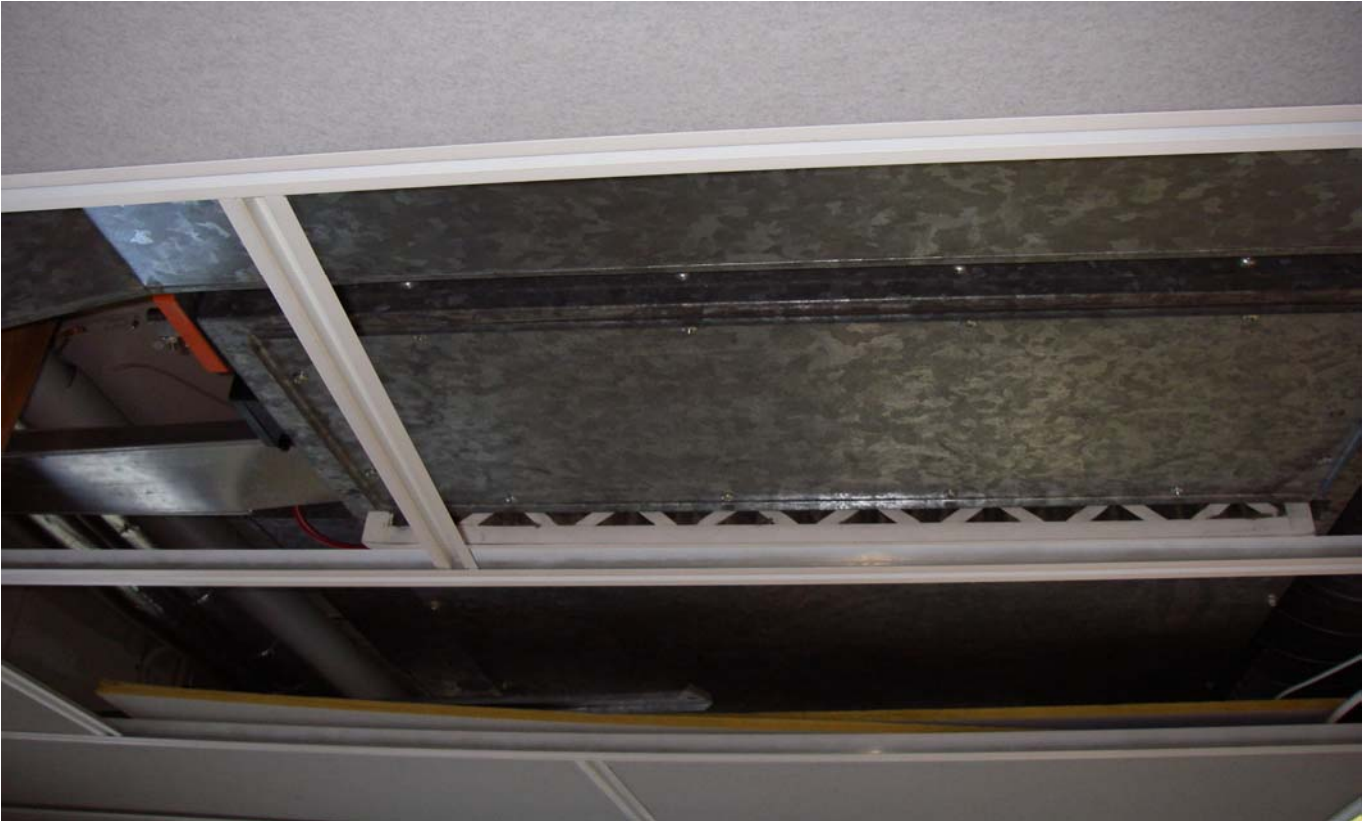
KUVA 1. Ilmastointikone on alkuperäinen Ilmaterän valmistama ns. pakettikone.
