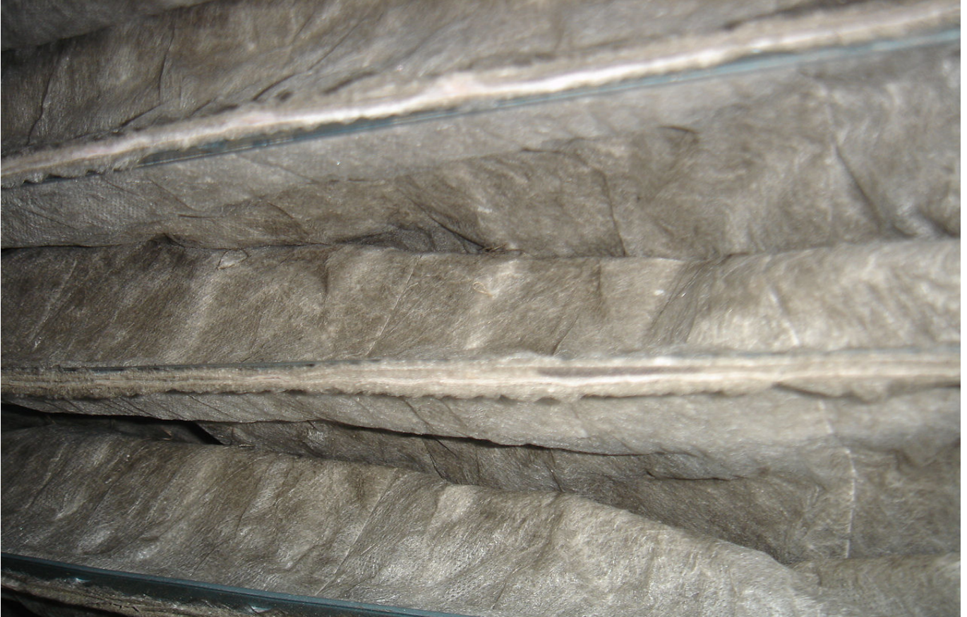
KUVA 11. Yleiskuva tuloilmailmasuodattimesta TK 04, TF 01.
