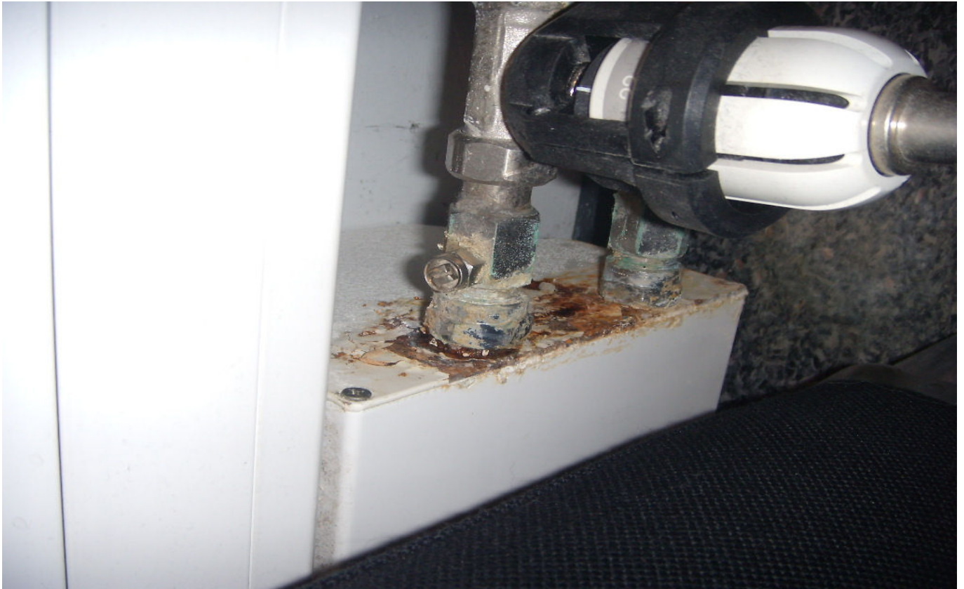
KUVA 35. Opettajien huoneessa n:o 1.35 lämpöpatterin liitos vuotaa.
