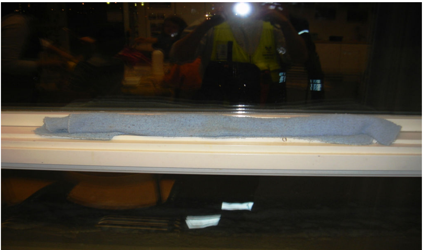
KUVA 30. Ikkunan karmin välistä tulee sateella vettä.
