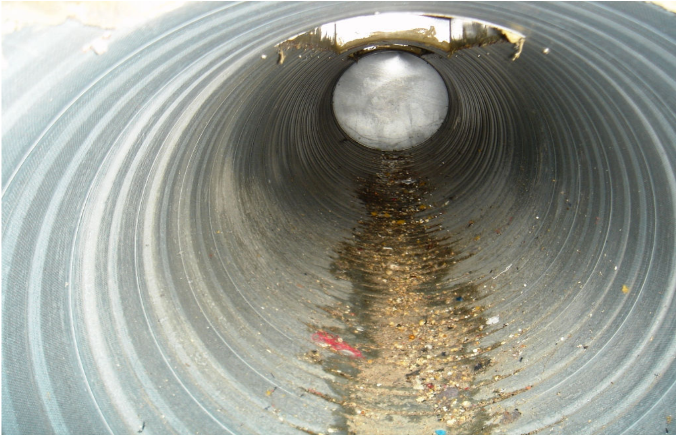
KUVA 21. Yleiskuva liikuntasalin tuloilmakanavasta.
