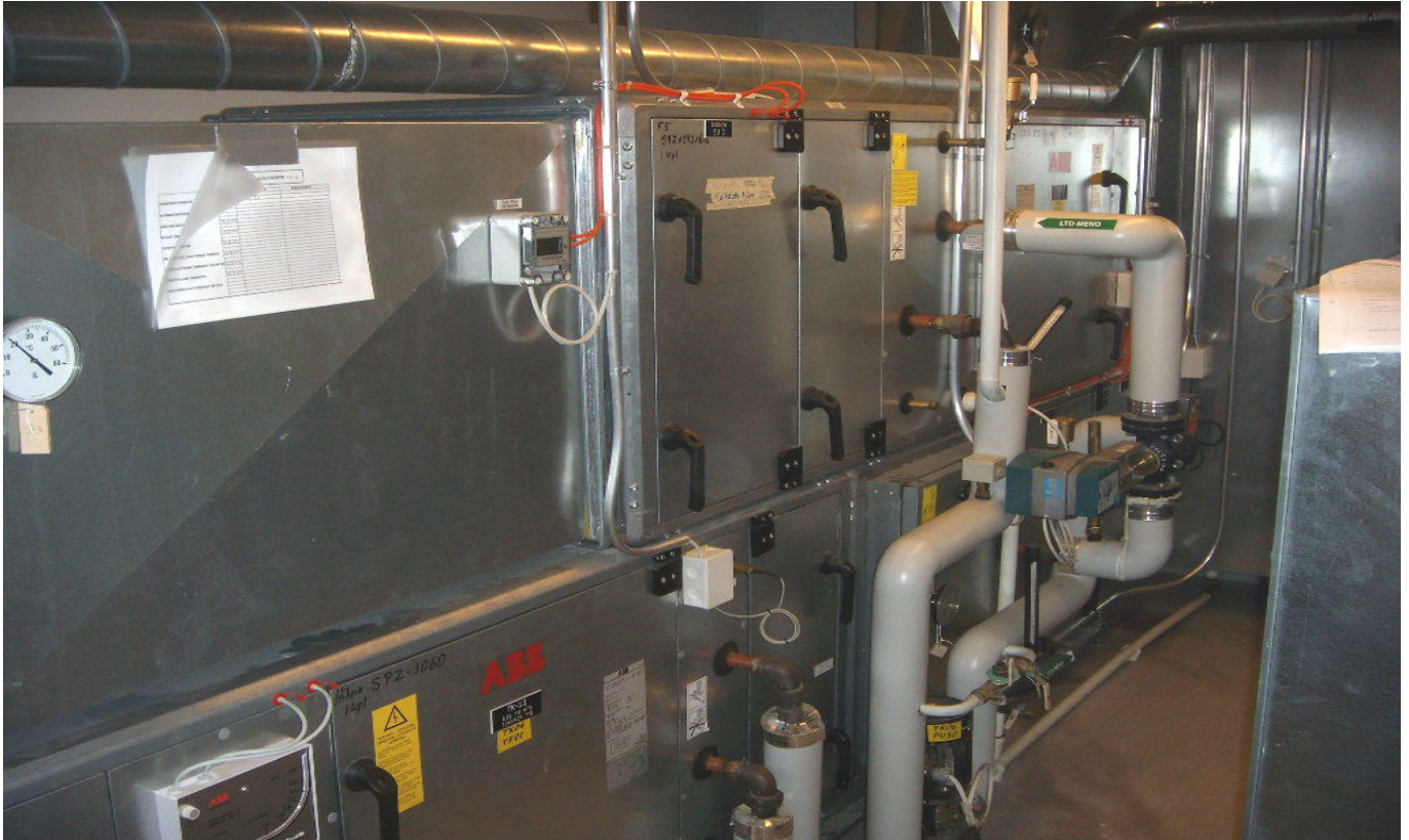
KUVA 1. Yleiskuva IV- konehuoneesta.
