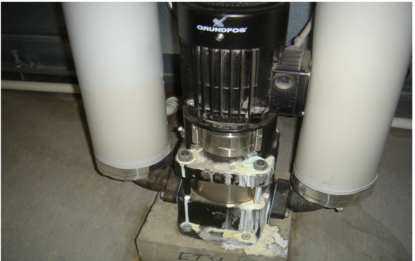
KUVA 4. Yleiskuva LTO:n kiertovesipumpusta.
