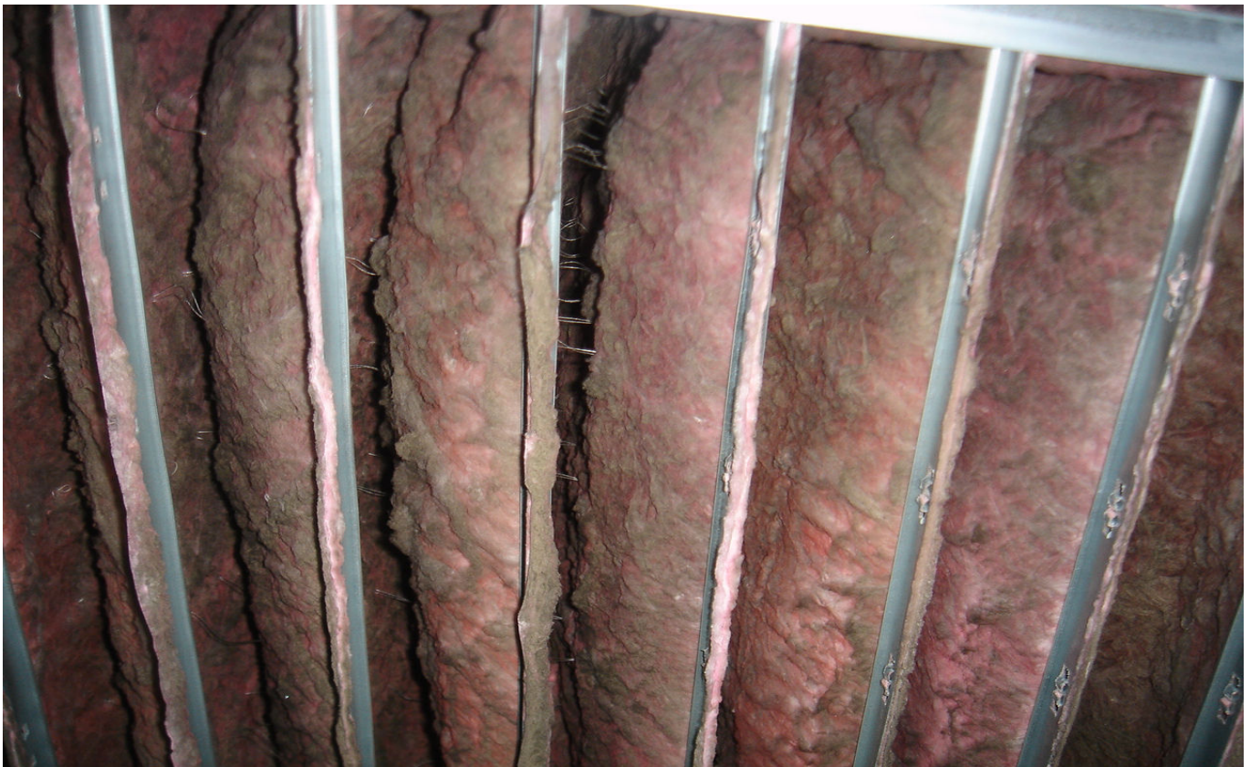
KUVA 6. Yleiskuva tuloilmasuodattimista TK 02, TF01.
