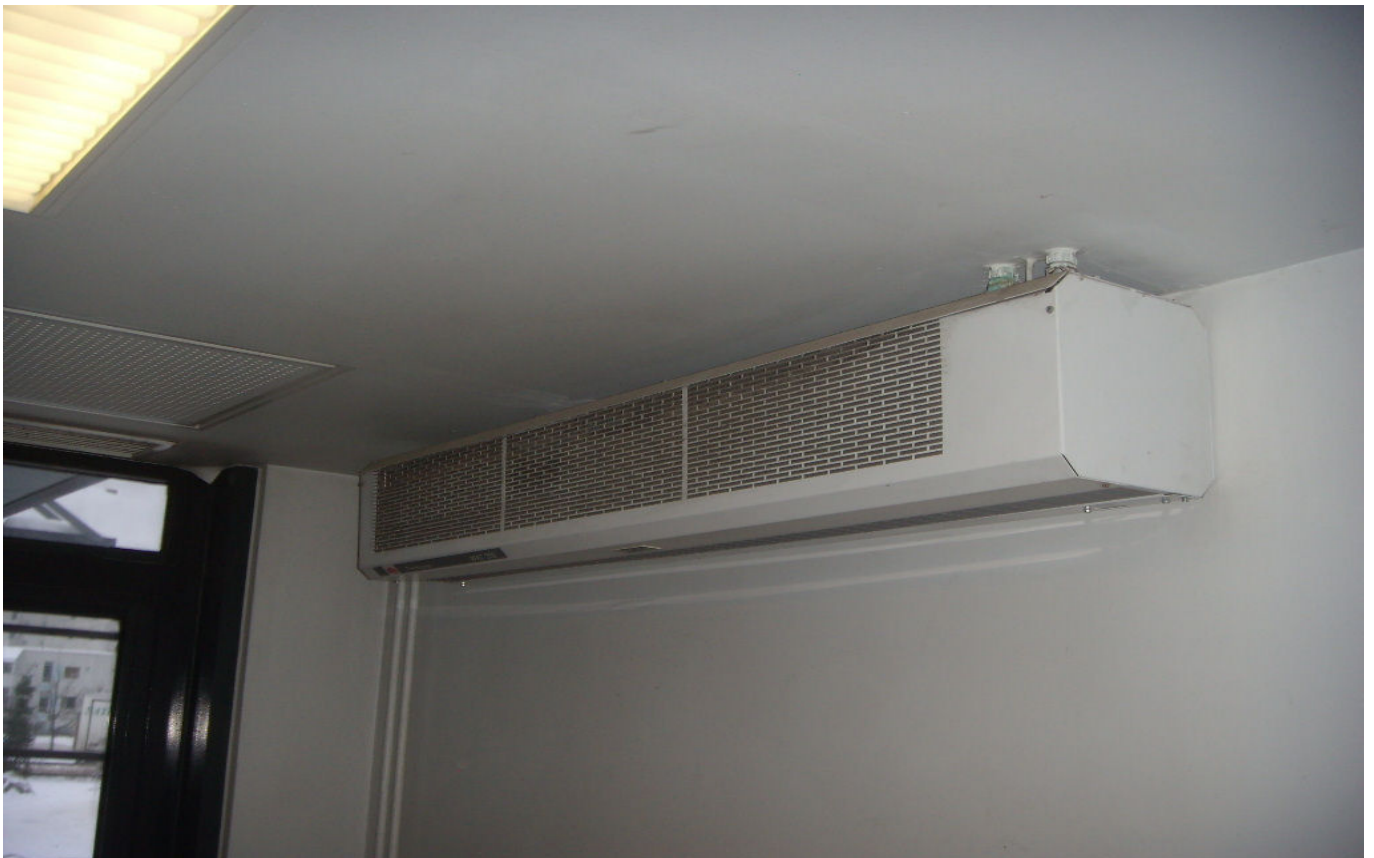
KUVA 36. Koulun tuulikaappeja palvelevat kiertoilmakoneet.
