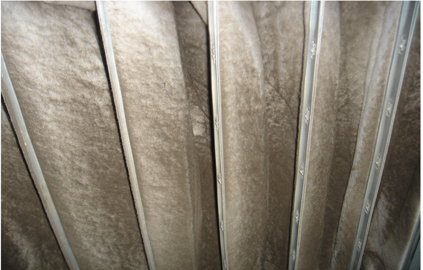
KUVA 5. Yleiskuva tuloilmasuodattimista TK 02, TF01.
