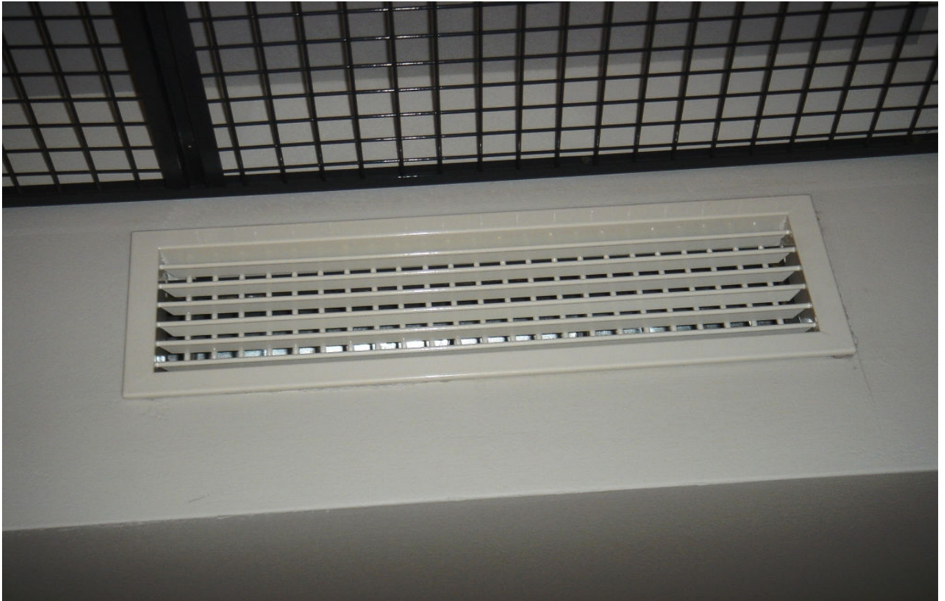
KUVA 25. Yleiskuva tuloilman ritiläsäleiköstä.
