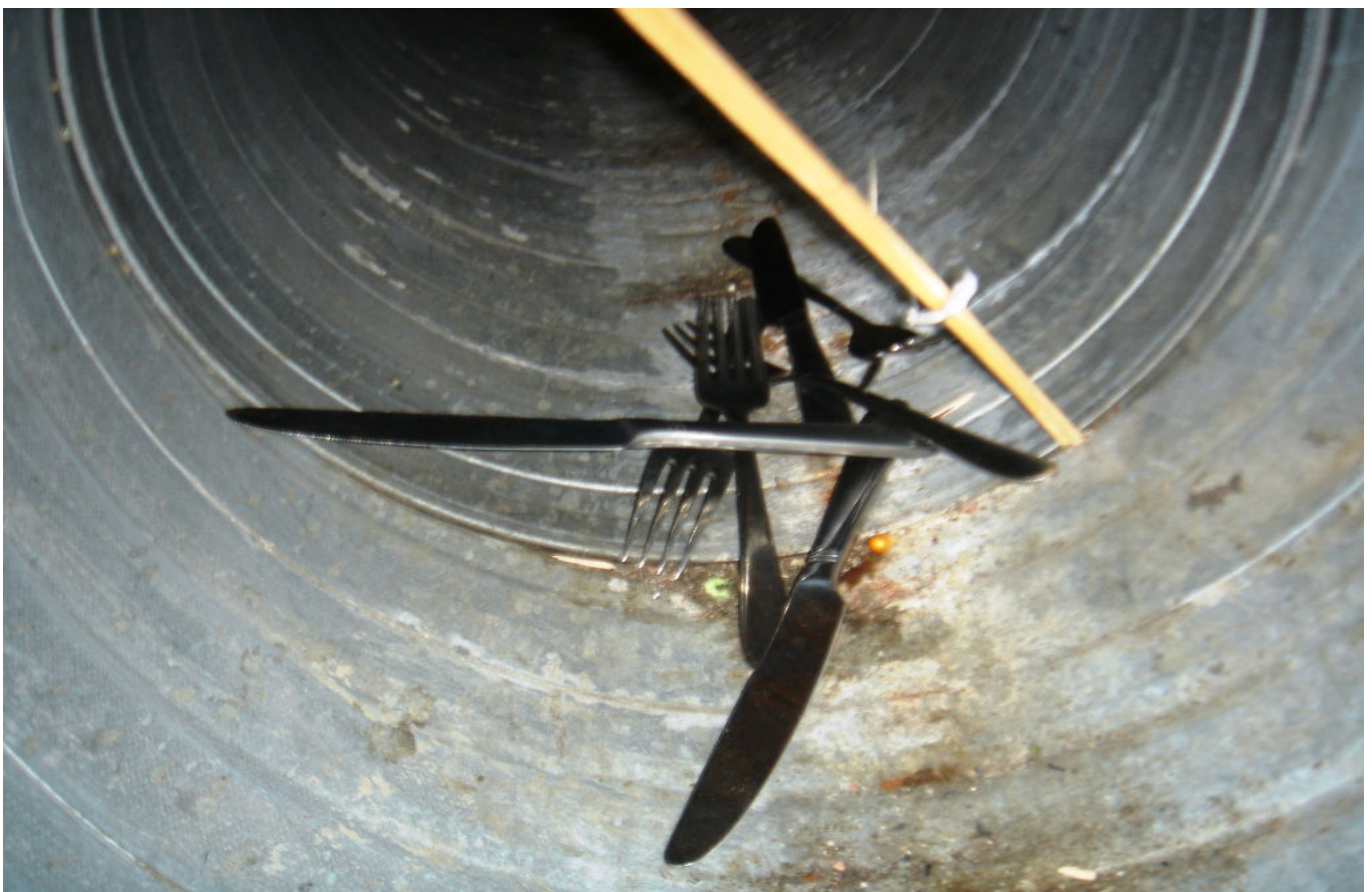
KUVA 20. Yleiskuva liikuntasalin tuloilmakanavasta.
