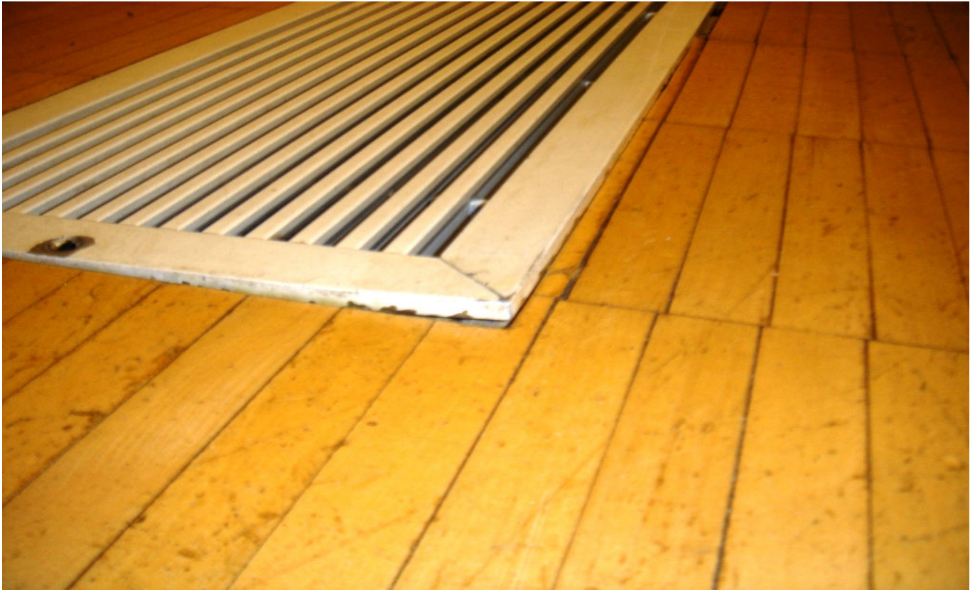
KUVA 27. Yleiskuva liikuntasalin lattialla olevasta tuloilman ritiläsäleiköstä.
