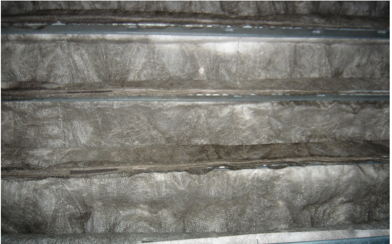
KUVA 9. Yleiskuva tuloilmasuodattimista TK 03, TF01.
