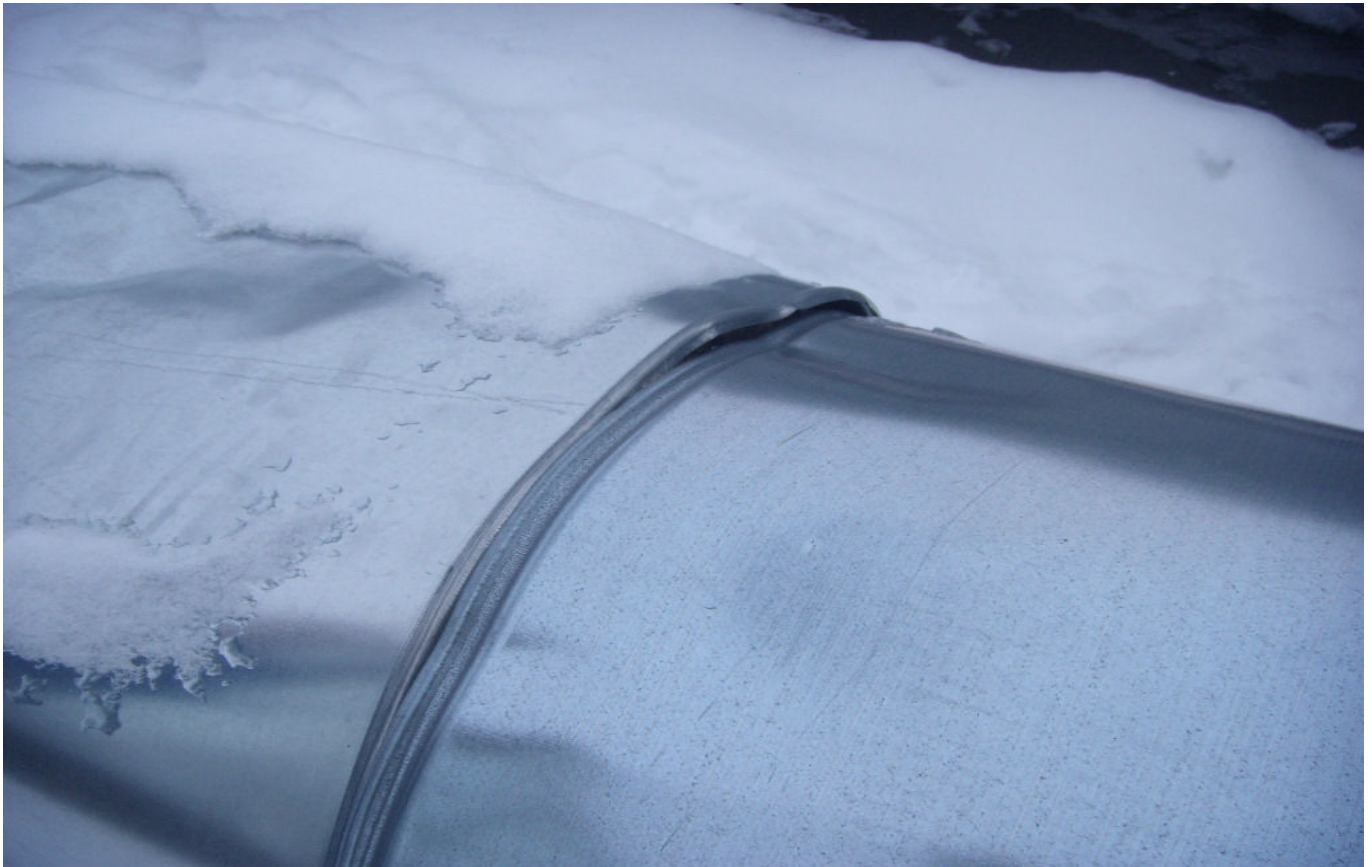
KUVA 24. Yleiskuva vesikatolla olevista ilmastointikanavista.
