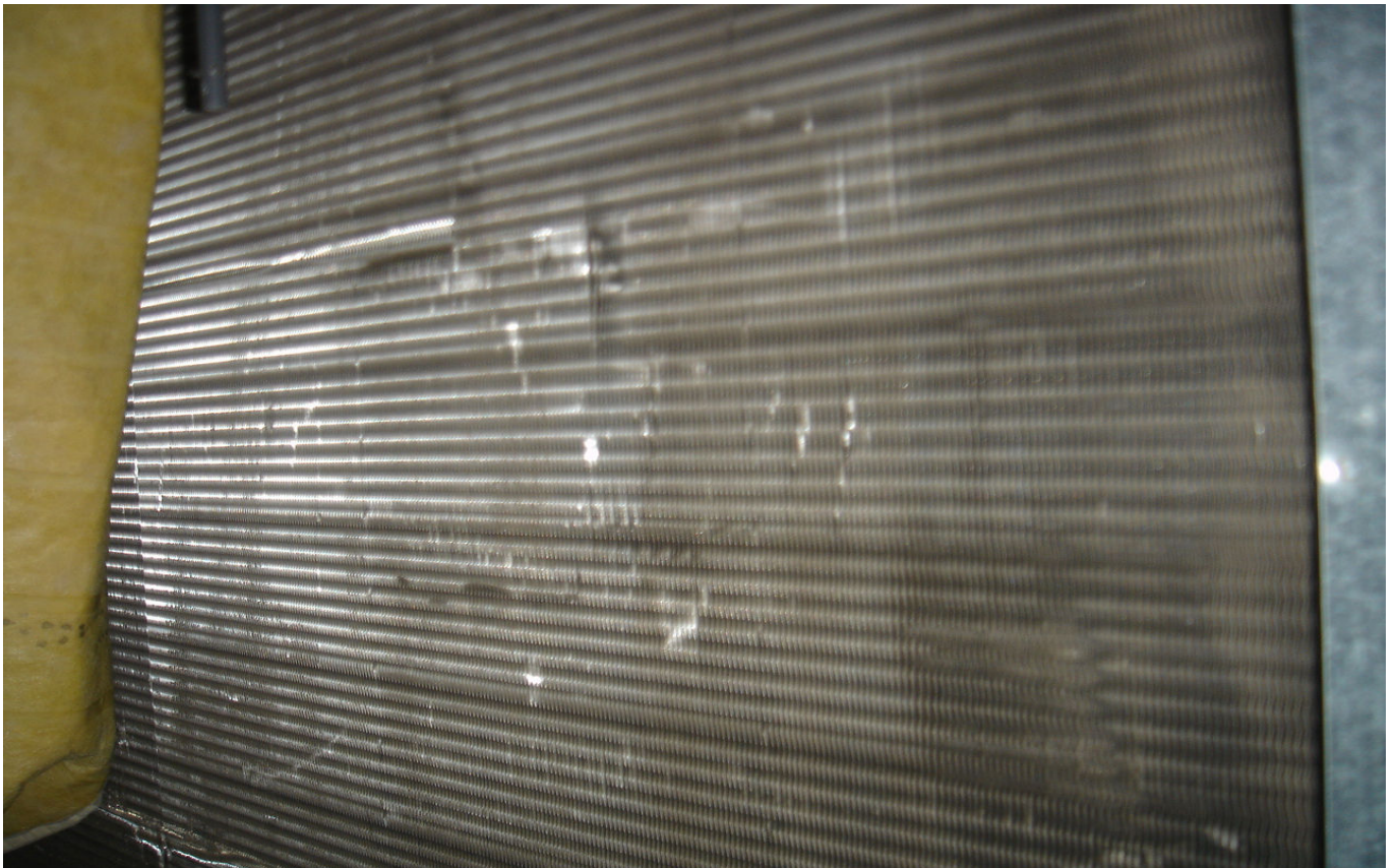
KUVA 10. Yleiskuva lämmityspatterista TK 03, TF01.
