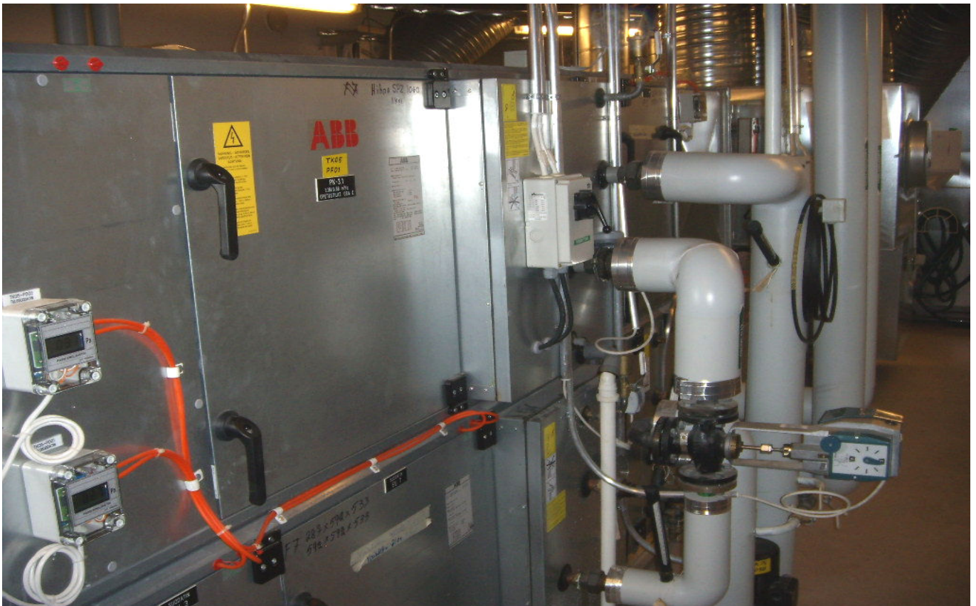
KUVA 2. Yleiskuva IV- konehuoneesta.
