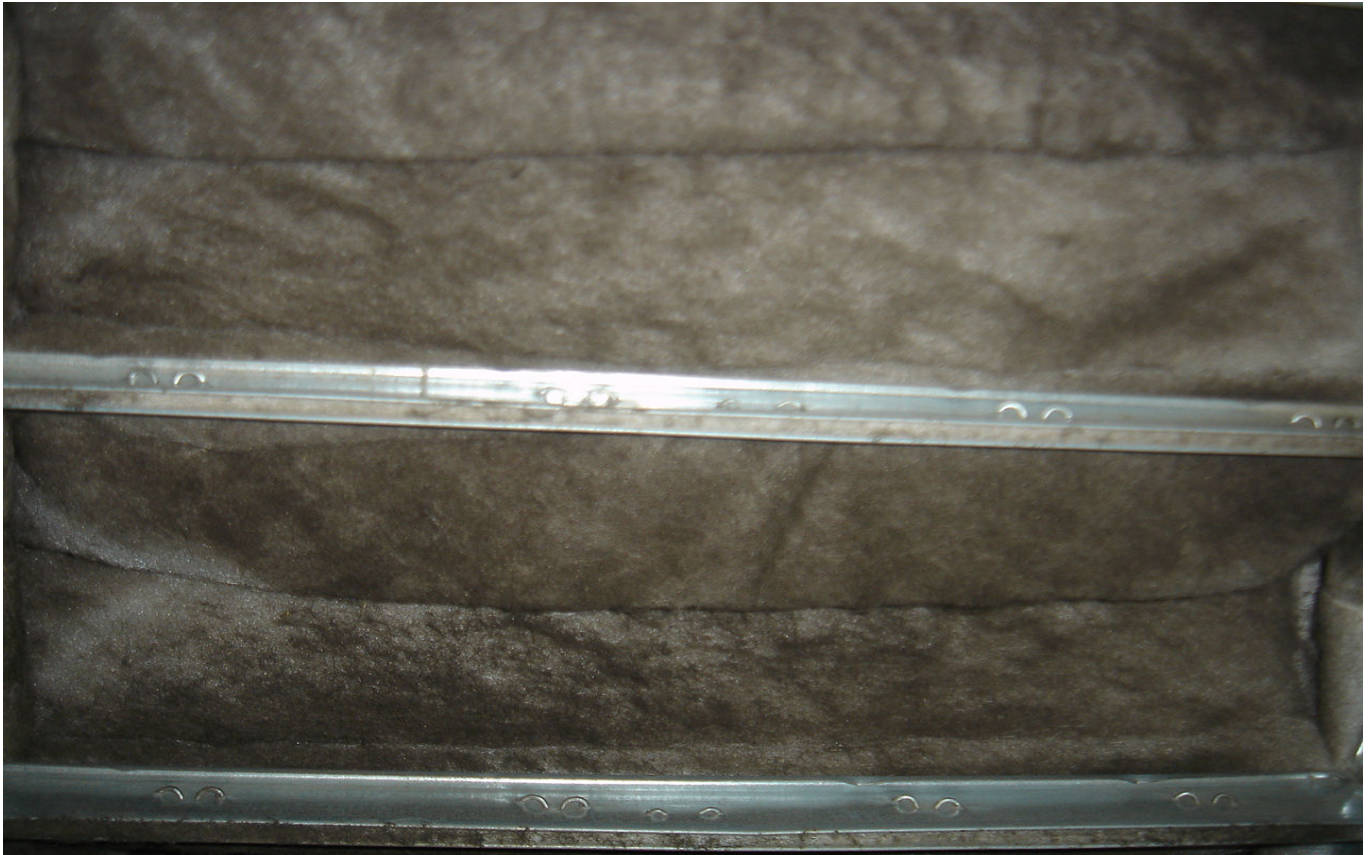
KUVA 3. Yleiskuva tuloilmasuodattimista TK 01.
