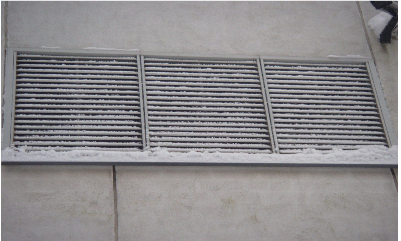
KUVA 17. Yleiskuva tuloilmakoneen ulkosäleiköistä.
