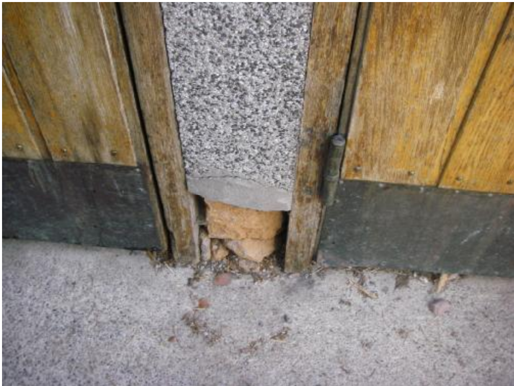
Sokkelissa on rapautumaa liikuntasalisiiven kellarikerroksen WC:n kohdalla.
