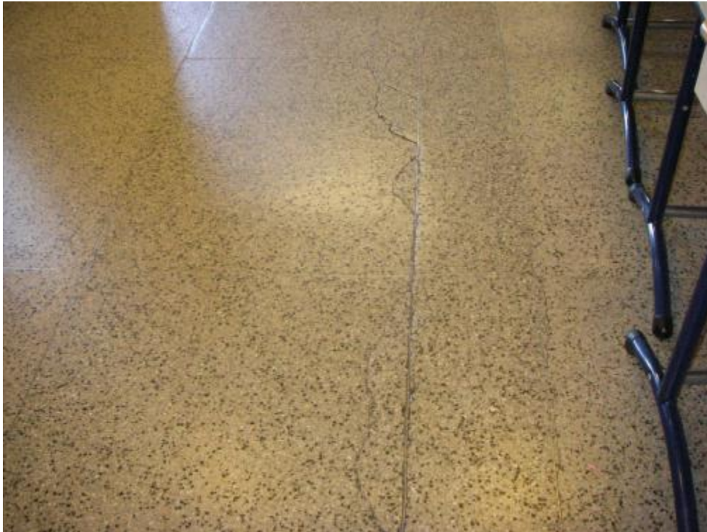
Ensimmäisen kerroksen käytävän lattiassa on halkeamia.
