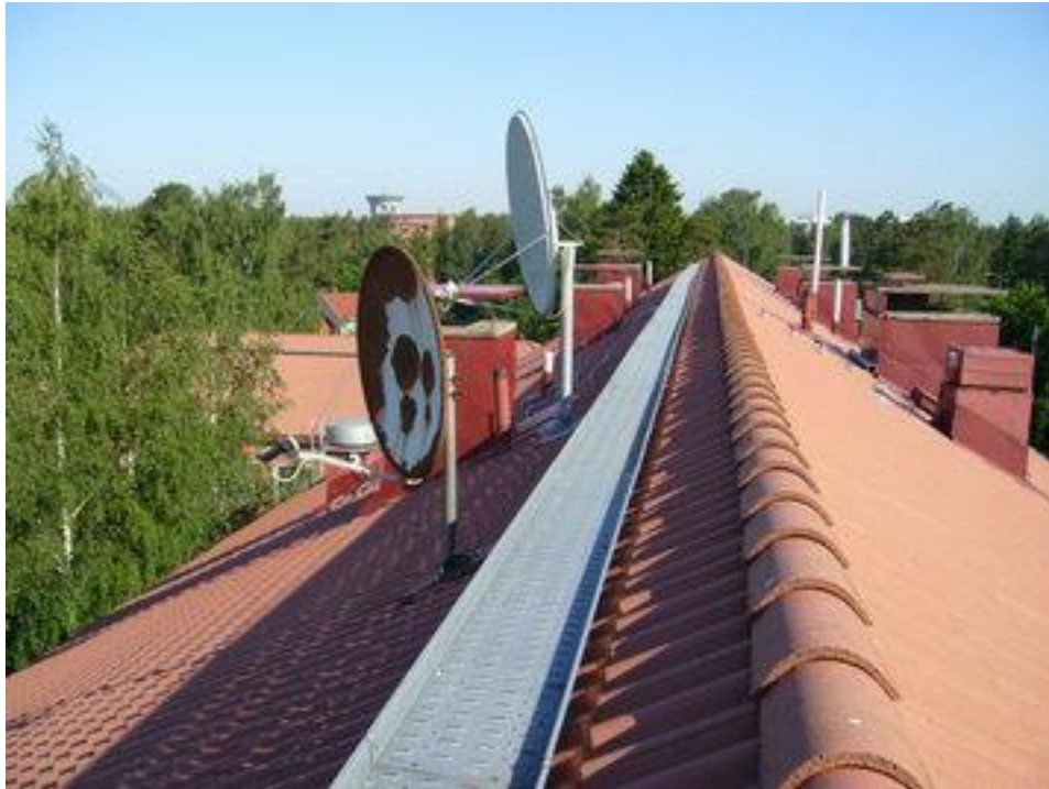
Katolla olevat satelliittilautaset ovat osittain ruosteessa.
