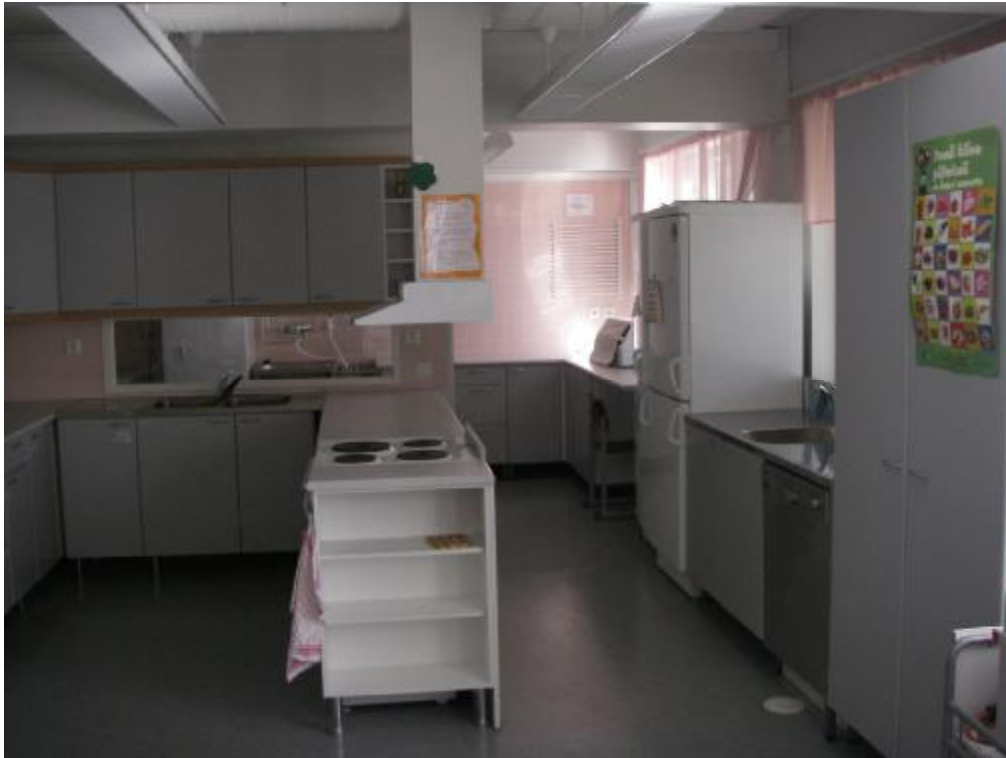
Ensimmäisessä kerroksessa sijaitsevan kotitalousluokan rakenteet on remontoitu ja ne ovat hyvässä kunnossa.
