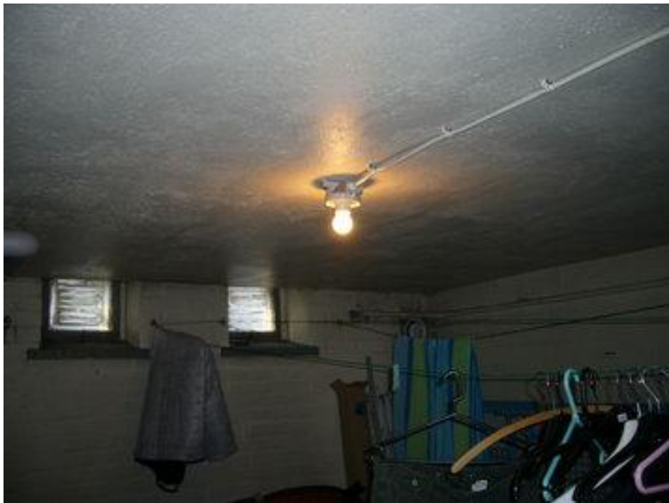
Valaisimesta puuttuu suojakupu.
