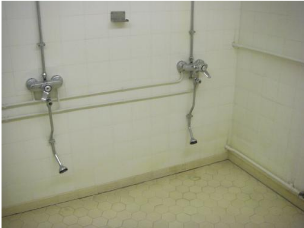
Liikuntasalin kellarikerroksessa olevat märkätilat alkavat olla elinkaarensa päässä.
