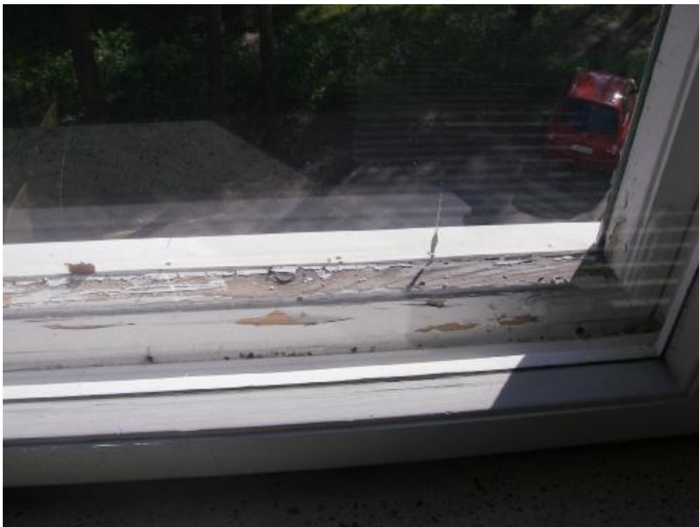
Ikkunoiden maalipinta hilseilee monin paikoin varsinkin ulkopuolteiden osalla.
