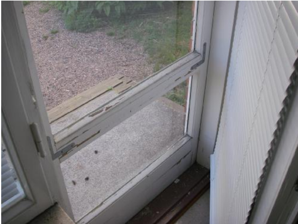
Mm. toimisto-osan ulko-ovi vaatii huoltokäsittelyä.
