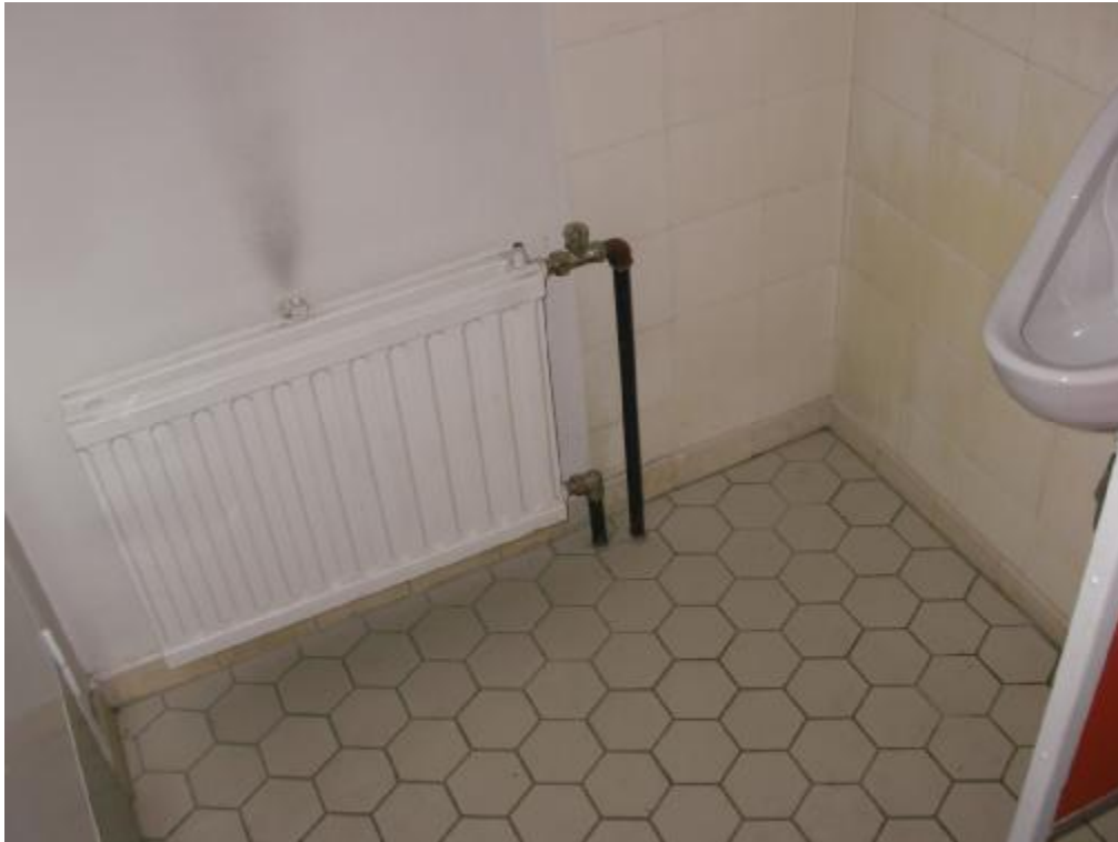
Sisääntuloaulan WC-tilat ovat teknisesti ikääntyneitä.
