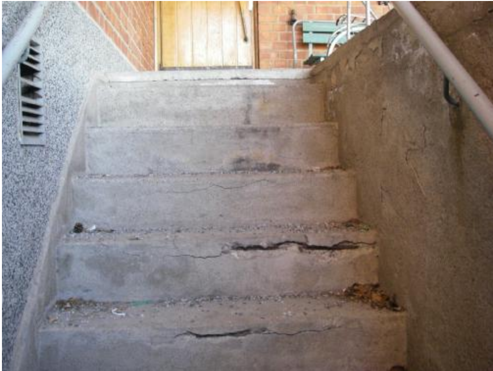
Samoin kellarin WC-tiloihin johtavissa ulkoportaissa esiintyy rapautumaa.
