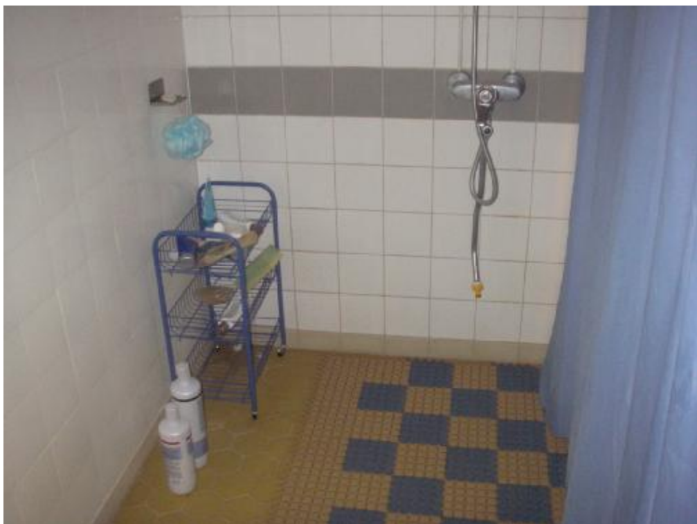
Saunaosaston märkätilat ovat kunnossa.
