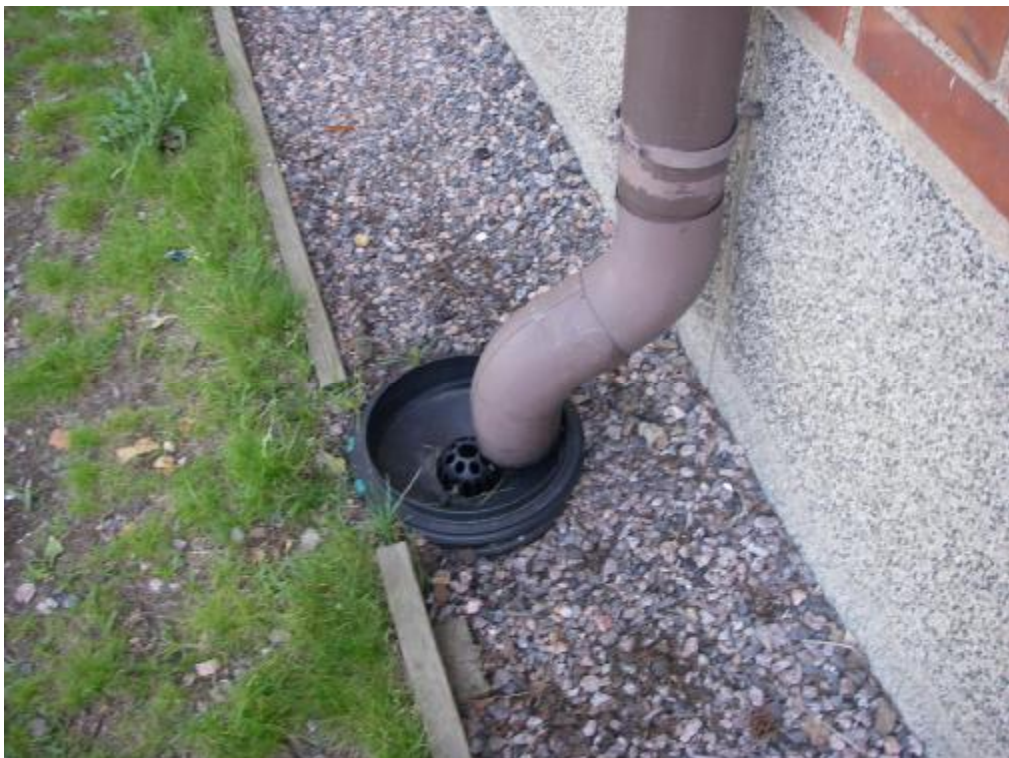
Kattovedet ohjautuvat sadevesijärjestelmällä pois rakennuksen vierustalta.
