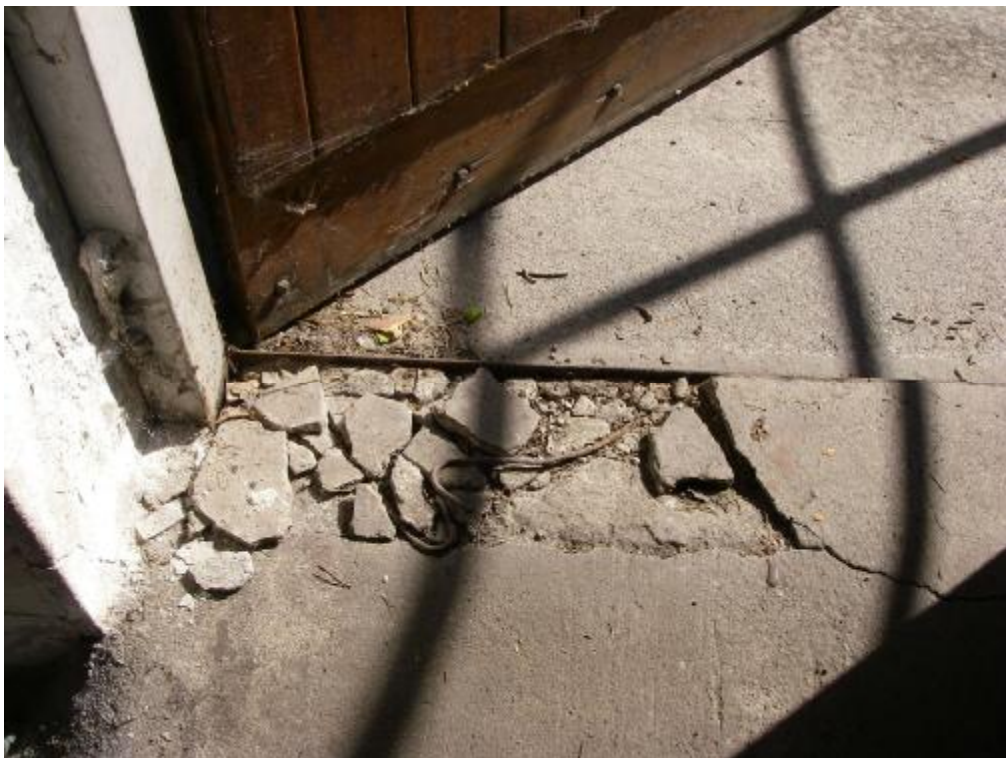
Autotallin betoniluiskassa on vaurioita oven kohdalla.
