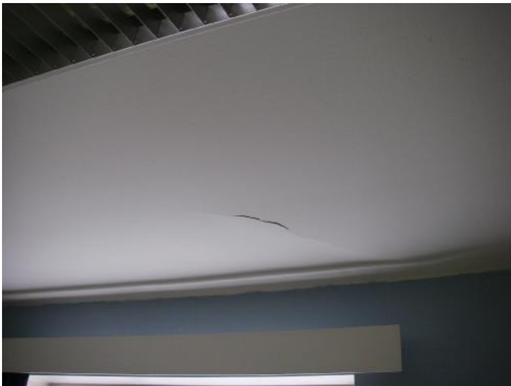
Kanslian kokoustilan sisäkatossa oleva halkeama on syytä korjata.
