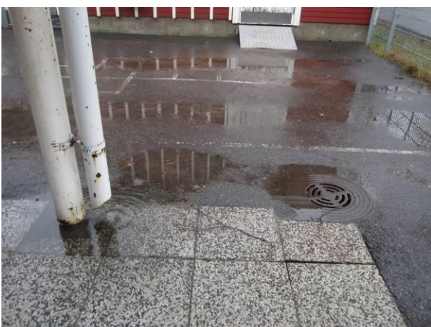
Kuva 13 Rännivedet valuvat asfaltille ja sitten kaivoon.
