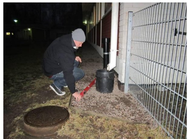
Kuva 4 Kulmalla kallistukset ovat pienet, mutta viettävät ulospäin.
