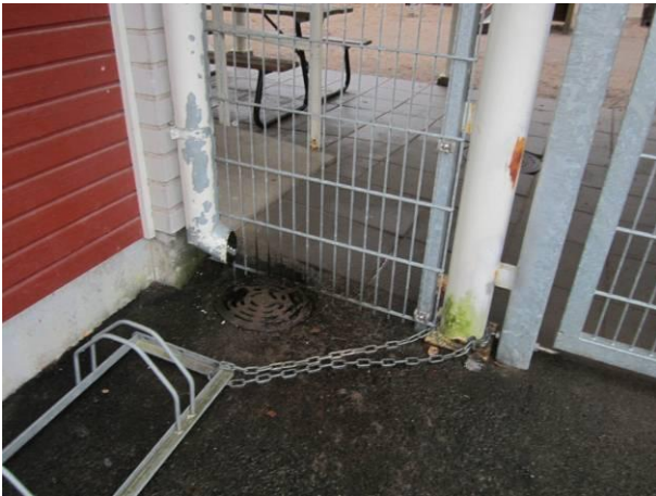
Kuva 11 Rännivedet ohjautuvat kaivoon.
