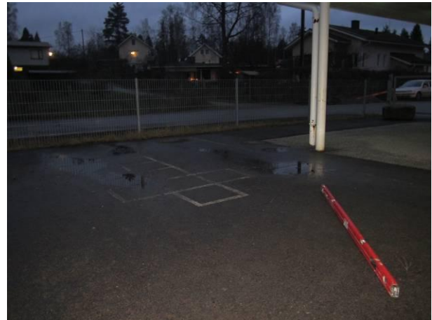
Kuva 12 Vesi lätköityy paikoin tasaiselle pihalle.
