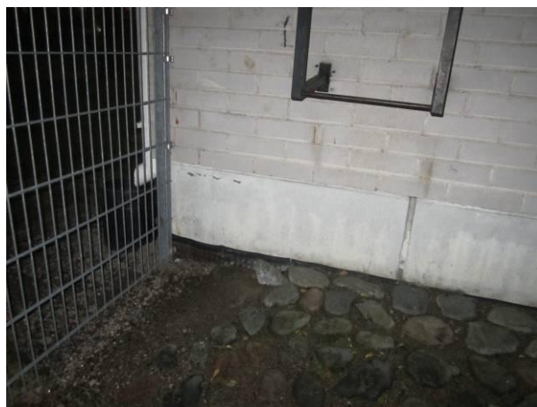
Kuva 3 Koillispäädyn alakulmalla kenttäkiveys puuttuu.
