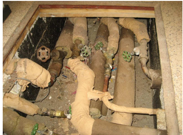
Kuva 16 Käytävällä putkikanaalissa on roinaa. Kanaali toimii hajujen kulkureittinä. Kanaalin sivuilla ja pohjalla on piki.
