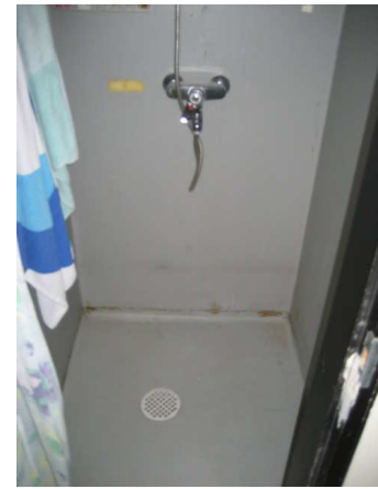
Kuva 20 Henkilökunnan sosiaalitalan suihkukomeron pinnat ovat vanhat.
