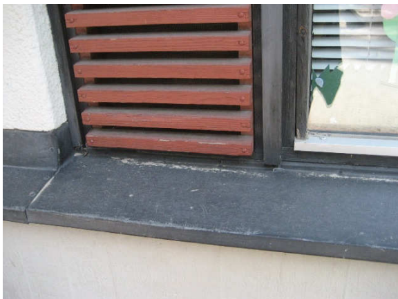
Kuva 11 Ikkunoiden ulkopinnat ovat kuluneet, vesipellit ovat hyvin loivat .
