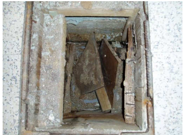
Kuva 4 Lahonnut valulautoitus viemärikaivossa.
