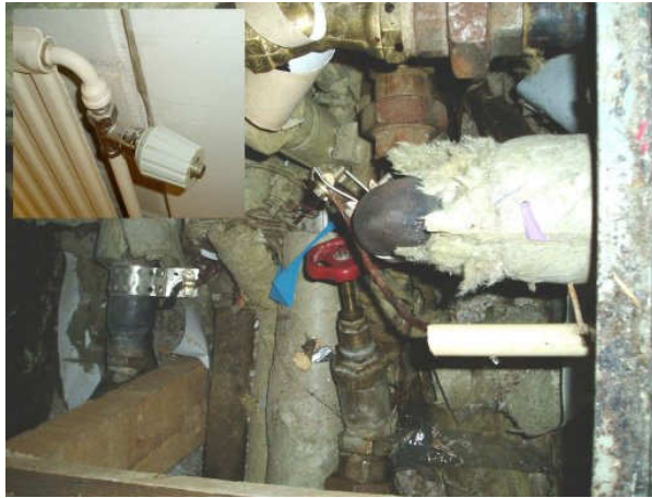
Kuva 1 Lämmitysjärjestelmän toimimaton varustus.
