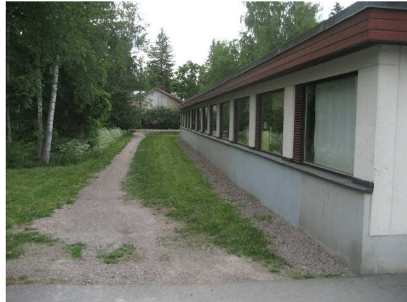
Kuva 2 Kulunut nurmi koillissivulla. Sokkelin maalipinta on kirjava.
