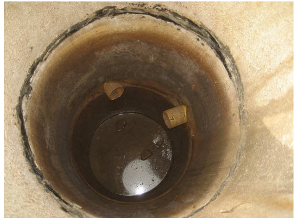
Kuva 4 Kaakkoispäädyn itäkulman salaojan tarkastuskaivossa pohjalla on vesi reilusti juoksupintaa alempana.
