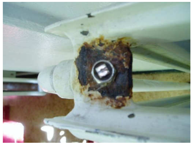
Kuva 2 Korjausta vaativa ruostevaurio lämpöpatterissa.
