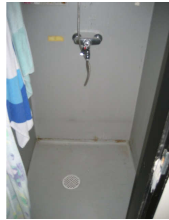
Kuva 20 Henkilökunnan sosiaalitalan suihkukomeron pinnat ovat vanhat.
