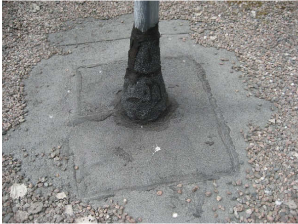
Kuva 13 Antennin läpivientiä ei ole tehty ao. kumiläpiviennillä.
