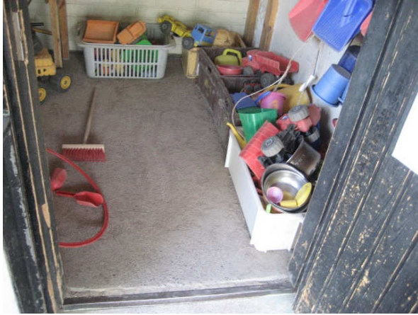
Kuva 19 Lasten ulkoleikkivälineiden varastotila on kulunut, samoin ulko-ovi.
