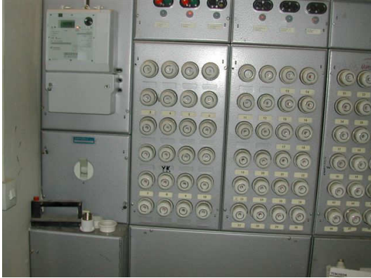
Kuva 1 Yleiskuva alkuperäisestä sähkökeskuksesta.
