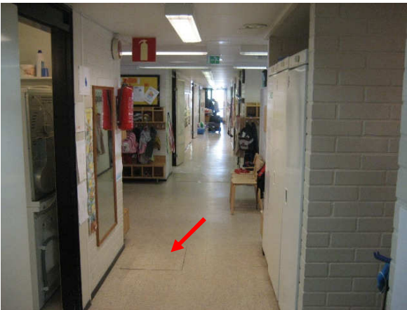
Kuva 27 yleiskuva käytävältä, jossa on useita luukkuja knaaliin. Oikealla kuivauskaapit.
