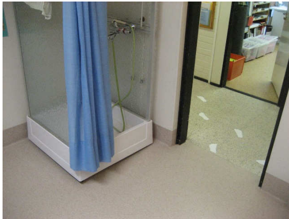
Kuva 21 Lasten wc-tilan suihkukaappi. Ovella ei ole kynnystä hulevesien varalta.
