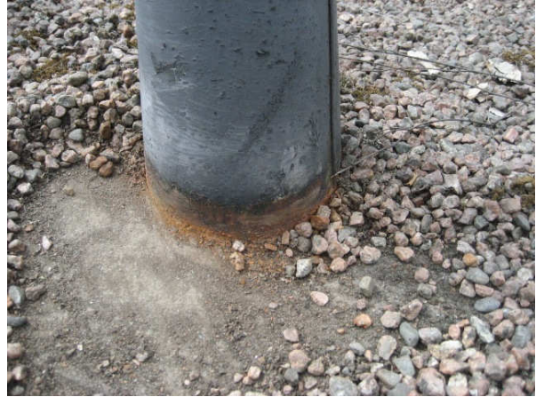
Kuva 14 Viemärin tuuletusputken peltisuojaus on ruostunut ja voi alkaa vuotaa.
