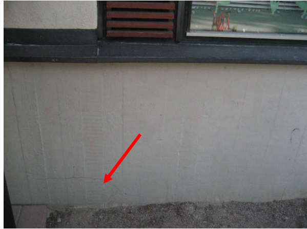
Kuva 8 Pitkien sivujen sokkelit nousevat vaalesokkeleina. Pinnat ovat siistit, mutta satunnaisia halkeamia on. Raudoitteiden kuntoa ei voitu arvioida.
