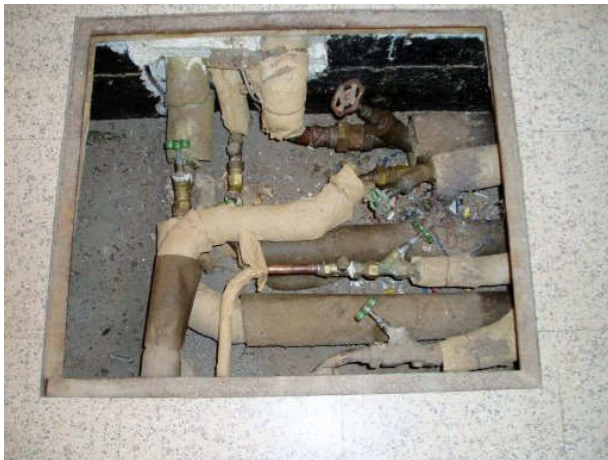
Kuva 3 Vesijohtoverkoston toimimaton varustus.
