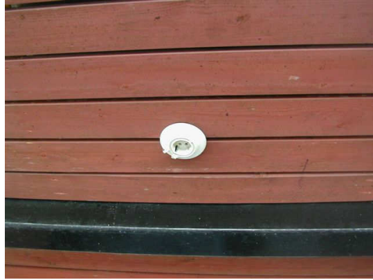
Kuva 4 Katoksen katon pistorasiasta puuttuu kansi.
