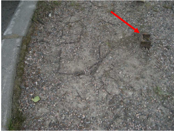
Kuva 7 Paikoitusalueen edessä olevan saarekkeen törröttävä rautapaalu, joka tulee poistaa tai peittää maalla.
