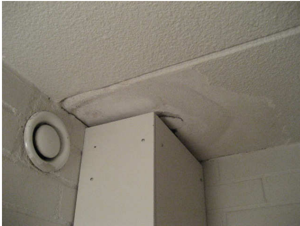
Kuva 15 Siivouskomeron katossa oleva vanha vuotojälki oli kuiva.
