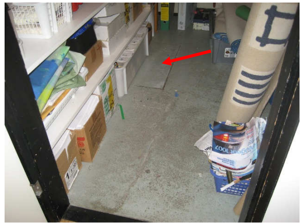
Kuva 26 Luoteispäädyn varasto, jonka lattia on kulunut ja siinä on epätiivis luukku.
